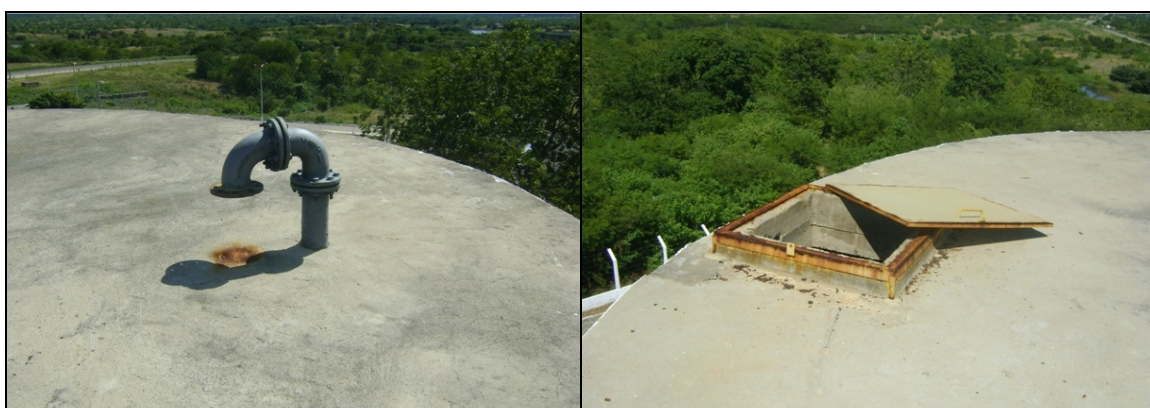
Foto 37 – Ventilação do REL-04.
