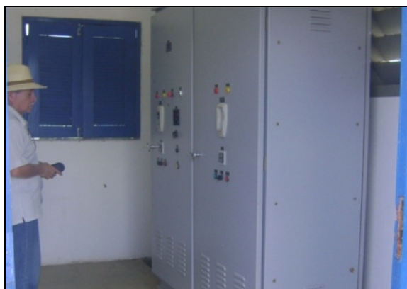
Foto 26 – Quadro de comando.
