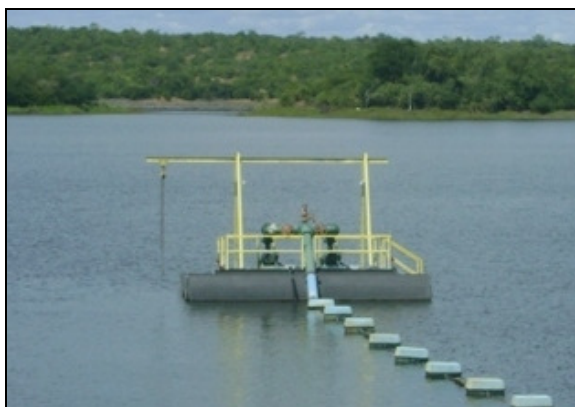
Foto 24 – Conjunto moto-bomba em flutuante.
