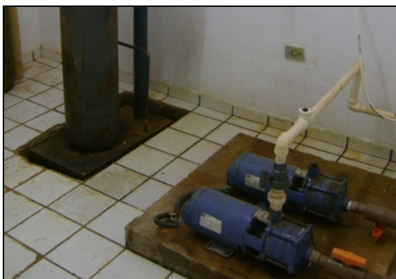
Foto 17 – Bombas dosadoras de cloro gasoso.
