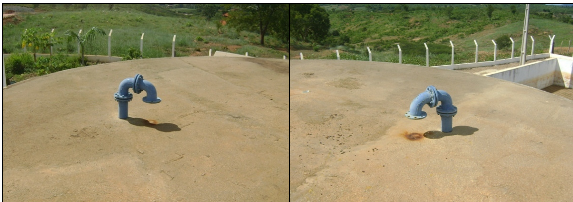
Fotos 32 e 33 – Tubos de ventilação do RAP-03.
