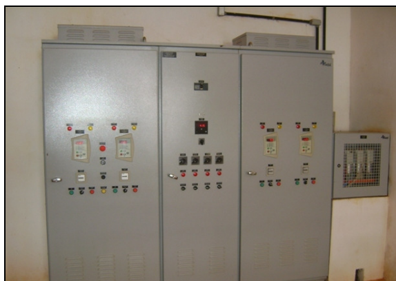
Foto 29 – Quadro de comando da EE-02.
