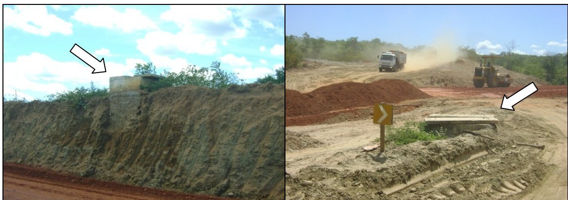
Fotos 48 e 49 – Caixas de registro expostas.
