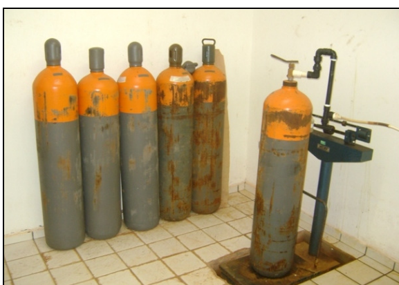
Fotos 15 e 16 – Cilindros de cloro gasoso e balança.
