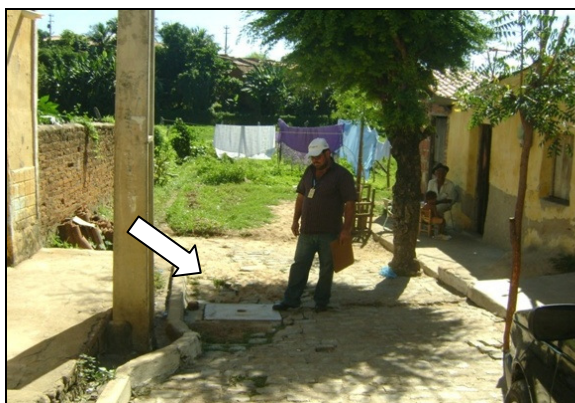
Foto 54 – Registro de descarga, Rua Antônio Gonçalves Aranha.
