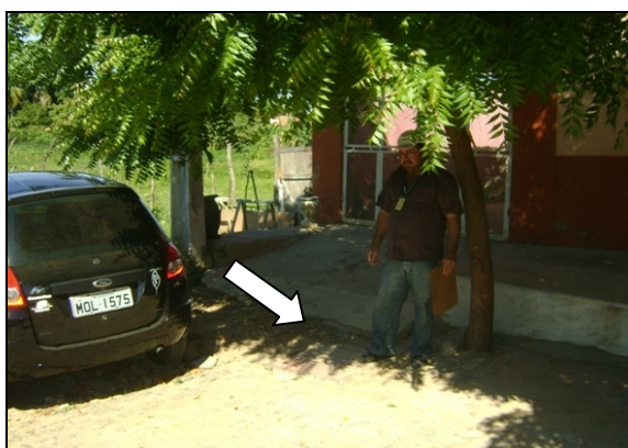
Foto 52 – Registro de descarga sem tampa e caixa, Rua Júlia Lobo.
