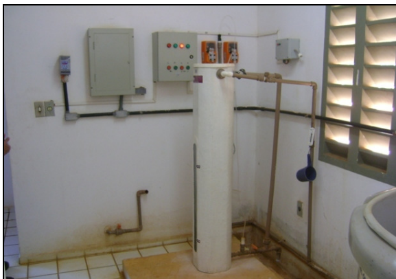
Foto 13 – Dosador de Flúor.
