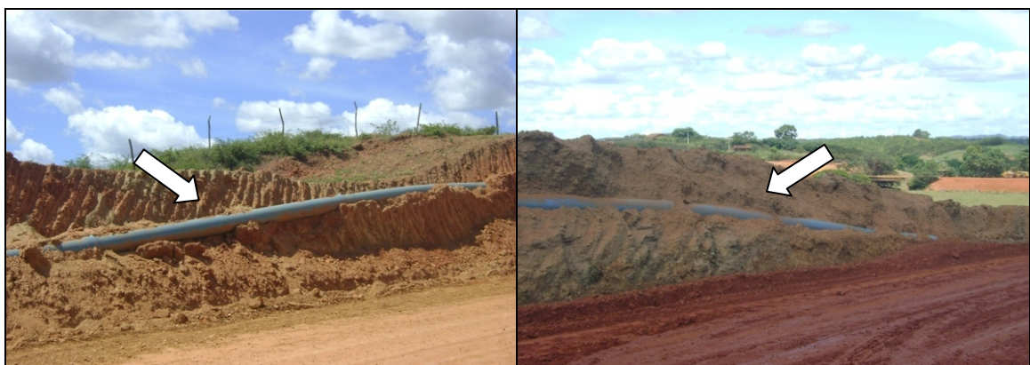
Fotos 46 e 47 – Adutora exposta.
