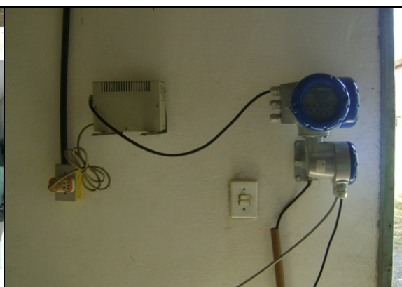
Foto 54 – Medidor eletromagnético de água bruta na entrada da ETA.
