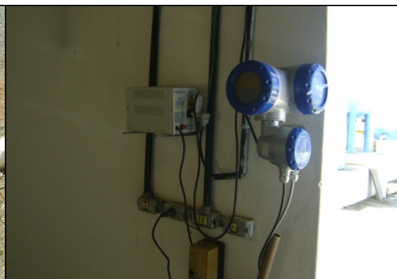
Foto 39 – Medidor eletromagnético para lavagem de filtros.
