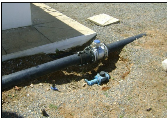
Foto 38 – Macromedidores para lavagem de filtros e da casa de química.
