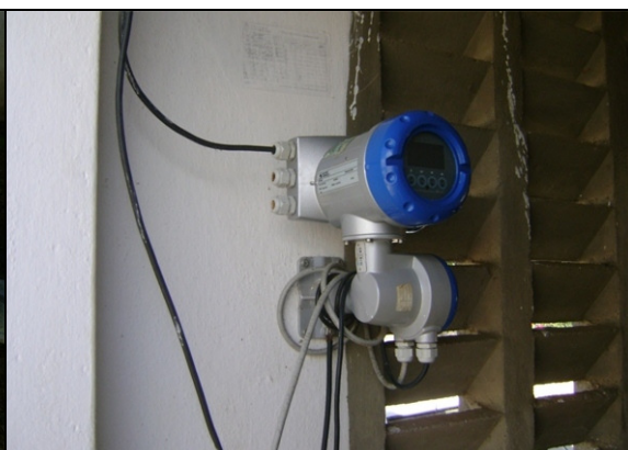
Foto 56 – Medidor eletromagnético de água tratada na saída da ETA.
