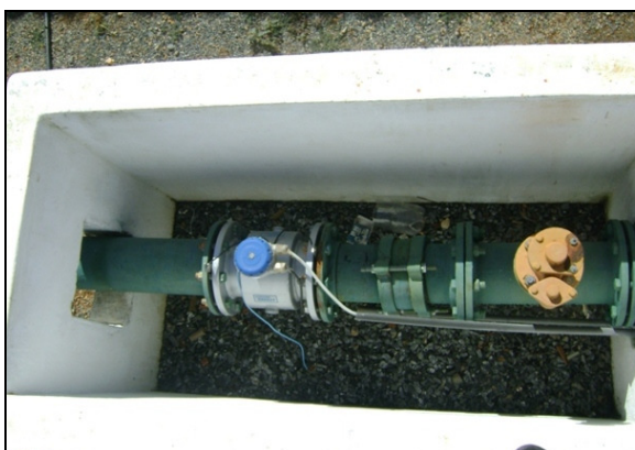
Foto 53 – Macromedidor de água bruta na entrada da ETA.
