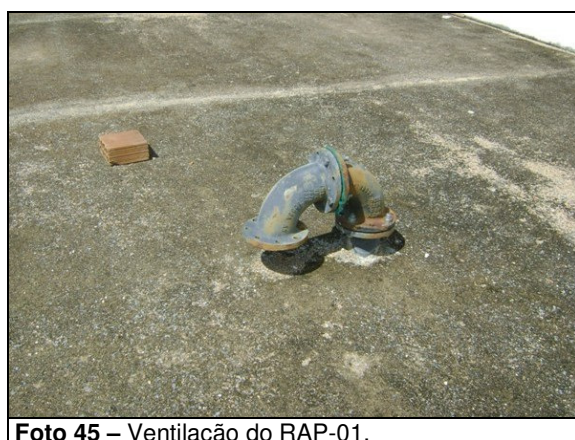
Foto 45 – Ventilação do RAP-01.
