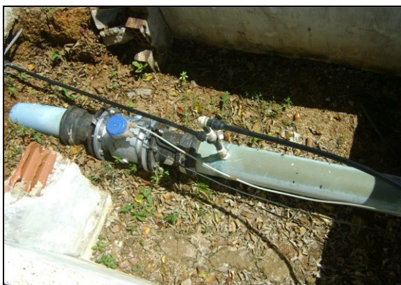
Foto 55 – Macromedidor de água tratada na saída da ETA.
