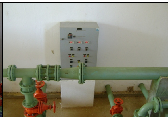
Foto 36 – Quadro de comando da EEAT-02.
