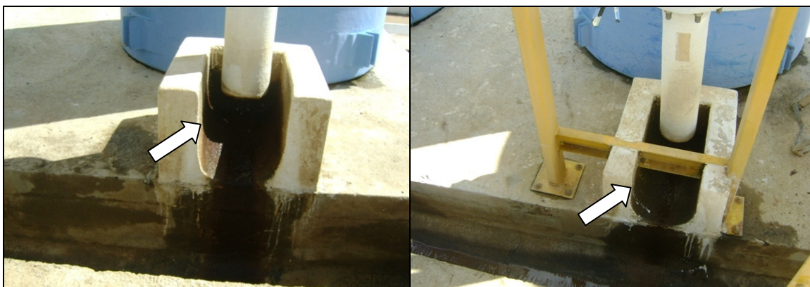
Foto 11 – Registro do filtro 01 com problema de vedação.
