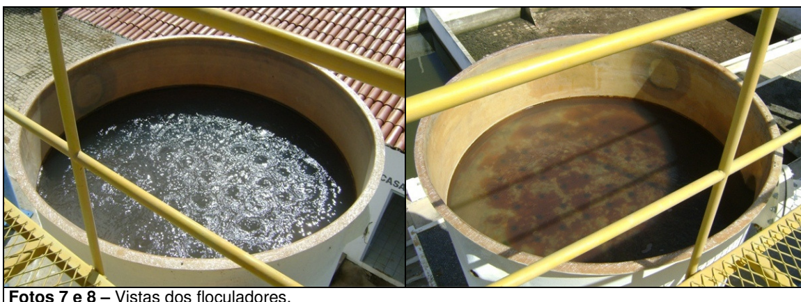
Fotos 7 e 8 – Vistas dos floculadores.
