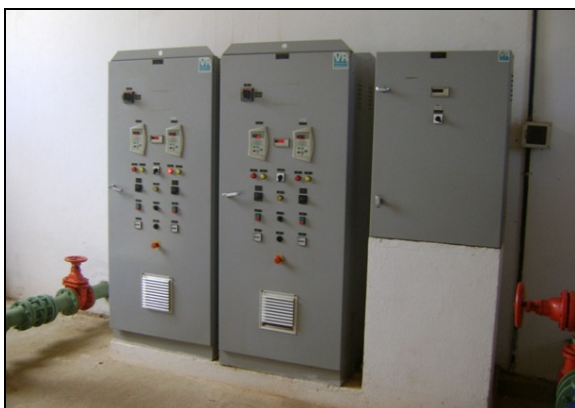
Foto 35 – Quadros de comando das EELF-01 e EEAT-01.
