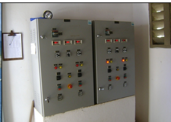
Foto 30 – Quadro de comando da EECS-01.
