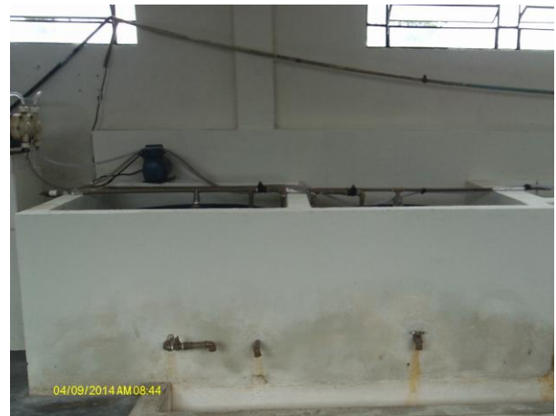
Foto 22 - Tratamento/casa de química: tanque dosador de soda caustica.
