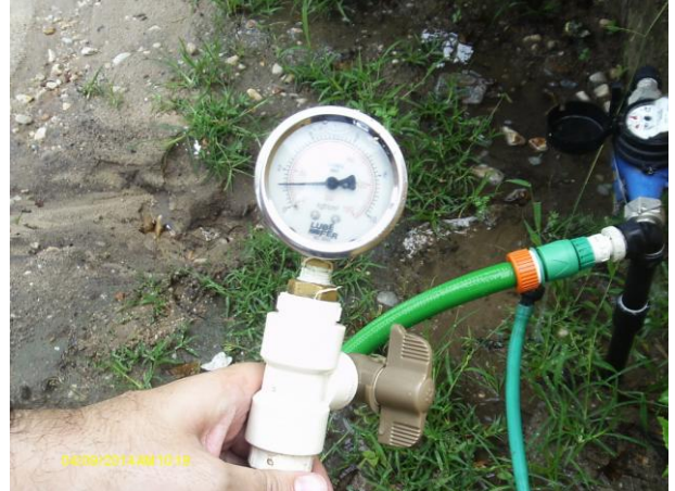
Foto 47 - Medição instantânea de pressão na rede de distribuição: Estrada para Jericoacoara.
