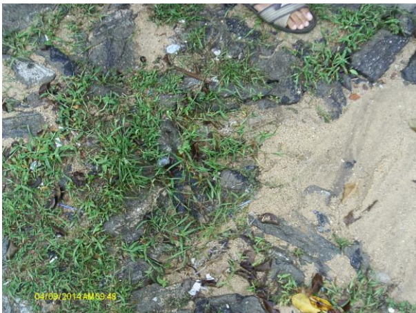
Foto 50 - Registro de descarga na rede de distribuição: Rua Duca da Silveira (soterrado).
