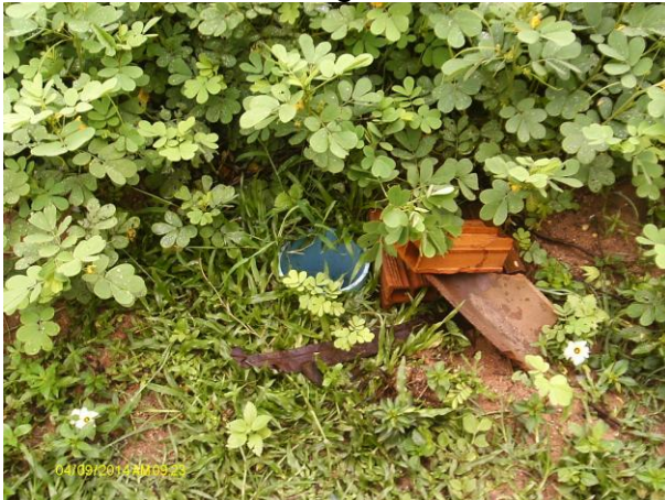
Foto 48 - Registro de descarga na rede de distribuição: Rua São Francisco.
