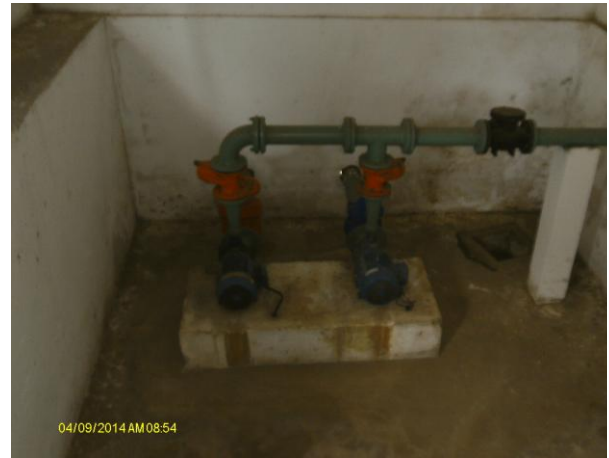
Foto 30 - EEAT-01: conjunto moto-bomba com reserva.
