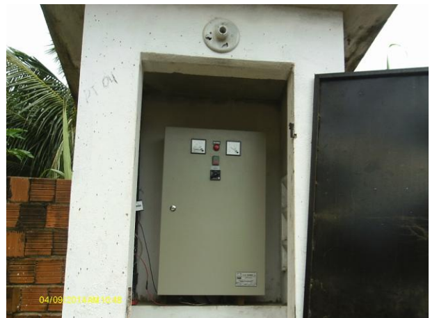
Foto 10 - PT-04: casa de abrigo do QC sem iluminação e portão danificado.
