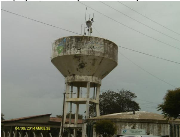
Foto 37 - REL-01: vista geral, pintura deteriorada, identificação apagada e pára-raio.
