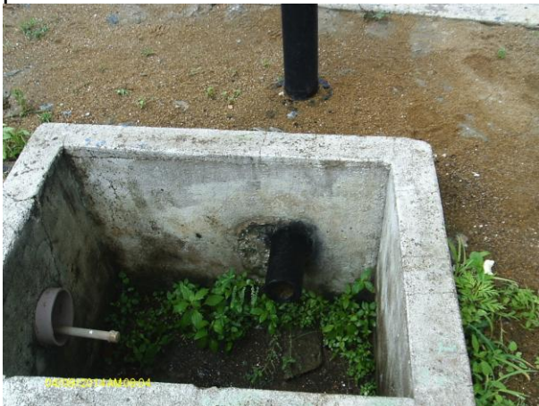
Foto 39 - REL-01: tubo extravasor.
