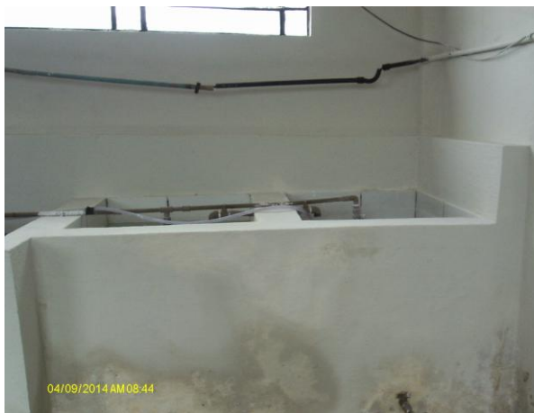
Foto 23 - Tratamento/casa de química: tanque dosador de hypocal.
