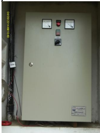
Foto 11 - PT-04: Quadro de Comando.
