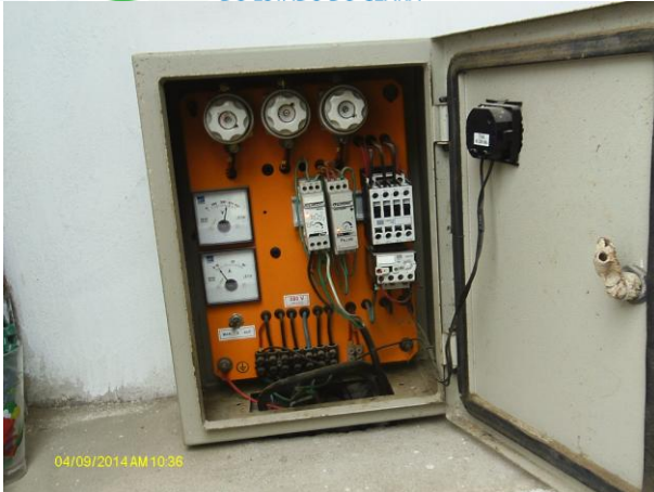
Foto 7 - PT-03: QC, amperímetro e voltímetro.
