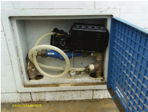
Foto 42 - Equipamento de medição contínua de pressão instalado: Rua Presidente Getúlio Vargas, SMS 73.
