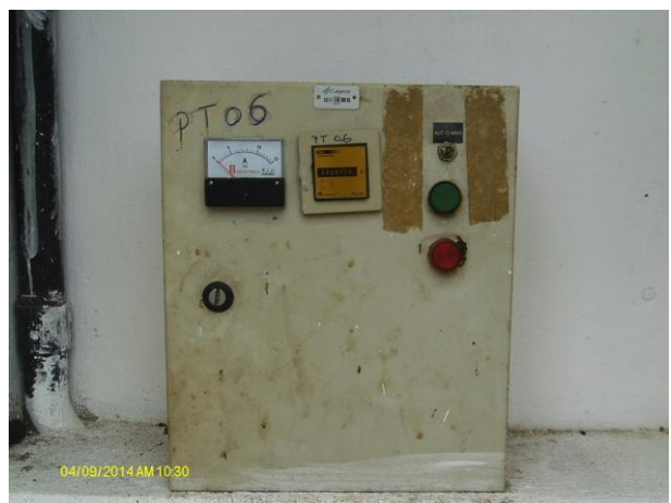
Foto 16 - PT-06: QC sem voltímetro.
