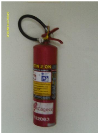
Foto 59 - Comercial/Almoxarifado: extintor de incêndio dentro do prazo de validade.
