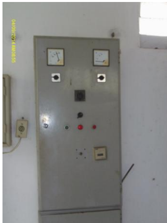
Foto 31 - EEAT-01: Quadro de Comando.
