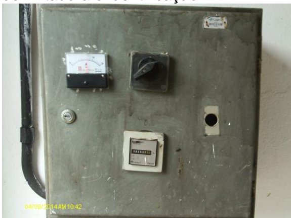
Foto 3 - PT-03: Quadro de Comando sem voltímetro.
