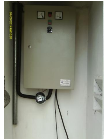
Foto 20 - PT-7: Quadro de Comando.
