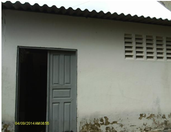
Foto 29 – EEAT-01: ausência de identificação.
