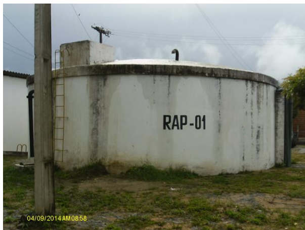
Foto 33 - RAP-01: pintura deteriorada, identificação.
