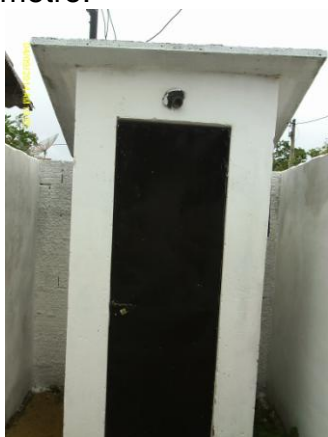
Foto 5 - PT-03: casa de abrigo do QC sem iluminação.
