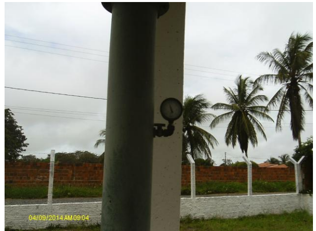
Foto 40 - REL-01: medidor de nível.
