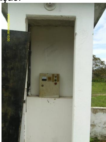
Foto 15 – PT-06: casa de abrigo do QC sem iluminação e portão danificado.
