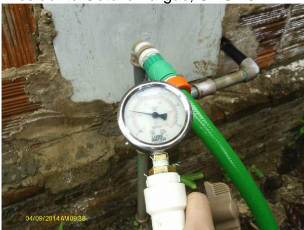
Foto 44 - Medição instantânea de pressão na rede de distribuição: Av. João Muniz, S/N.
