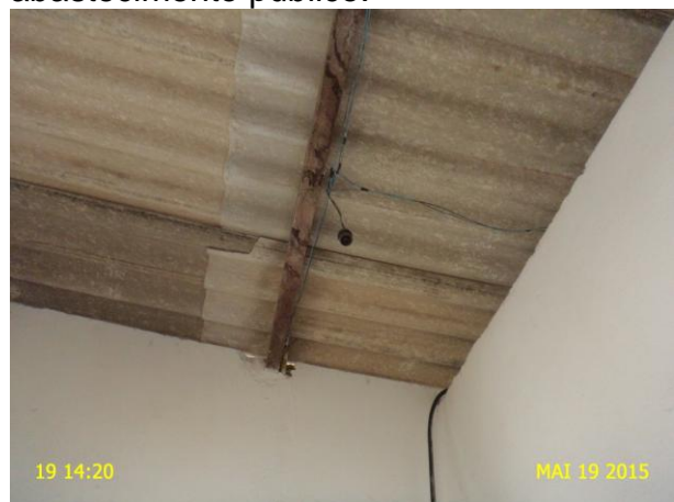
Foto 6 - PT-04: sem iluminação.
