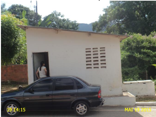
Foto 3 - PT-03: sem identificação, pintura deteriorada e sem placa de área destinada ao abastecimento público.
