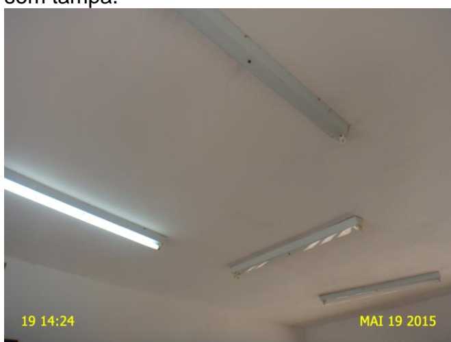
Foto 11 - EEAT-01: lâmpadas com defeito.
