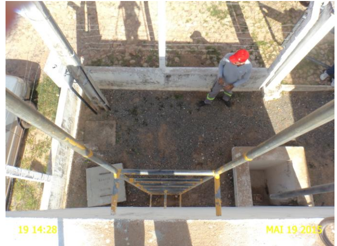
Foto 20 - RAP-01: escada de acesso com pintura deteriorada.
