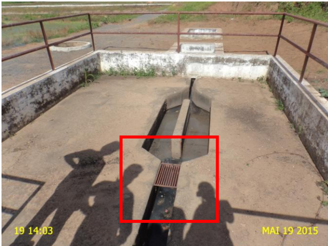
Foto 13 - ETE: gradeamento danificado.
