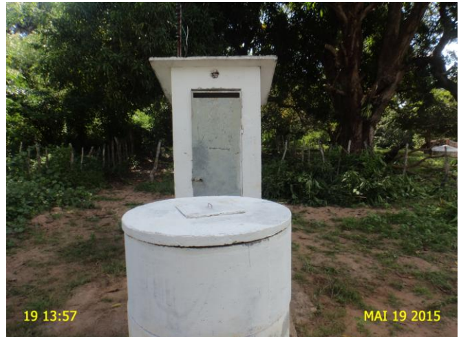
Foto 2 - PT-02: sem delimitação/isolamento da área, sem iluminação sem identificação, pintura deteriorada e sem placa de área destinada ao abastecimento público.
