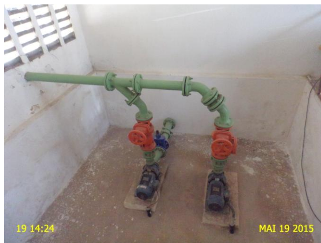
Foto 10 - EEAT-01: sem identificação.
