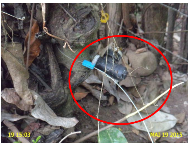
Foto 17 - RDA: Registro de descarga na Rua 13 de Maio sem caixa de proteção.
