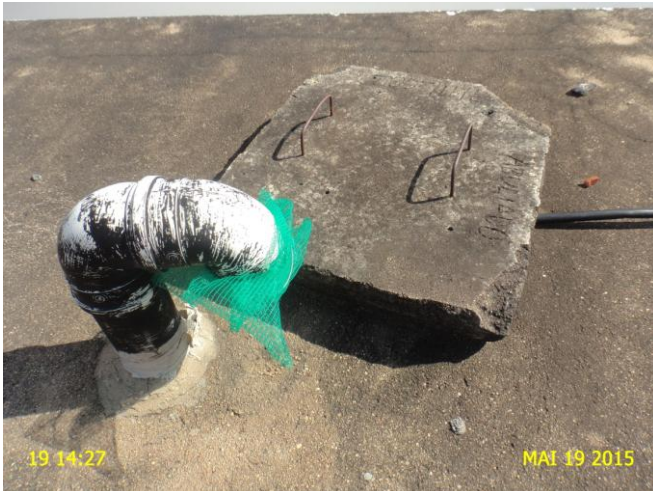
Foto 19 - RAP-01: tampa da entrada de produtos químicos sem vedação.
