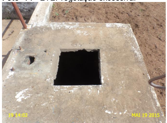
Foto 16 - ETE: caixa de chegada do esgoto bruto sem tampa.
