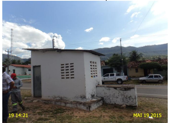
Foto 4 - PT-04: sem identificação, pintura deteriorada e sem placa de área destinada ao abastecimento público.
