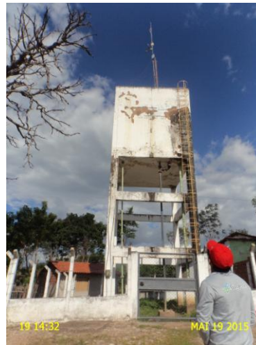
Foto 8 - REL-01: sem guarda corpo na laje de cobertura, pintura deteriorada, sem identificação e sinais de vazamento.
