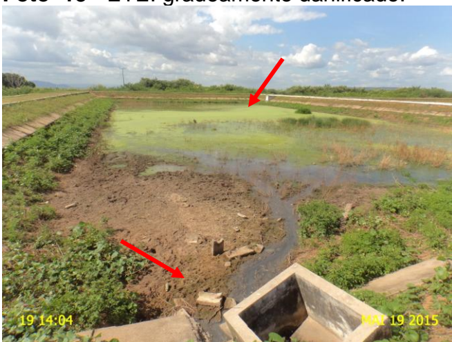
Foto 15 - ETE: caixa de inspeção danificada e acúmulo de sobrenadante na lagoa facultativa.
