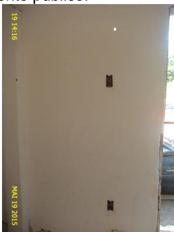
Foto 5 - PT-03: sem iluminação.
