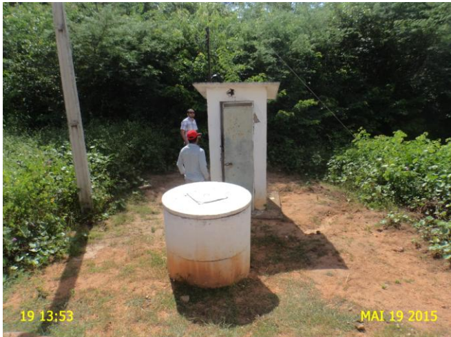
Foto 1 - PT-01: sem delimitação/isolamento da área, sem iluminação, sem identificação, pintura deteriorada e sem placa de área destinada ao abastecimento público.
