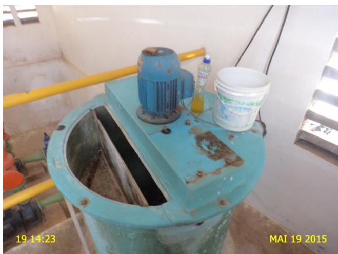
Foto 9 – Tratamento: Tanque de cloração sem tampa.
