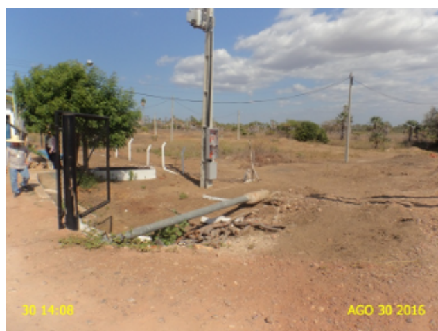
Foto 3 - ETA: cerca danificada.
