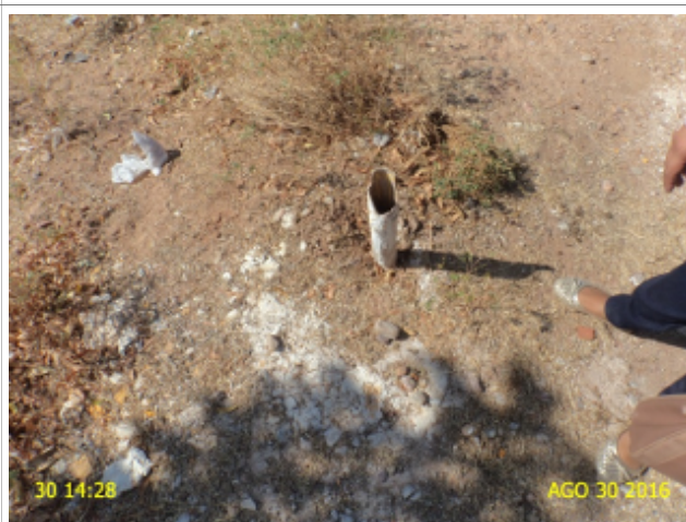
Foto 4 - Registro de descarga: Rua Maria Galdino, Alto Brito (sem caixa).
