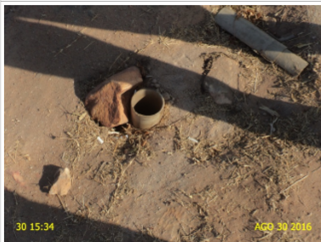
Foto 5 - Registro de descarga: Avenida João Barbosa Lima - Matadouro (sem caixa).
