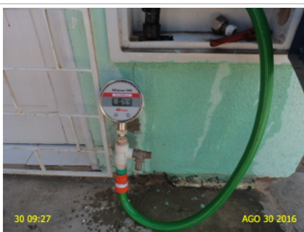
Foto 8 - Medição instantânea de pressão na rede de distribuição, no endereço localizado na Rua Cícero Teixeira, 200.
