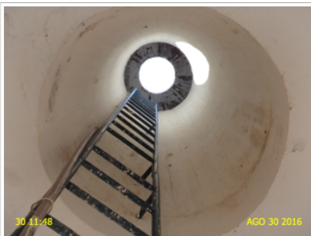
Foto 1 - REL-01: sem tampa de inspeção.
