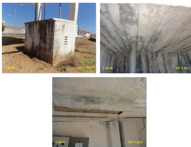
Foto 4 – EEAT-02: Rachadura, pintura e reboco deteriorados.
