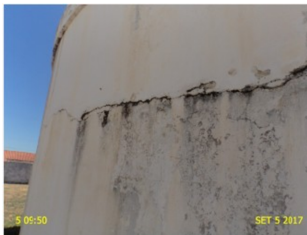
Foto 12 – RAP-03: Sinais de vazamento.
