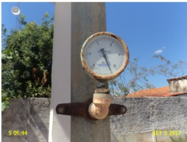
Foto 1 – REL-01: Medidor de nível quebrado.
