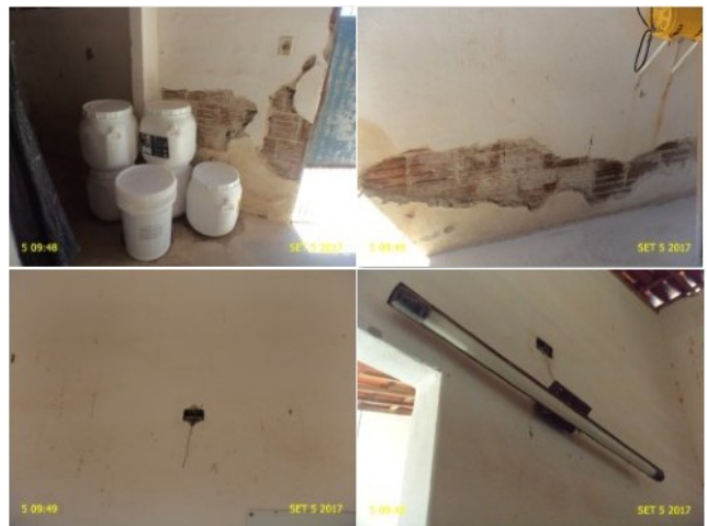
Foto 8 – Casa de química: Reboco deteriorado e ausência de iluminação.
