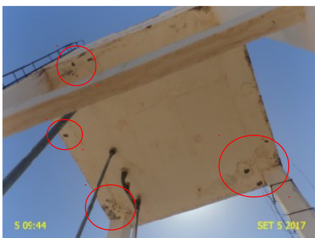
Foto 15 – REL-01: reboco deteriorado na base do reservatório.
