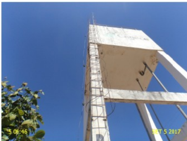
Foto 17 – REL-01: pintura deteriorada, escada e guarda-corpos em processo de corrosão.
