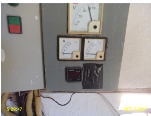
Foto 14 – EEAT-02: Amperímetro e horímetro sem funcionar.
