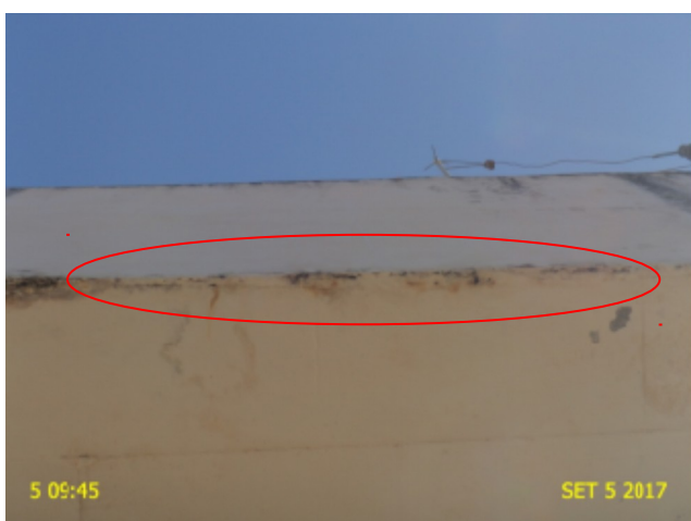
Foto 13 – REL-01: Sinais de vazamento.
