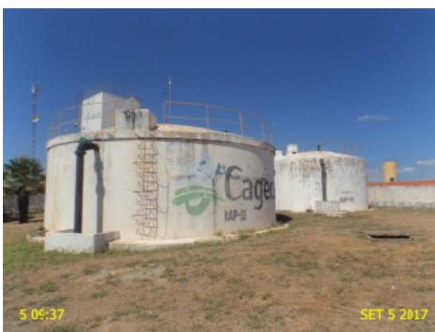
Foto 16 – RAP-03 e RAP-04: Pintura deteriorada.
