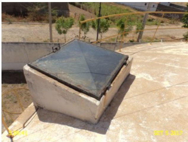
Foto 11 – RAP-03: Tampa em processo de corrosão.
