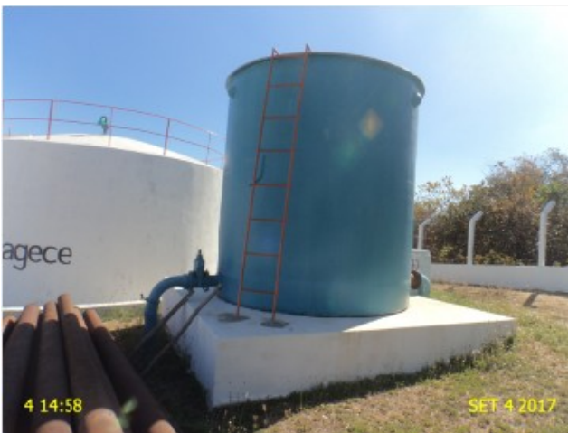
Foto 7 – F-04: Ausência de identificação.
