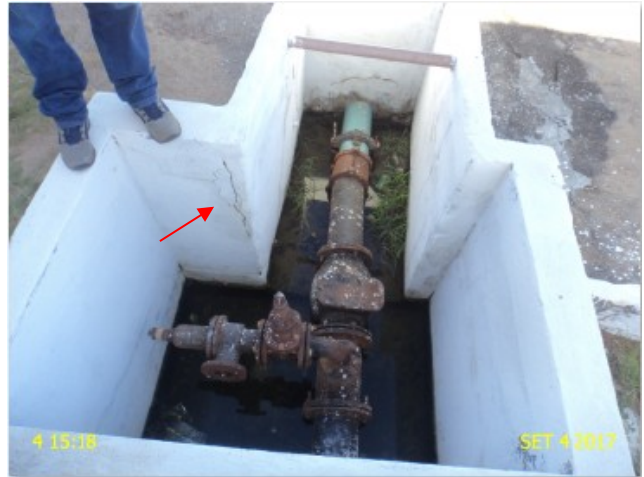
Foto 6 – AAT: caixa com rachaduras e ausência de tampa ou grade.
