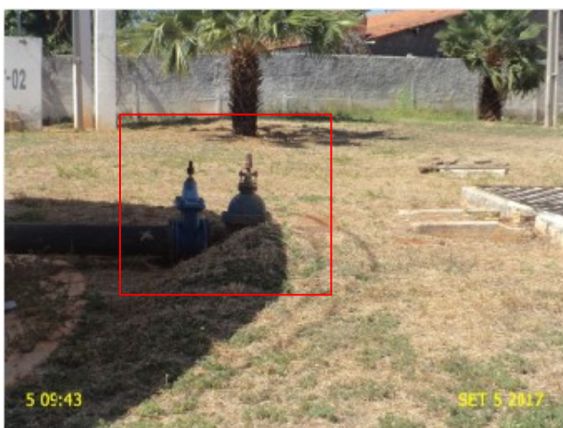
Foto 3 – RAP-03 e RAP-04: Registro sem caixa de proteção.
