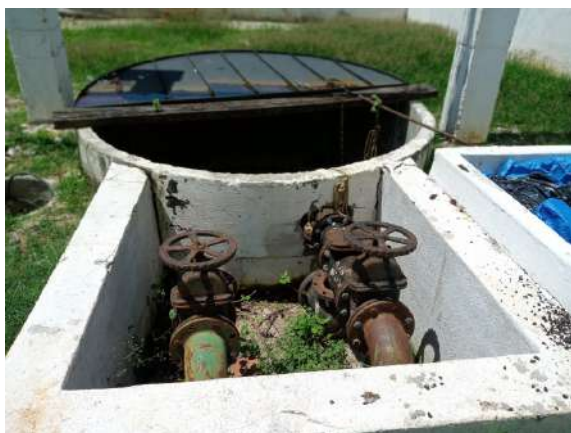
Foto 22 - EEE 2: caixa sem tampa.
