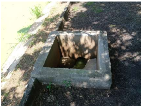
Foto 20 - ETE: a caixa LF sem tampada.
