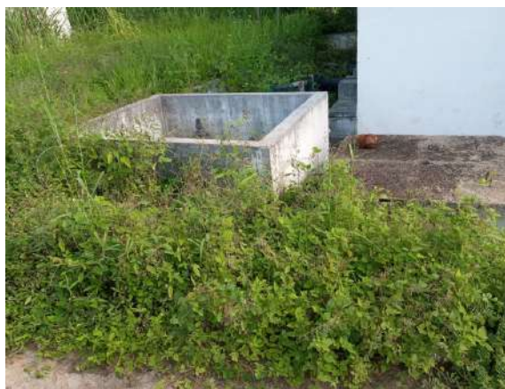
Foto 13 - Captação: área e instalações tomadas pela vegetação.
