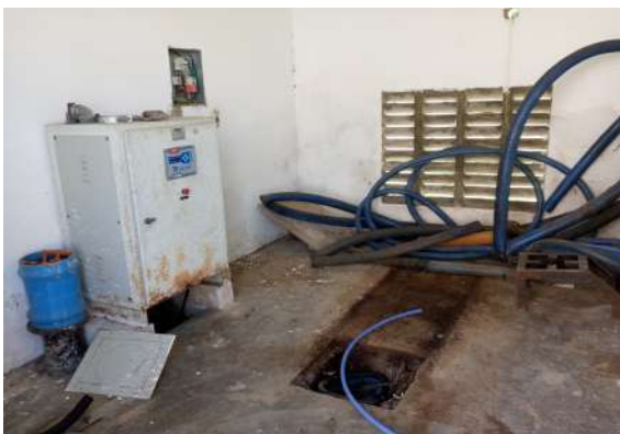
Foto 42 - EEE-02: deterioração e/ou condições de limpeza e manutenção das infraestruturas.
