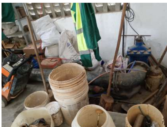
Foto 36 - EEE-01: materiais armazenados de forma indevida e precária nas instalações de recalque de esgoto.
