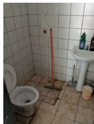
Foto 37 - EEE-01 (banheiro): deterioração e/ou condições de limpeza e manutenção das infraestruturas.
