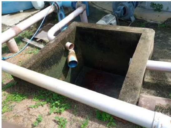
Foto 8 - ETA: caixa de descarga sem tampa.
