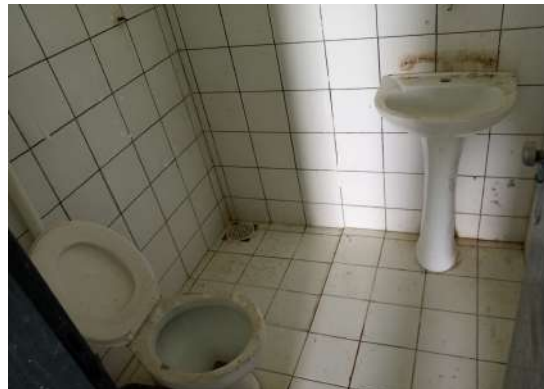
Foto 39 - EEE-02 (banheiro): deterioração e/ou condições de limpeza e manutenção das infraestruturas.
