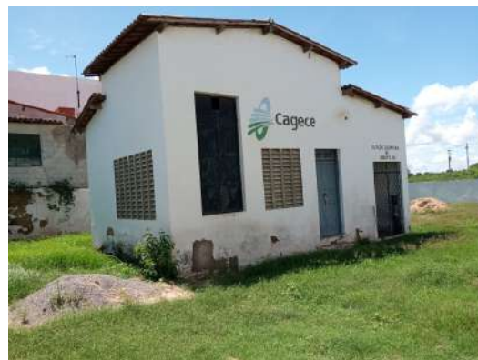
Foto 43 - EEE-02: deterioração e/ou condições de limpeza e manutenção das infraestruturas.
