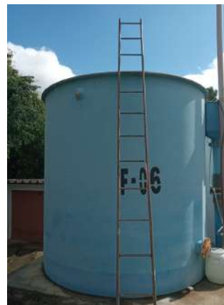
Foto 3 - ETA: Filtro-06 escada improvisada e sem guarda corpo.
