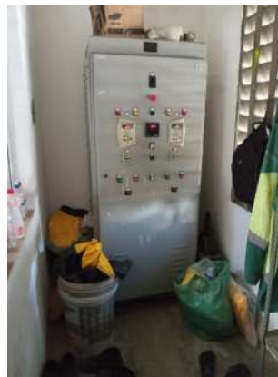
Foto 35 - EEE-01: materiais armazenados de forma indevida e precária na sala dos quadros de bombas.
