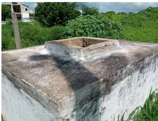
Foto 18 - ETE: caixa na chegada sem tampa.
