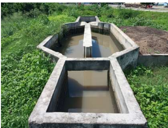
Foto 28 - ETE: tratamento preliminar sem grade de retenção e caixa de areia sem comportas de controle de fluxo e tanque de secagem com material acima da capacidade.
