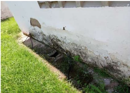
Foto 38 - EEE-02: deterioração e/ou condições de limpeza e manutenção das infraestruturas e fiação exposta.
