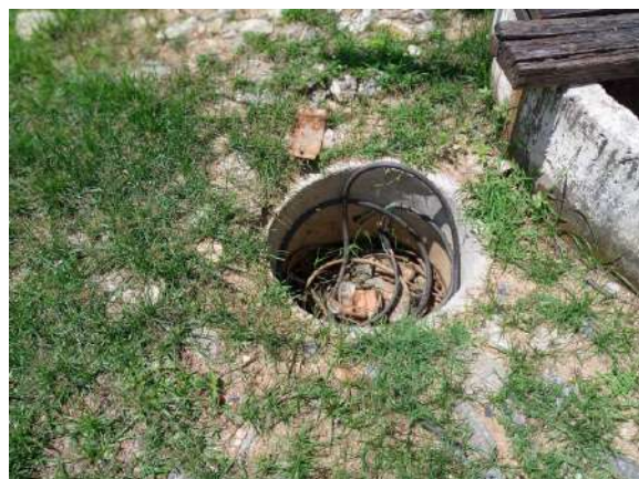
Foto 23 - EEE 2: registro sem tampa.
