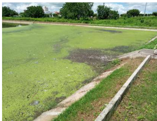
Foto 29 - ETE: presença de sólidos grosseiros, matos crescidos e placas erodidas na LF.
