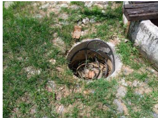
Foto 45 - EEE-02: iluminação defeituosa ou inadequada.
