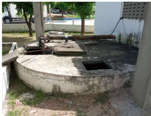
Foto 21 - EEE 1: poço sem tampa.
