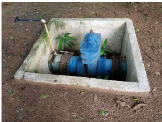
Foto 10 - Adutora: caixa do registro água bruta sem tampa.
