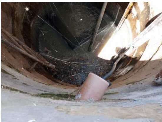
Foto 34 - EEE-02: presença de sólidos grosseiros no poço de sucção.
