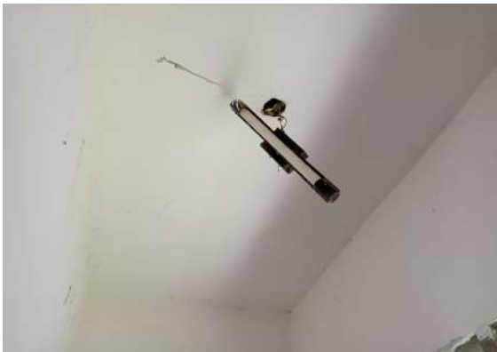
Foto 44 - EEE-02: iluminação defeituosa ou inadequada.
