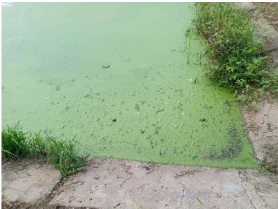
Foto 32 - ETE: presença de sólidos grosseiros, matos crescidos e placas erodidas na LM.
