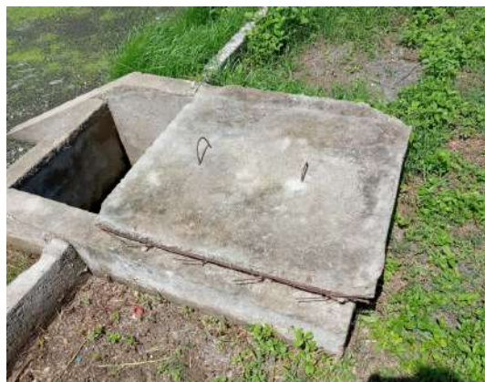
Foto 19 - ETE: a caixa LF não está devidamente tampada.
