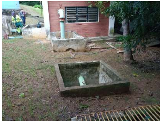
Foto 9 - ETA: Caixas da adutora sem tampas.
