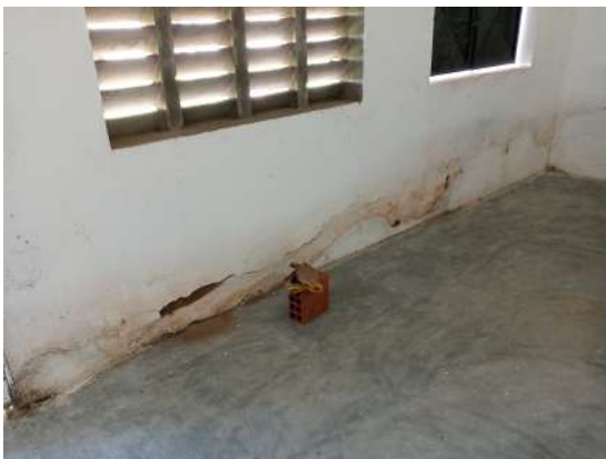
Foto 40 - EEE-02: deterioração e/ou condições de limpeza e manutenção das infraestruturas.
