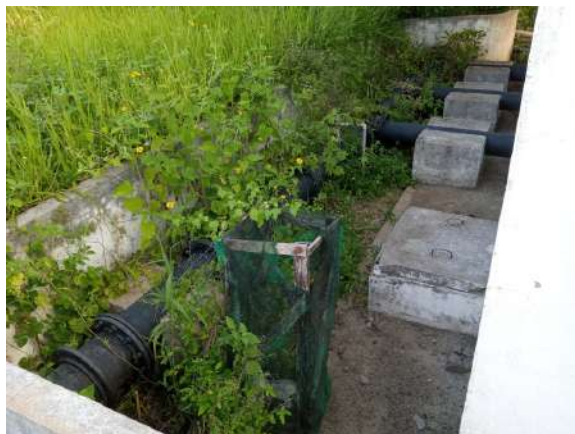
Foto 14 - Captação: área e instalações tomadas pela vegetação.
