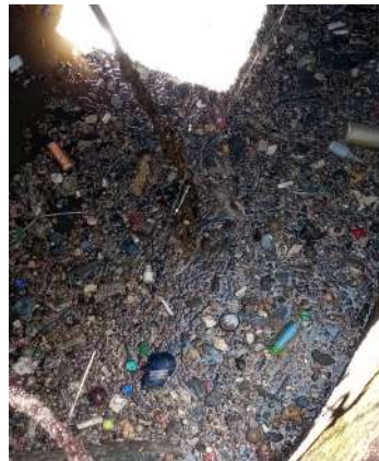
Foto 33 - EEE-01: presença de sólidos grosseiros no poço de sucção.
