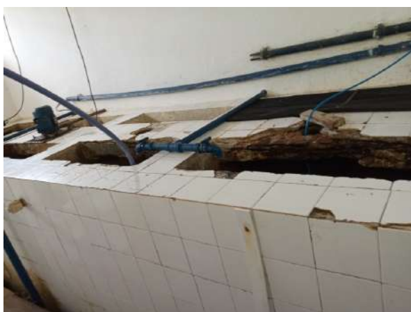
Foto 4 - ETA: tanques da casa de química com estrutura deteriorada.
