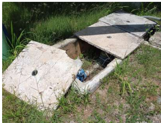
Foto 11 - REL-01: Caixa com tampa quebrada.
