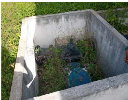
Foto 7 - Captação: caixa do registro sem tampa.
