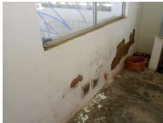
Foto 41 - EEE-02: deterioração e/ou condições de limpeza e manutenção das infraestruturas.
