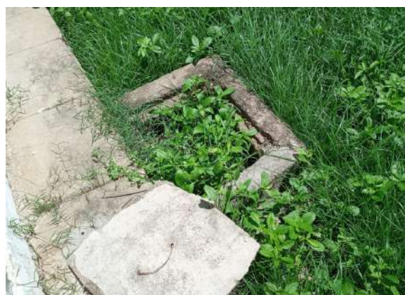
Foto 25 - ETE: a caixa LF não está devidamente tampada.
