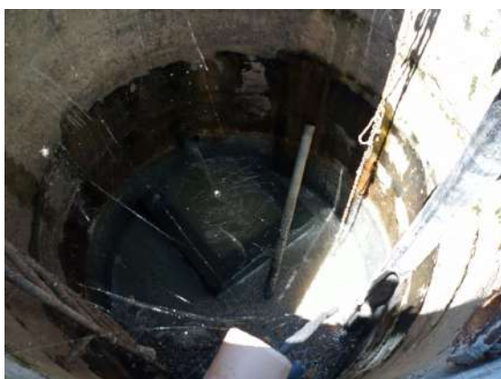
Foto 24 - EEE 2: a caixa está alagada.
