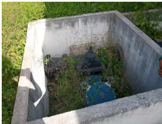
Foto 15 - Captação: área e instalações tomadas pela vegetação.
