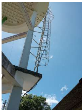
Foto 6 - REL-01: instalações elétricas inadequadas ou improvisadas conduzidas ao longo da escada.
