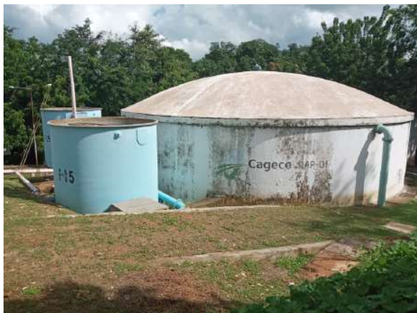
Foto 2 - ETA: Filtro-05 escada improvisada e sem guarda corpo.
