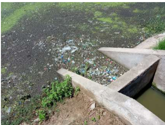
Foto 30 - ETE: presença de sólidos grosseiros, matos crescidos e placas erodidas na LF.
