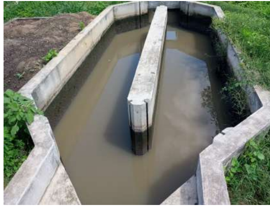
Foto 27 - ETE: tratamento preliminar sem grade de retenção e caixa de areia sem comportas de controle de fluxo.
