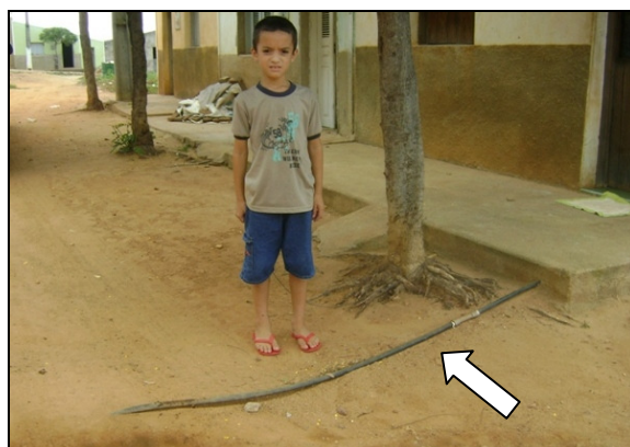
Foto 33 – Tubulação exposta na Rua SDO-01.
