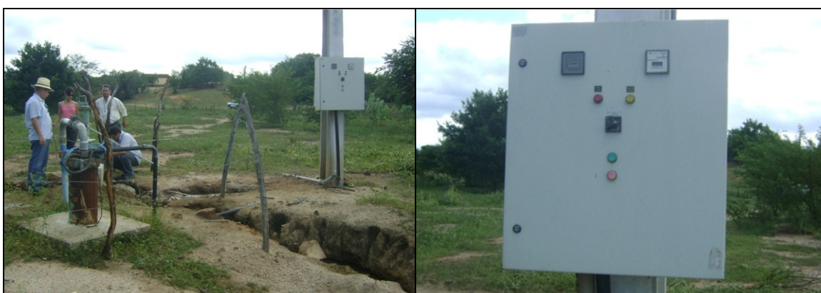
Foto 8 – Erosão no terreno do PT-06.
