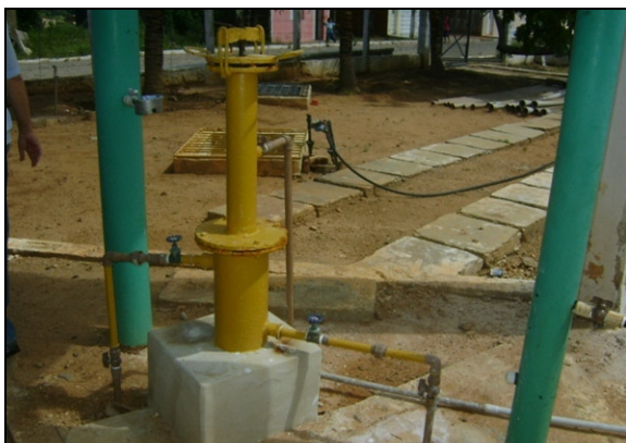
Foto 11 – Vista do clorador de pastilhas.
