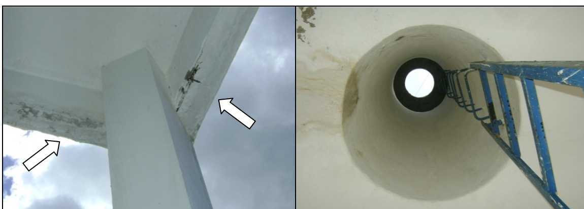
Foto 22 – Estrutura do REL-01.
