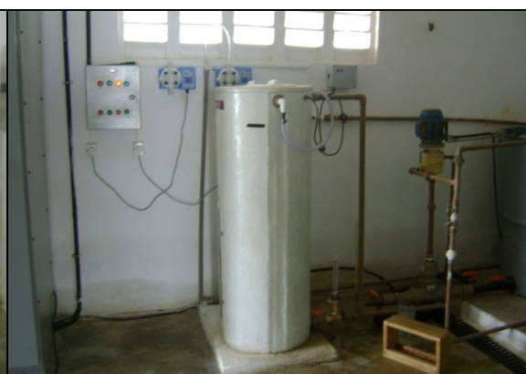
Foto 12 – Dosador de flúor.
