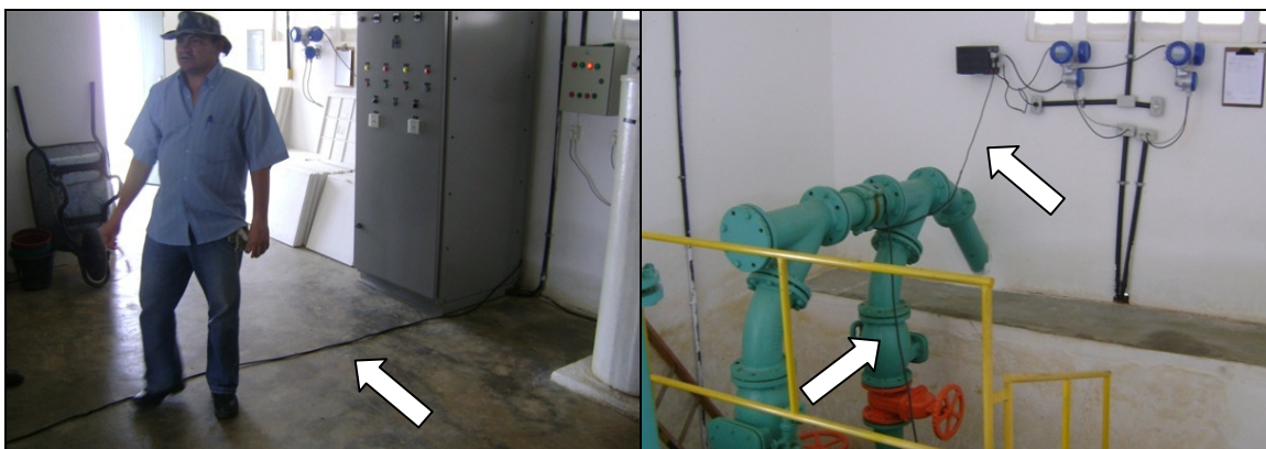
Fotos 29 e 30 – Fiação exposta na área das elevatórias.
