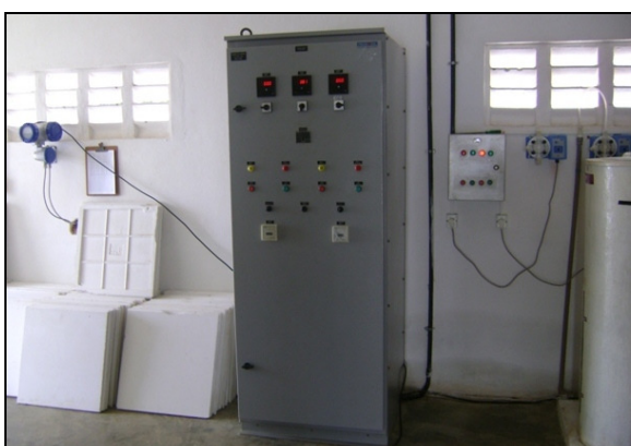
Foto 27 – Quadro de comando da EEAT-01.
