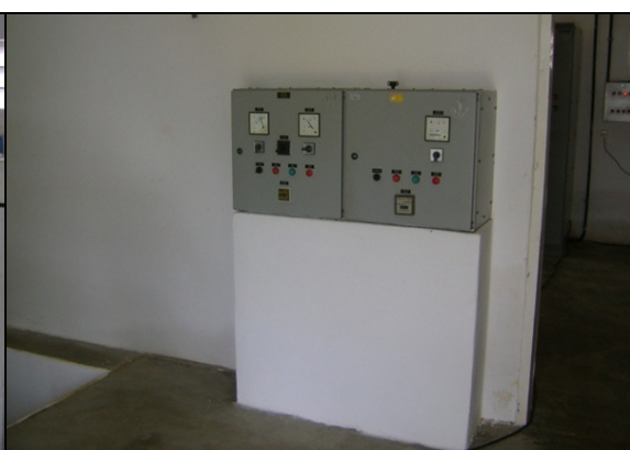
Foto 28 – Quadro de comando da EEAT-02.
