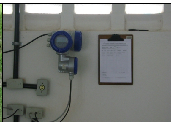
Foto 9 – Leitor do macromedidor para lavagem de filtros.
