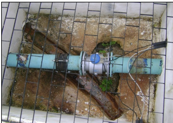
Foto 44 – Macromedidor de água tratada na entrada do REL-01.
