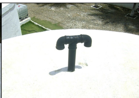
Foto 35 – Ventilação do RAP-02.
