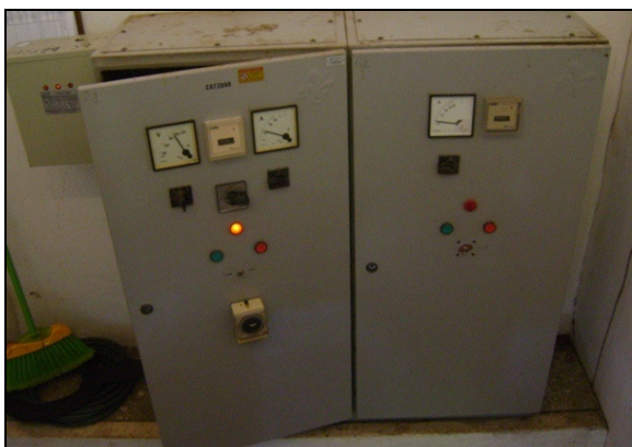
Foto 23 – Quadro de comando da EECS-01.
