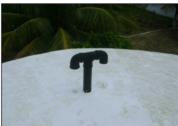
Foto 34 – Ventilação do RAP-01.
