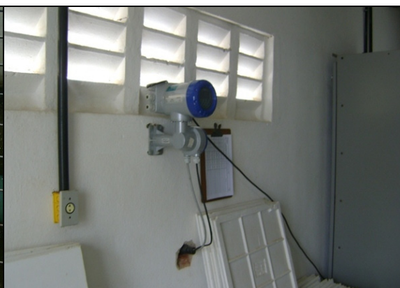
Foto 42 – Medidor eletromagnético de água bruta na entrada da ETA.
