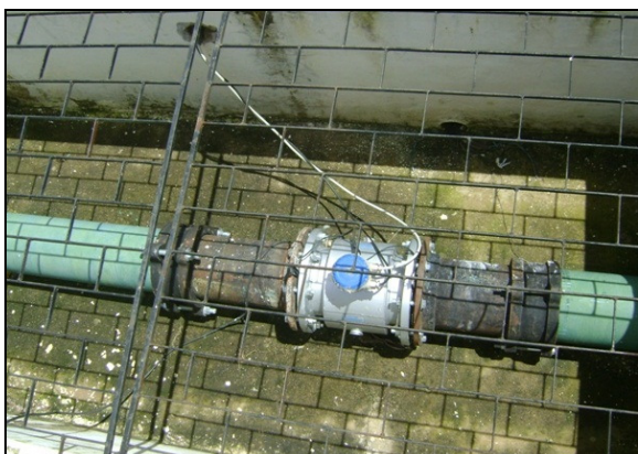
Foto 41 – Macromedidor de água bruta na entrada da ETA.
