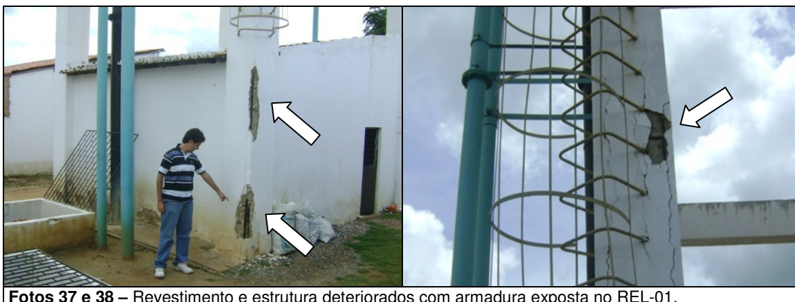
Fotos 37 e 38 – Revestimento e estrutura deteriorados com armadura exposta no REL-01.
