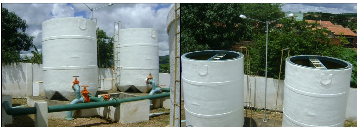
Fotos 5 e 6 – Vistas dos filtros.
