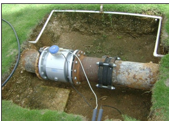
Foto 8 – Macromedidor para lavagem de filtros.
