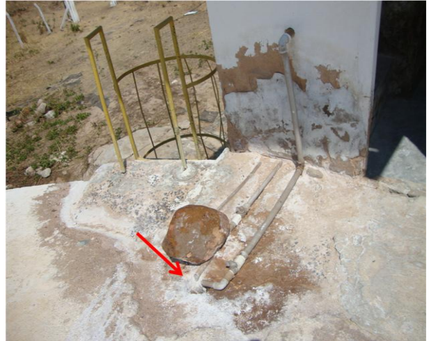
Foto 28 – RAP-02: entrada de solução de hipocal inadequada.
