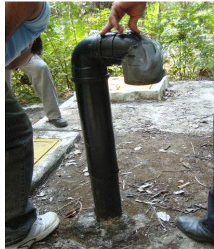
Foto 24 – Tubulações de ventilação do RAP-01/Fonte com tela de vedação.
