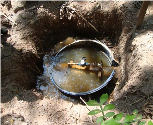
Foto 18 – Macromedidor na adutora de água bruta na saída da Fonte/RAP-01.
