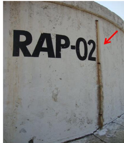
Foto 30 – RAP-02: medidor de nível.
