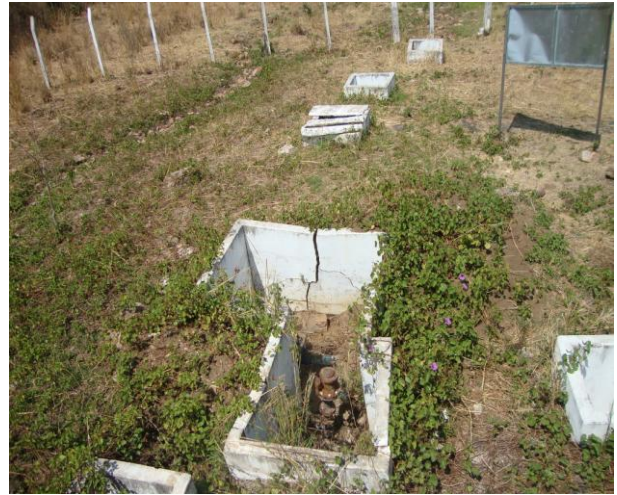
Foto 19 – Caixas de passagem sem tampa ou grade de proteção na área do RAP-02.
