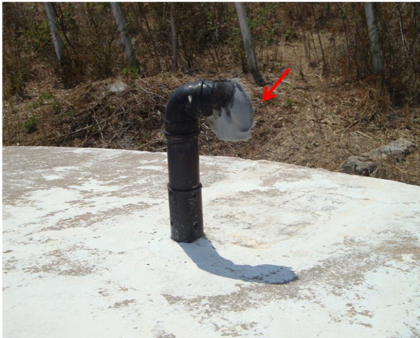
Foto 29 – RAP-02: tubulações de ventilação com tela de vedação.
