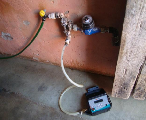
Foto 41 – Medição de pressão com instalação às 11:20h do dia 28/09/13 e retirada às 11:20h do dia 29/09/13, com aparelho datalogger na Av. Patativa do Assaré, nº 372, Centro.
