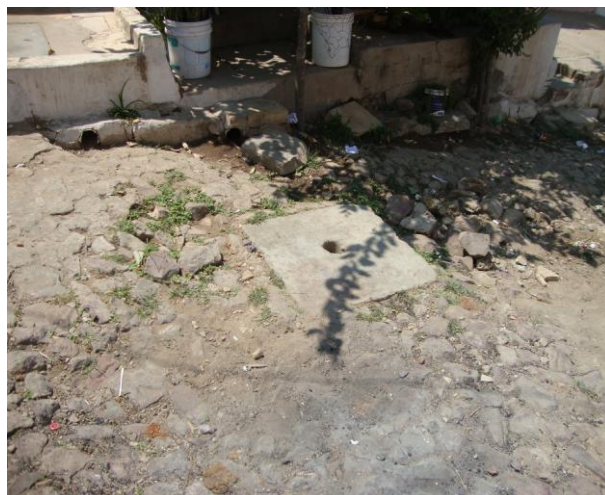
Foto 48 – Registro de descarga na Rua Padre Cícero, nº 40.
