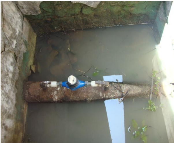
Foto 20 – Macromedidor na adutora de água bruta na saída do RAP-02.
