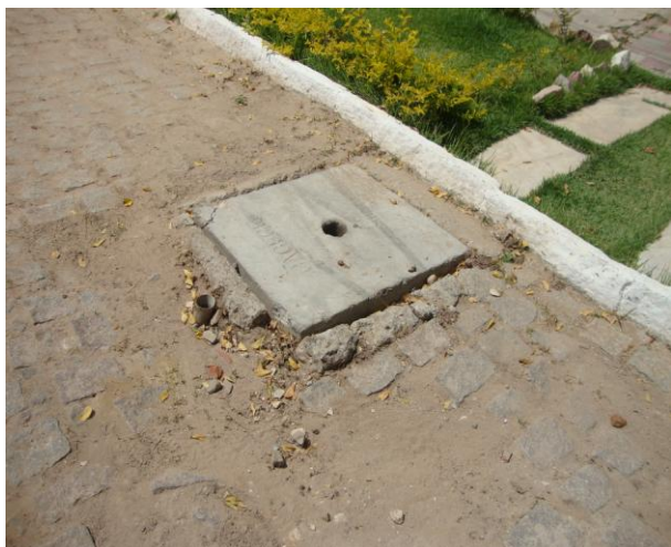
Foto 47 – Registro de descarga na Rua Senhora Santana, nº 521.
