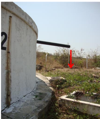
Foto 31 – RAP-02: tubo extravasor.
