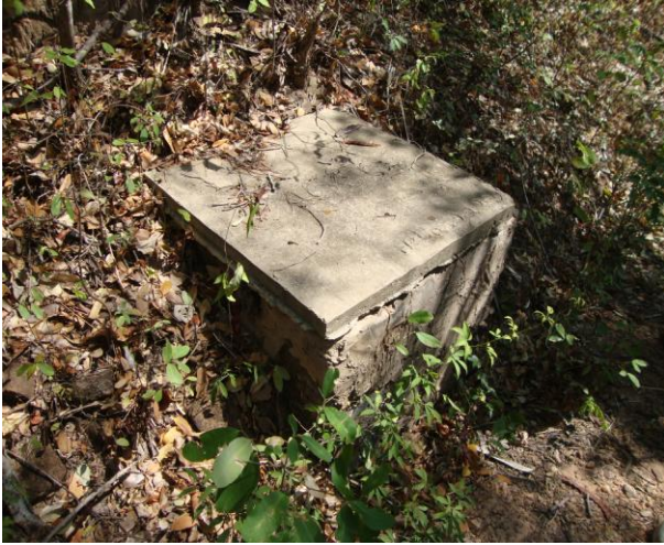
Foto 16 – Caixa de ventosa da adutora de água bruta.
