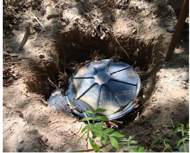
Foto 17 – Macromedidor na adutora de água bruta na saída da Fonte/RAP-01.
