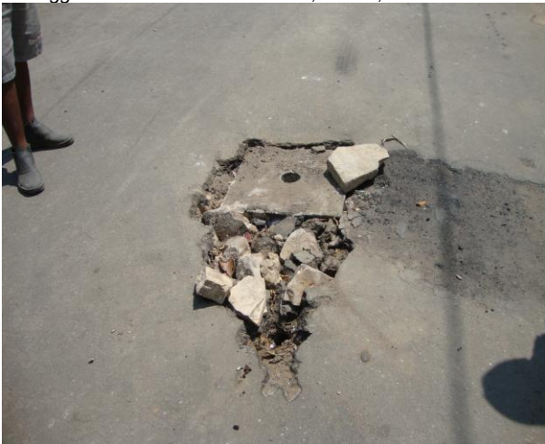
Foto 43 – Registro de descarga na Rua São Pedro, nº 694.
