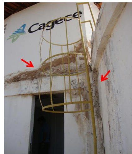
Foto 26 – RAP-02: escada de acesso e sinais de infiltração na parede da casa de química.
