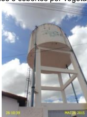
Foto 24 – REL-02: ausência de identificação e pintura deteriorada.
