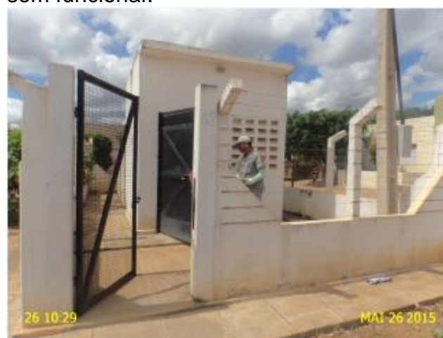
Foto 10 – EEAT-03: ausência de identificação.
