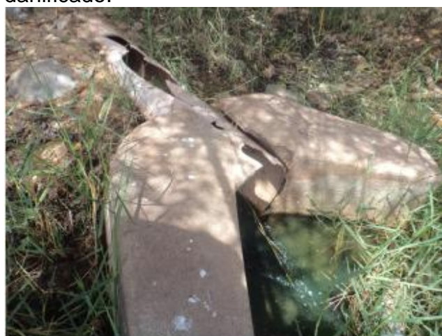
Foto 15 – ETE: tubulação de saída danificada.
