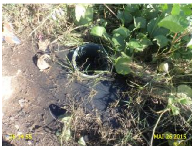
Foto 16 – RDA: registro de descarga na Rua Flamengo coberto por esgoto.
