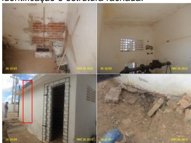
Foto 11 – EEAT-02: estrutura danificada.
