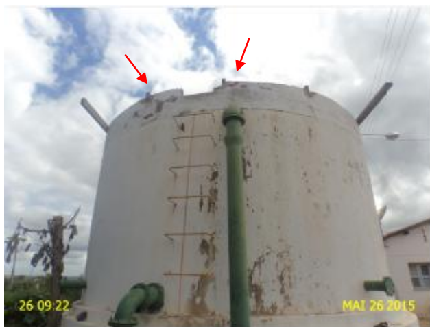
Foto 7 – Pré-Filtração: estrutura deteriorada.
