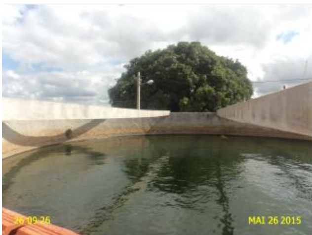
Foto 1 – Pré-Filtro: ausência de tampa.
