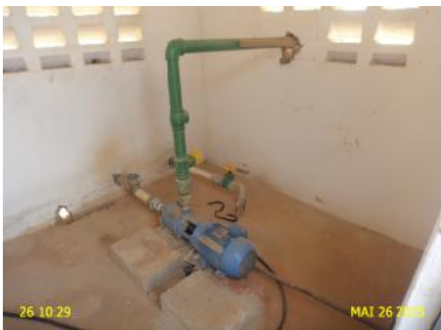
Foto 3 – EEAT-03: ausência de bomba reserva.
