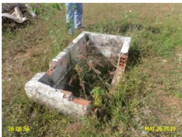
Foto 5 – AAB: caixa danificada sem tampa ou grade.
