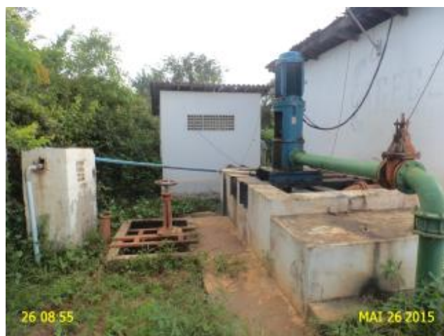
Foto 6 – EECS-01 e EEAB-01: ausência de identificação.
