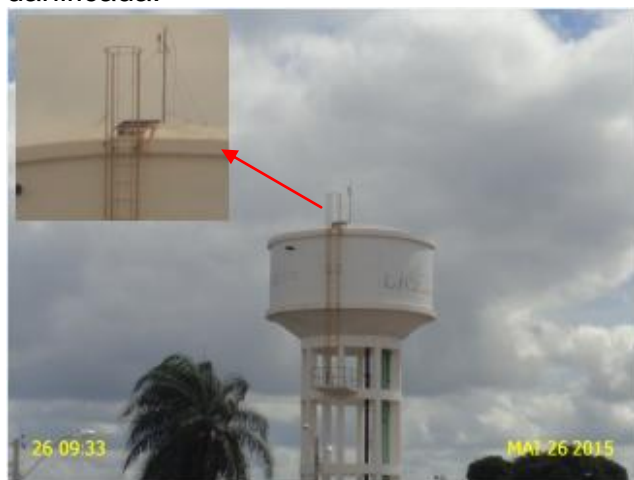
Foto 17 – REL-01: tampa de inspeção aberta e ausência de identificação
