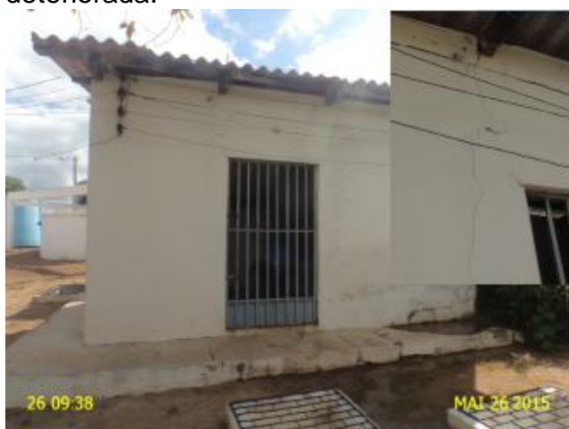
Foto 9 – EEAT-01: ausência de identificação e estrutura rachada.
