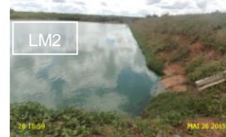
Foto 22 – ETE: lagoas com taludes deteriorados e cobertos por vegetação.
