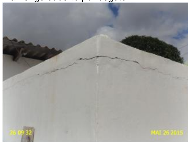
Foto 18 – RAP-01: rachadura na estrutura.
