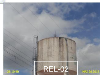
Foto 4 – Reservatórios elevados: ausência de guarda corpo na laje de cobertura.
