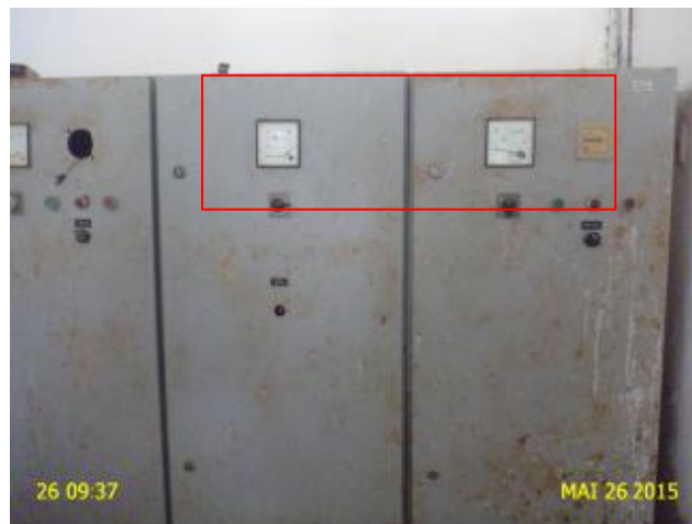
Foto 8 – EEAT-01: amperímetro e voltímetro sem funcionar.
