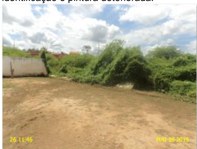
Foto 21 – EEE-01: muro desmoronado.
