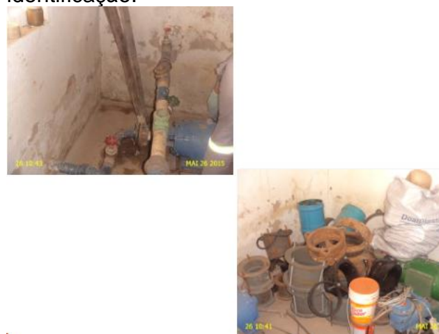
Foto 12 – EERD-01: estrutura danificada e materias armazenados.
