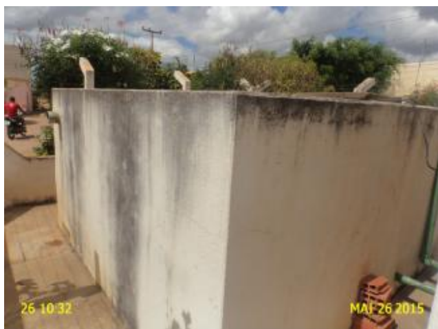
Foto 19 – RAP-02: ausência de identificação e pintura deteriorada.
