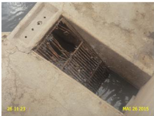
Foto 13 – EEE-06: gradeamento danificado.
