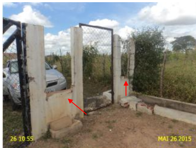
Foto 14 – ETE: cerca danificada.
