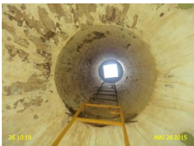
Foto 23 – REL-03: ausência de tampa de inspeção.
