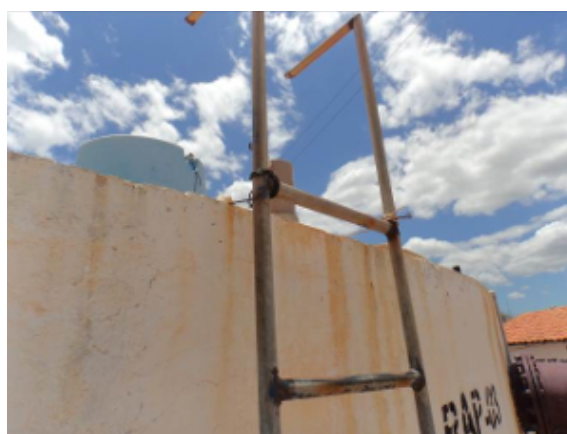
Foto 36 – RAP-03: escada de acesso sem fixação.
