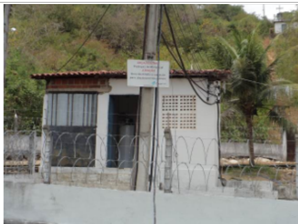
Foto 27 - EEAB-02: ausência de identificação.
