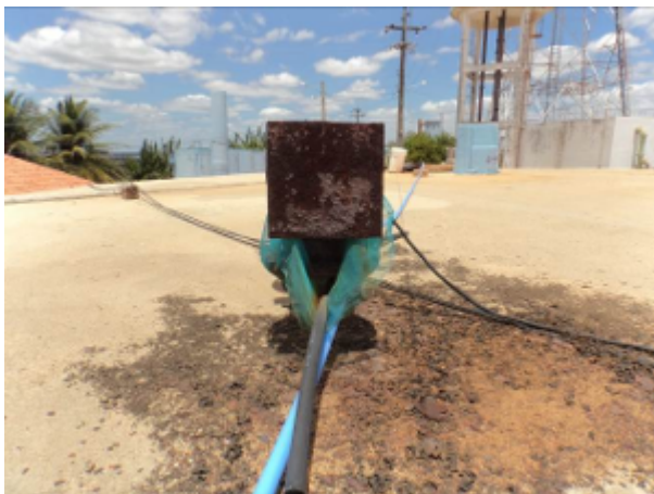
Foto 7 – RAP-03: tubulação de ventilação inadequada.
