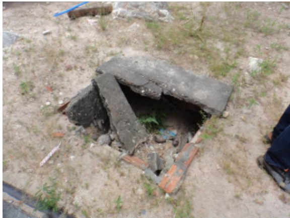
Foto 37 – RAP-02: caixa de inspeção com tampa danificada.
