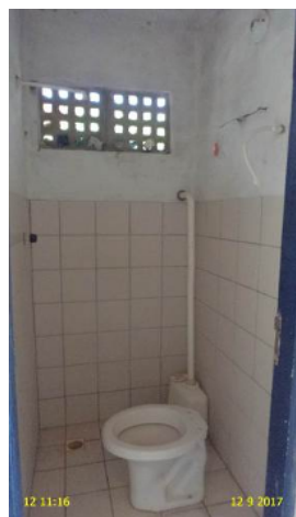
Foto 13 – ETE Zumbi: Banheiro da casa de abrigo do operador sem a caixa de descarga instalada.
