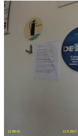
Foto 2 – Loja de atendimento: ausência de extintor de incêndio.
