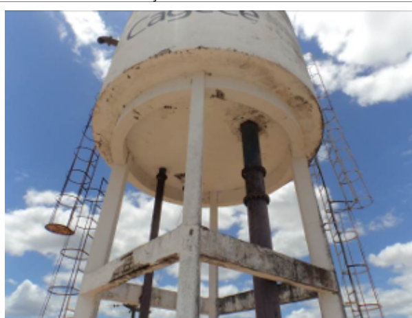
Foto 34 – REL-01: escada em processo de corrosão, pintura deteriorada e armaduras expostas.
