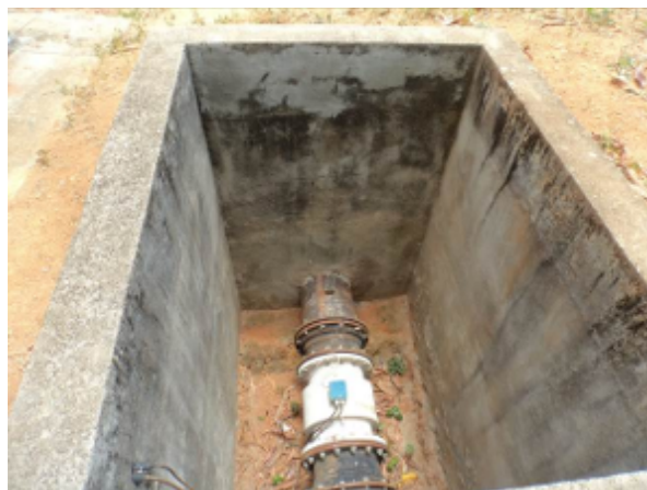
Foto 30 – ETA: caixa do macromedidor sem tampa ou caixa de proteção (2).
