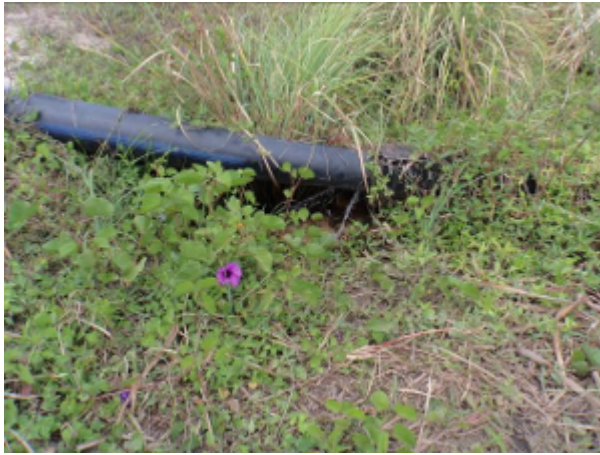
Foto 19 - AAB: vazamento no trecho da adutora entre a captação e a ETA.
