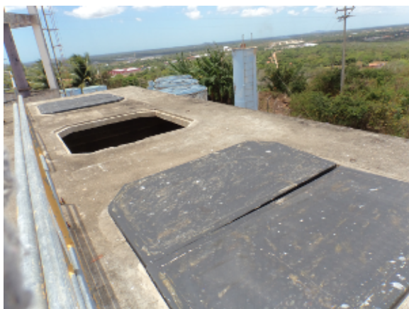
Foto 47 - ETA/Filtração: F-12 sem tampa de inspeção.
