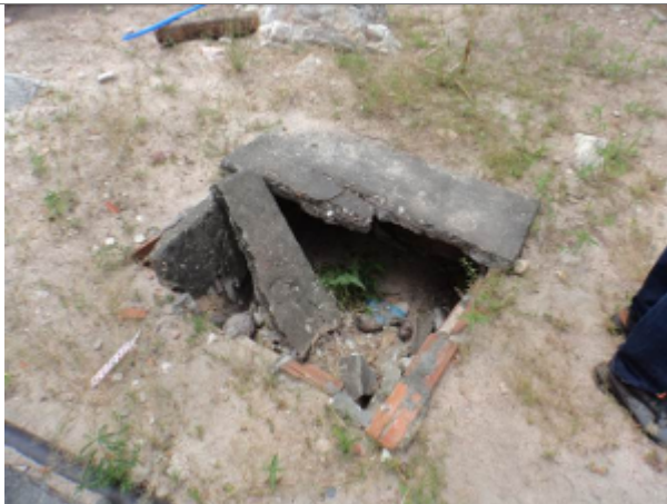
Foto 25 – RAP-02: caixa de inspeção com tampa danificada.
