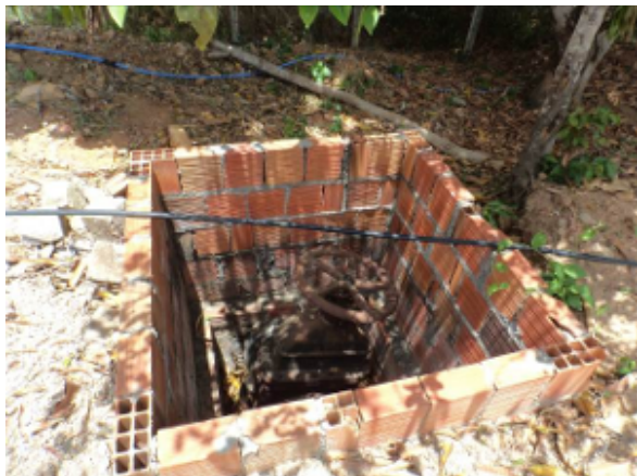
Foto 31 – ETA: caixa do registro sem tampa ou grade de proteção.
