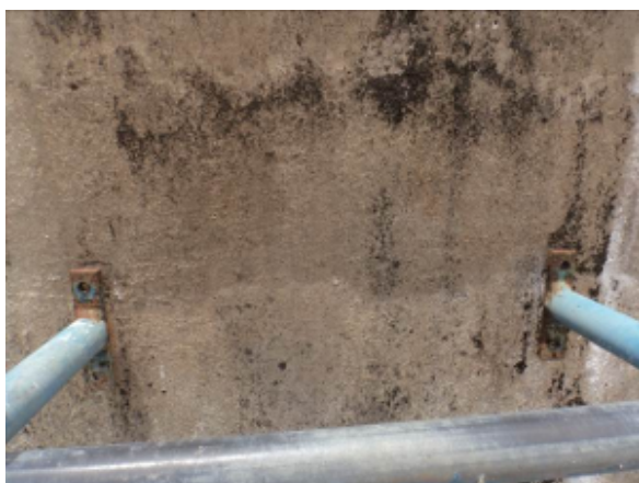
Foto 35 – RAP-02: escada de acesso sem fixação.
