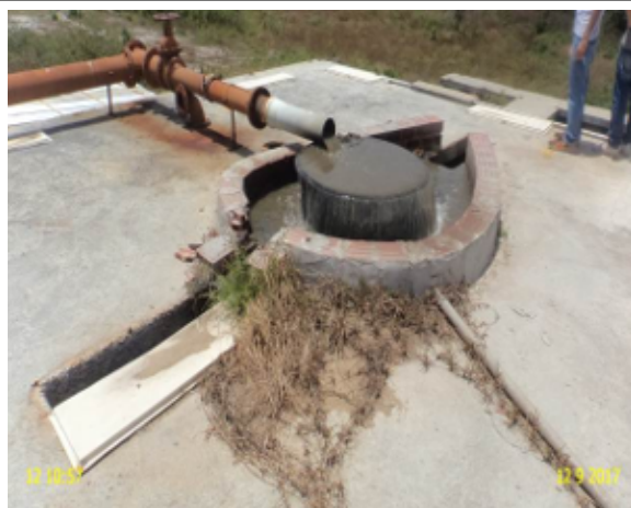
Foto 18 – ETE Dourado: Reator UASB sem funcionamento adequado.
