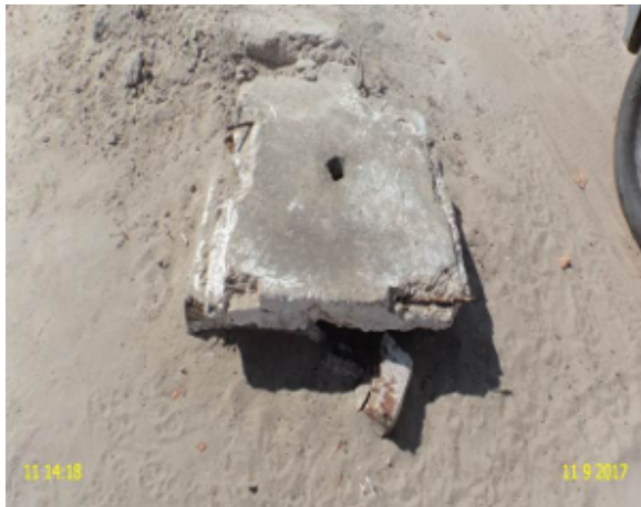
Foto 21 – RDA: registro de descarga com caixa danificada, localizado na Rua Manoel Castro.
