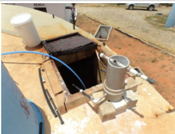
Foto 33 – RAP-03: tampa de inspeção em processo de corrosão e sem vedação.
