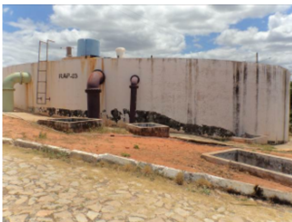
Foto 41 – RAP-03: pintura deteriorada.
