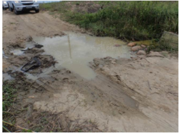
Foto 20 - AAB: sinais de vazamento no trecho da adutora entre a captação e a ETA.
