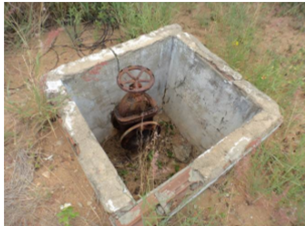
Foto 38 – REL-01: caixa do registro sem tampa ou grade de proteção.
