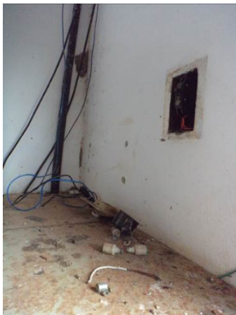
Foto 5 – EEAT-01: instalações elétricas inadequadas e quadro do disjuntor sem tampa.
