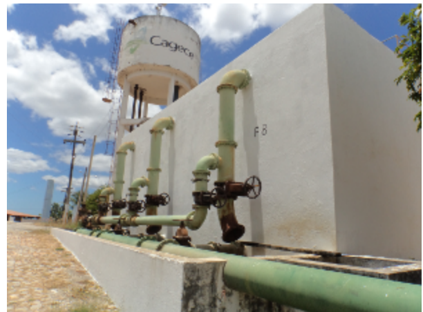
Foto 24 – ETA/Filtração: filtros F-09 e F-10 sem identificação.
