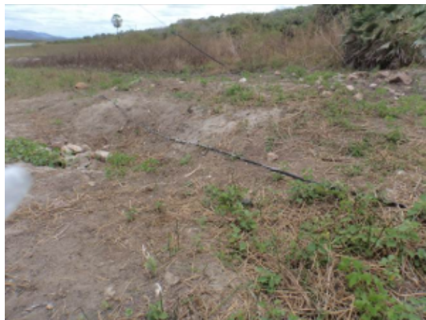
Foto 14 – AAB (EECS-02): instalações elétricas inadequadas.
