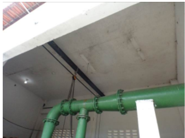
Foto 6 – EEAB-02: lâmpadas com defeito.
