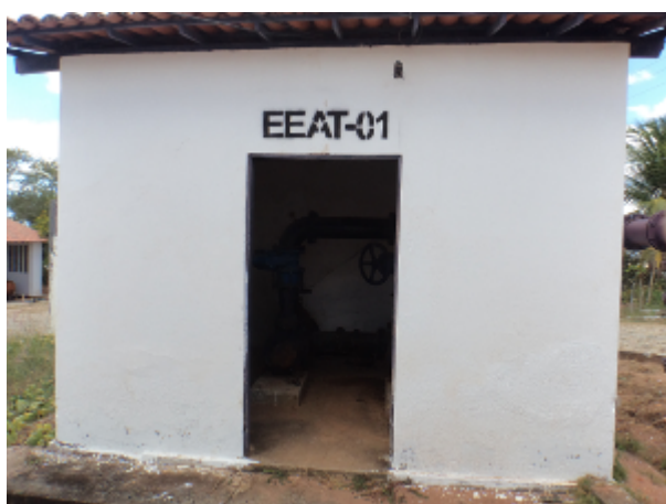
Foto 15 – EEAT-01: ausência de porta.
