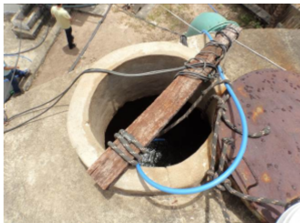
Foto 32 – RAP-02: tampa de inspeção em processo de corrosão e sem vedação.
