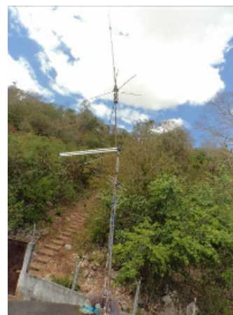
Foto 22 – RAP-02: instalações elétricas inadequadas.
