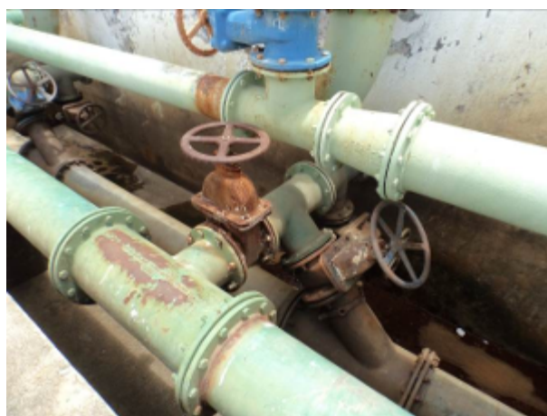
Foto 17 – ETA/Filtração: registro do filtro F-12 (desativado) sem vedação.
