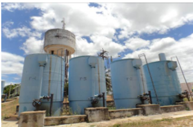
Foto 3 – ETA/Filtração: calhas de saída de água sem tampa nos filtros F-01 (desativado), F-02, F-03 e F-04.
