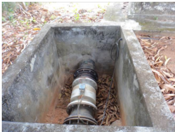
Foto 29 – ETA: caixa do macromedidor sem tampa ou caixa de proteção (1).
