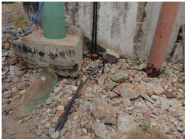
Foto 23 – ETA/Filtração: filtros F-09 e F-10 sem identificação.
