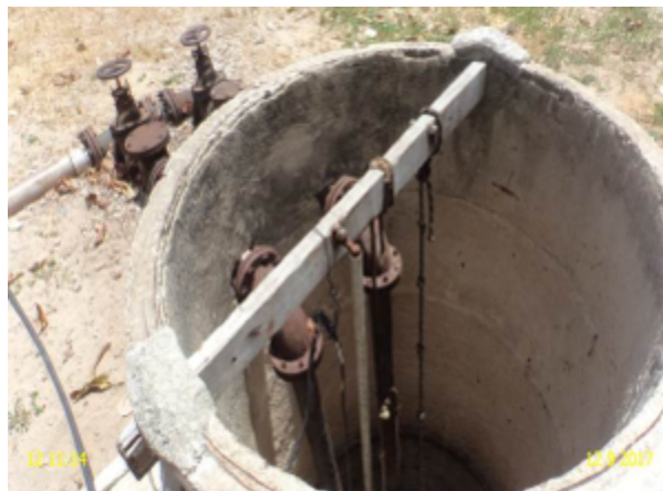
Foto 10 – ETE Zumbi: poço de sucção sem tampa.
