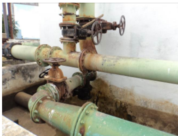
Foto 16 – ETA/Filtração: registro do filtro F-10 sem vedação.
