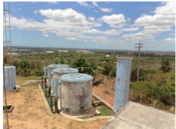
Foto 4 – ETA/Filtração: calhas de saída de água sem tampa nos filtros F-05, F-06 e F-07.
