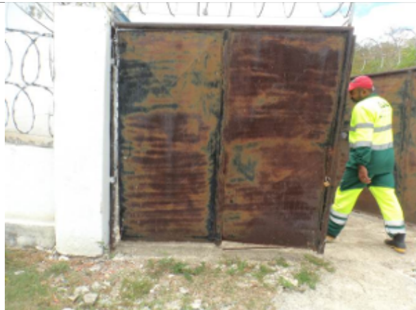
Foto 26 – Portão da casa de abrigo do quadro de comando da captação danificado.
