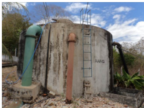
Foto 40 – RAP-02: pintura deteriorada.
