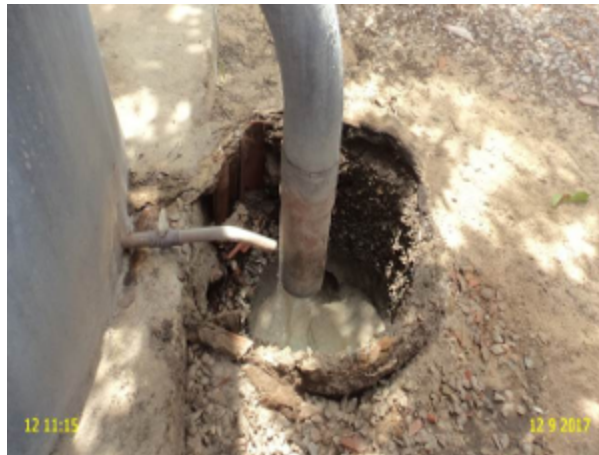
Foto 8 – ETE Zumbi: caixa de inspeção na saída do efluente tratado sem tampa.
