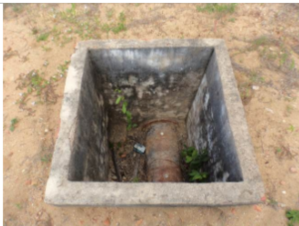
Foto 39 – RAP-03: caixa do medidor sem tampa ou grade de proteção.
