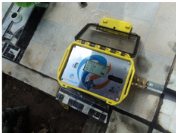
Foto 3 – RDA: medição instantânea de pressão na Rua Ceará, nº 839.
