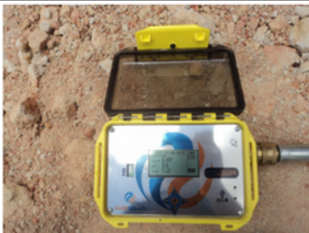
Foto 8 – RDA: medição instantânea de pressão na Rua Marçal de Souza, (Parque Matusa).
