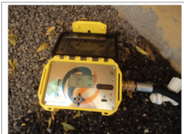
Foto 1 – RDA: medição contínua de pressão na Rua Cruzeiro do Brandão, nº 79.
