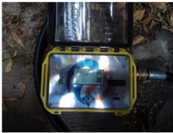
Foto 7 – RDA: medição instantânea de pressão na Tv. Palmas, nº 212 L.
