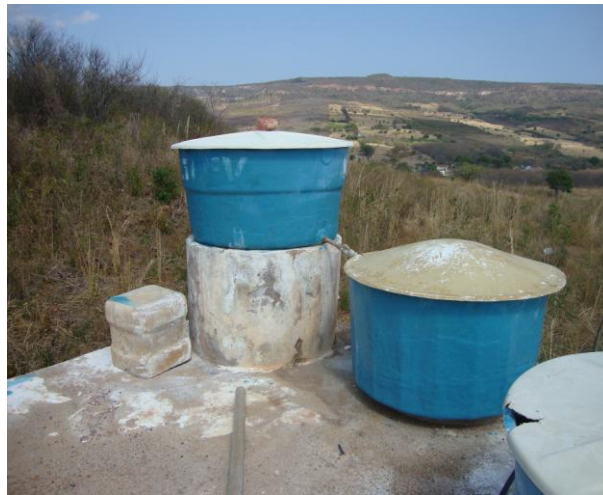
Foto 15 – Tanques dosadores no RAP-03.
