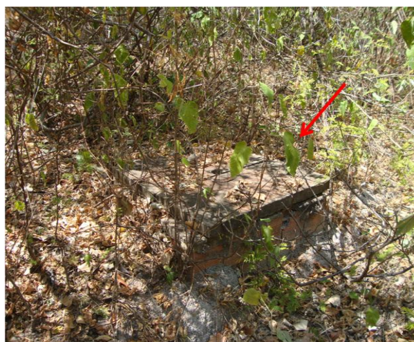
Foto 28 – Caixa de ventosa da adutora de água bruta das fontes 02 e 03.
