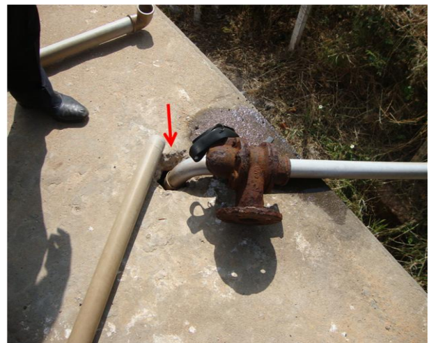
Foto 37 – Tubulações de entrada ao reservatório RAP-03 de forma inadequada.
