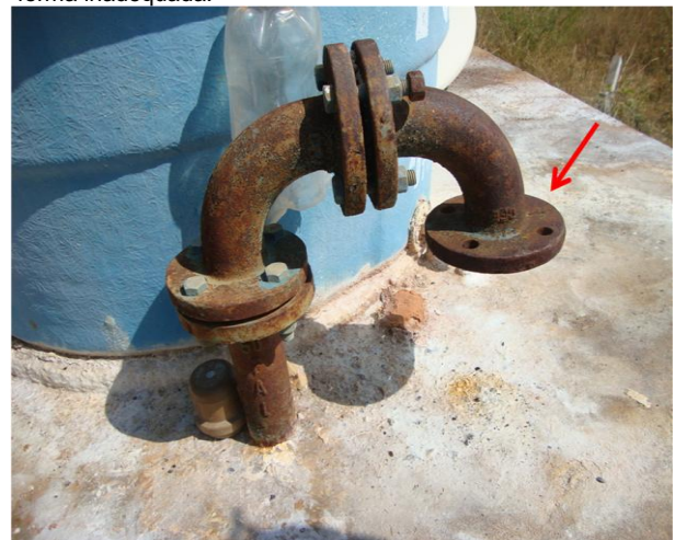
Foto 39 – RAP-03: tubulação de ventilação sem tela de vedação.
