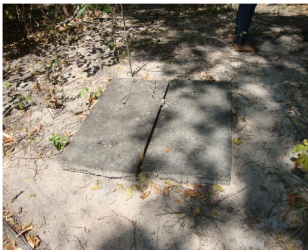
Foto 29 – Caixa de ventosa da adutora de água bruta das fontes 02 e 03.
