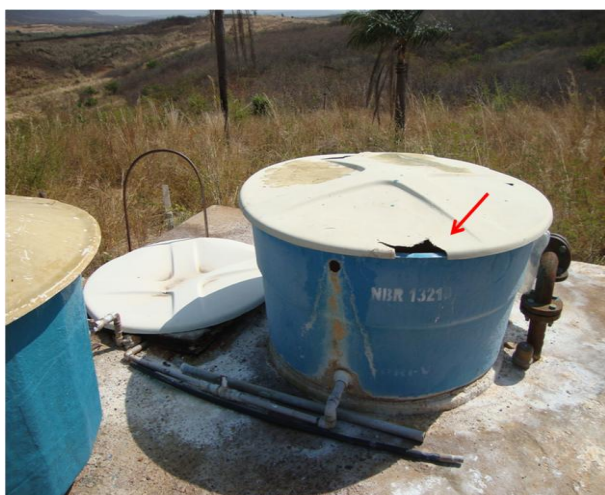
Foto 16 – Tanques dosadores no RAP-03.
