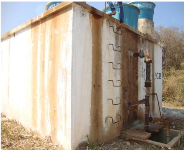
Foto 36 – RAP-03: escada de acesso e sinais de extravazamento na parede.
