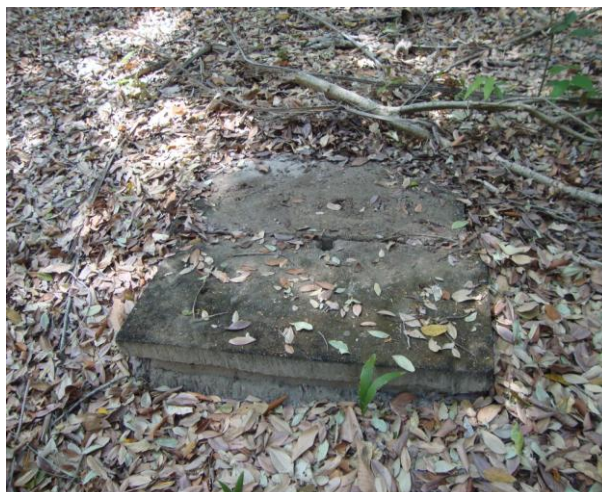
Foto 30 – Caixa de registro da adutora de água bruta das fontes 02 e 03.
