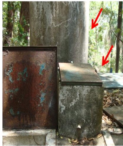
Foto 13 – Dosador de nível constante do RAP-01 desativado.
