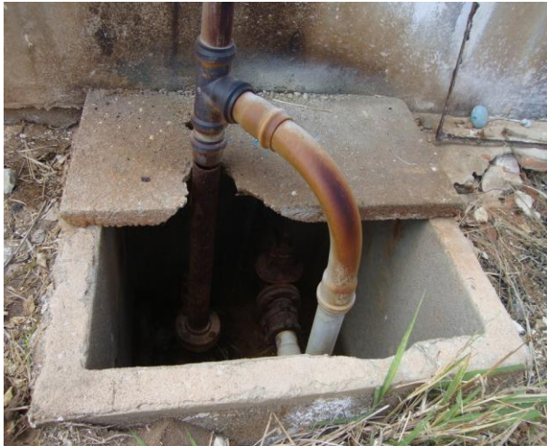
Foto 42 – Caixa de registro sem tampa ou grade de proteção.
