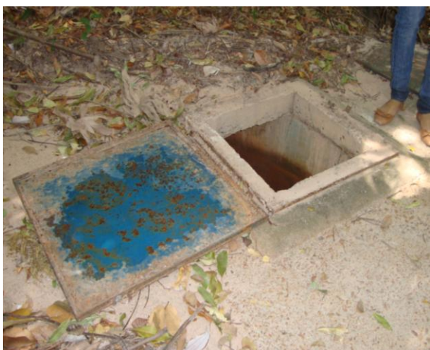
Foto 11 – Fonte 03 com tampa de inspeção.
