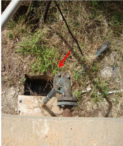
Foto 40 – RAP-03: tubo extravasor.
