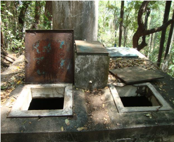
Foto 34 – RAP-01/Fonte: tampas de inspeção.
