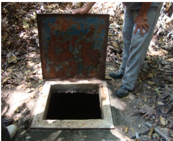
Foto 7 – Fonte 02 com tampa de inspeção.
