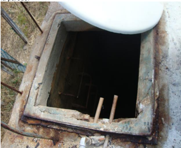
Foto 38 – RAP-03: tampa de inspeção improvisada.
