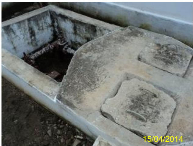
Foto 132 – ETE Nova Vida: poço de sucção.
