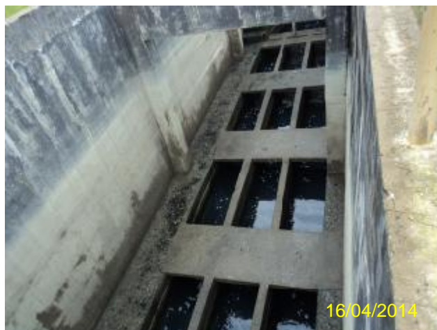
Foto 37 – EEE-01: caixa de areia.
