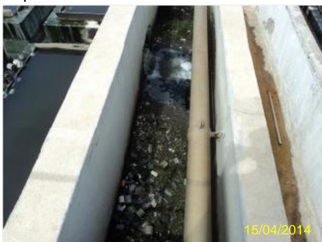
Foto 152 – ETE Pajuçara: FSA 1 – más condições de conservação e manutenção com acúmulo de resíduos.
