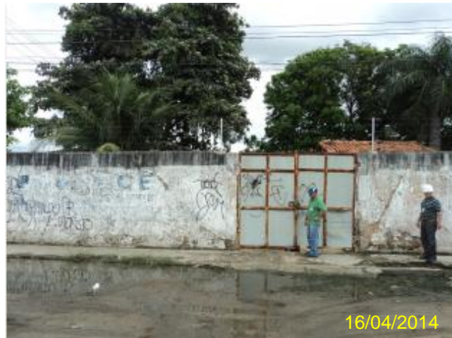
Foto 97 – EEE Novo Maracanaú: pintura deteriorada e ausência de identificação.
