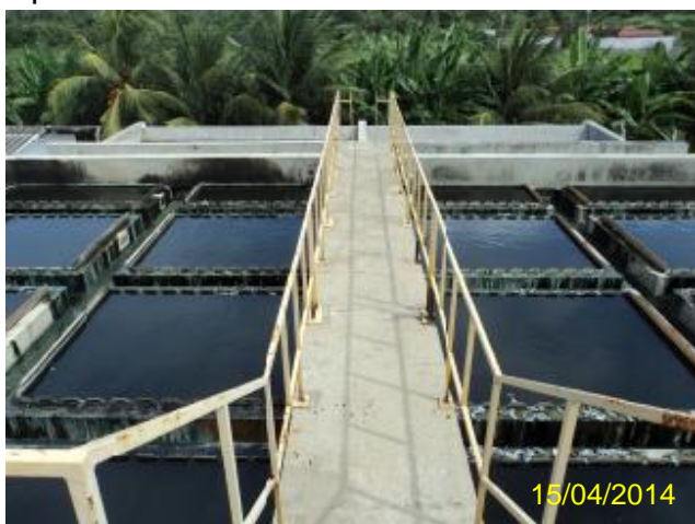
Foto 149 – ETE Pajuçara: FSA 1.
