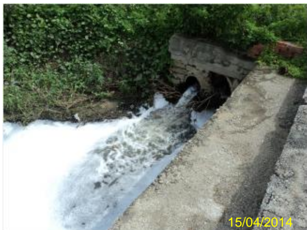
Foto 206 – ETE Pajuçara: ponto de lançamento do efluente tratado no Riacho Timbó.
