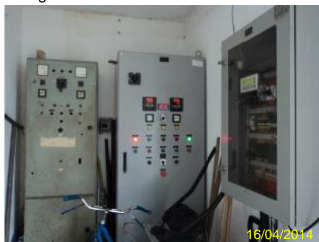
Foto 95 – EEE Conj. Industrial: quadro de comando.
