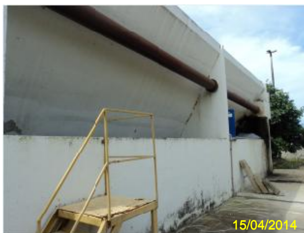
Foto 170 – ETE Pajuçara: tanque de contato 2 - vista lateral.
