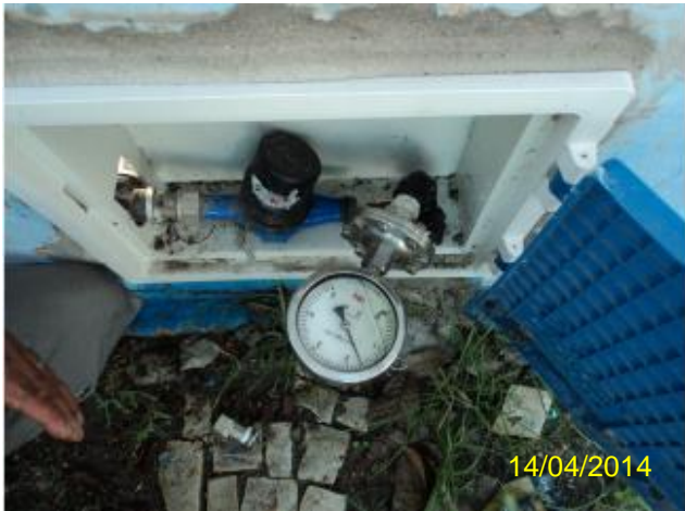
Foto 19 – RDA: medição instantânea de pressão na Av. Central, s/n – CENTEC Maracanaú – Jereissati I.
