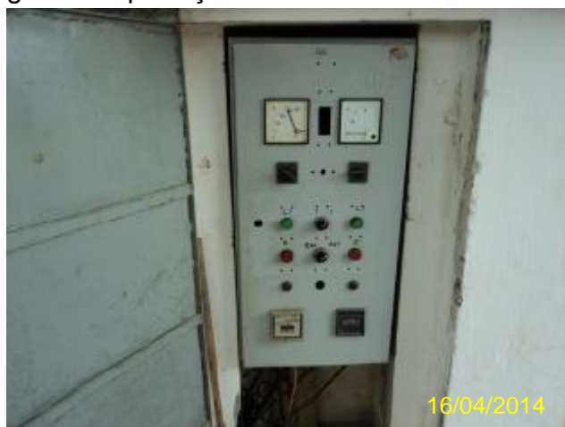
Foto 105 – EEE Novo Maracanaú: quadro de comando.
