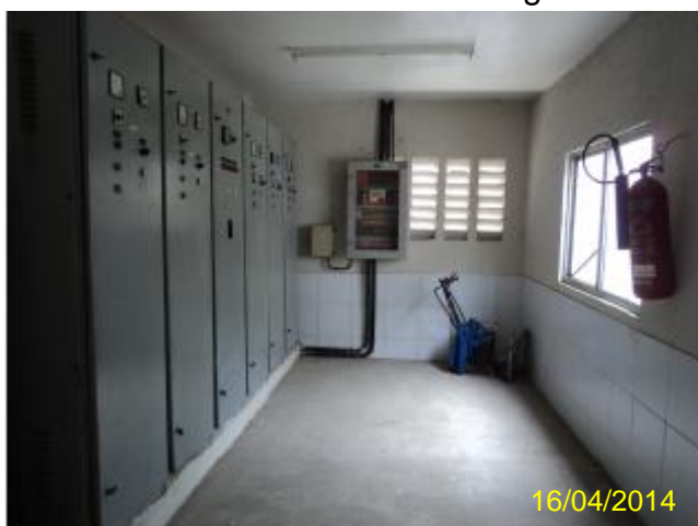
Foto 62 – EEE-03: quadros de comando e extintor de incêndio.
