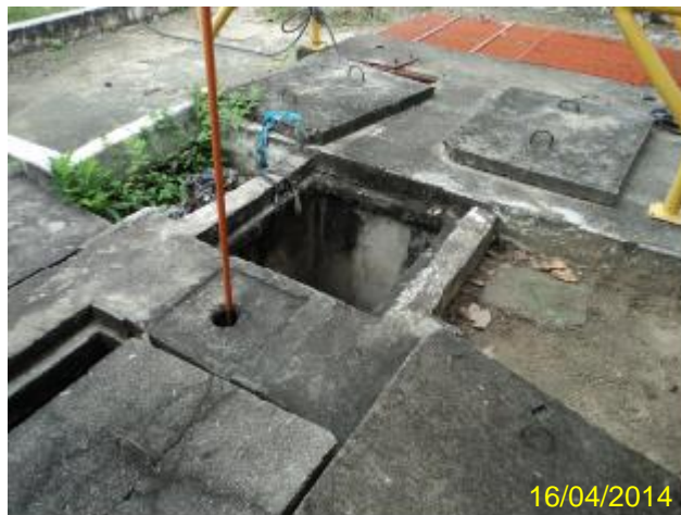
Foto 109 – EEE Novo Oriente: poço de sucção sem tampa ou grade de proteção.
