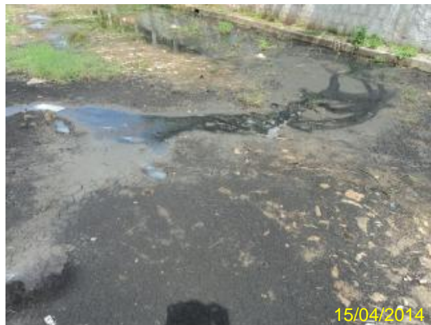
Foto 160 – ETE Pajuçara: condições de limpeza e conservação – transbordamento de esgoto.
