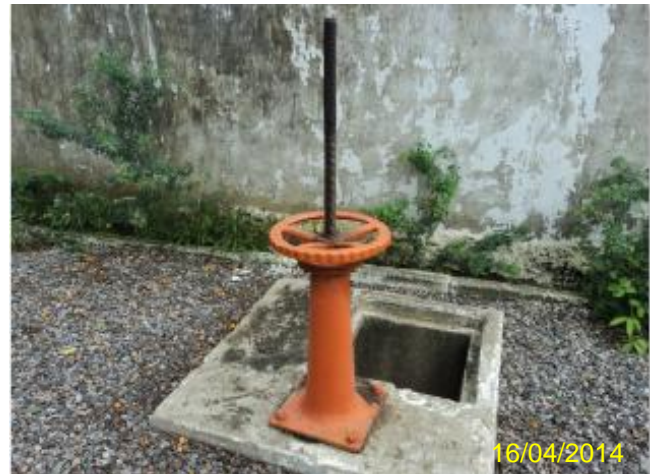
Foto 71 – EEE Acaracuzinho: poço de visita sem tampa.
