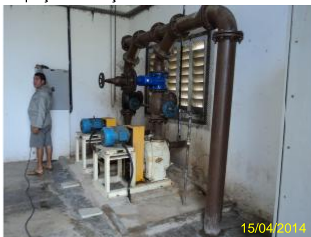
Foto 77 – EEE Bandeirantes: conjunto moto-bomba.
