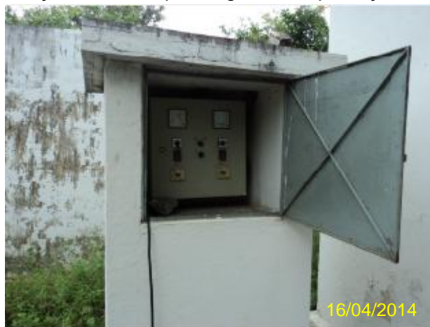
Foto 111 – EEE Novo Oriente: quadro de comando.
