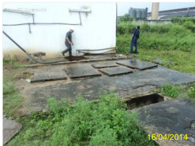
Foto 49 – EEE-02: poço de sucção.
