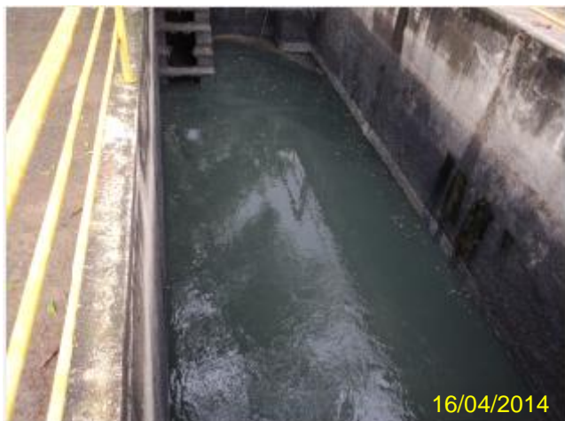
Foto 90 – EEE Conj. Industrial: instalações submersas pelo esgoto.
