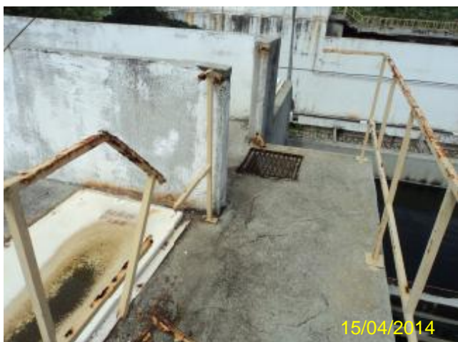
Foto 155 – ETE Pajuçara: guarda-corpos deteriorados.
