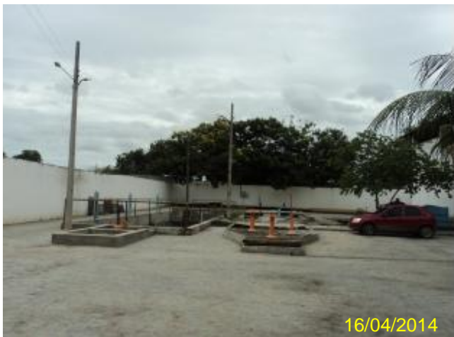
Foto 54 – EEE-03: vista geral (1).
