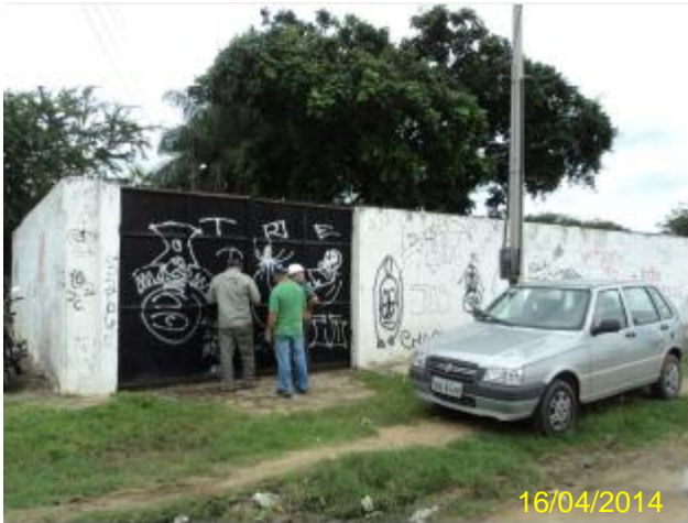
Foto 68 – EEE Acaracuzinho: pintura deteriorada e ausência de identificação.
