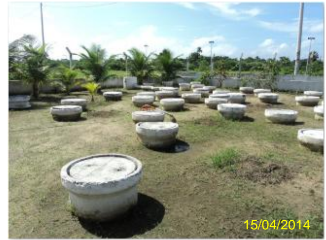
Foto 119 – ETE Maracananzinho: vista geral dos decantos-digestores e filtros anaeróbios.
