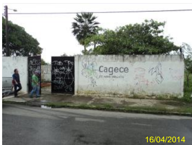
Foto 107 – EEE Novo Oriente: pintura deteriorada e identificação ilegível.
