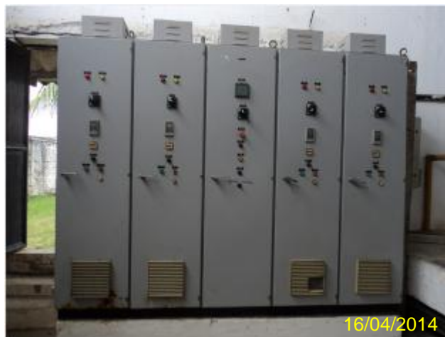
Foto 43 – EEE-01: quadros de comando.
