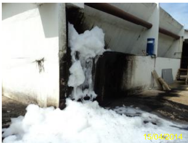
Foto 158 – ETE Pajuçara: condições de limpeza e conservação – transbordamento de espuma.
