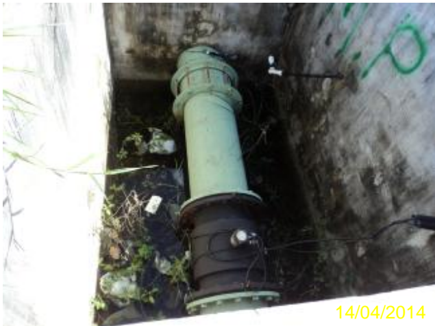
Foto 1 – AAT: caixa do macromedidor sem tampa ou grade de inspeção.
