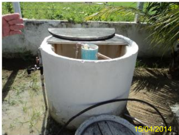
Foto 120 – ETE Maracananzinho: tanque de cloração.
