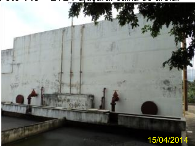
Foto 145 – ETE Pajuçara: DAFA 1.
