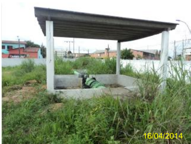
Foto 5 – AAT: casa de abrigo da válvula redutora de pressão instalada na área do REL-01.
