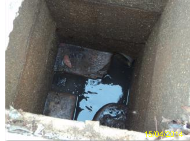
Foto 131 – ETE Nova Vida: tanque de contato.
