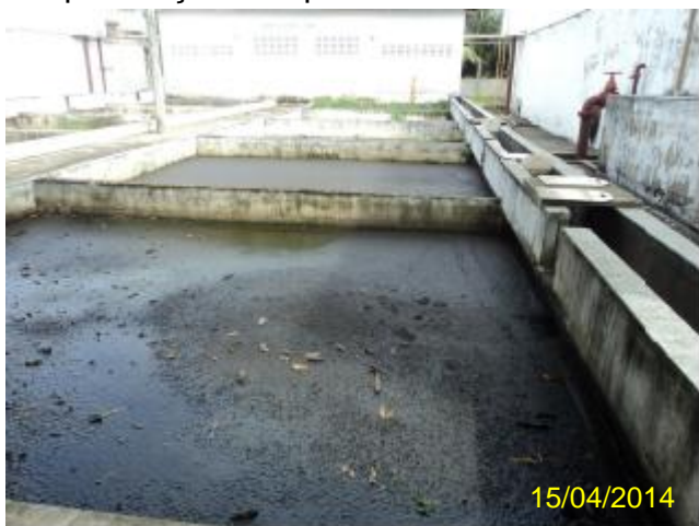
Foto 173 – ETE Pajuçara: leitos de secagem do DAFA 1.
