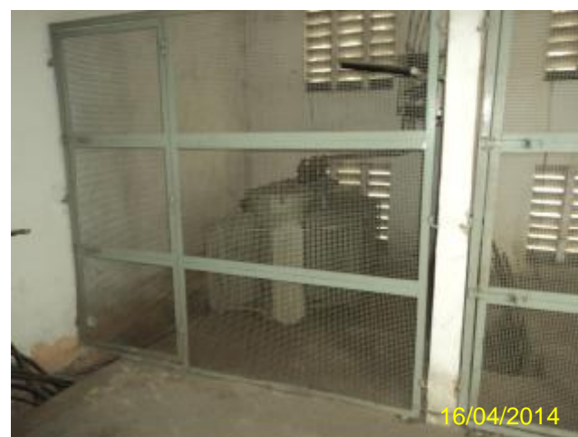
Foto 64 – EEE-03: subestação de energia.
