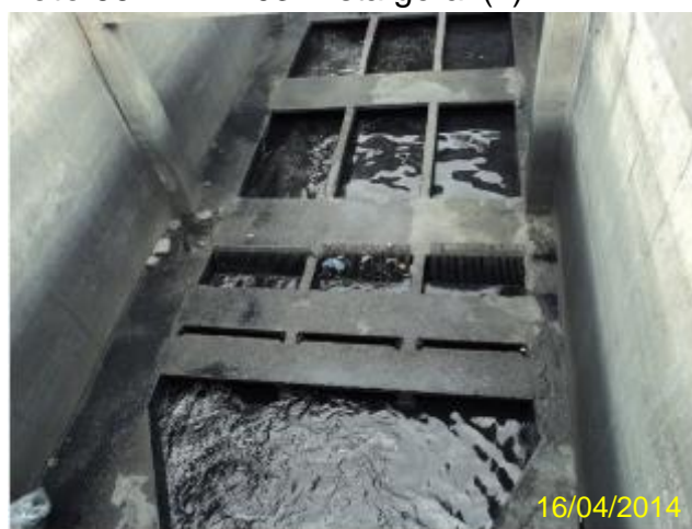
Foto 57 – EEE-03: gradeamento e caixa de areia.
