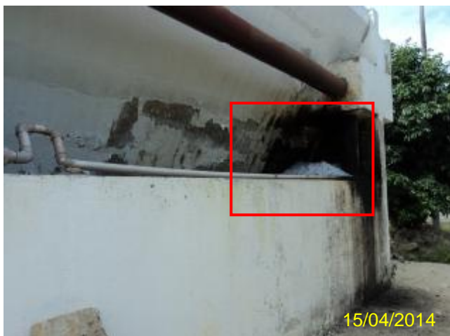
Foto 171 – ETE Pajuçara: tanque de contato 2 – presença de espuma.
