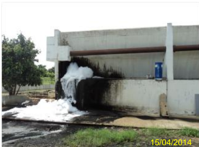
Foto 159 – ETE Pajuçara: condições de limpeza e conservação – transbordamento de espuma.
