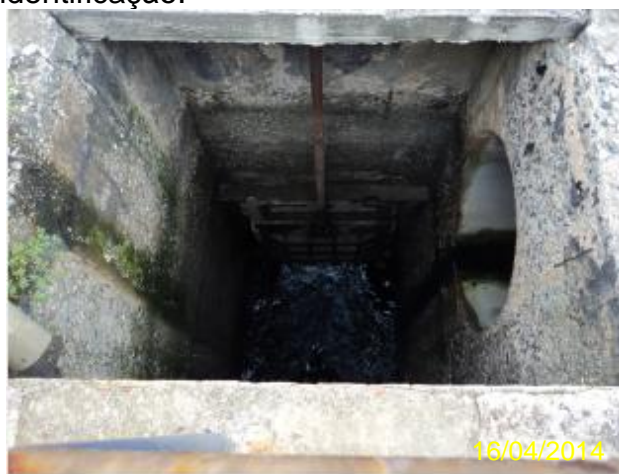
Foto 35 – EEE-01: poço de chegada sem tampa ou grade de proteção.
