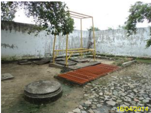
Foto 108 – EEE Novo Oriente: vista geral.
