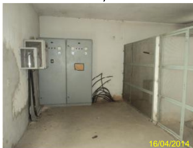
Foto 63 – EEE-03: subestação de energia.
