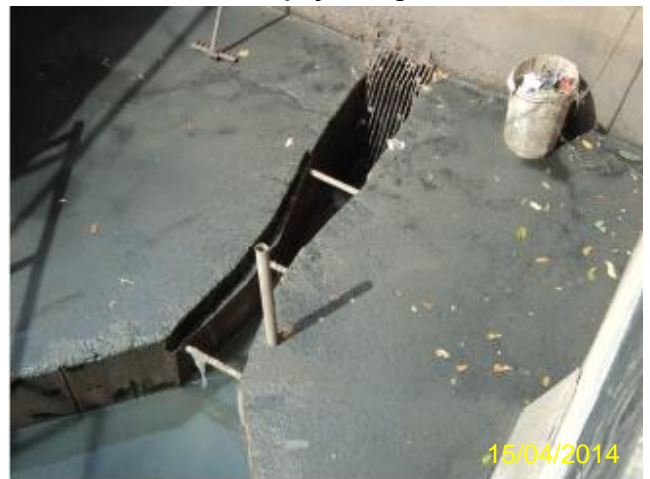
Foto 144 – ETE Pajuçara: calha parshall.
