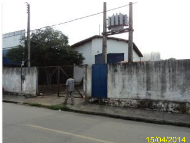
Foto 81 – EEE Barbara de Alencar: pintura deteriorada e ausência de identificação.
