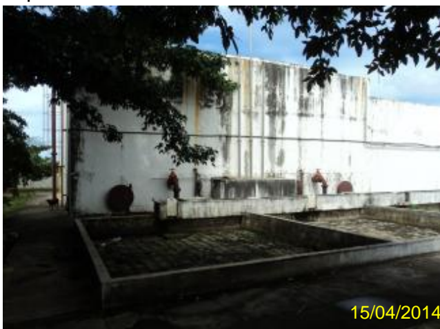
Foto 161 – ETE Pajuçara: DAFA 2 – vista geral.
