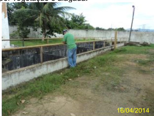
Foto 34 – EEE-01: vista geral.
