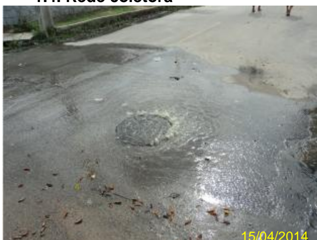
Foto 29 – Extravasamento de esgoto na R. Hamilton de Oliveira.
