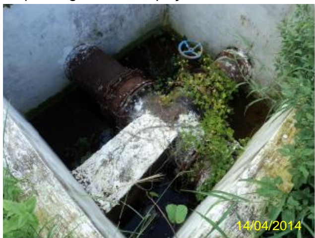
Foto 3 – AAT: caixa sem tampa ou grade de inspeção.
