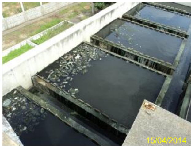
Foto 166 – ETE Pajuçara: FSA 2 - más condições de conservação e manutenção com acúmulo de resíduos.
