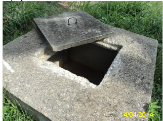
Foto 4 – AAT: caixa de inspeção.
