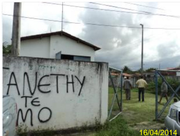
Foto 73 – EEE Bandeirantes: área de acesso, pintura deteriorada e ausência de identificação.
