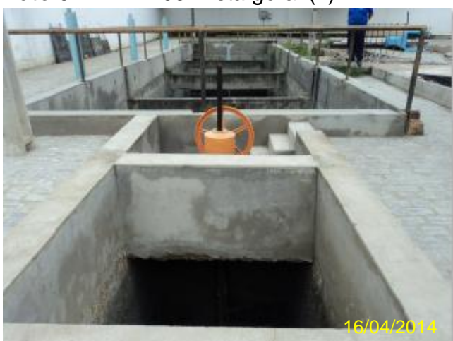
Foto 56 – EEE-03: poço de chegada sem tampa ou grade de proteção.
