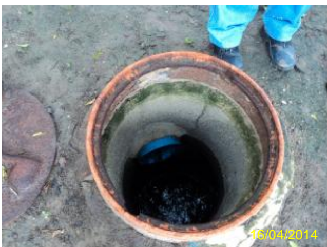
Foto 92 – EEE Conj. Industrial: tubo extravasor.
