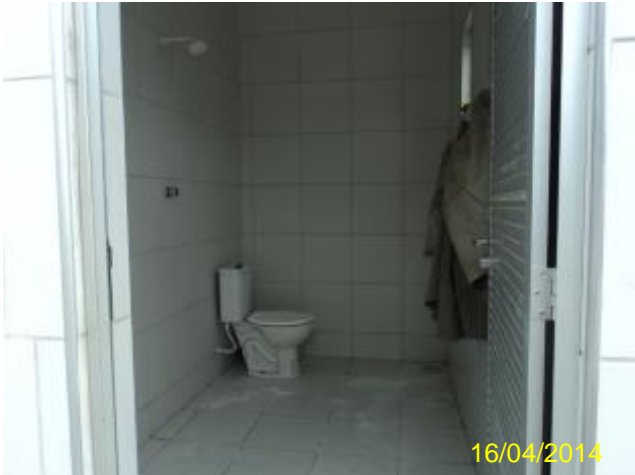
Foto 66 – EEE-03: instalações sanitárias da casa de apoio ao operador.
