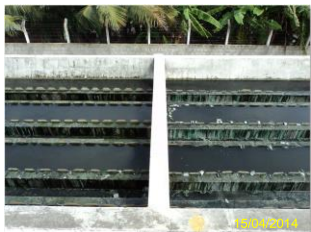
Foto 169 – ETE Pajuçara: Decantador Lamelar 2.
