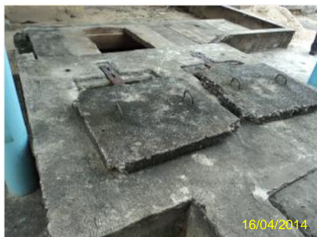
Foto 101 – EEE Novo Maracanaú: poço de sucção.
