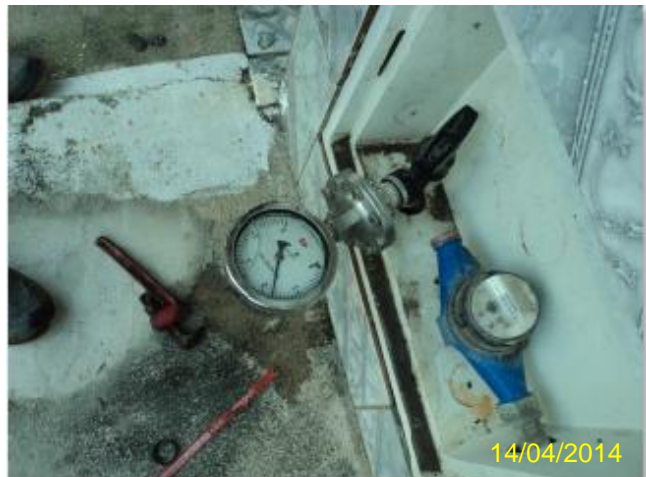
Foto 22 – RDA: medição instantânea de pressão na R. 140, 60 – Timbó.
