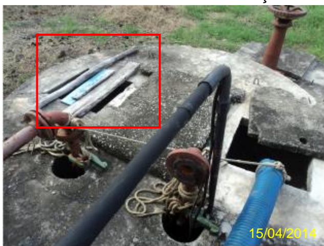
Foto 83 – EEE Barbara de Alencar: tampa improvisada inadequada.
