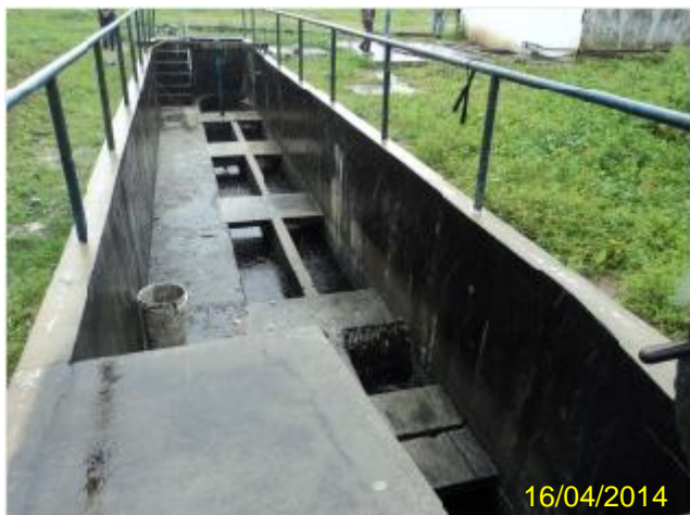
Foto 48 – EEE-02: caixa de areia.
