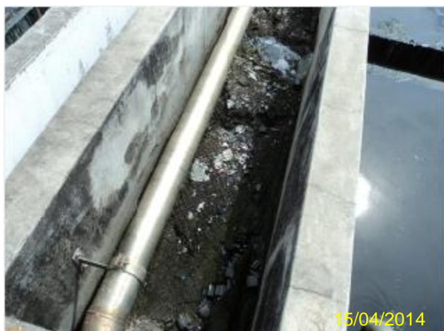
Foto 167 – ETE Pajuçara: FSA 2 - más condições de conservação e manutenção com acúmulo de resíduos.
