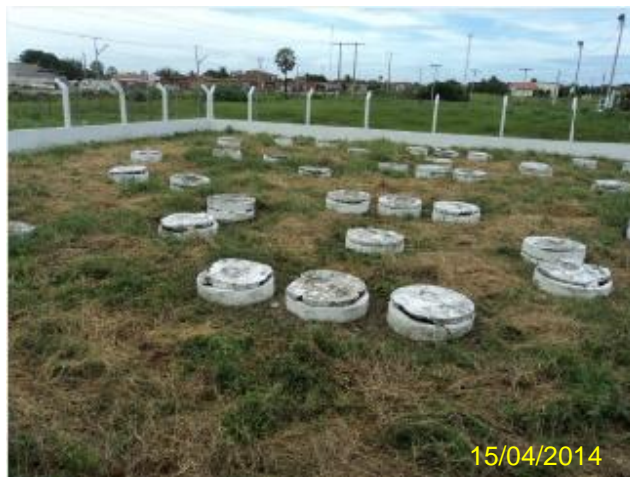
Foto 127 – ETE Nova Vida: decantadores e filtros anaeróbios.
