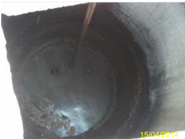
Foto 84 – EEE Barbara de Alencar: vista interna do poço de sucção.
