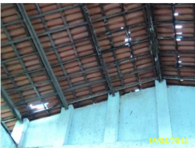
Foto 50 – EEE-02: telhado da casa de abrigo da elevatória deteriorado.
