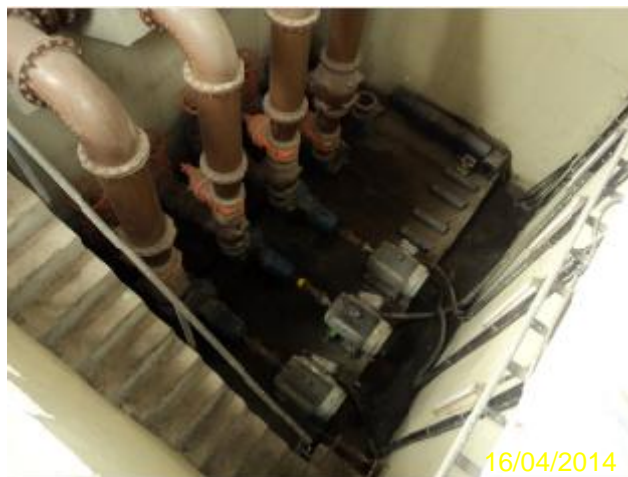
Foto 61 – EEE-03: conjunto moto-bomba.
