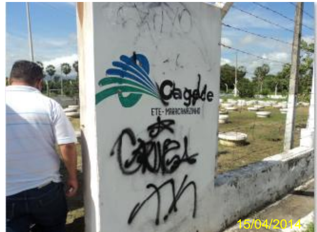
Foto 117 – ETE Maracananzinho: identificação em muro com pintura deteriorada.
