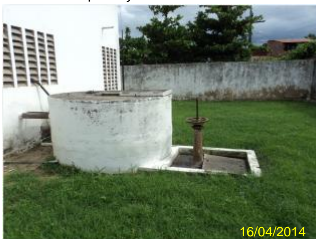
Foto 74 – EEE Bandeirantes: poço de sucção.
