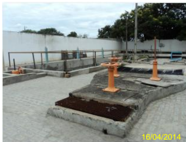
Foto 55 – EEE-03: vista geral (2).
