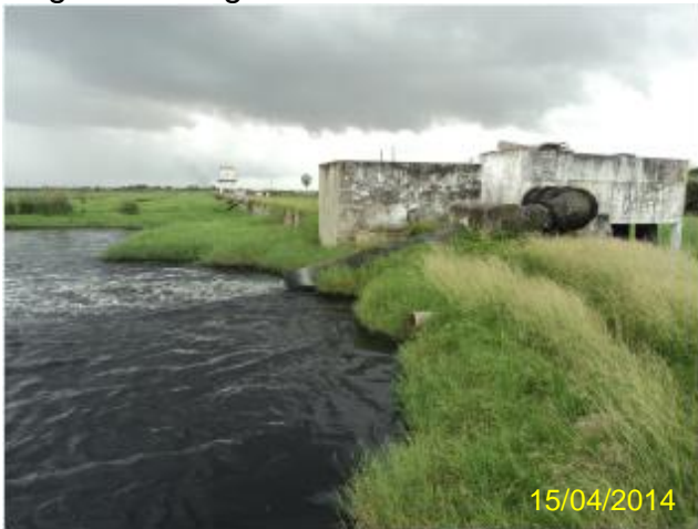
Foto 181 – ETE SIDI: entrada do esgoto bruto na Lagoa Anaeróbia.
