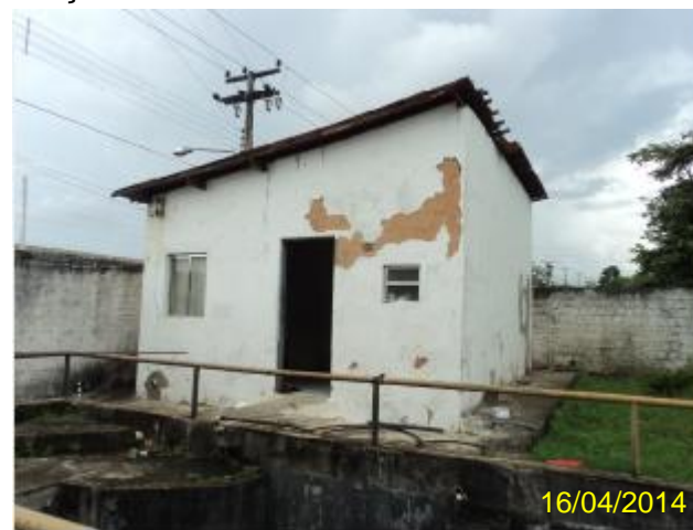
Foto 41 – EEE-01: casa de abrigo do conjunto moto bomba com reboco deteriorado.
