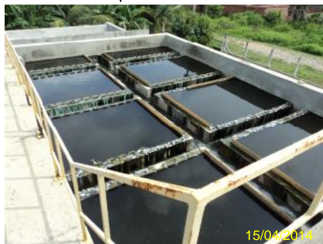
Foto 150 – ETE Pajuçara: FSA 1 – lado esquerdo.
