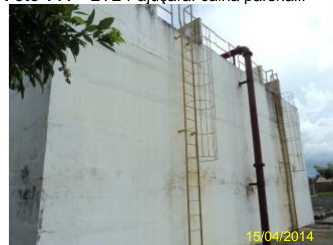
Foto 146 – ETE Pajuçara: DAFA 1 - escadas de acesso.
