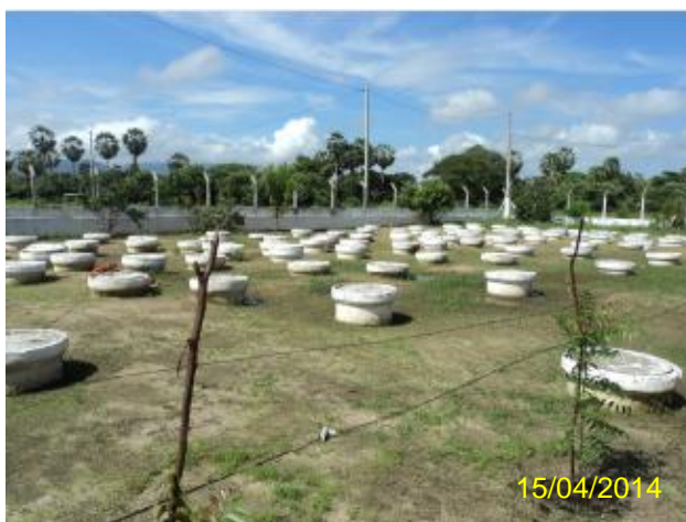
Foto 118 – ETE Maracananzinho: vista geral dos decantos-digestores e filtros anaeróbios.
