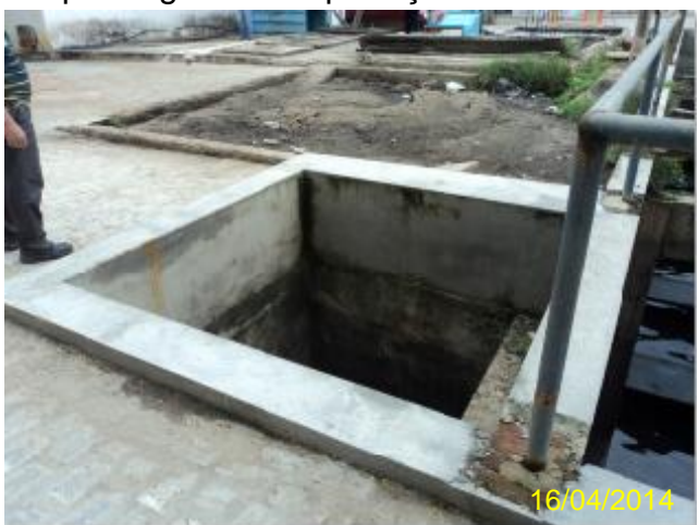
Foto 58 – EEE-03: poço de visita sem tampa ou grade de proteção.
