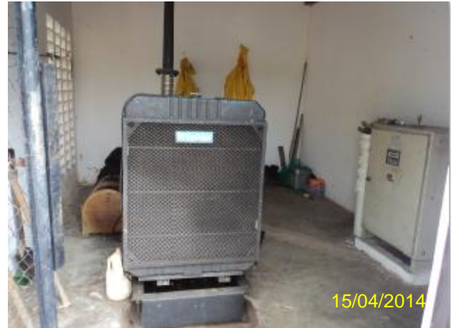
Foto 115 – EEE Pajuçara: grupo gerador de energia parado.
