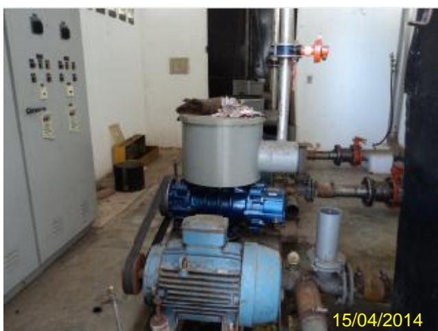
Foto 175 – ETE Pajuçara: soprador parado.
