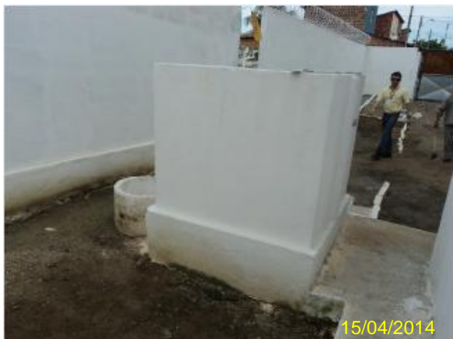
Foto 128 – ETE Nova Vida: tanque de cloro.
