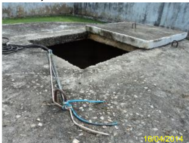
Foto 75 – EEE Bandeirantes: vista superior do poço de sucção.
