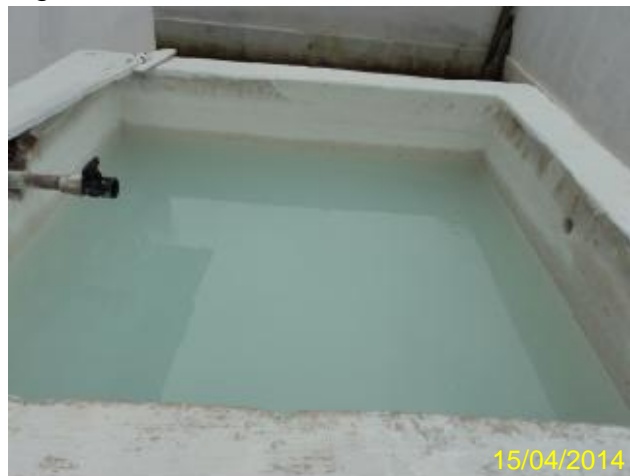
Foto 129 – ETE Nova Vida: tanque de cloro.
