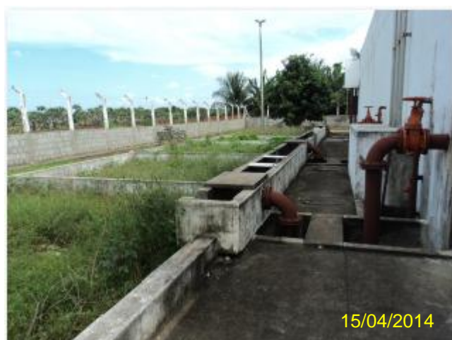
Foto 174 – ETE Pajuçara: leitos de secagem do DAFA 2.
