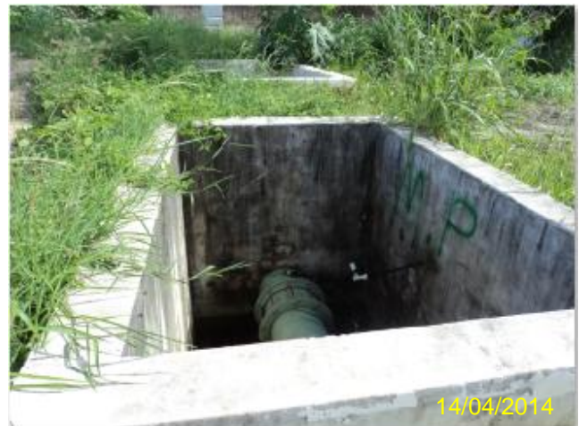
Foto 2 – AAT: caixa sem tampa ou grade de inspeção.
