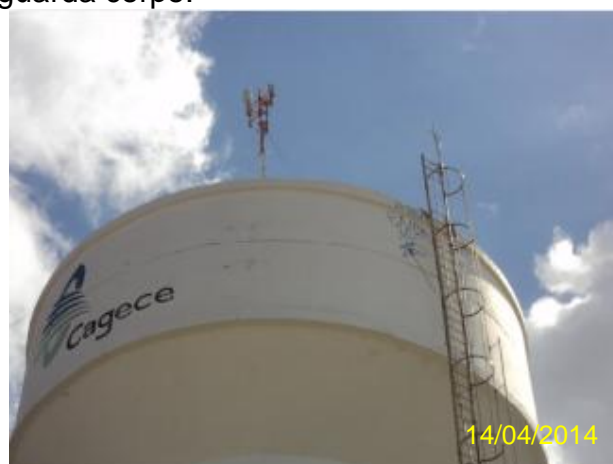
Foto 11 – REL-01: identificação, para-raios, sinalização noturna e ausência de guarda-corpo na laje superior.
