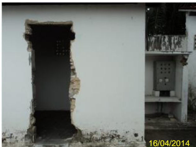
Foto 72 – EEE Acaracuzinho: quadro de comando e casa de apoio ao operador deteriorada por ações de vandalismo.
