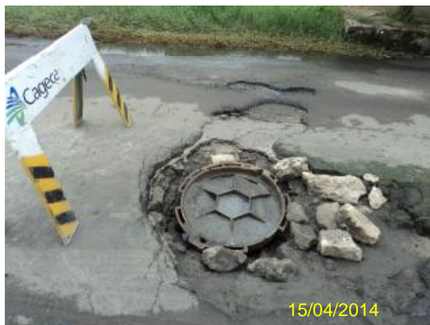
Foto 31 – Poço de visita com estrutura deteriorada na R. 19 com R.1, Novo Maracanaú.
