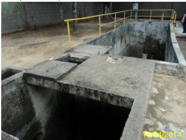
Foto 98 – EEE Novo Maracanaú: vista geral e poço de chegada sem tampa ou grade de proteção.
