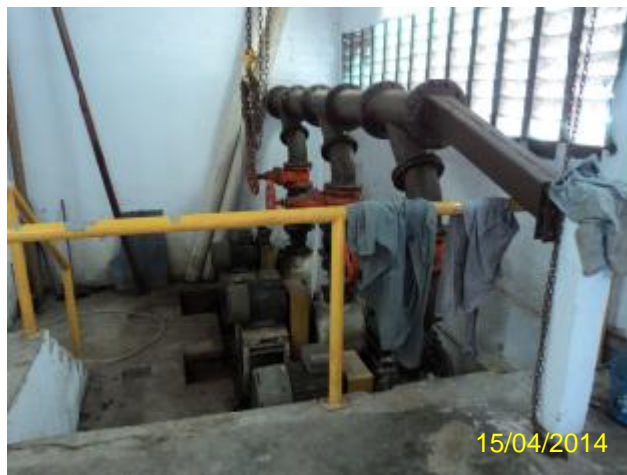
Foto 113 – EEE Pajuçara: conjunto moto-bomba.
