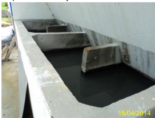
Foto 156 – ETE Pajuçara: tanque de contato.
