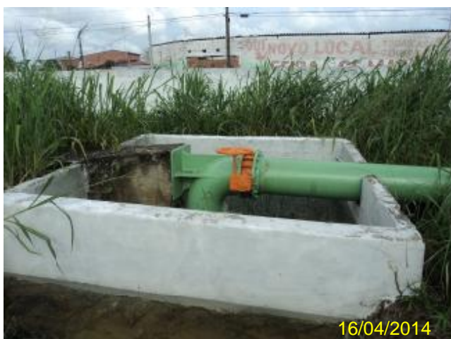
Foto 7 – AAT: caixa da tubulação da válvula redutora de pressão.
