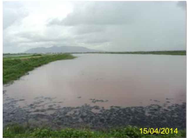
Foto 192 – ETE SIDI: Lagoa de Maturação 1 – coloração e acúmulo de materiais sobrenadantes.
