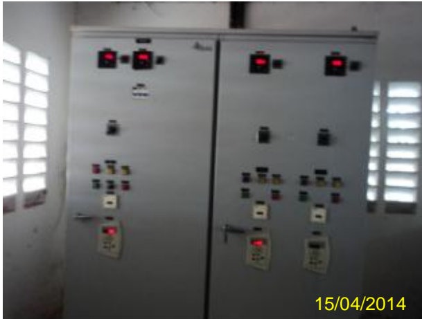
Foto 114 – EEE Pajuçara: quadro de comando.
