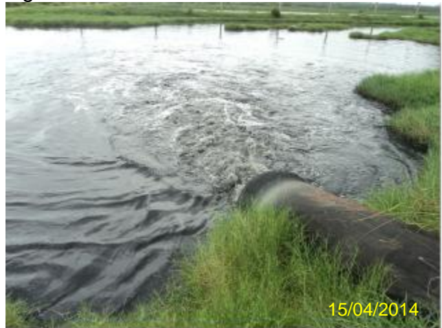
Foto 182 – ETE SIDI: entrada do esgoto bruto na Lagoa Anaeróbia.
