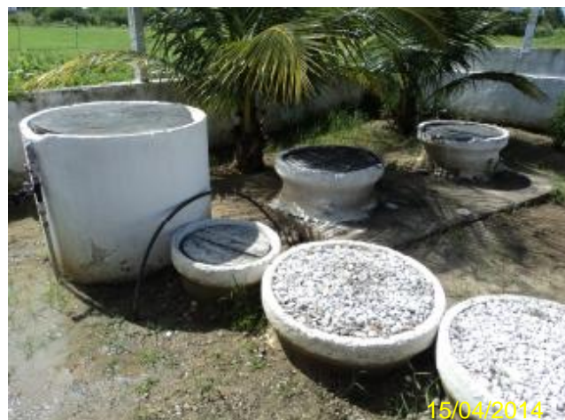
Foto 121 – ETE Maracananzinho: tanque de contato.
