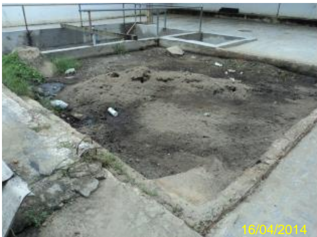
Foto 60 – EEE-03: leitos de secagem.
