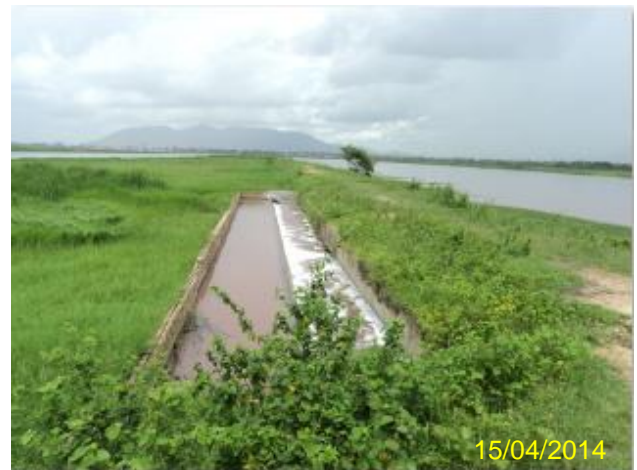
Foto 194 – ETE SIDI: caixa de passagem do esgoto da Lagoa de Maturação 1 para a Lagoa de Maturação 2.
