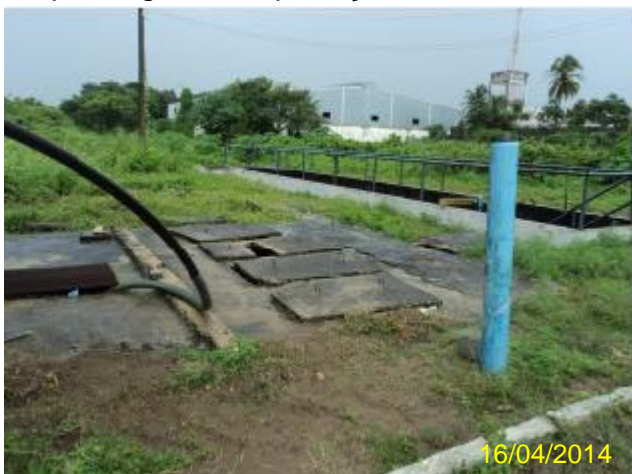
Foto 46 – EEE-02: vista geral.
