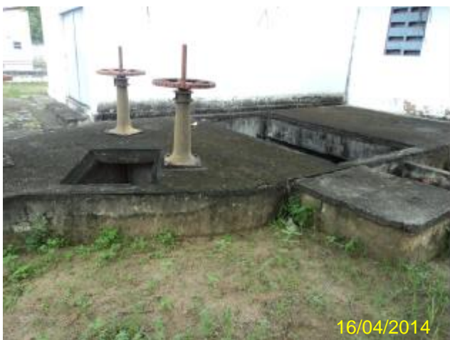
Foto 44 – EEE-01: antigas instalações sem tampa ou grade de proteção.
