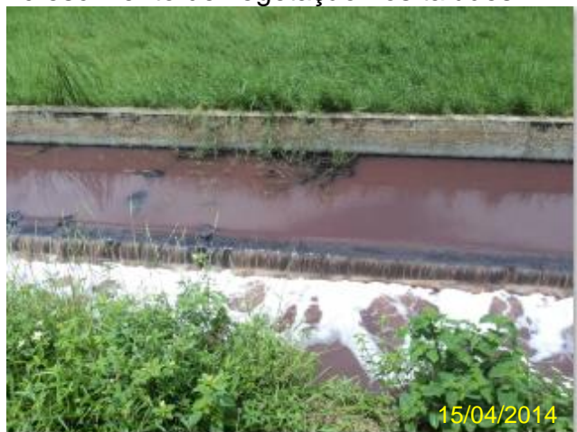
Foto 199 – ETE SIDI: Lagoa de Maturação 3 - caixa de saída do efluente para o corpo receptor com coloração avermelhada.
