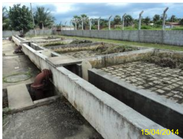
Foto 172 – ETE Pajuçara: leitos de secagem do DAFA 1.
