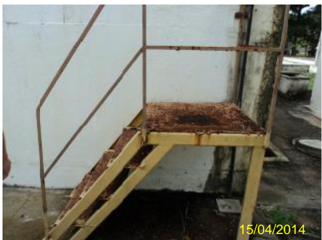
Foto 157 – ETE Pajuçara: escada de acesso ao tanque de contato em processo de corrosão.
