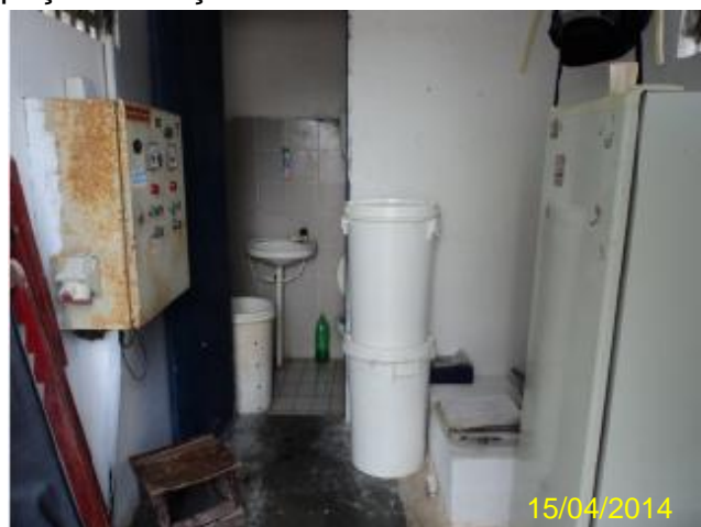
Foto 135 – ETE Nova Vida: vista interna da casa de apoio ao operador.
