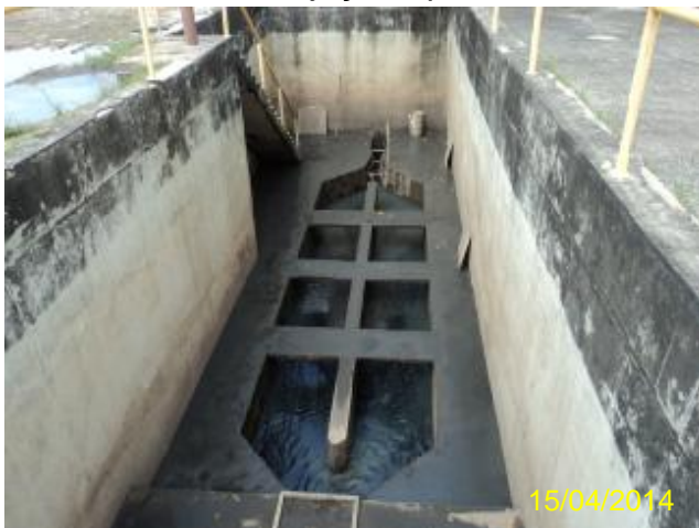
Foto 143 – ETE Pajuçara: caixa de areia.
