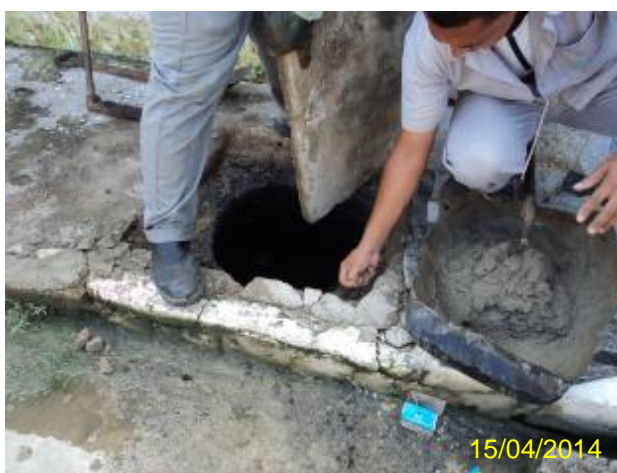
Foto 30 – Execução do serviço de desobstrução de esgoto na R. P, nº 32 – Maracanzinho.
