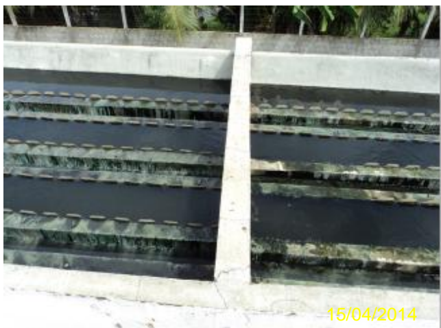
Foto 153 – ETE Pajuçara: Decantador Lamelar 1.
