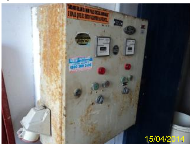
Foto 136 – ETE Nova Vida: quadro de comando.
