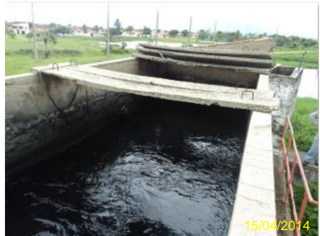
Foto 180 – ETE SIDI: caixa de recepção do esgoto.
