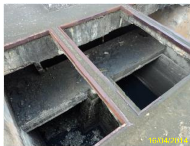
Foto 39 – EEE-01: detalhe do poço de sucção.
