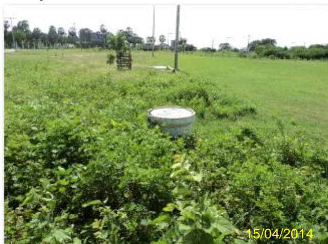
Foto 122 – ETE Maracananzinho: poço de saída do esgoto.
