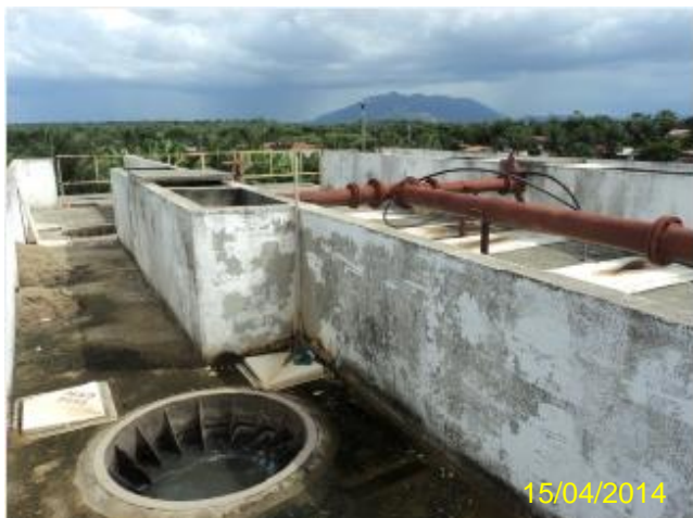
Foto 147 – ETE Pajuçara: DAFA 1 – vista superior.
