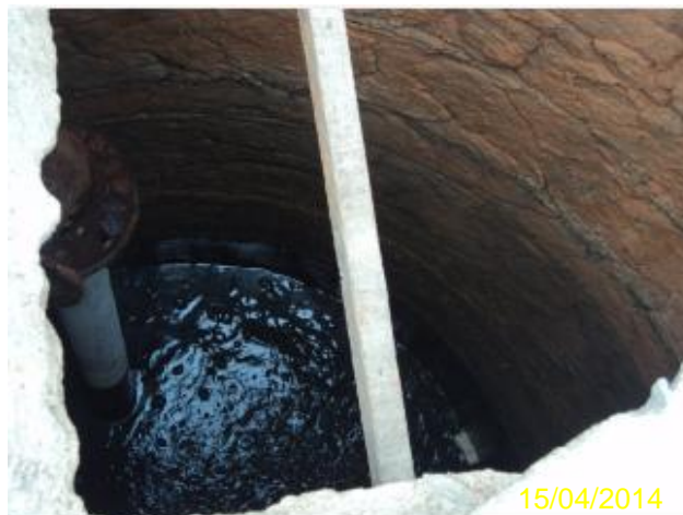
Foto 133 – ETE Nova Vida: vista interna do poço de sucção.
