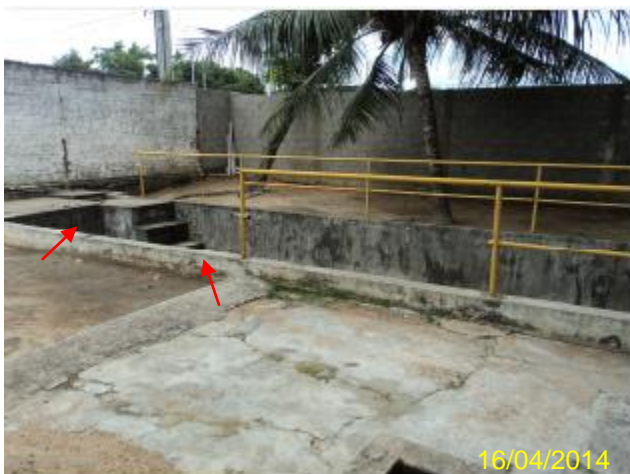
Foto 102 – EEE Novo Maracanaú: guarda corpos deteriorados.
