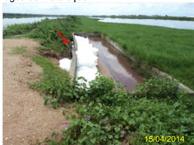
Foto 196 – ETE SIDI: caixa de passagem do esgoto da Lagoa de Maturação 2 para a Lagoa de Maturação 3 deteriorada.
