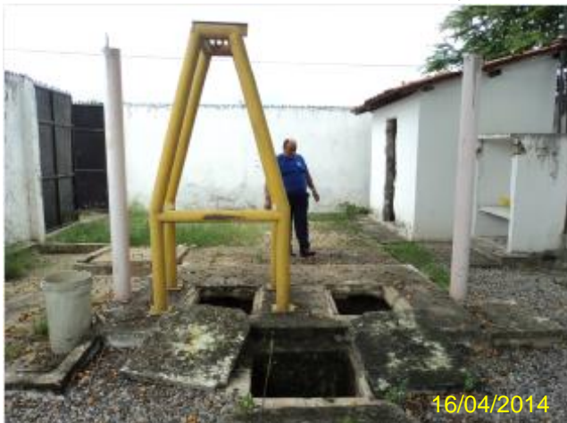
Foto 70 – EEE Acaracuzinho: poço de sucção com as tampas abertas.
