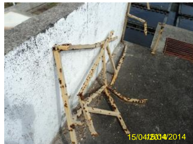
Foto 164 – ETE Pajuçara: DAFA 2 – guarda corpos das instalações deteriorados.
