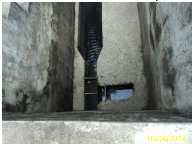
Foto 99 – EEE Novo Maracanaú: gradeamento.
