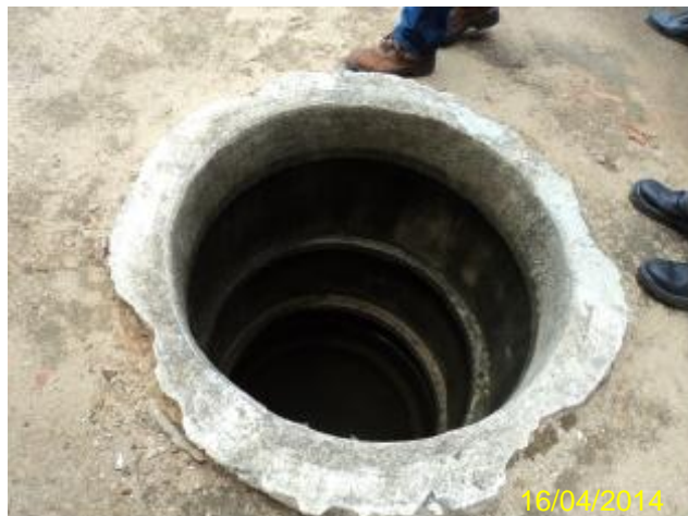
Foto 103 – EEE Novo Maracanaú: poço para medição do recalque sem tampa ou grade de proteção.
