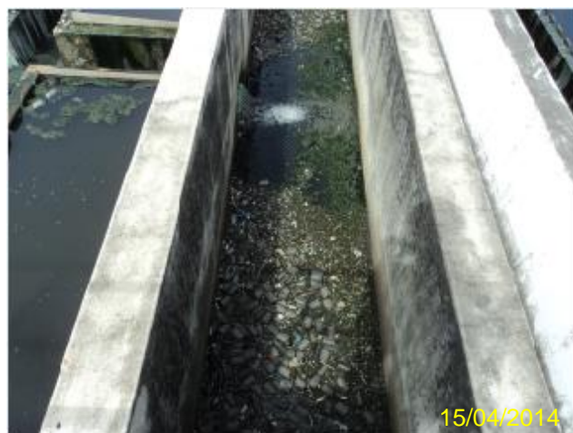
Foto 168 – ETE Pajuçara: FSA 2 - más condições de conservação e manutenção com acúmulo de resíduos.
