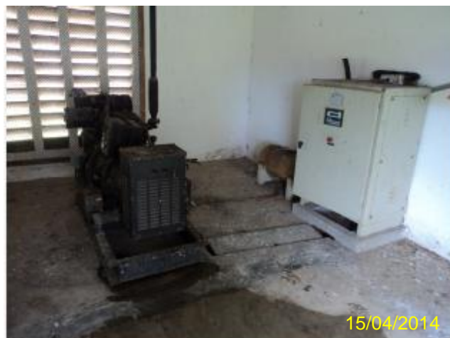
Foto 79 – EEE Bandeirantes: grupo gerador de energia parado devido a furto de fios necessários ao seu funcionamento.
