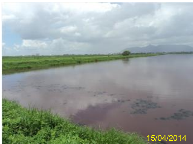
Foto 197 – ETE SIDI: Lagoa de Maturação 3 – crescimento de vegetação nos taludes.
