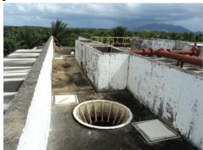
Foto 163 – ETE Pajuçara: DAFA 2 – vista superior.
