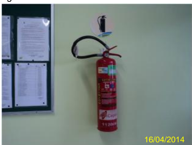
Foto 215 – Almoxarifado (Loja 1): extintor de incêndio.
