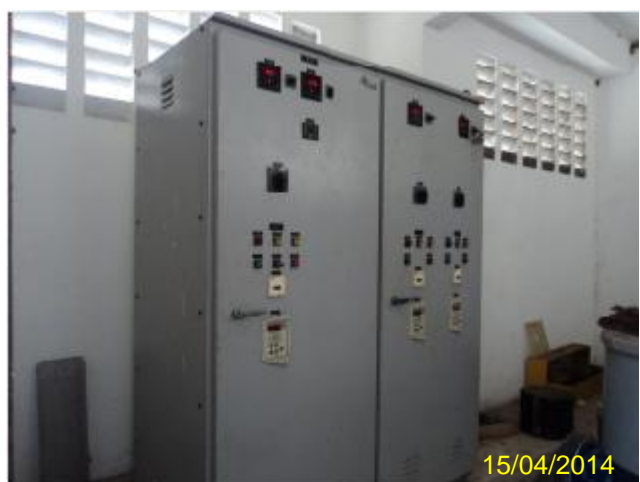
Foto 176 – ETE Pajuçara: quadro de comando.
