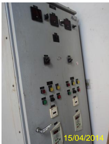
Foto 78 – EEE Bandeirantes: quadro de comando.
