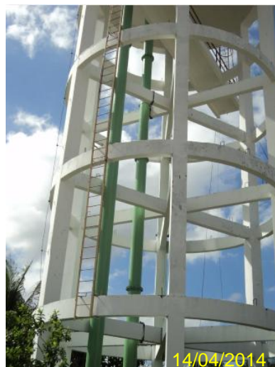
Foto 9 – REL-01: escada de acesso sem guarda-corpo.
