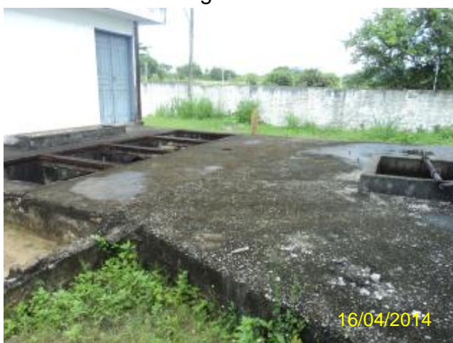
Foto 38 – EEE-01: poço de sucção sem tampa ou grade de proteção.
