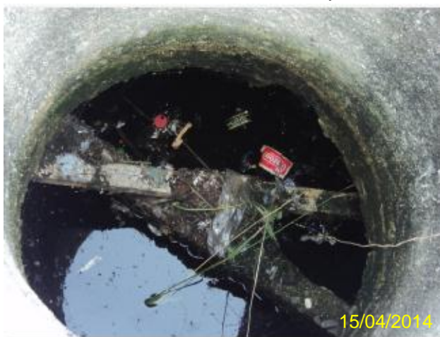
Foto 130 – ETE Nova Vida: vista interna da caixa de inspeção – necessitando de limpeza.
