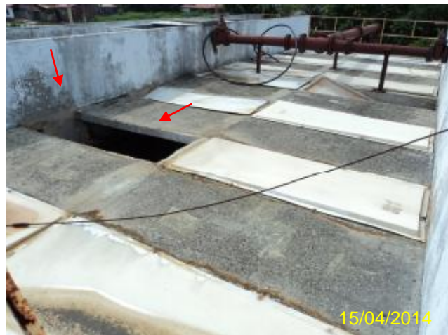
Foto 148 – ETE Pajuçara: DAFA 1 – ausência de tampa na calha coletora.
