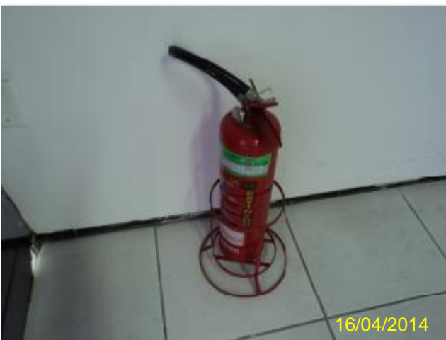
Foto 232 – Loja de atendimento 2: extintor de incêndio.
