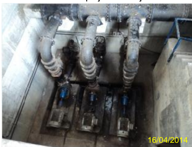
Foto 51 – EEE-02: conjunto moto-bomba.
