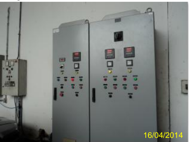
Foto 52 – EEE-02: quadro de comando.
