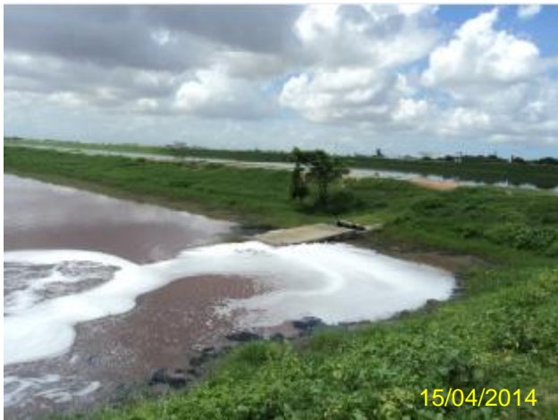
Foto 191 – ETE SIDI: Lagoa de Maturação 1 – chegada do esgoto.
