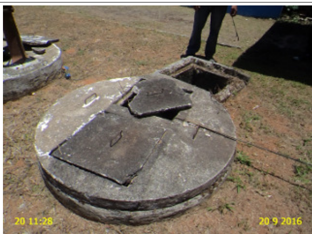
Foto 11 – EEE-01: tampas danificadas.
