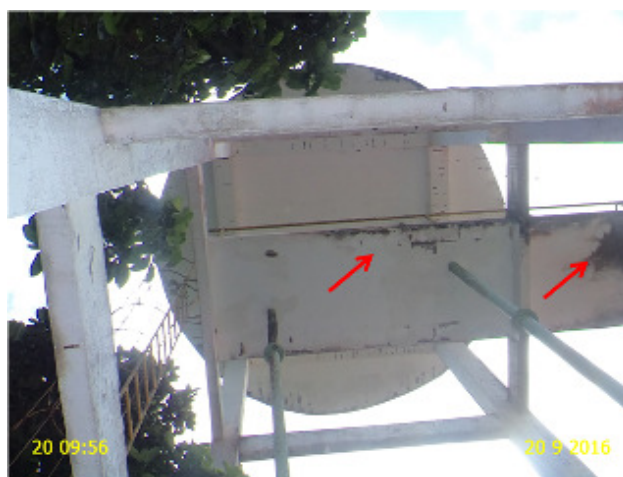
Foto 21 – REL-01: estrutura deteriorada com armadura exposta e sinais de extravasamento.
