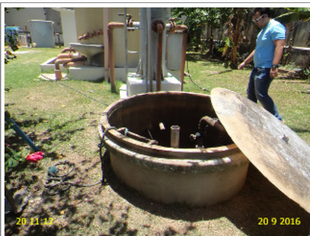
Foto 14 – EEE-02: ausência de identificação.
