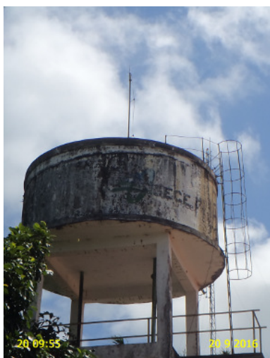
Foto 20 – REL-01: pintura deteriorada.
