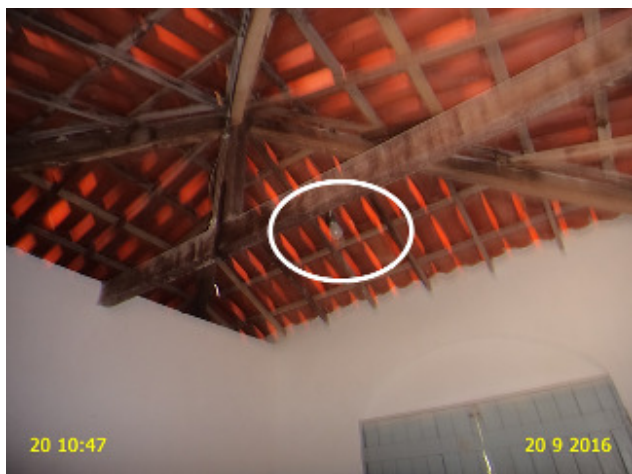
Foto 9 – ETE Forquilha: lâmpada da casa de apoio não ascende.
