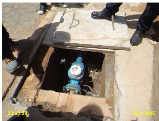
Foto 8 – PT-03: ausência de tampa de proteção no poço.
