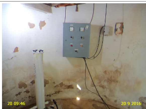
Foto 13 – PA-01: estrutura deteriorada
