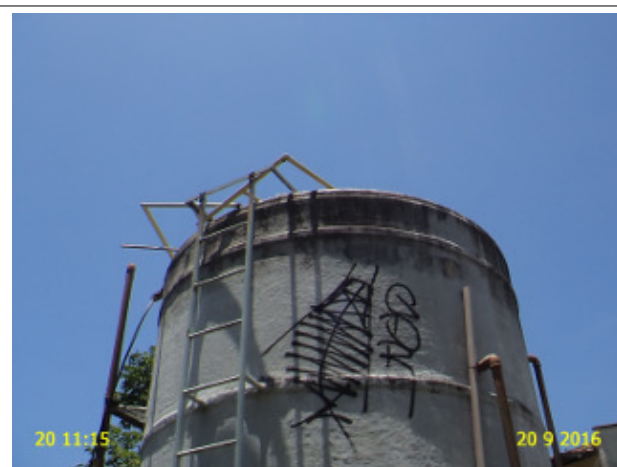
Foto 17 – ETE: filtro aeróbio com guarda-corpos danificado.
