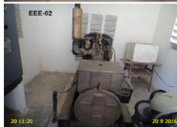
Foto 10 – EEE-01 / EEE-02: geradores sem funcionamento.
