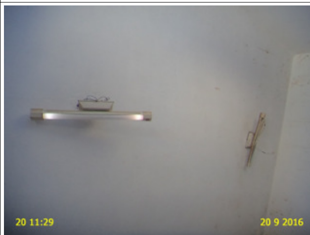
Foto 12 – EEE-01: lâmpada da casa de abrigo do gerador não ascende adequadamente.
