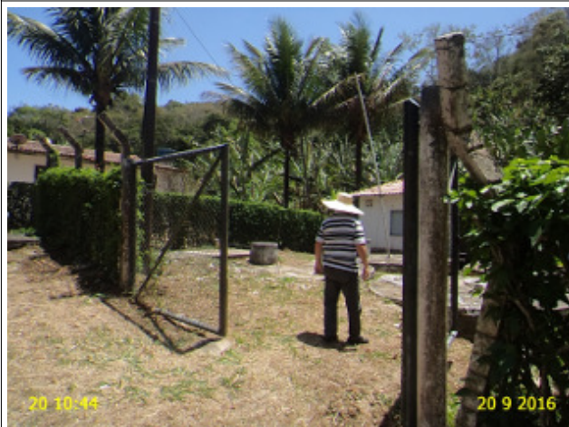
Foto 18 – ETE Forquilha: ausência de identificação.
