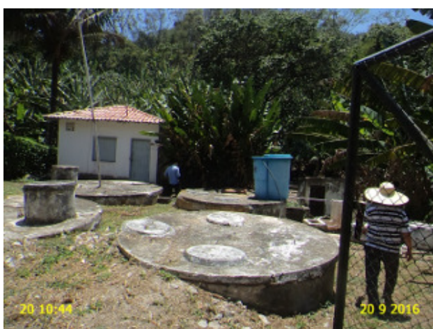
Foto 5 – ETE Forquilha: ausência de instalação para iluminação adequada.
