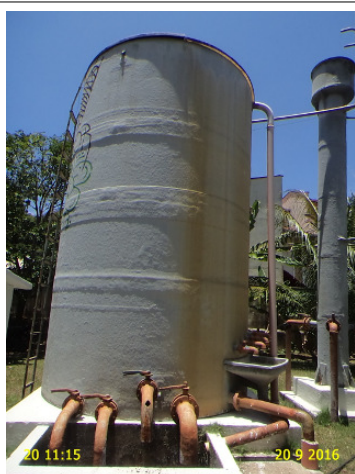
Foto 16 – ETE: filtro aeróbio sem identificação e sem funcionamento.
