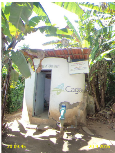
Foto 1 - PA-01: ausência de iluminação e estrutura deteriorada.
