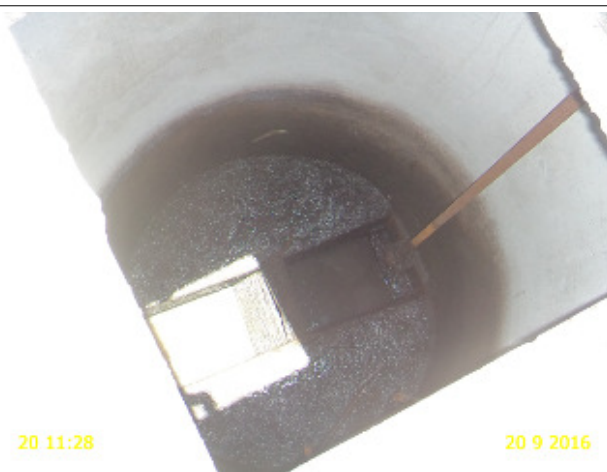
Foto 6 – EEE-01: ausência de bomba reserva.
