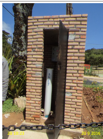
Foto 4 – PT-03: ausência de identificação e iluminação interna.
