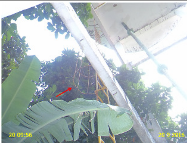
Foto 19 – REL-01: escada de acesso e guarda-corpos com corrosão.
