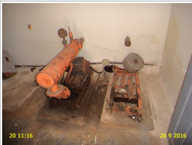
Foto 7 – EEE-02: ausência de bomba reserva no soprador.
