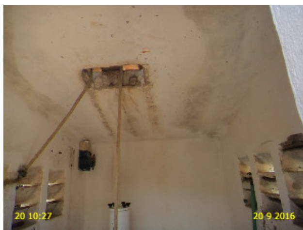
Foto 2 – PT-01: ausência de iluminação.
