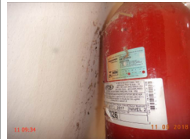
Foto 7 - O extintor de incêndio das elevatórias EEAT-01 e EELF-01 está com a recarga vencida.
