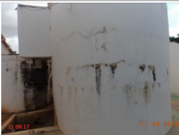
Foto 5 - O filtro F-01 está com a pintura deteriorada e apresenta sinais de infiltração
