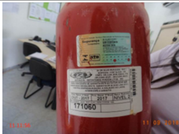
Foto 4 - O extintor de incêndio da Loja de Atendimento da Cagece está com a recarga vencida.
