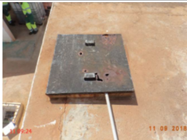
Foto 2 - A tampa de inspeção do reservatório RAP-01 está em processo de corrosão.
