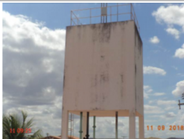
Foto 6 - O reservatório REL-01 está com a pintura deteriorada.
