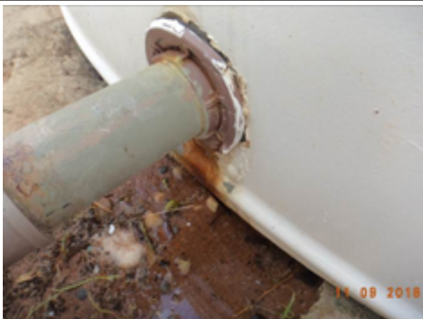
Foto 1 - Vazamento na interligação de saída do reservatório RAP-04.
