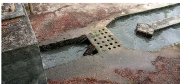
Foto 12 - ETE: O tratamento preliminar não tem grade de retenção e a caixa de areia está sem as comportas de controle/alteração de fluxo de uso nos trabalhos de operação e manutenção.
