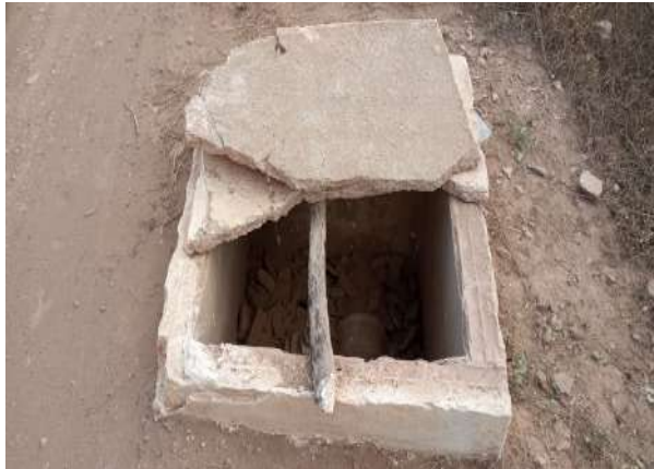
Foto 18 - Adutora bruta (Ubaúna): caixa de descarga com tampa quebrada
