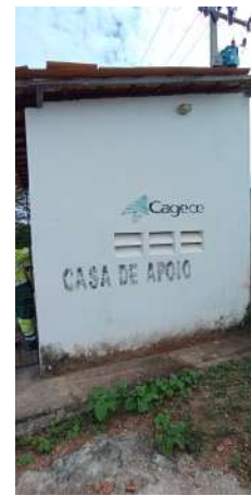
Foto 11 - ETE: Iluminação local defeituosa ou inadequada com lâmpadas queimadas e/ou em falta na casa de apoio.
