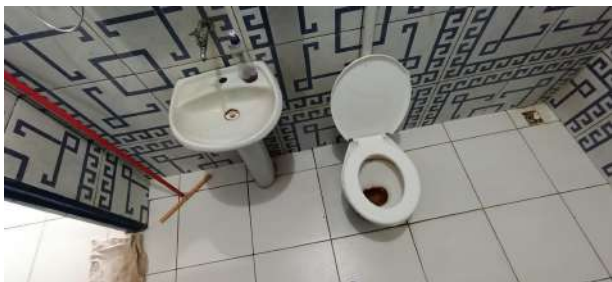
Foto 26 - Escritório (Ubaúna): Banheiro misto em condições inadequadas de manutenção e limpeza.
