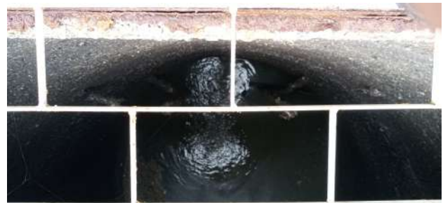
Foto 3 - EEE: Não existem dispositivos para retenção de sólidos grosseiros e areia na estação elevatória.
