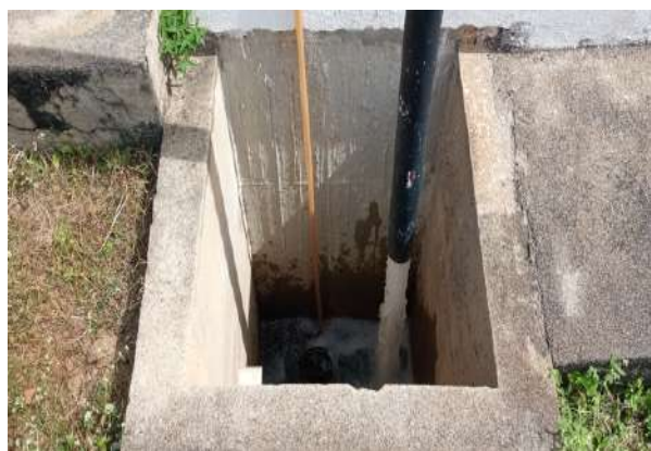
Foto 22 - RAP-02 (Ubaúna): sem controle de nível (ocorrência de extravasamento).
