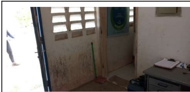
Foto 6 - EEE: Deterioração e/ou condições de manutenção e limpeza inadequadas da infraestrutura predial e demais áreas.
