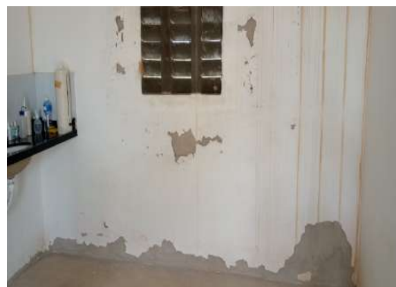
Foto 23 - ETA (Ubaúna): laboratório com revestimento da parede deteriorado.
