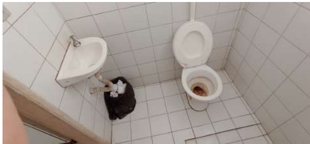
Foto 8 - EEE: condições de manutenção e limpeza inadequadas do banheiro.
