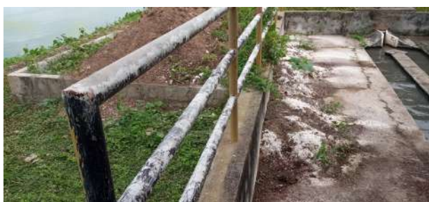
Foto 14 - ETE: tanque de secagem do tratamento preliminar está com material acima da capacidade.
