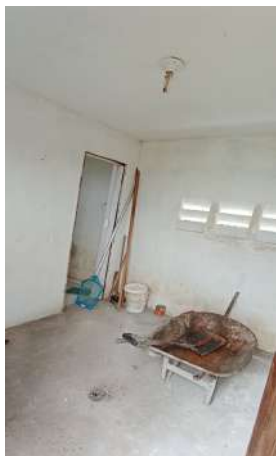
Foto 10 - ETE: Iluminação local defeituosa ou inadequada com lâmpadas queimadas e/ou em falta na casa de apoio.
