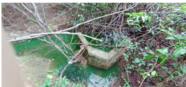
Foto 16 - ETE: Obstrução do ponto de lançamento do efluente por material de podas de árvores.
