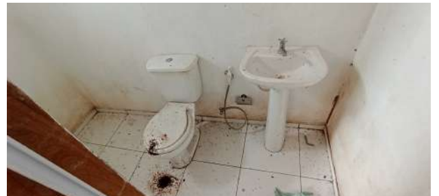
Foto 9 - ETE: condições de manutenção e limpeza inadequadas do banheiro, não há ligação de água no banheiro
