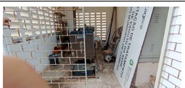
Foto 7 - EEE: Deterioração e/ou condições de manutenção e limpeza inadequadas da infraestrutura predial e demais áreas, e grupo gerador inoperante.
