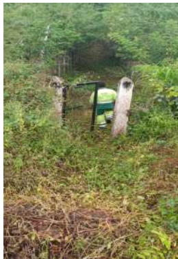
Foto 2 - RAP-02 (Sede): portão de acesso não fecha.
