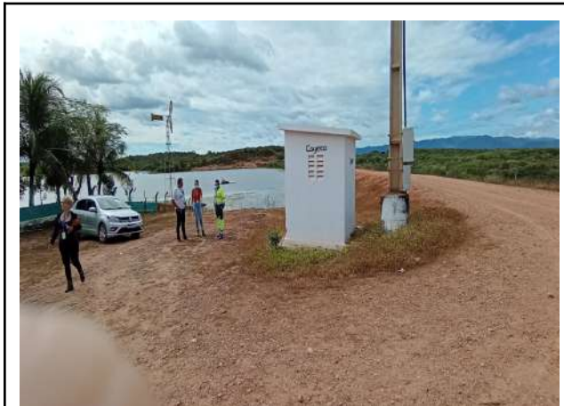
Foto 1 - Captação Ubaúna: instalações sem placa indicativa de área restrita ao abastecimento público.
