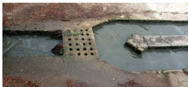
Foto 13 - ETE: O tratamento preliminar não tem grade de retenção e a caixa de areia está sem as comportas de controle/alteração de fluxo de uso nos trabalhos de operação e manutenção.
