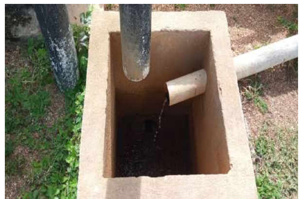
Foto 21 - Filtro Ubaúna: vazamento na descarga de lavagem.
