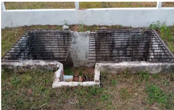
Foto 24 - ETA (Ubaúna): caixa macromedição com grade de proteção incompleta.
