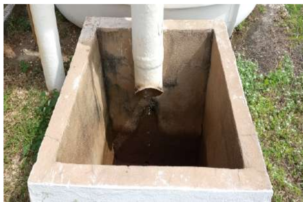
Foto 20 - Filtro Ubaúna: vazamento na descarga de lavagem.
