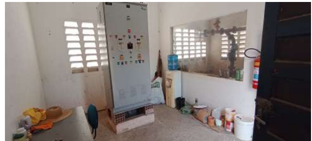
Foto 5 - EEE: Materiais armazenados de forma indevida e precária.
