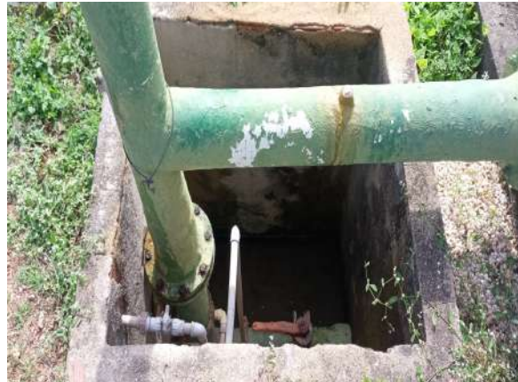
Foto 19 - ETA (Ubaúna): caixa da chegada de água bruta sem tampa ou grade de proteção.
