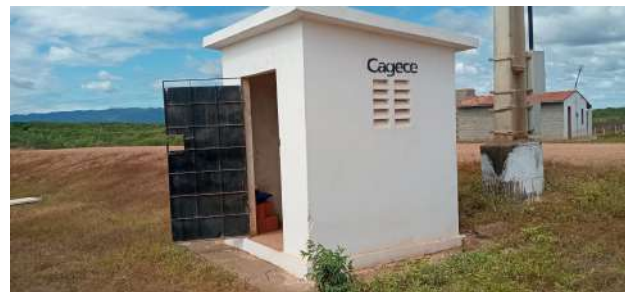
Foto 25 - Captação (Ubaúna): Casa do quadro de bombas sem iluminação interna e externa.
