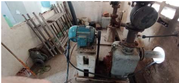
Foto 4 - EEE: Bomba reserva inoperante e deterioração da infraestrutura e material armazenado de forma indevida e precária.
