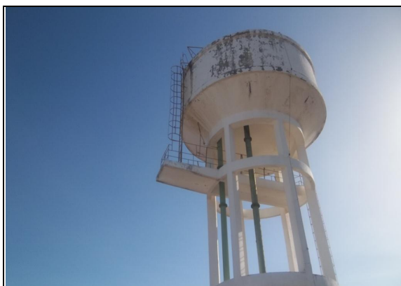
Foto 61 – REL-01: pintura deteriorada e ausência de guarda corpo na laje de cobertura.
