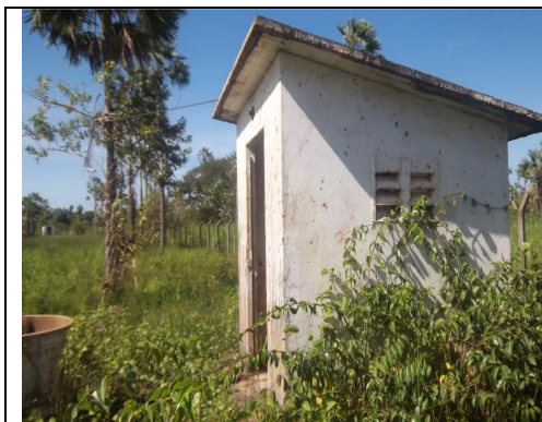
Foto 14 – PT-09: ausência de identificação.
