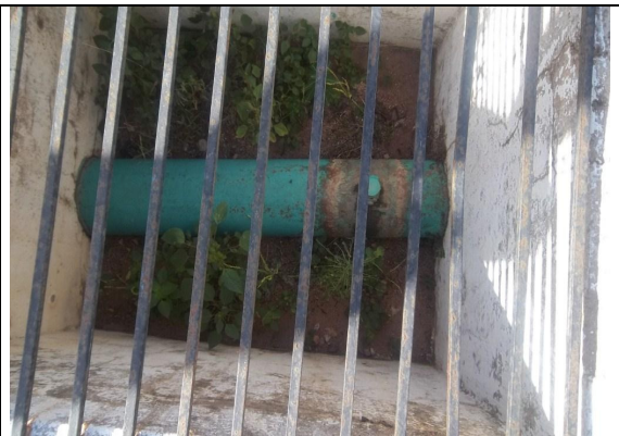
Foto 66 – Estação pitométrica na linha de ligação da EEAT-01 ao REL-01.
