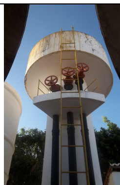
Foto 25 – Escada externa de acesso à torre de nível sem gaiola protetora.
