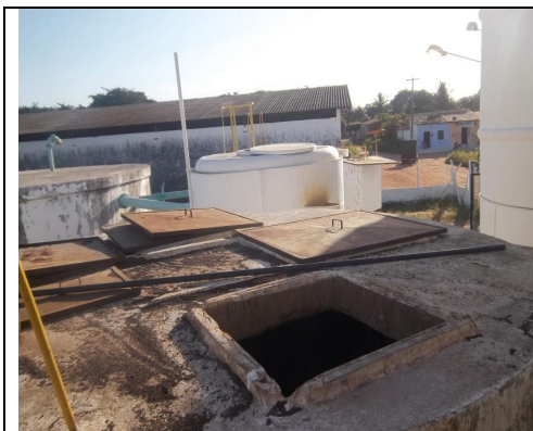
Foto 27 – Vista de cima das tampas dos filtros, deterioradas.
