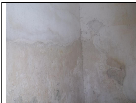
Foto 50 – EEAT-01: reboco e pintura deteriorados.
