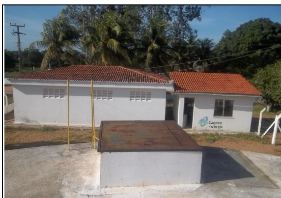
Foto 56 – RAP-02: tampa de inspeção com pintura deteriorada.
