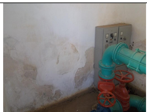
Foto 51 – EEAT-01: reboco e pintura deteriorados.
