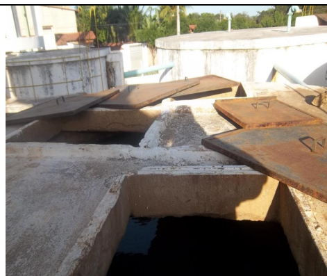
Foto 28 – Vista de cima das tampas dos filtros, deterioradas.
