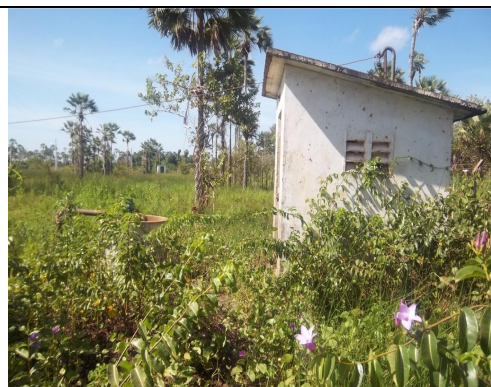
Foto 15 – PT-09: ausência de iluminação externa.
