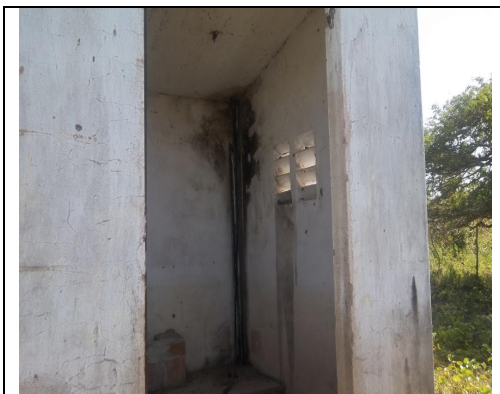
Foto 13 – PT-08: pintura deteriorada da casa de proteção do poço.
