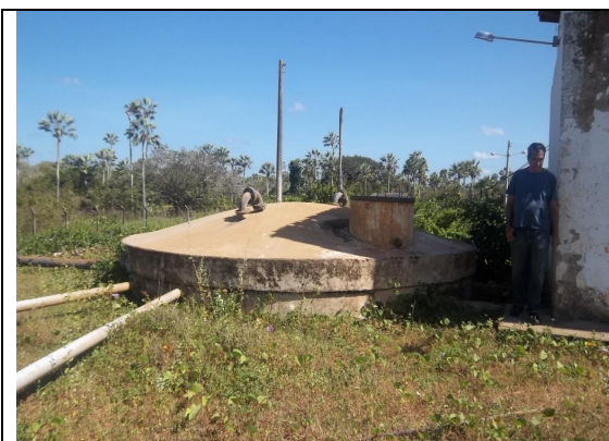
Foto 52 – RAP-01: pintura deteriorada.
