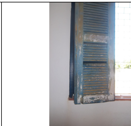
Foto 83 – Esquadria com pintura deteriorada.
