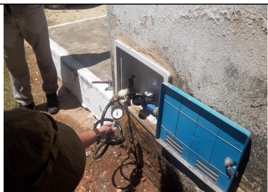
Foto 77 – RDA: medição de pressão no endereço Rua Nicolau Peixoto, 6 (SMS) - Areias.
