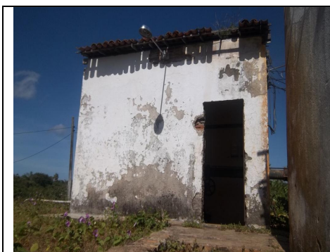
Foto 45 – EEAB-01: ausência de identificação, e casa de proteção com estrutura e pintura deterioradas, e sem porta.
