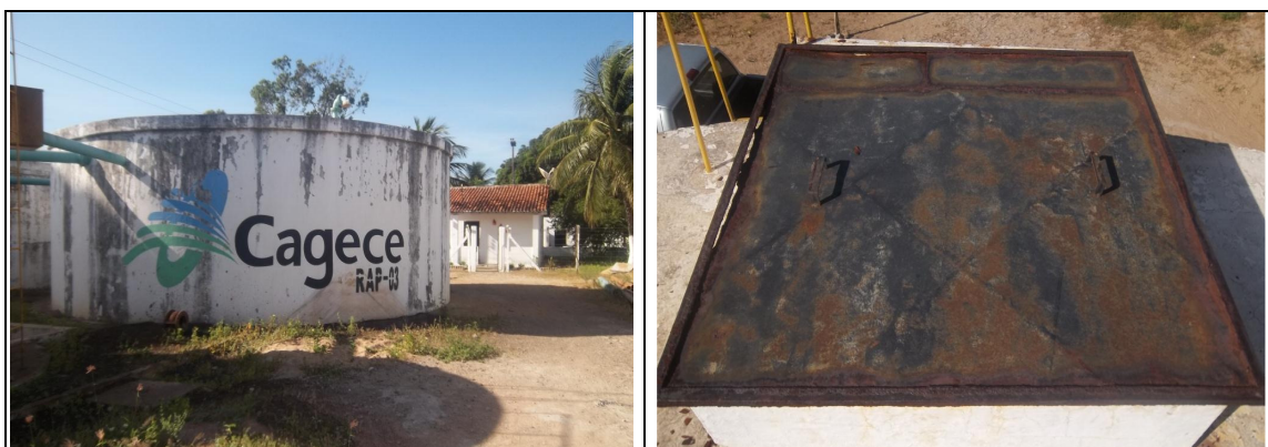
Foto 59 – RAP-04: identificação não coincidente com a do croqui e pintura deteriorada.
