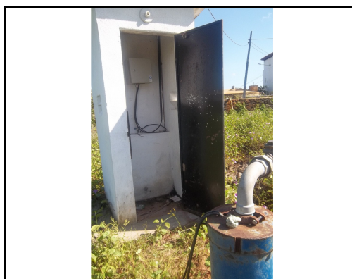
Foto 6 – PT-s/n (2º poço): ausência de horímetro.
