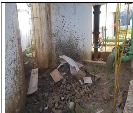
Foto 24 – Pátio externo da ETA em péssimas condições de limpeza.
