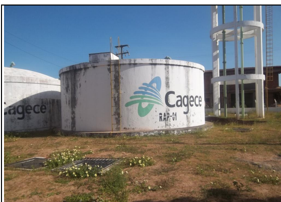
Foto 54 – RAP-02: identificação não coincidente com a do croqui e pintura deteriorada.
