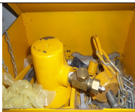
Foto 41 – Kit de emergência para cloro gasoso.
