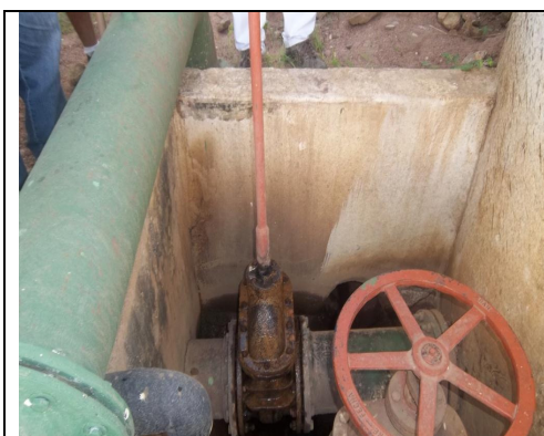
Foto 31 – Registro de lavagem do Filtro-3, com sinais de vazamento.
