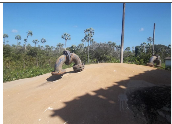
Foto 53 – RAP-01: tubulação de ventilação sem tela de proteção.
