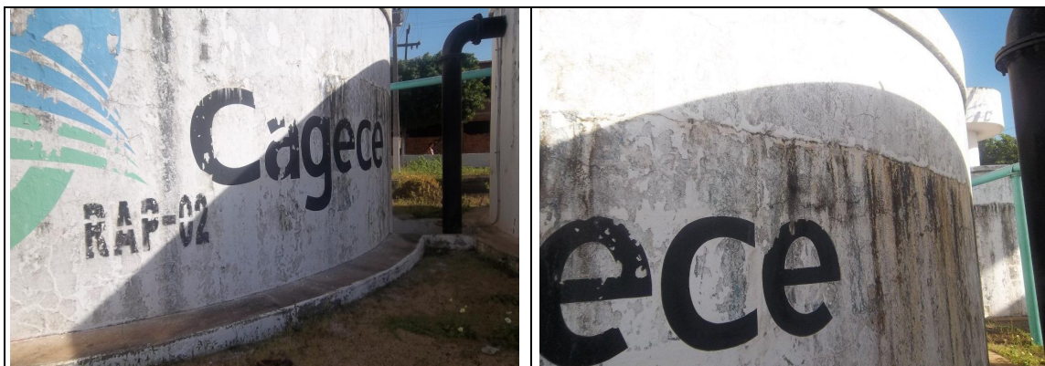
Foto 57 – RAP-03: identificação não coincidente com a do croqui e pintura deteriorada.
