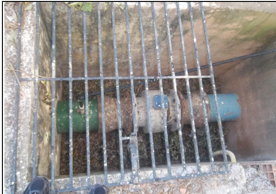
Foto 63 – Macromedidor na adutora de chegada da torre de nível sem parte da grade de proteção.
