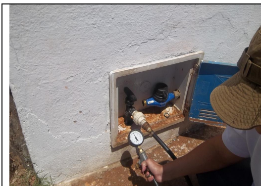
Foto 76 – RDA: medição de pressão no endereço Rua Francisco Romão – 51 (SMS) - Ipueiras.
