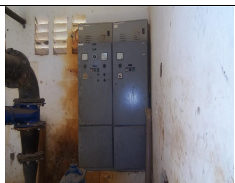
Foto 48 – EEAB-01: pintura do quadro de comando, deteriorada.
