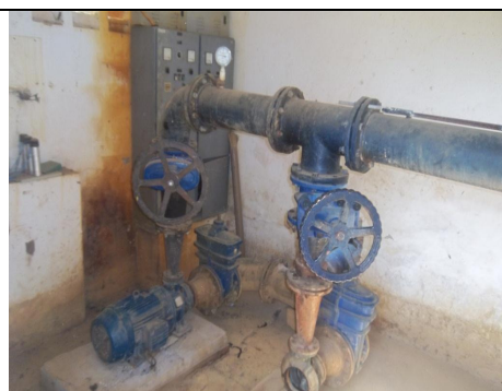
Foto 46 – EEAB-01: pintura do barrilete, deteriorada.
