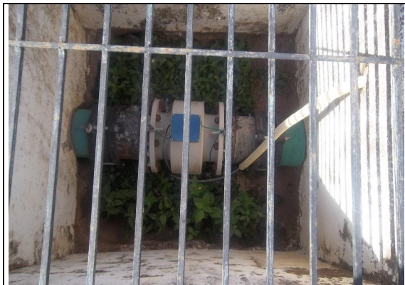
Foto 65 – Macromedidor na linha de ligação da EEAT-01 ao REL-01.
