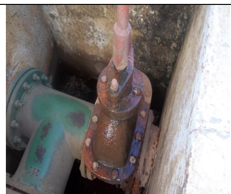
Foto 30 – Registro de lavagem do Filtro-1, com sinais de vazamento.
