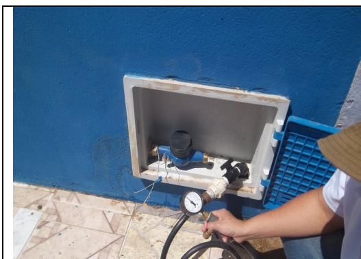
Foto 74 – RDA: medição de pressão no endereço Rua Santa Cruz, 44 (SMS) – Centro.
