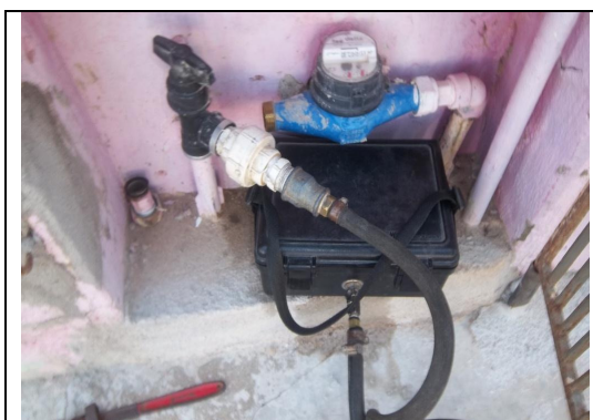
Foto 79 – RDA: medição de pressão contínua no endereço da Rua José Xerez de Sousa, 48 (SMS) – Córrego Grande.
