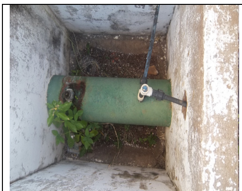
Foto 39 – Caixa da estação pitométrica, sem tampa, na tubulação de lavagem dos filtros.
