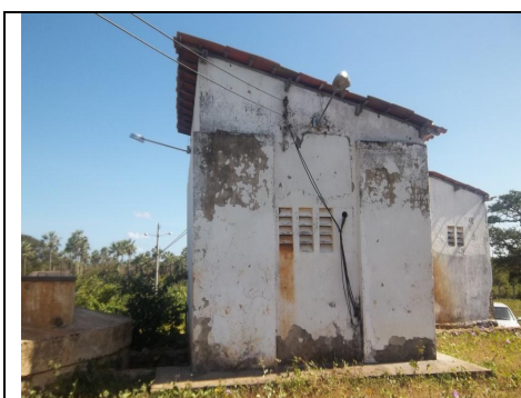
Foto 47 – EEAB-01: ausência de iluminação elétrica interna e externa.
