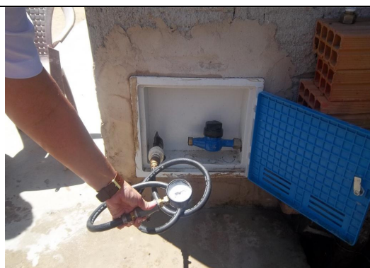
Foto 75 – RDA: medição de pressão no endereço Rua SDO 31, 12 (SMS) – Alto do Bode.
