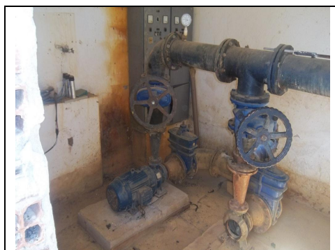
Foto 49 – EEAB-01: sem motor da bomba reserva.
