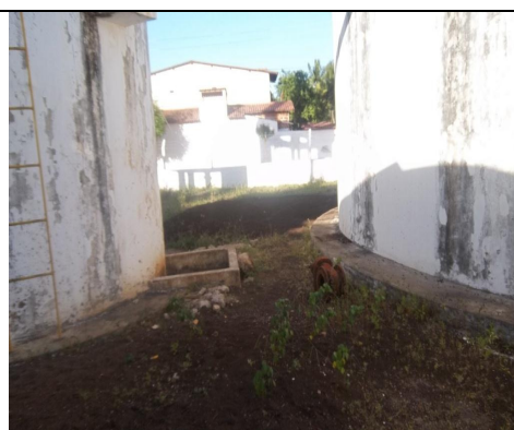
Foto 32 – Pintura deteriorada dos filtros.
