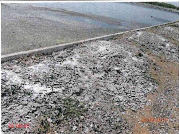
Foto 30 – Lagoa Facultativa (Sede): acúmulo de sobrenadantes nos diques.
