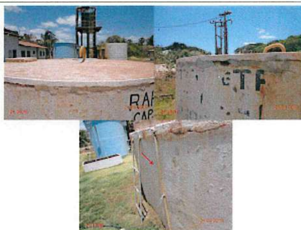
Foto 8 – RAP-01 (Cumbe): ausência de tela na tubulação de ventilação, mangueira de nível opaca, pintura e estrutura deterioradas.
