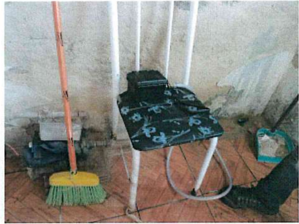
Foto 2 – RDA (Sede): pressão datalogger fora da faixa de 10 a 50 mca na Travessa Paulo Ney, 73.
