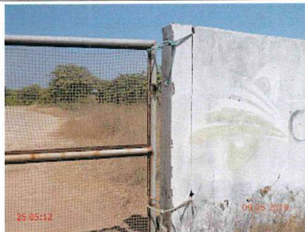
Foto 55 – ETE (Canoa Quebrada): Portão danificado e em processo de corrosão.
