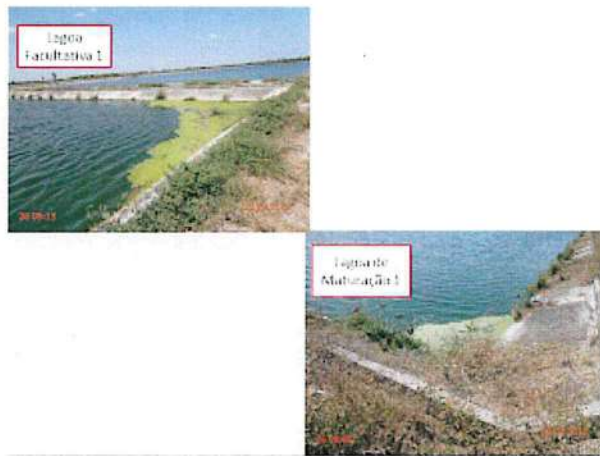
Foto 51 – ETE (Sede): acúmulo de sobrenadantes na superfície das lagoas.
