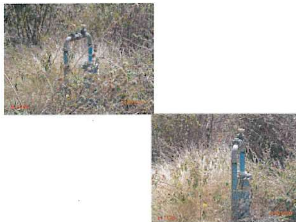
Foto 16 – PT-04 (Alto da cheia): vazamento na luva de união, ausência de identificação, laje e tampa.
