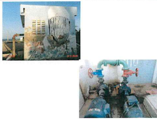
Foto 43 – EEAT-01 (Canoa Quebrada): ausência de identificação e pintura deteriorada.
