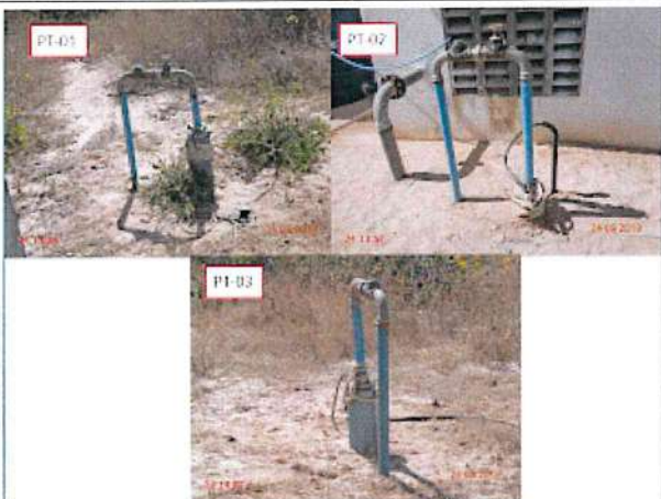
Foto 15 – Poços PT-01, PT-02 e PT-03 (Alto da cheia): ausência de identificação, laje e tampa.
