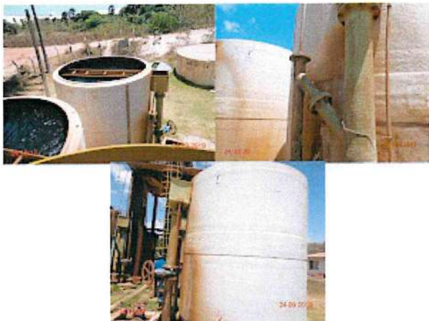
Foto 9 – F-01 (Cumbe): pintura deteriorada, extravasamento, ausência de identificação, escada e de tampa na calha.
