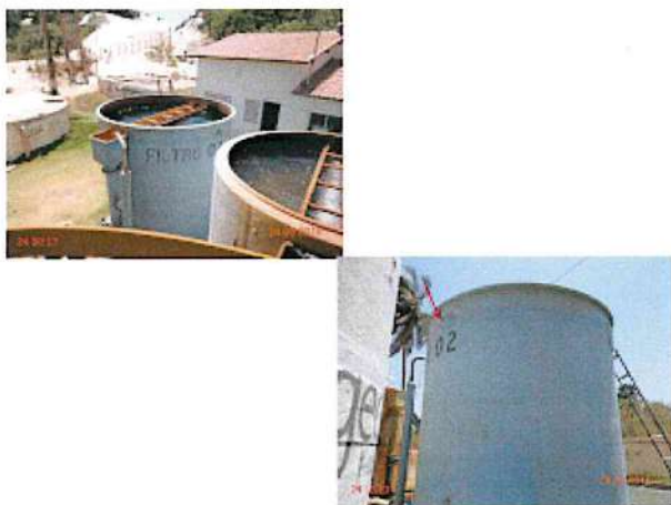
Foto 13 – F-06 (Cumbe): ausência de tampa e identificação incorreta.
