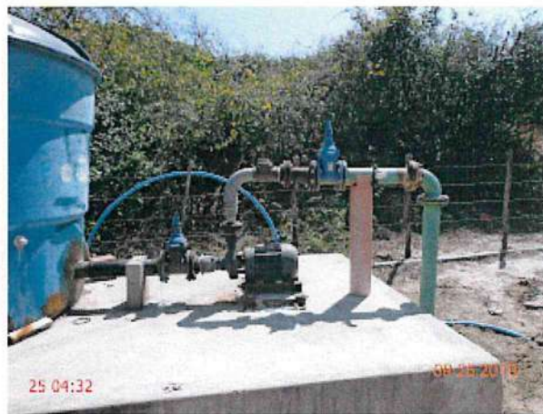
Foto 14 – EEAT-02 (Canoa Quebrada): ausência de identificação e bomba reserva.
