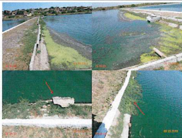
Foto 53 – lagoa facultativa (Canoa Quebrada): placas danificadas e presença de sobrenadantes.
