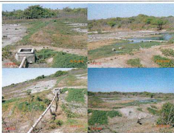
Foto 76 – Vala de infiltração (Canoa Quebrada): canos quebrados e caixa de passagem sem tampa.
