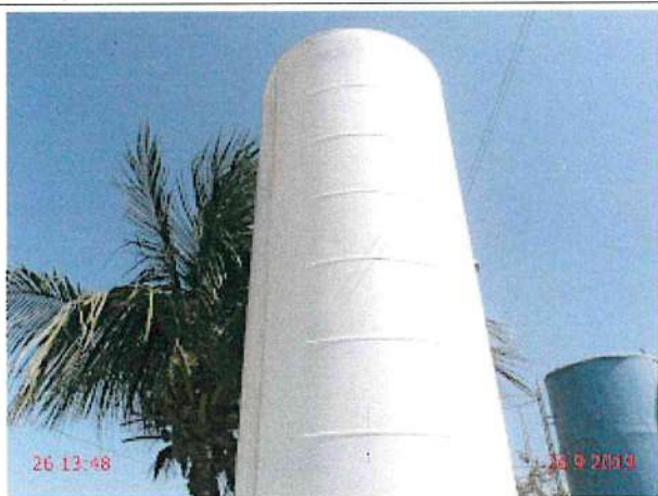
Foto 34 – Flocodecantador (Tabuleiro do Cabreiro): ausência de identificação.
