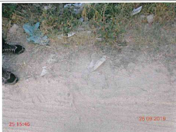
Foto 40 – RDA (Sede): registro de descarga soterrado na Rua Irmã Núbia Alves.
