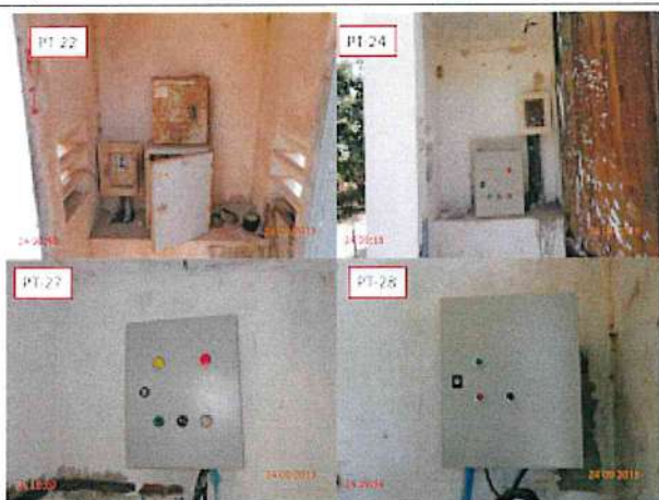
Foto 11 – Poços PT-22, PT-24, PT-27 e PT-28 (Cumbe): ausência de horímetro no quadro de comando.
