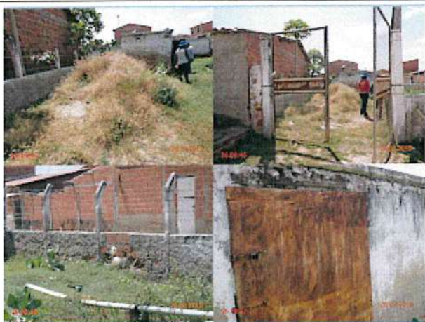
Foto 32 – EEE Vila São Rafael (Sede): vegetação excessiva, pintura deteriorada, ausência de identificação, cerca, muro e portão de acesso danificados.
