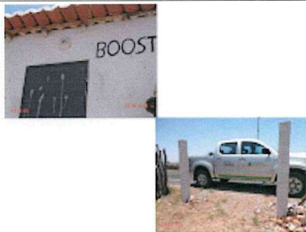
Foto 35 – EERD-04 Canaveira (Cumbe): ausência de portão e iluminação.
