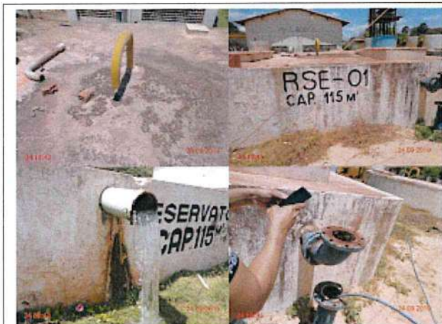
Foto 28 – RSE-01 (Cumbe): ausência de tela na tubulação de ventilação, tubulação inadequada, pintura e estruturas deterioradas e reservatório extravasando.
