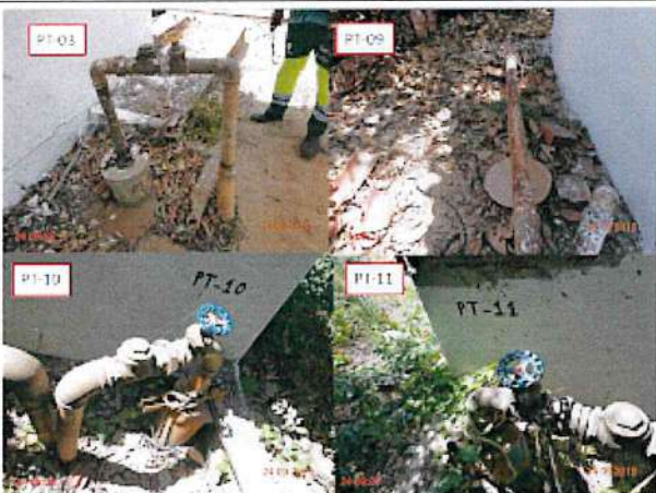
Foto 17 – PT-03, PT-09, PT-10 e PT-11 (Cumbe): ausência de laje.
