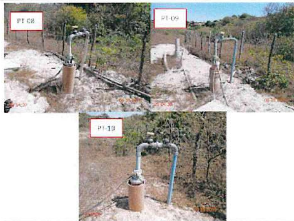
Foto 24 – Poços PT-08, PT-09, PT-10 (Canoa Quebrada): ausência de laje e tampa.
