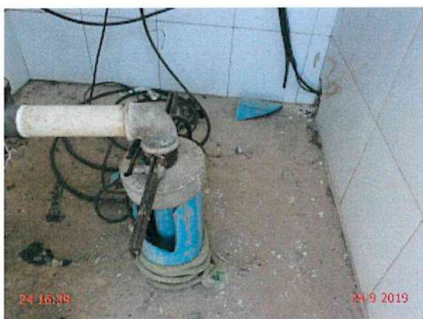
Foto 62 – Poço PT-03 (Canoa Quebrada): tubulação de proteção quebrada.
