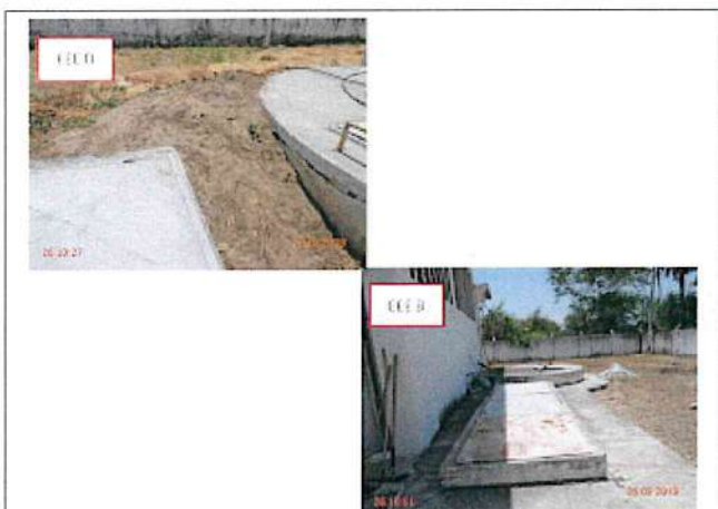
Foto 5 – EEE-D e EEE-B (Sede): ausência de leito de secagem.
