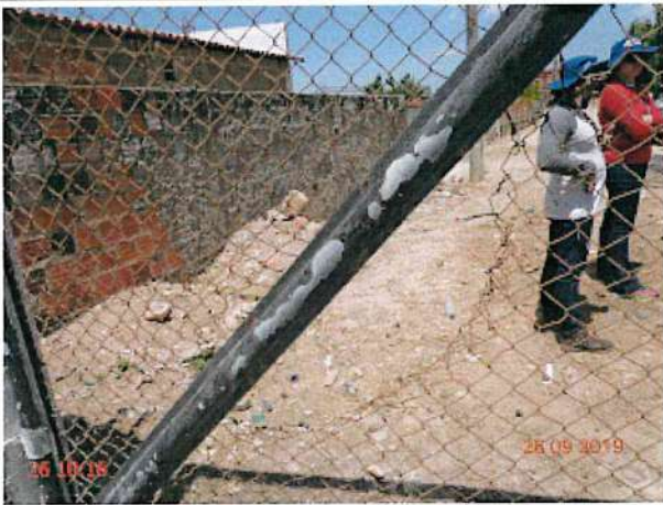
Foto 66 – EEE Tabajara (Sede): portão danificado.
