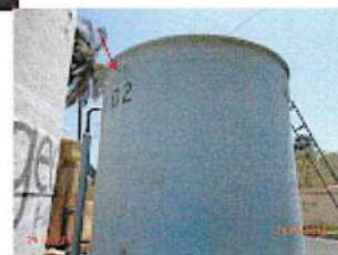
Foto 63 - F-06 (Cumbe): ausência de tampa e identificação incorreta.
