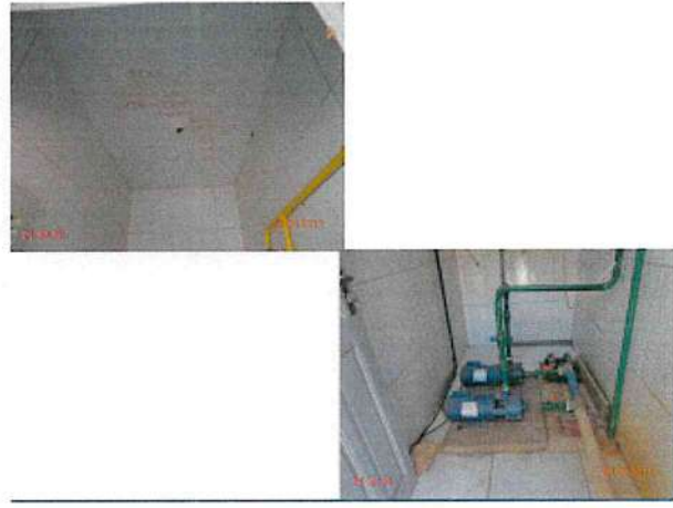
Foto 47 – Casa de cloro (Cumbe): ausência de iluminação e bomba reserva com defeito.
