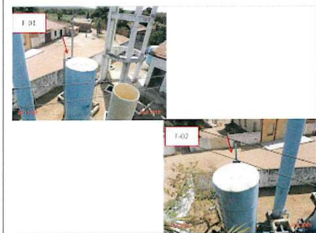
Foto 46 – F-01 e F-02 (Tabuleiro do cabreiro): Calhas sem tampa.
