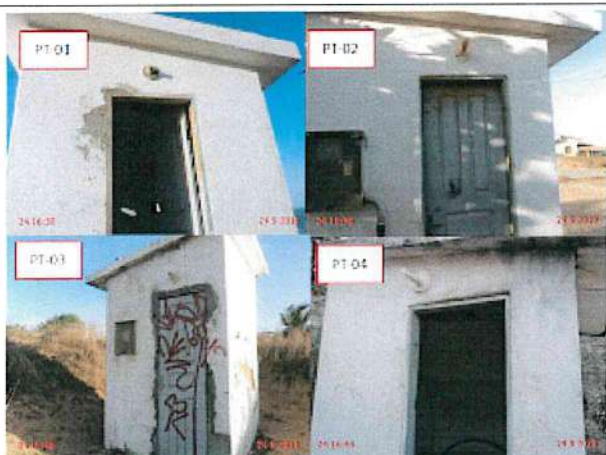
Foto 56 – Poços PT-01, PT-02, PT-03 e PT-04 (Canoa Quebrada): ausência de identificação.
