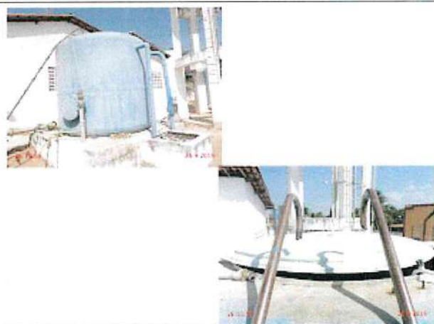
Foto 29 – RAP-01 (Tabuleiro do Cabreiro): ausência de identificação, tampa não garante vedação, escada solta e em processo de corrosão.
