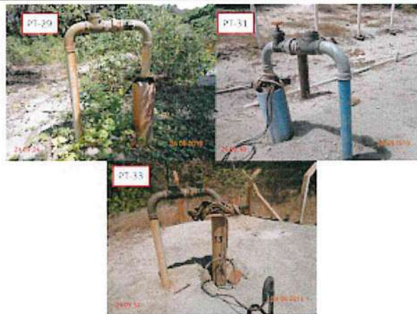
Foto 18 – PT-29, PT-31 e PT-33 (Cumbe): ausência de laje.
