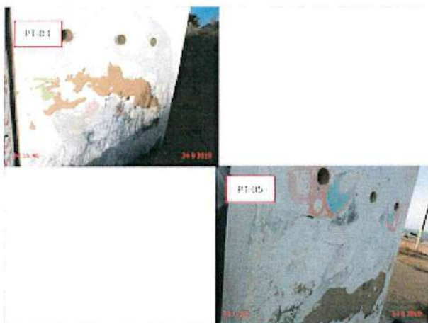
Foto 50 – Poços PT-03 e PT-05 (Canoa Quebrada): Pintura deteriorada.
