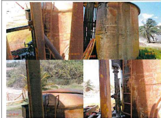
Foto 44 – F-03 (Cumbe): pintura deteriorada, extravasamento, ausência de identificação, tampas na calha e na abertura de inspeção.
