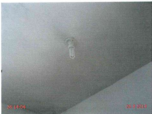
Foto 36 – EEAT-01 (Tabueliro o Cabreiro): lâmpada queimada.
