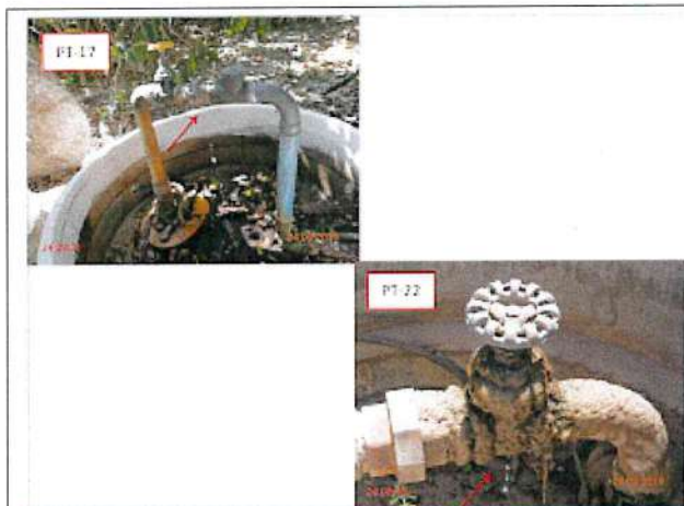
Foto 60 – Poços PT-17 e PT-22 (Cumbe): vazamento na luva de união.
