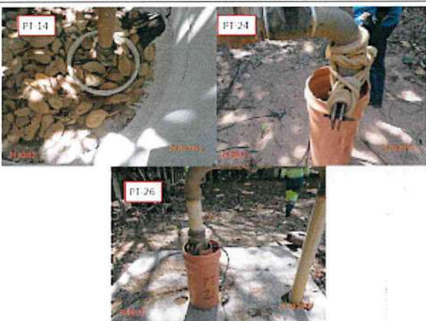
Foto 19 – PT-14, PT-24 e PT-26 (Cumbe): ausência de tampa.
