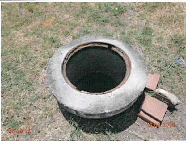
Foto 68 – EEE Tabajara (Sede): ausência de tampa no poço de visita.
