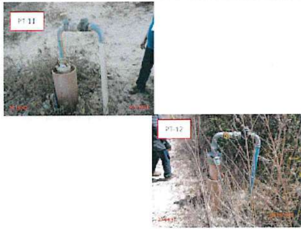
Foto 22 – Poços PT-11 e PT-12 (Canoa Quebrada): ausência de identificação, laje e tampa.
