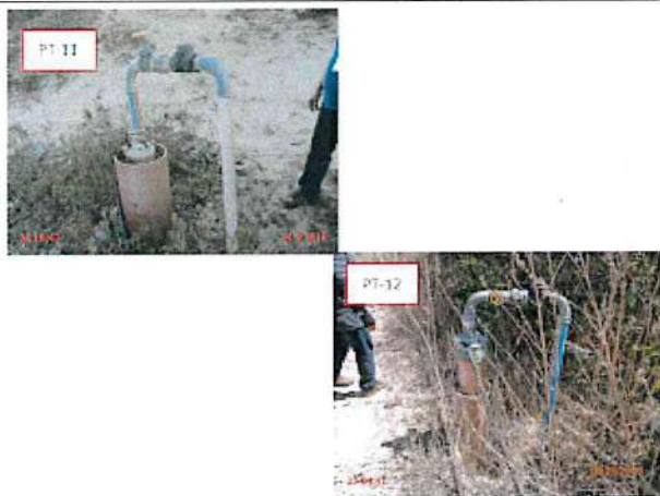
Foto 25 – Poços PT-11 e PT-12 (Canoa Quebrada): ausência de tampas.
