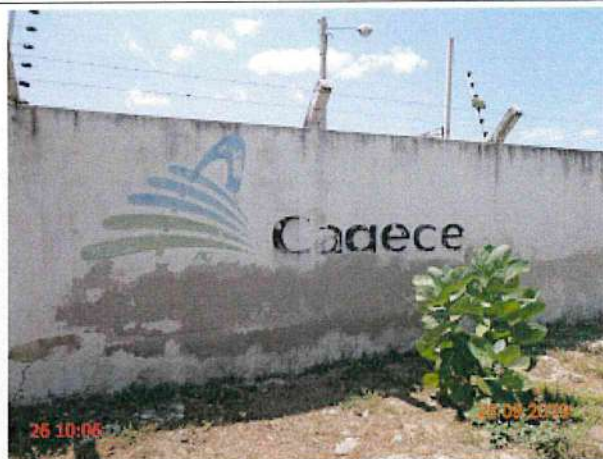
Foto 31 – EEE – G (Sede): ausência de identificação e pintura deteriorada.
