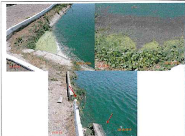
Foto 54 – Lagoa de Maturação (Canoa Quebrada): placas danificadas e presença de sobrenadantes.
