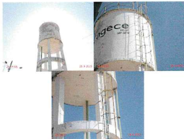
Foto 37 – REL-01 (Tabuleiro do Cabreiro): pintura deteriorada e guarda-corpo em processo de corrosão.
