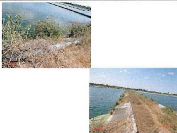
Foto 52 – Lagoa de Maturação (Sede): excesso de vegetação nos diques.
