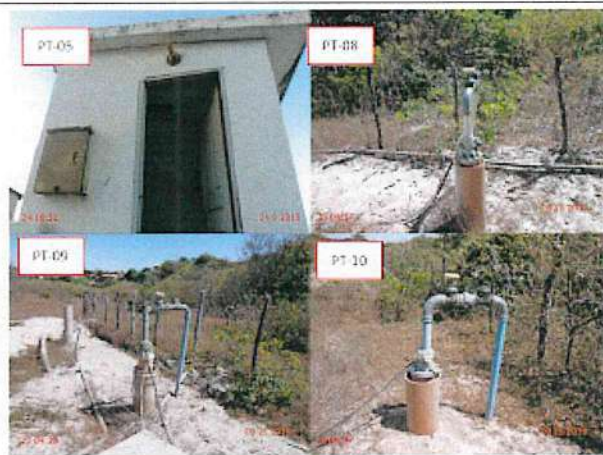
Foto 57 – Poços PT-05, PT-08, PT-09 e PT-10 (Canoa Quebrada): ausência de identificação.
