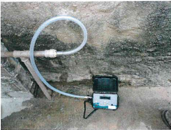
Foto 1 – RDA (Sede): pressão datalogger fora da faixa de 10 a 50 mca na Rua Dragão do Mar, 1439.
