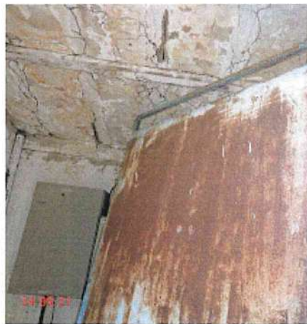
Foto 49 – PT-19 (Cumbe): portão da casa de abrigo quebrado.
