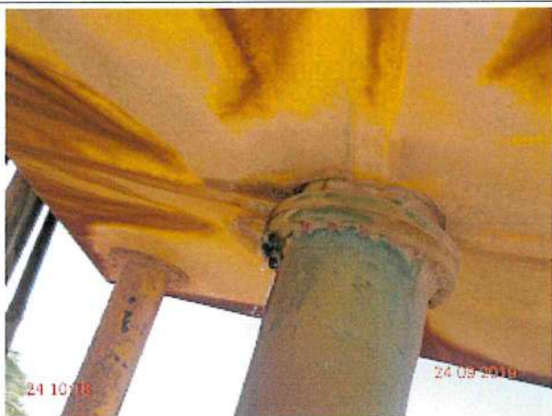
Foto 64 – Aerador (Cumbe): vazamento na tubulação.
