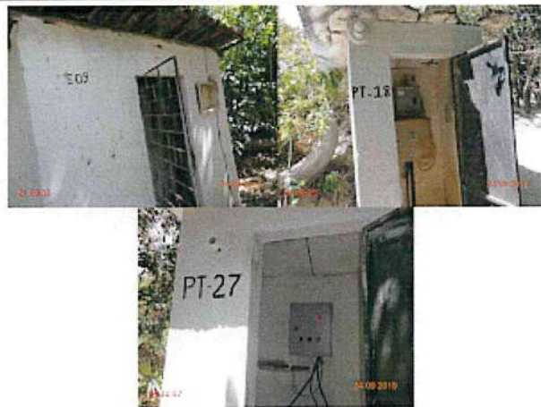
Foto 26 – Poços EE-09, PT-18 e PT-27 (Cumbe): ausência de iluminação.
