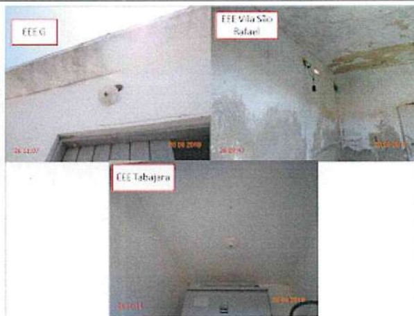
Foto 65 – EEE G, EEE – Vila São Rafael e EEE-Tabajara (Sede): ausência de iluminação.
