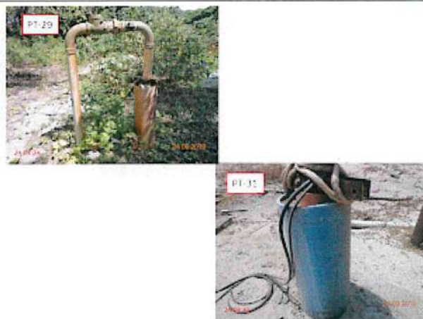
Foto 20 – PT-29 e PT-31 (Cumbe): ausência de tampa.
