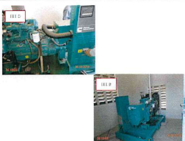
Foto 33 – EEE-D e EEE-B (Sede): grupo gerador de energia com defeito.
