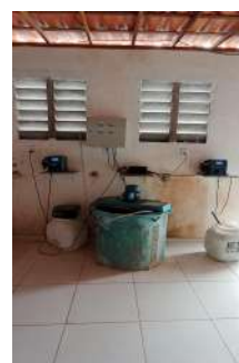
Foto 10 - ETA de Moraújo - Bomba dosadora sobre base improvisada (bambona).
