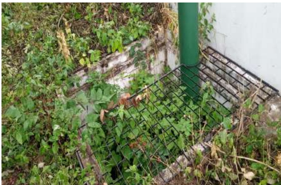
Foto 21 - RAP-02 (Várzea da Volta): caixa com grade incompleta e tomada pela vegetação.
