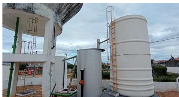
Foto 12 - ETA de Moraújo - Instalações sem identificação.
