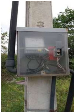
Foto 15 - Captação: Quadro Enel com chave elétrica desprotegida e acessível.
