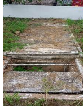
Foto 20 - REL-01 (Várzea da Volta): caixa sem tampa.
