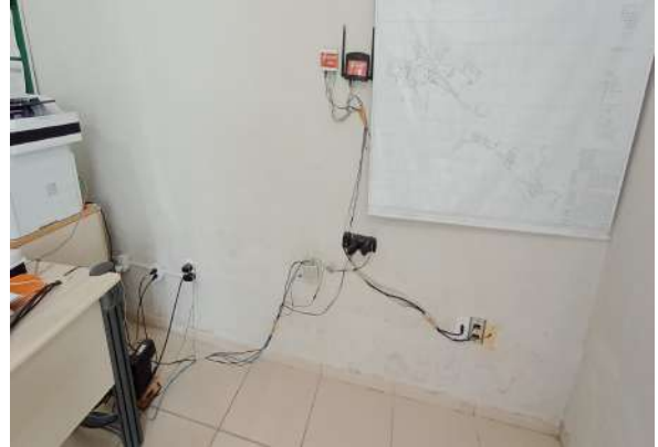
Foto 14 - Escritório de Moraújo - Instalações elétricas inadequadas.
