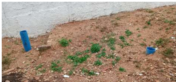
Foto 5 - ETA de Moraújo - Registros sem caixa de proteção.
