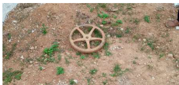
Foto 4 - ETA de Moraújo - Registro sem caixa de proteção.
