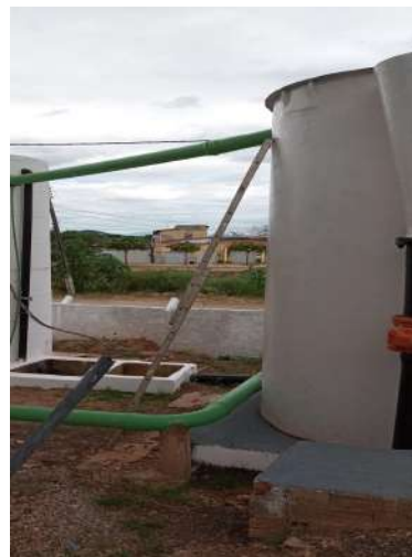
Foto 8 - ETA de Moraújo - Filtro com escada inadequada.
