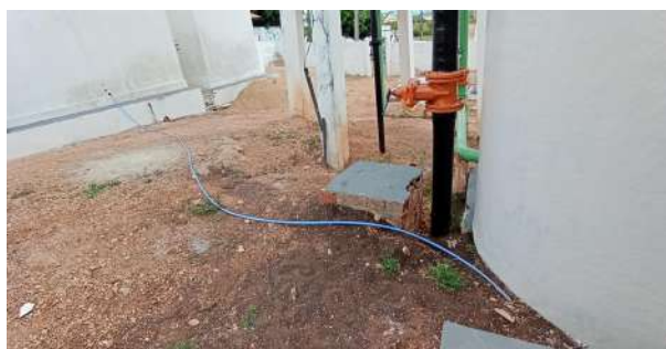
Foto 11 - ETA de Moraújo - Tubulação de polímero.
