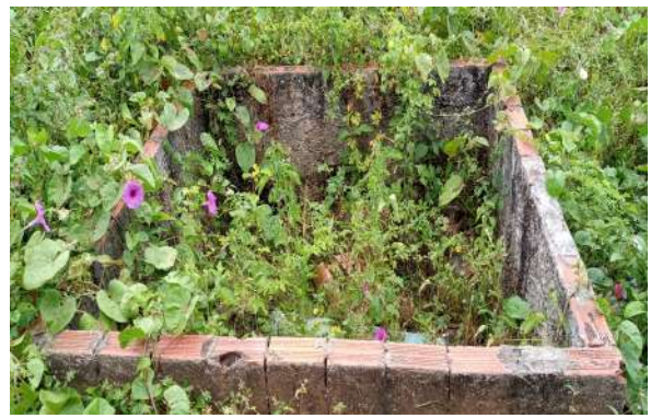
Foto 18 - Adutora (Várzea da Volta): caixa sem tampa na adutora de água bruta.
