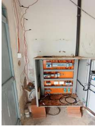
Foto 13 - ETA de Moraújo - Quadro de comando com instalações inadequadas.
