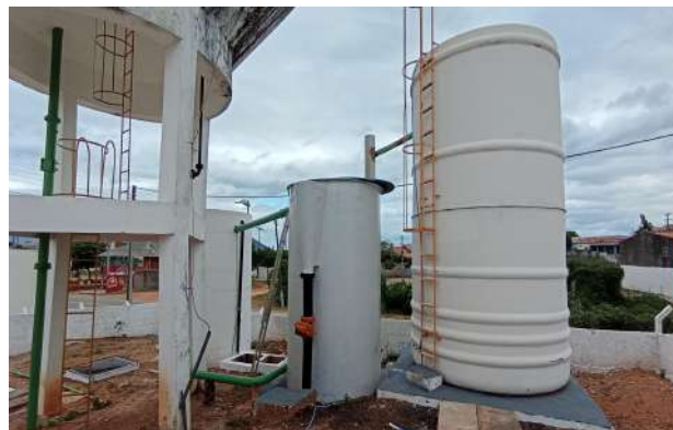
Foto 24 - ETA de Moraújo - Área do pátio das instalações sem pavimentação.
