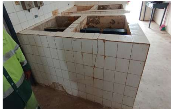
Foto 16 - ETA (Várzea da Volta): tanques da casa de química deteriorados e/ou condições de manutenção e limpeza inadequadas.
