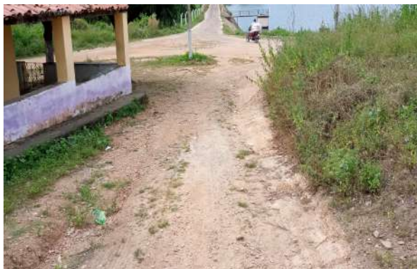
Foto 17 - Adutora (Várzea da Volta): tubulação exposta na adutora de água tratada.
