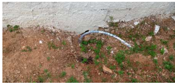
Foto 6 - ETA de Moraújo - Aplicação do PAC sem caixa de proteção.
