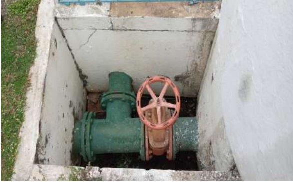
Foto 19 - ETA (Várzea da Volta): caixa registro da entrada do filtro sem tampa.
