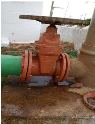
Foto 7 - ETA de Moraújo - Registros com vazamento.
