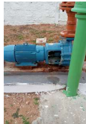
Foto 23 - ETA de Moraújo - Bomba elevatória instalada sem abrigo de proteção.
