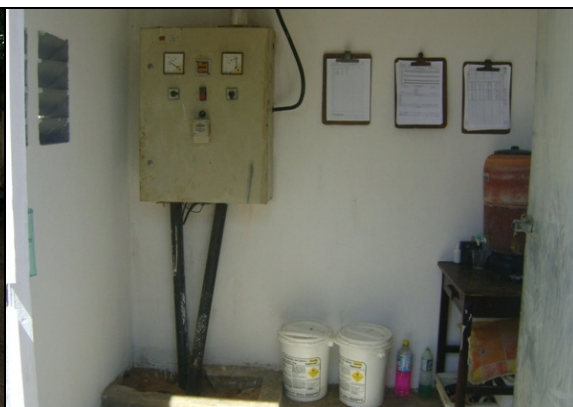
Foto 19 – Quadro de comando da EEPT-07.
