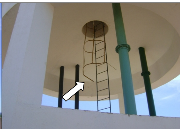
Foto 45 – Gaiola protetora da escada de acesso do REL-03, não fixada.
