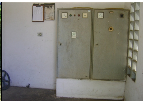
Foto 2 – Quadro de comando da EEPT-01.
