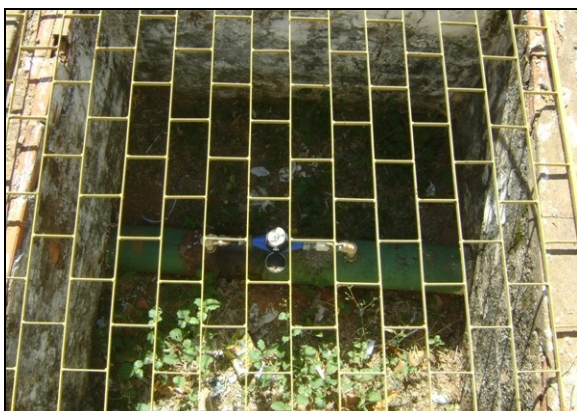
Foto 49 – Medidor proporcional de água bruta na saída do PT-01.
