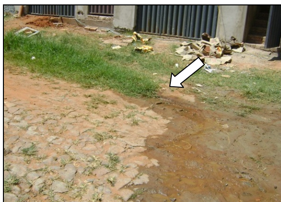
Foto 65 – Vazamento na rede de distribuição, localizado na Rua Antônio Francisco Magalhães, Alto da Alegria.
