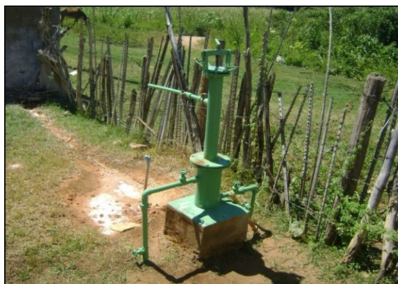
Foto 24 – Clorador de pastilhas do PT-09.
