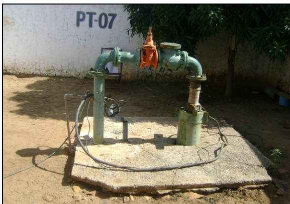
Foto 18 – Vista do poço tubular PT-07.
