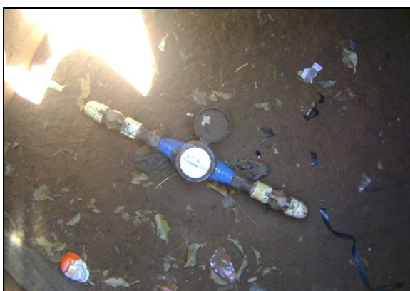
Foto 53 – Medidor proporcional de água tratada na saída do PT-06.
