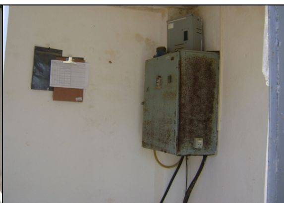
Foto 12 – Quadro de comando da EEPT-05.
