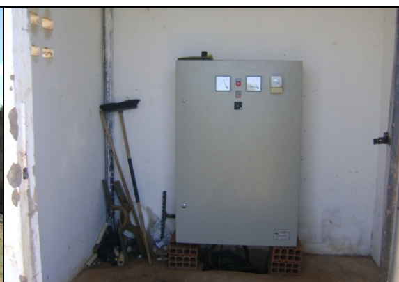
Foto 23 – Quadro de comando da EEPT-09.
