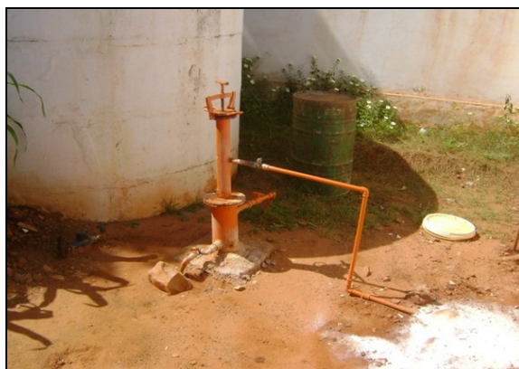
Foto 10 – Clorador de pastilhas da EEPT-04.
