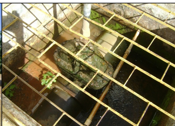
Foto 32 – Vazamento no registro da tubulação de entrada do RSE-01.
