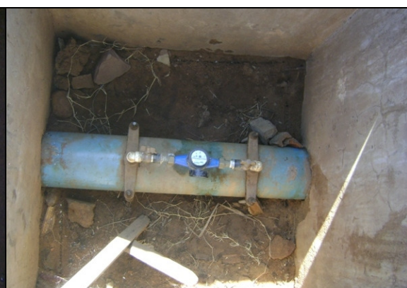
Foto 54 – Medidor proporcional de água tratada na saída do PT-07.
