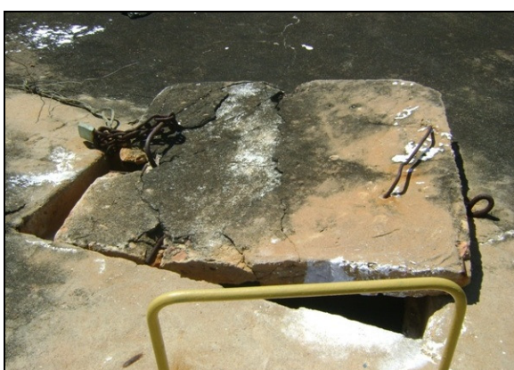
Foto 39 – Tampa de inspeção do REL-01, danificada.
