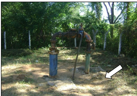
Foto 1 – Poço tubular PT-01, com sua laje de proteção parcialmente enterrada.
