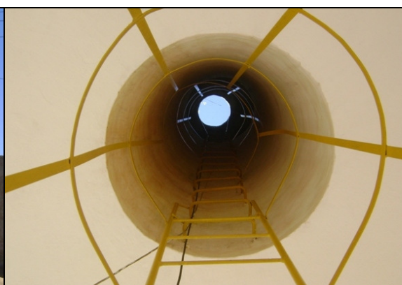
Foto 43 – Ausência de tampa de proteção no REL-02.
