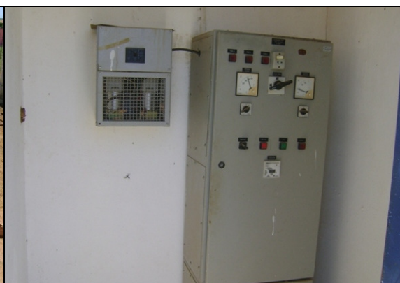
Foto 15 – Quadro de comando da EEPT-06.
