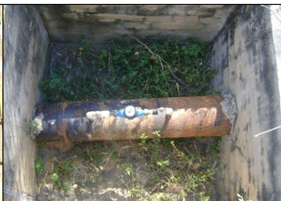
Foto 50 – Caixa do medidor proporcional de água bruta, sem tampa de proteção, na saída do PT-02.
