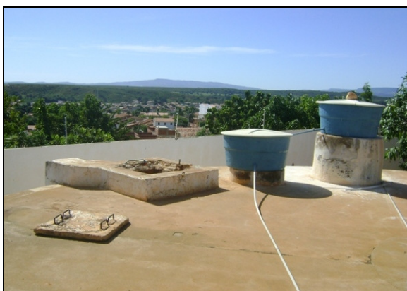
Foto 31 – Tampa de inspeção e dosador de hypocal do RSE-01.
