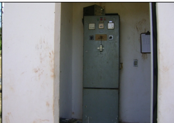
Foto 5 – Quadro de comando da EEPT-02.
