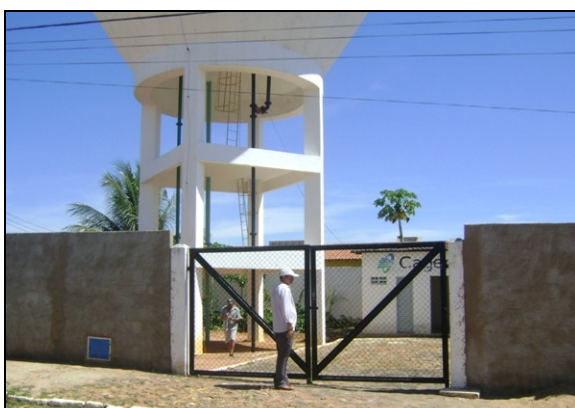
Foto 42 – Muro de proteção do REL-02, com pintura deteriorada.
