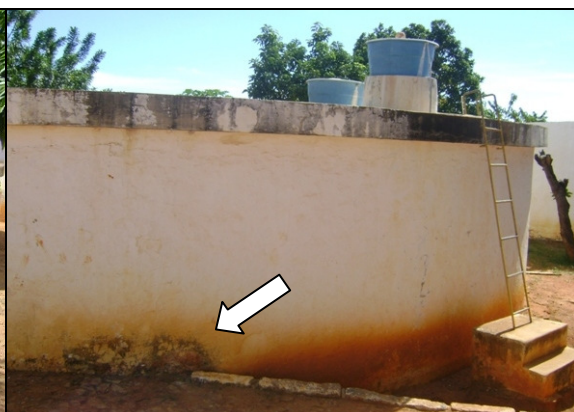
Foto 30 – Problema de infiltração na parede do RSE-01.
