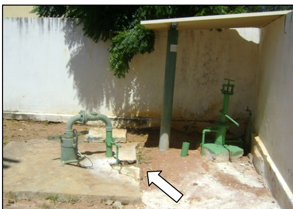
Foto 11 – Poço tubular PT-05, com laje de proteção danificada e clorador de pastilhas.
