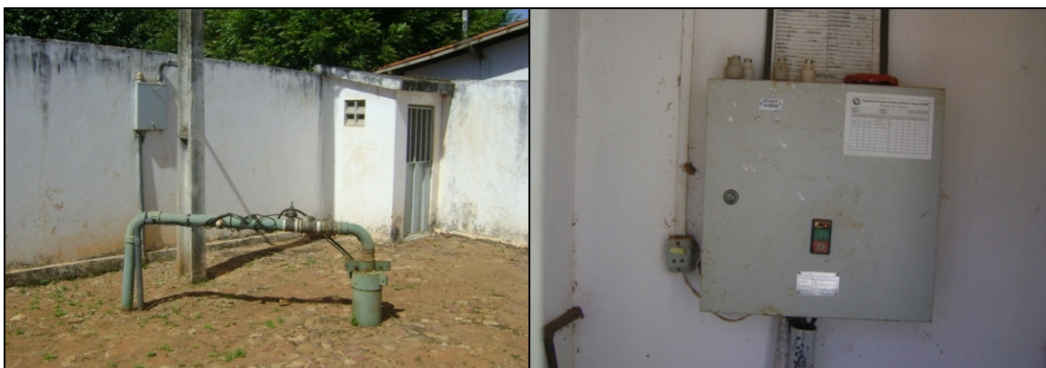
Foto 8 – Poço tubular PT-04, sem laje de proteção e Prédio de abrigo da EEPT-04.
