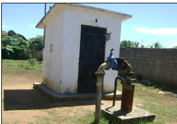
Foto 22 – Poço tubular PT-09 e prédio de abrigo do quadro de comando da EEPT-09.
