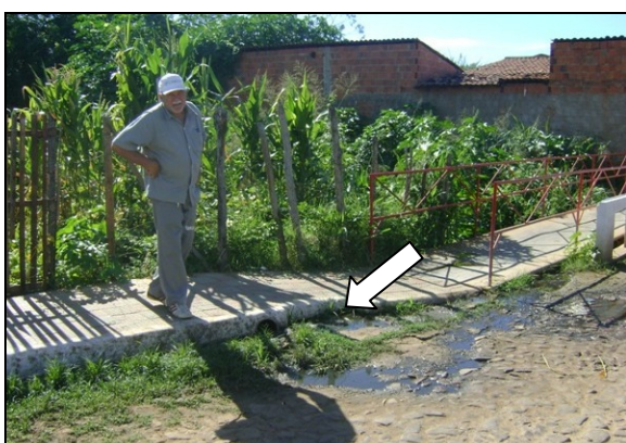
Foto 59 – Registro de descarga, localizado na Rua Divino Salvador, Alto do Rosário.
