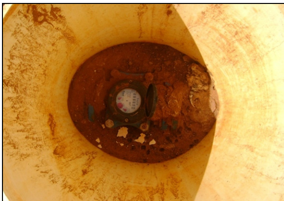
Foto 51 – Macromedidor de água tratada na saída do PT-04.
