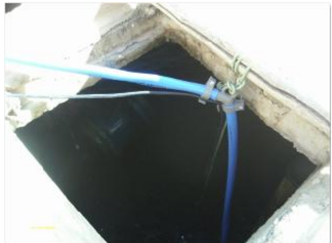
Foto 30 – RSE-06: ausência de tampa de inspeção.
