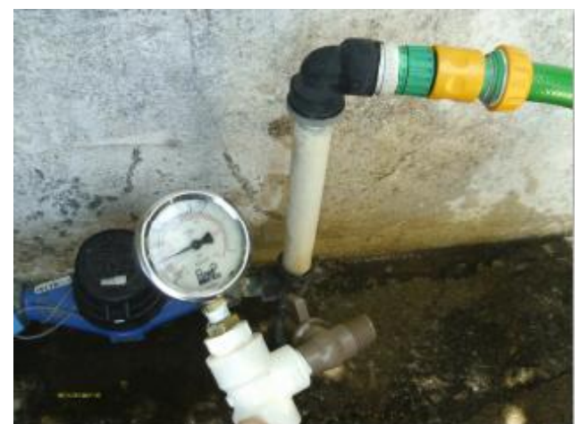
Foto 32 – Medição instantânea de pressão na Rua Coronel João Felipe, 553.
