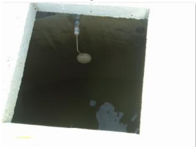
Foto 23 – REL-06: ausência de tampa de inspeção.
