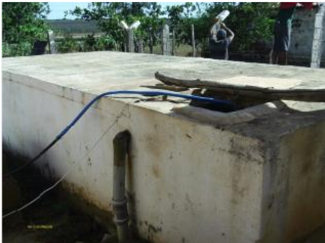
Foto 29 – RSE-06: ausência de identificação.
