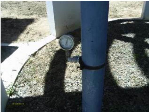
Foto 11 – REL-04: medidor de nível.
