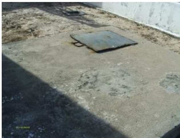
Foto 42 – EEE: poço de sucção.
