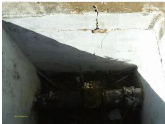
Foto 22 – REL-06: caixa do registro sem tampa ou grade de proteção.
