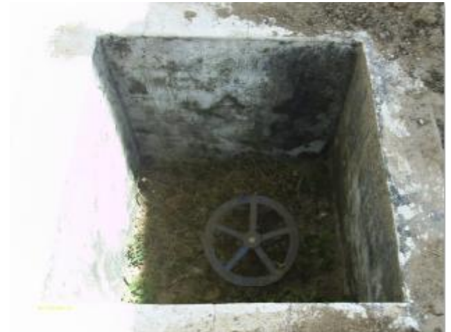
Foto 12 – REL-04: registro sem tampa ou grade de proteção.
