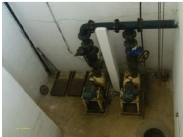
Foto 38 – EEE: conjunto moto-bomba.
