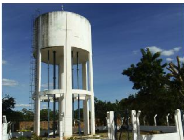
Foto 19 – REL-06: área de acesso, ausência identificação e de guarda corpo na laje superior.
