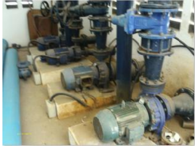
Foto 2 – EEAT-04 e 05: conjunto moto-bomba.
