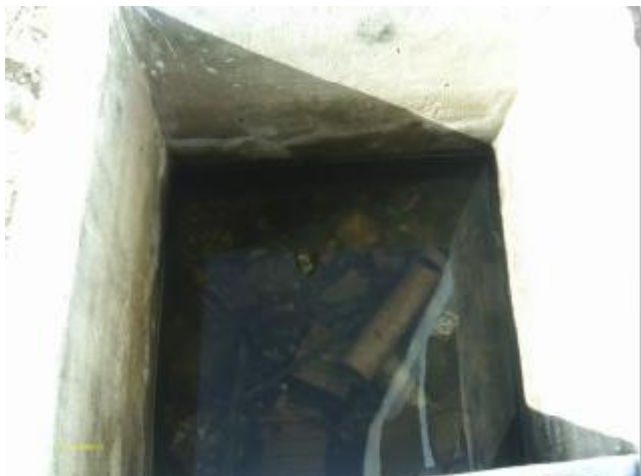
Foto 21 – REL-06: caixa de inspeção com transbordamento de água.
