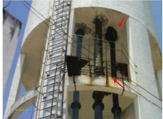
Foto 10 – REL-04: colônia de abelhas e plataforma deteriorada.
