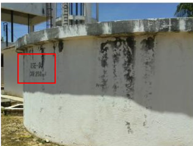
Foto 26 – RSE-05: pintura deteriorada e identificação desatualizada.
