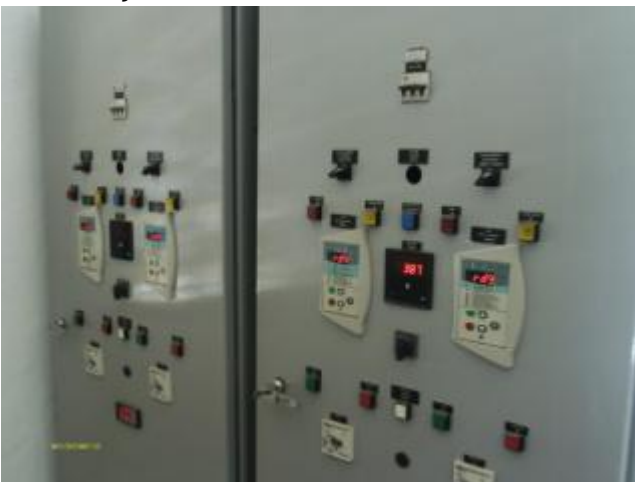
Foto 3 – EEAT-04 e 05: quadro de comando.
