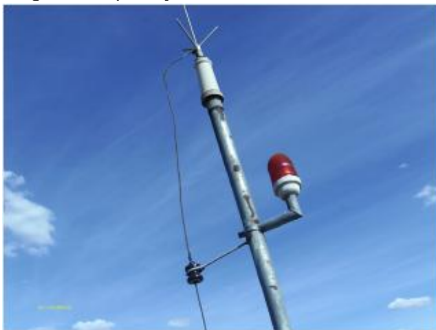
Foto 24 – REL-06: sinalização noturna e para-raios.
