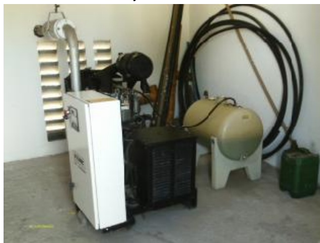
Foto 40 – EEE: grupo gerador de energia elétrica.
