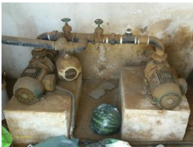
Foto 5 – EEAT-06 Booster : conjunto moto-bomba.
