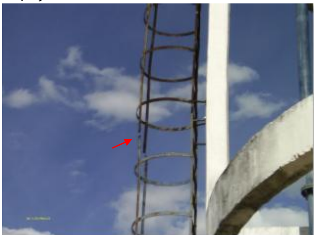
Foto 25 – REL-06: guarda corpo deteriorado.
