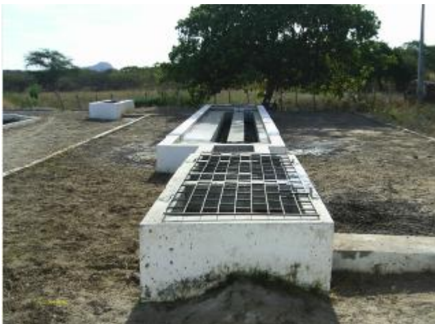
Foto 45 – Vista geral do tratamento de esgoto.
