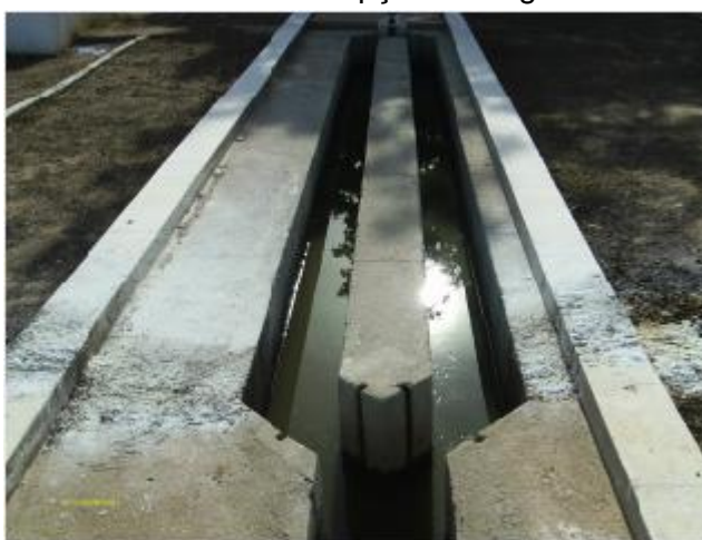
Foto 48 – Caixa de areia.
