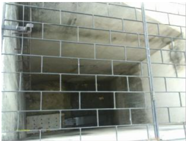
Foto 41 – EEE: chegada do esgoto e gradeamento.
