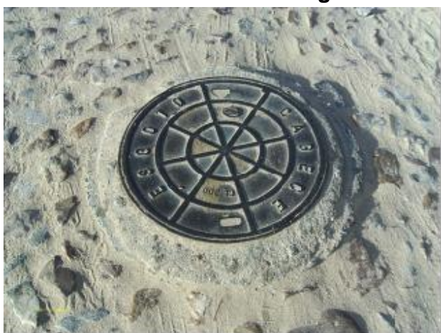
Foto 36 – Poço de visita na rede coletora.
