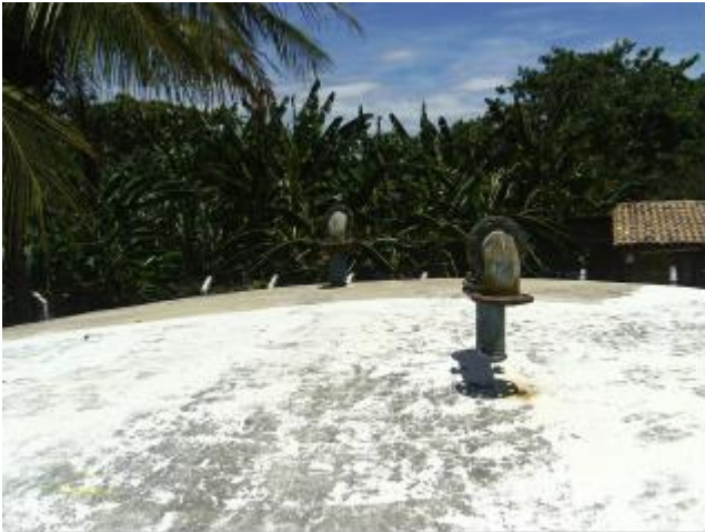
Foto 27 – RSE-05: tubulação de ventilação sem tela de proteção.
