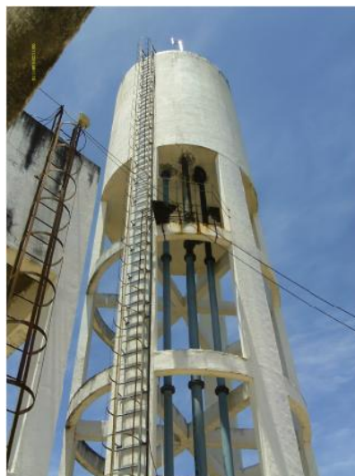
Foto 8 – REL-04: ausência de identificação e de guarda corpo na laje superior.
