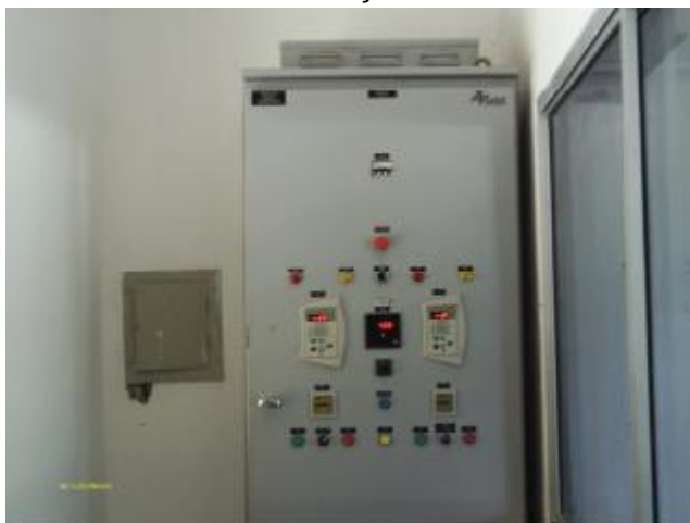
Foto 39 – EEE: quadro de comando
