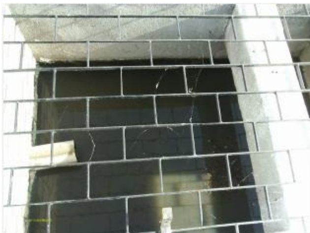
Foto 46 – Caixa de recepção do esgoto.
