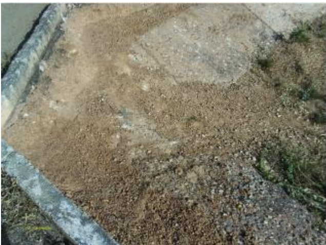
Foto 53 – Lagoa de maturação 1: talude deteriorado.
