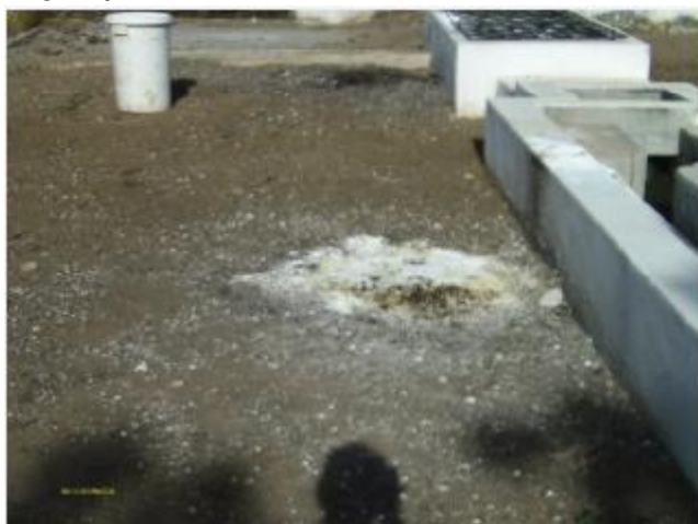
Foto 57 – Material retido no gradeamento e caixa de areia – ausência de leitos de secagem.
