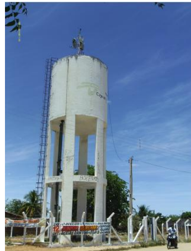
Foto 14 – REL-05: área de acesso, ausência de identificação e de guarda corpo na laje superior.
