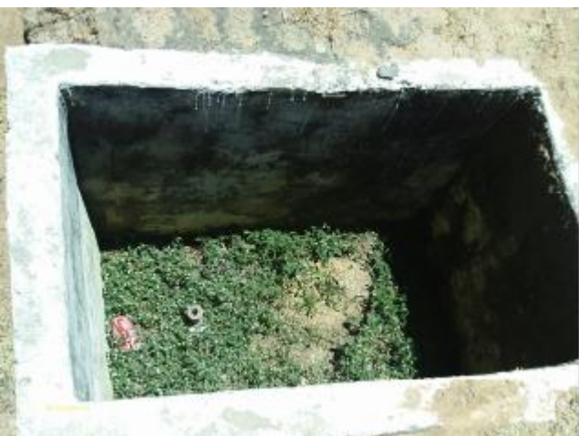
Foto 13 – REL-04: registro sem tampa ou grade de proteção.
