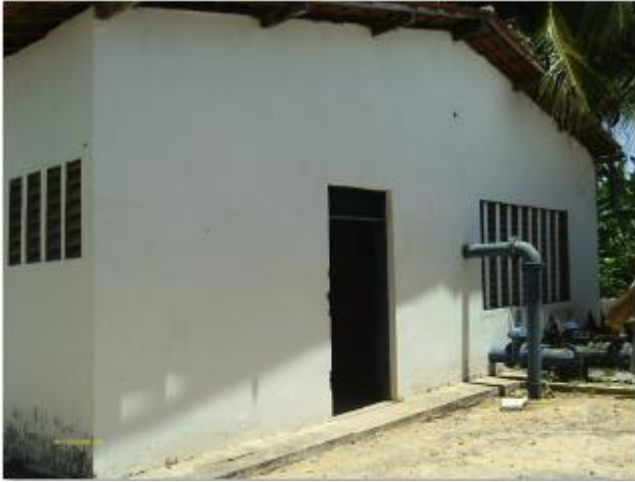
Foto 1 – EEAT-04 e 05: ausência de identificação.
