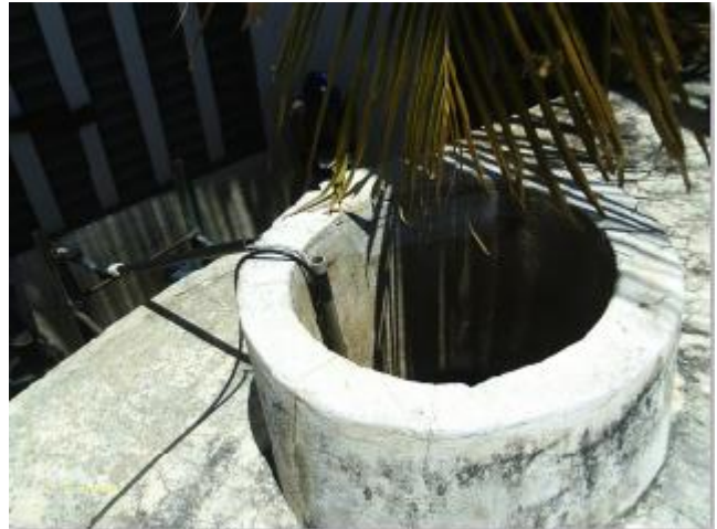
Foto 28 – RSE-05: ausência de tampa de inspeção.
