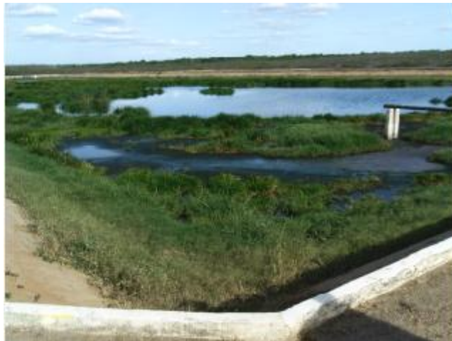
Foto 50 – Lagoa facultativa: presença de vegetação.
