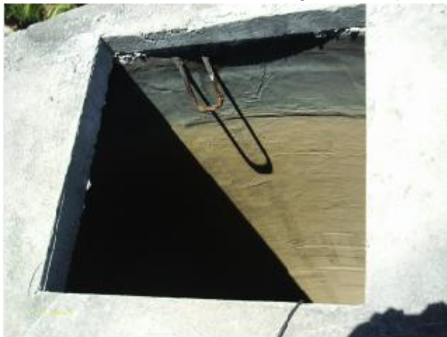
Foto 17 – REL-05: ausência de tampa de inspeção.
