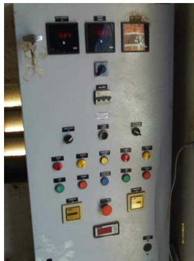
Foto 6 – EEAT-06 Booster : quadro de comando.
