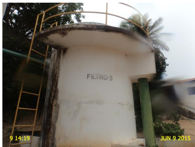
Foto 6 - Filtro F-03: identificação pouco visível.
