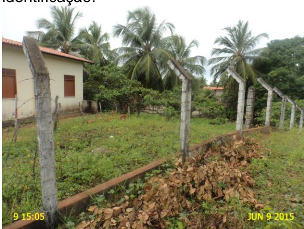
Foto 19 - REL-02: cerca de delimitação danificada.
