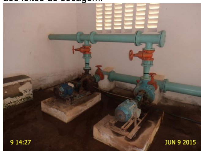
Foto 12 - EEAT-01: ausência de identificação.
