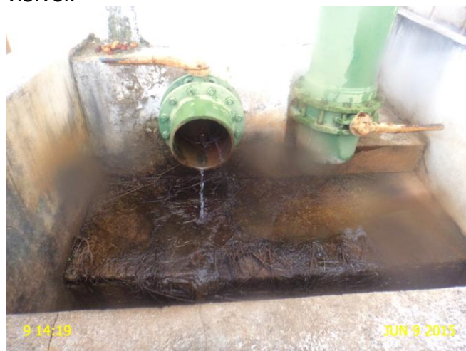
Foto 8 - F-02: registro sem vedação.
