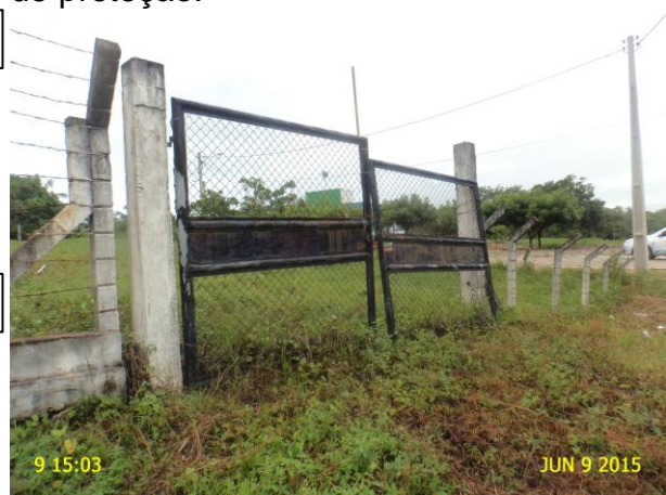
Foto 18 - REL-02: portão danificado.
