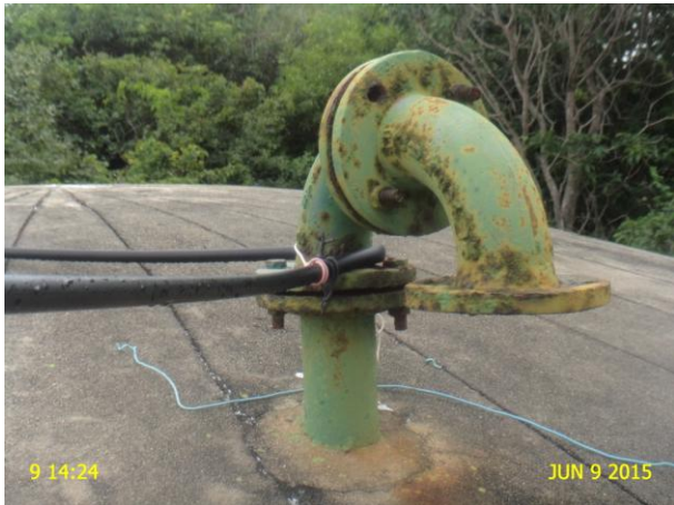
Foto 15 - RAP-01: tubulação de ventilação sem tela de proteção.
