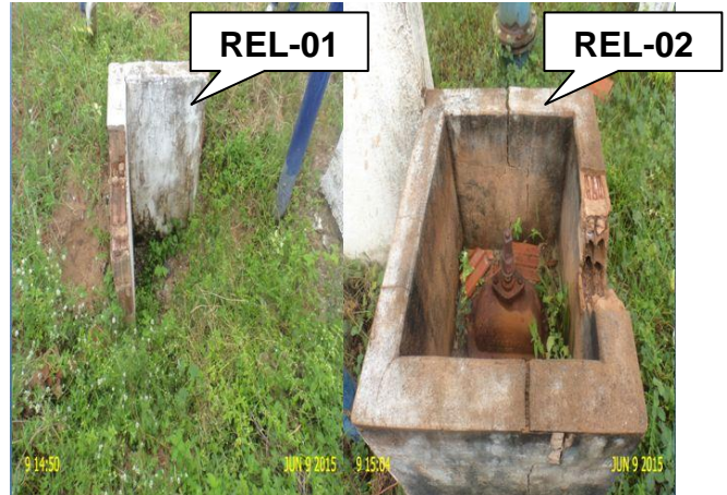
Foto 16 - REL-01 e REL-02: caixas de inspeção danificadas e sem tampa ou grade de proteção.
