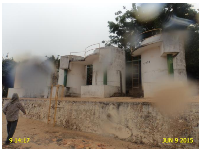
Foto 7 - Filtros F-01, F-02 e F-03: pintura deteriorada.
