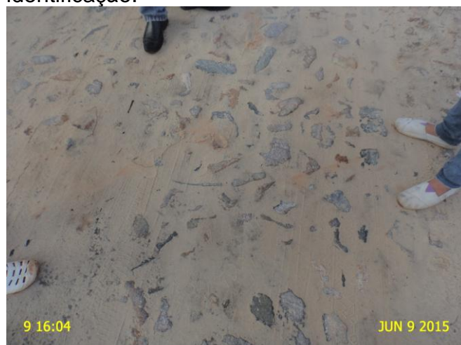
Foto 14 - RDA: registro de descarga soterrado - Rua José Paiva.
