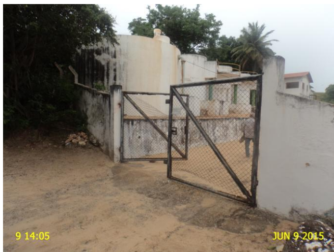
Foto 9 - ETA: portão danificado.
