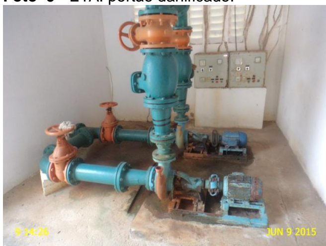
Foto 11 - EEAB-01: ausência de identificação.
