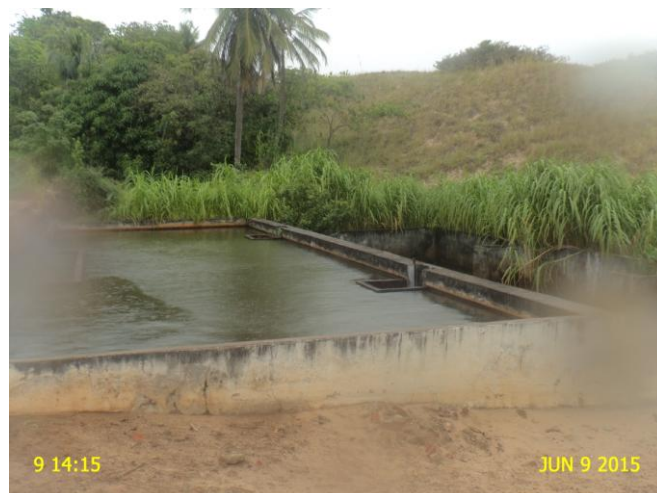
Foto 10 - ETA: vegetação excessiva na área dos leitos de secagem.
