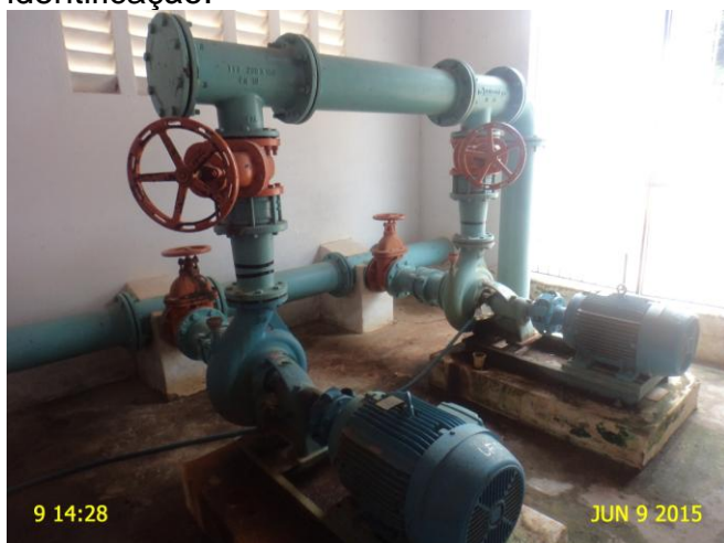
Foto 13 - EELF-01: ausência identificação e vazamento na gaxeta.
