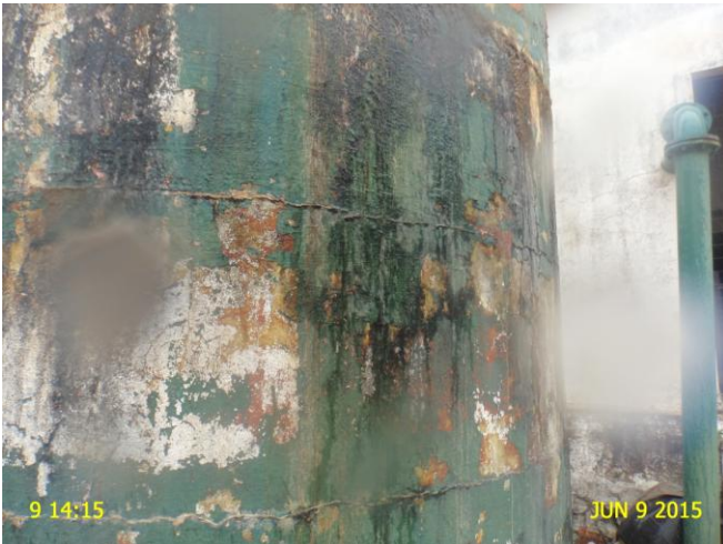
Foto 23 - PR-01: sinais de vazamento.
