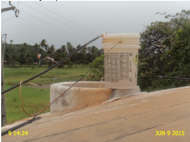
Foto 3 - RAP-01: sem tampa de inspeção.
