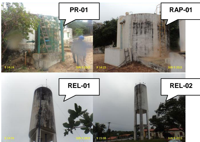
Foto 17 - PR-01, RAP-01, REL-01 e REL-02: pintura deteriorada e ausência de identificação.
