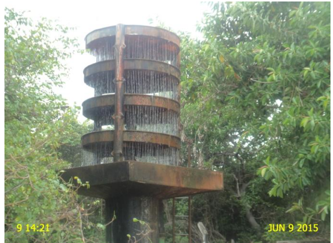
Foto 2 - Aerador: acesso sem guarda-corpo e escada em processo de corrosão.
