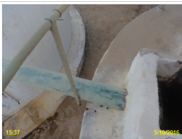
Foto 6 - F-01 (Sucesso): guarda-corpo danificado.
