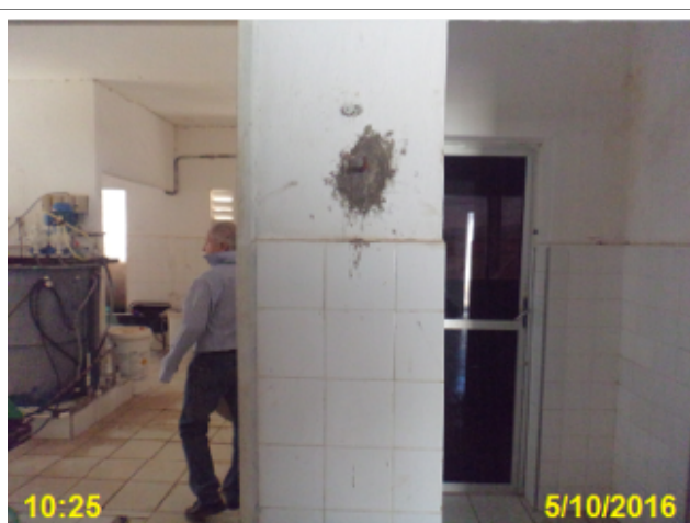
Foto 2 – EEAT-01 e EELF-01 (Tamboril): ausência de extintor de incêndio.
