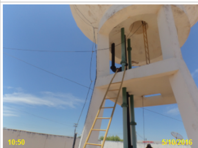
Foto 7 - REL-02 (Tamboril): escada sem fixação.
