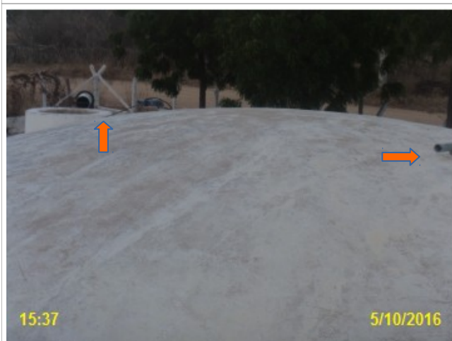
Foto 13 – RAP-01 (Sucesso): tubulação de ventilação sem tela de proteção e ausência de tampa de inspeção.
