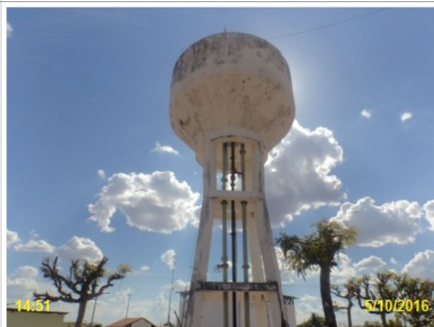
Foto 20 – REL-01 (Sucesso): ausência de identificação e pintura deteriorada.
