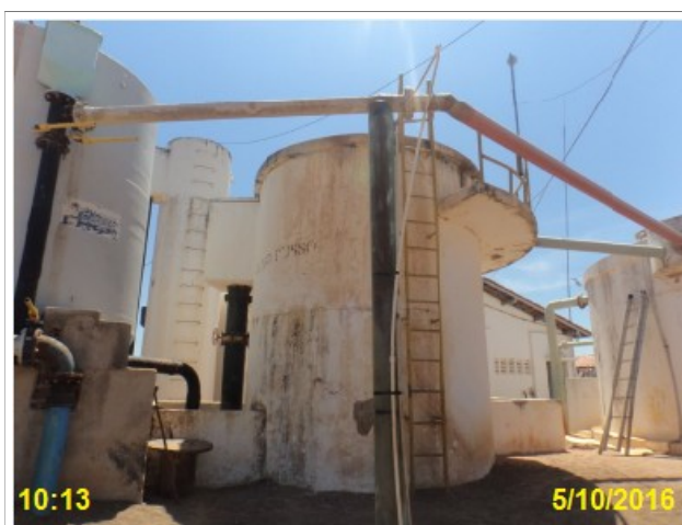
Foto 28 – Filtro Russo: pintura deteriorada e identificação apagada.
