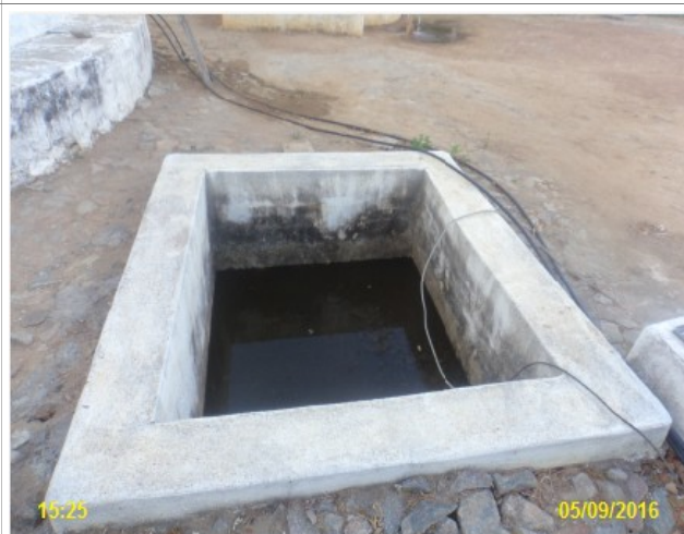
Foto 22 – AAB (Sucesso): sinais de alagamento e ausência de tampa ou grade de inspeção.
