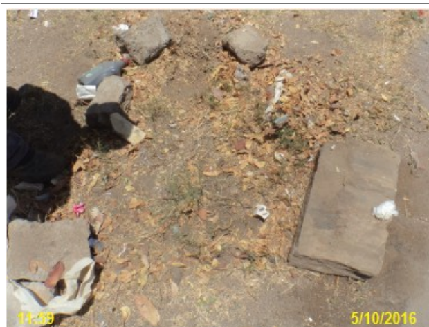
Foto 17 – RDA (Tamboril): registro de descarga soterrado na Rua Cândida Rodrigues, COHAB.
