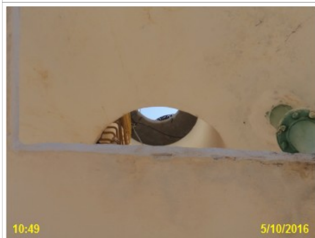
Foto 27 – REL-02: tampa de inspeção em processo de corrosão.
