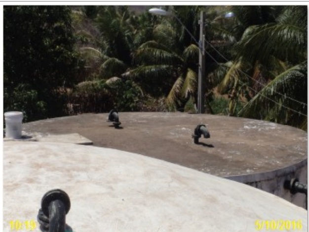
Foto 26 – RAP-01 (Tamboril): tubulação de ventilação sem tela de proteção.
