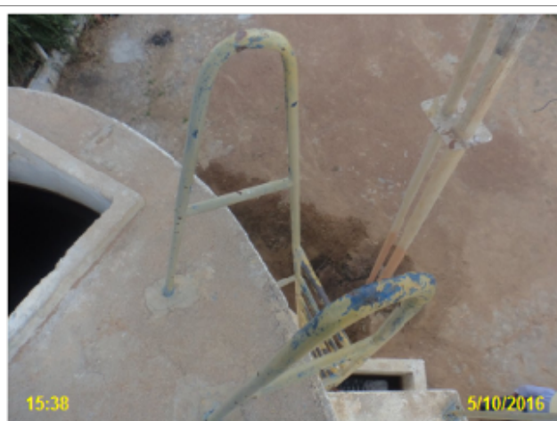
Foto 8 - F-01 (Sucesso): escada com pintura deteriorada.
