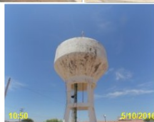
Foto 18 – RAP-01, RAP-02 e REL-02 (Tamboril): pintura deteriorada.
