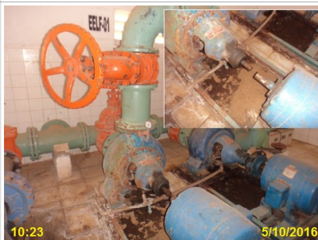
Foto 16 – EELF-01 (Tamboril): bomba sem interligação com o motor.
