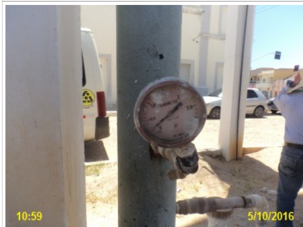
Foto 25 – REL-01: medidor de nível danificado.
