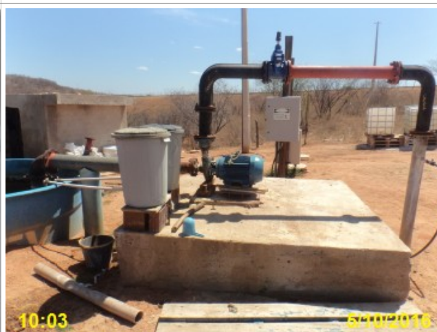
Foto 14 – EEAB-01 (Tamboril): ausência de identificação.
