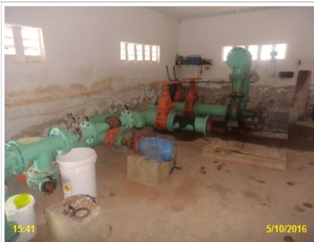
Foto 15 – EEAT-01 e EELF-01 (Sucesso): ausência de identificação e estrutura deteriorada.
