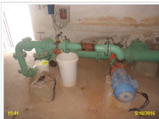
Foto 1 – EEAT-01 (Sucesso): ausência de bomba reserva.
