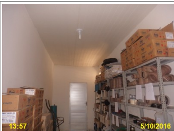
Foto 12 – Almoxarifado (Tamboril): a lâmpada não está ascendendo.
