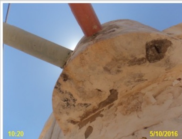
Foto 19 – RAP-02: sinais de vazamento.
