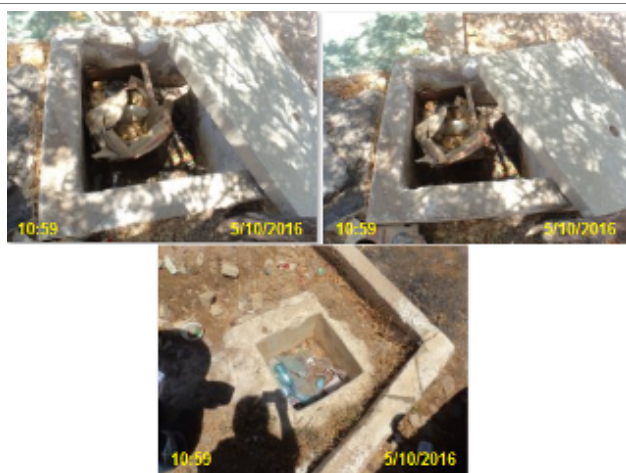
Foto 24 – REL-01 (Tamboril): caixa de inspeção sem tampa ou grade de proteção, com acúmulo de lixo.
