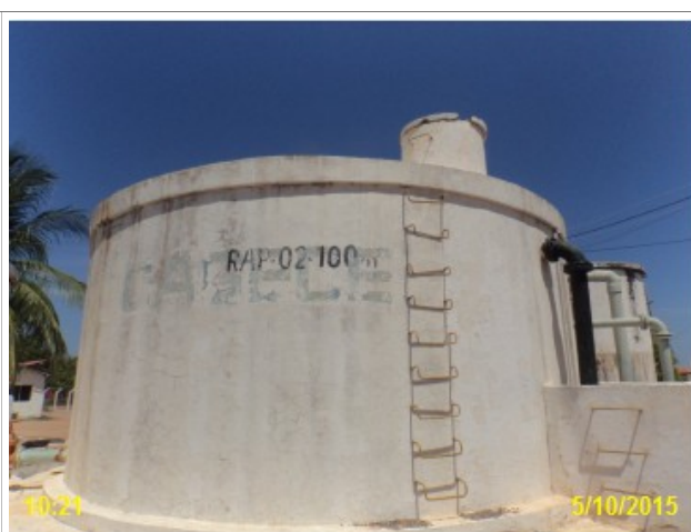
Foto 29 – RAP-02: identificação apagada e tampa de inspeção deteriorada.
