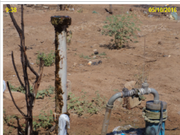
Foto 9 - PT-06 (Tamboril): identificação apagada, sinais de vazamento no clorador.
