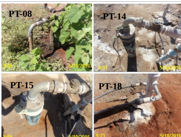
Foto 10 - PT-08, PT-14, PT-15 e PT-18 (Tamboril): sinais de vazamento.
