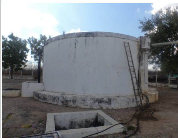
Foto 21 – RAP-01 (Sucesso): ausência de identificação.
