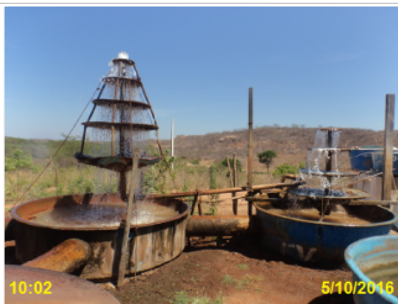
Foto 4 – Aerador dos poços (Tamboril): sustentação improvisada.
