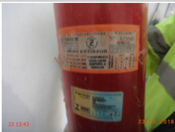
Foto 13 - EEAT-01: Extintor com recarga vencida.
