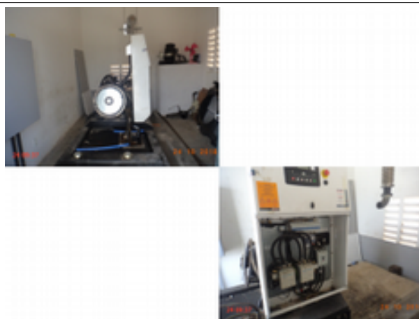
Foto 12 - Gerador: O gerador está desinstalado.
