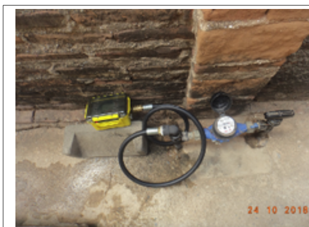
Foto 24 - RDA: instalação datalogger na Rua D, S/N. Bairro Paraíso.
