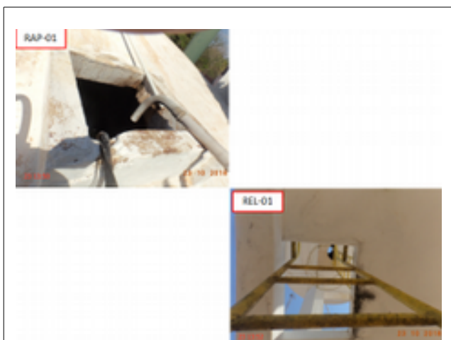
Foto 3 – Reservatórios: RAP-01 e REL-01 estão sem tampa de inspeção.
