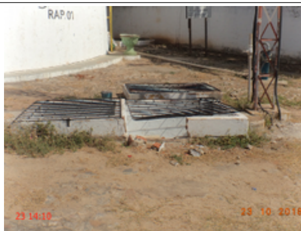
Foto 16 - ETA: Caixa de proteção do medidor proporcional danificada.
