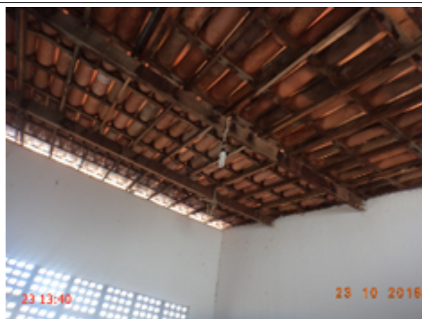
Foto 11 - EEAT-02: A iluminação elétrica não funciona.
