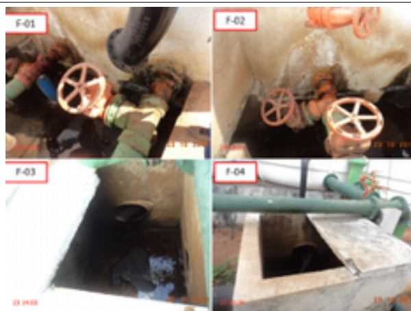
Foto 14 - Filtros: Os registros de descargas dos filtros F-01, F-02, F-03 e F-04 não vedam.
