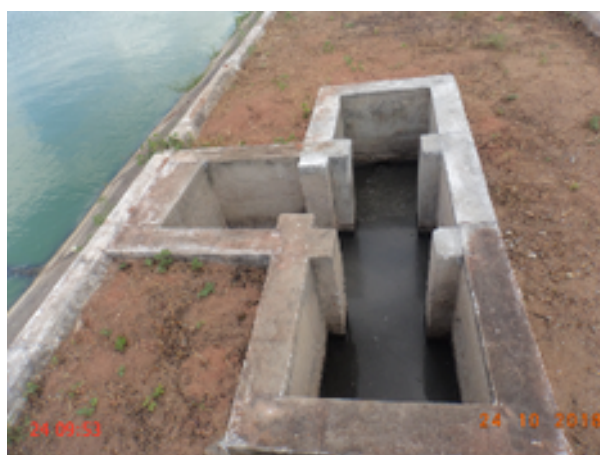
Foto 8 - ETE: Existem caixas de passagem no interior da ETE sem tampa ou grade de proteção.
