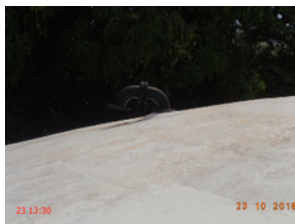
Foto 4 – RAP-01: Tubulação de ventilação está sem tela de proteção.
