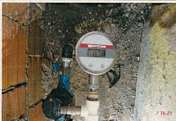
Foto 4 – RDA: pressão instantânea fora da faixa de 10 a 50 mca na Rua Alto da Caixa D'água.
