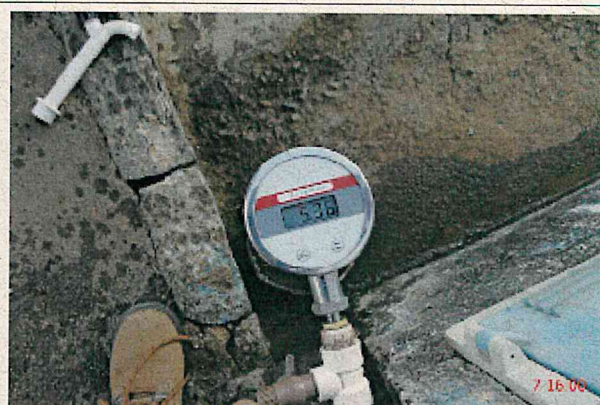
Foto 2 – RDA: pressão instantânea fora da faixa de 10 a 50 mca na Rua Padre José Laurindo, FNS 202.
