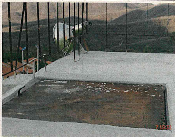
Foto 17 – REL-01: tampa em processo de corrosão.
