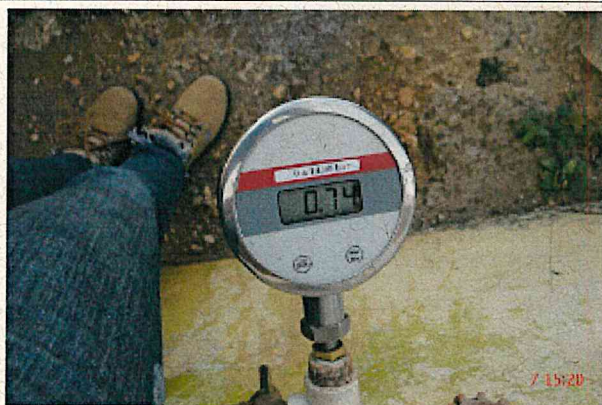
Foto 1 – RDA: pressão instantânea fora da faixa de 10 a 50 mca na Saída para Arisco, nº 417/2.
