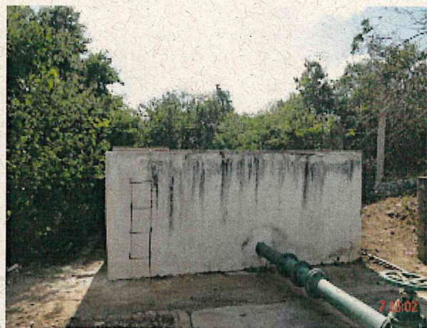
Foto 13 – RAP-01: pintura deteriorada e ausência de identificação.
