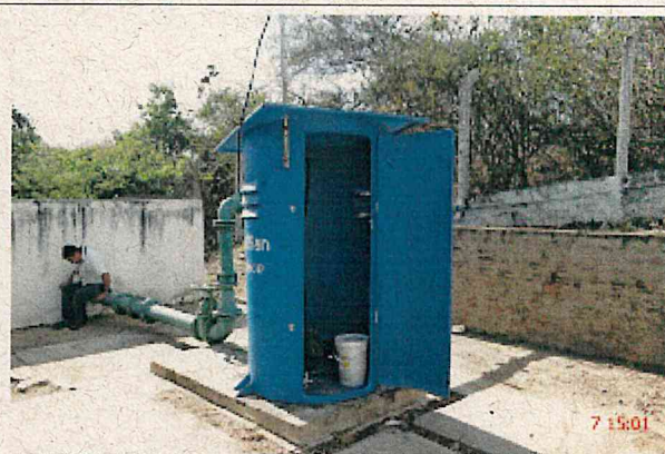
Foto 21 – EEAT-02: ausência de identificação.
