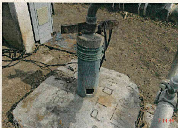
Foto 19 – PT-05: camisa de proteção danificada e identificação errada (PT-04).
