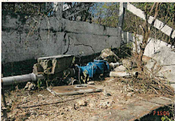
Foto 22 – RAP-01: medidor sem caixa.
