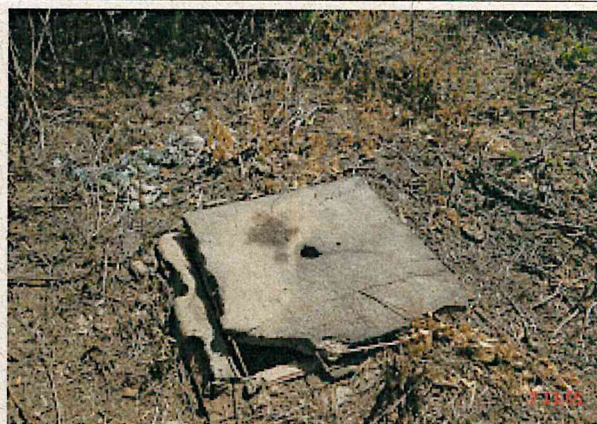
Foto 23 – RDA: registro de descarga com tampa danificada na Rua Antônio Alves Guerra.
