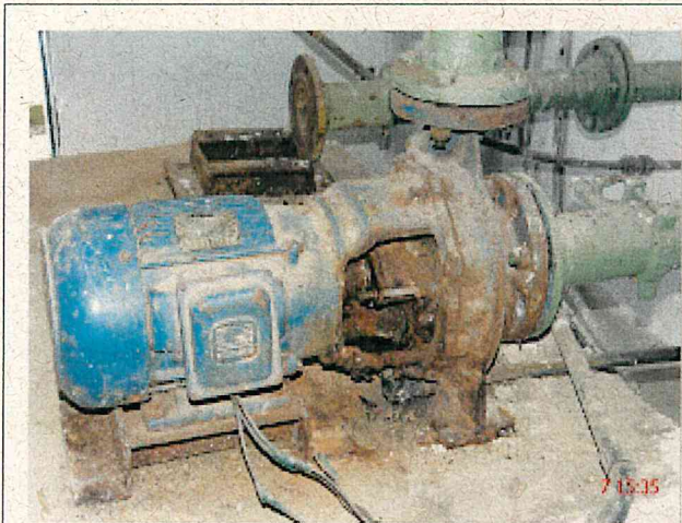
Foto 12 – EEAT-01: vazamento na gaxeta.
