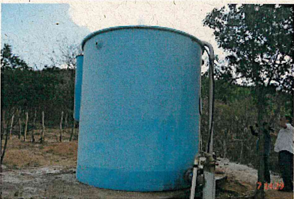
Foto 9 – RAP-03 e EEAB-02: ausência de identificação e de escada de acesso.
