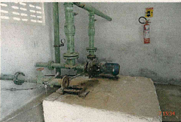
Foto 7 – EEAT-01: ausência de bomba reserva e de identificação.
