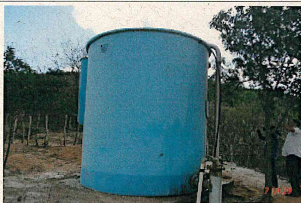
Foto 20 – RAP-03 e EEAB-02: ausência de identificação e de escada de acesso.
