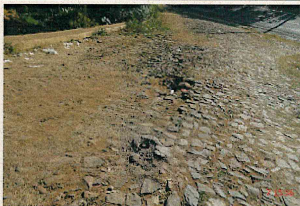
Foto 25 – RDA: registro de descarga sem proteção na Rua Padre José Laurindo.
