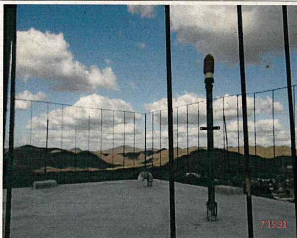
Foto 28 – REL-01: ausência de para-raios.
