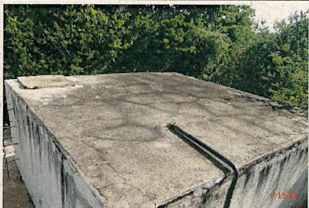
Foto 8 – RAP-01: rachaduras, tampa inadequada, abertura na laje de cobertura e ausência de tubulação de ventilação.
