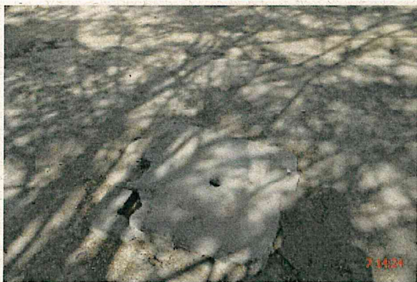
Foto 24 – RDA: registro de descarga com tampa danificada na Rua 02, Assent. Santa Terezinha..
