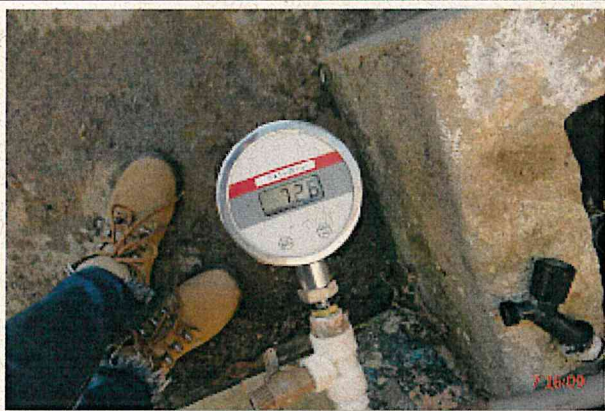
Foto 3 – RDA: pressão instantânea fora da faixa de 10 a 50 mca na Rua Conjunto Novo, s/n.
