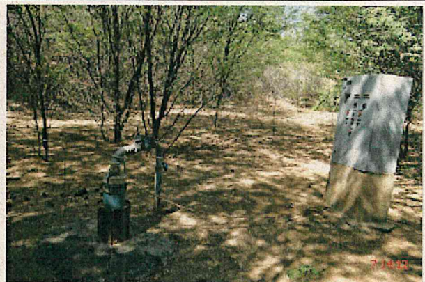
Foto 10 – PT-17: área não delimitada, quadro sem casa de abrigo e ausência de identificação e de iluminação.
