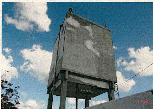
Foto 14 – REL-01: ausência de identificação e pintura deteriorada.
