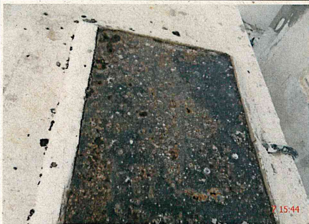
Foto 16 – RAP-02: tampa em processo de corrosão.
