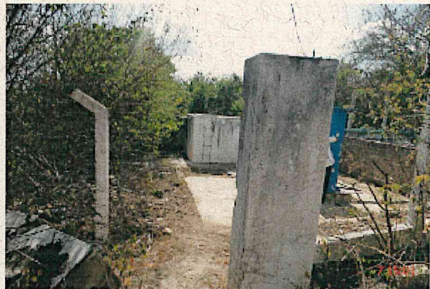
Foto 6 – RAP-01: cerca e portão danificados.
