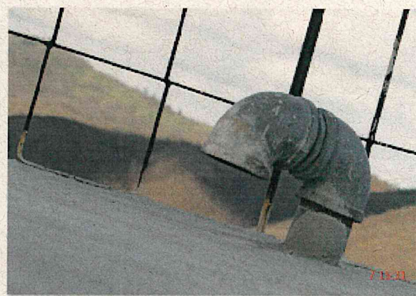
Foto 15 – REL-01: ausência de tela de proteção.
