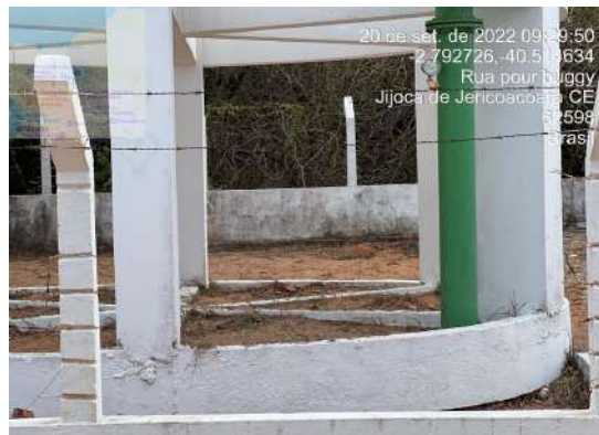
Foto 2 - REL-01 (Jericoacoara): ausência de cerca em vários pontos.
