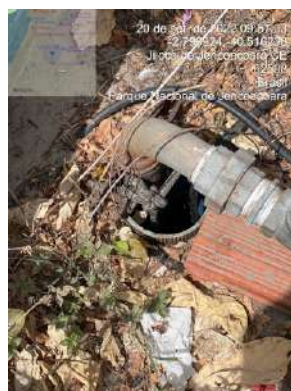
Foto 8 - Poço (Jericoacoara) ausência ou tampa aberta.
