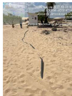
Foto 12 - Poços (Jericoacoara): fiação aparente na área dos poços.
