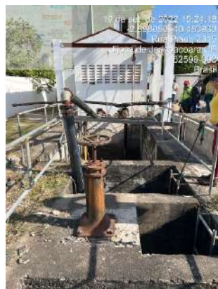
Foto 16 - EEE-02 (Jijoca): estado precário de operação.
