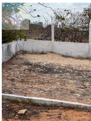
Foto 3 - REL-01 (Jericoacoara): ausência de cerca em vários pontos.
