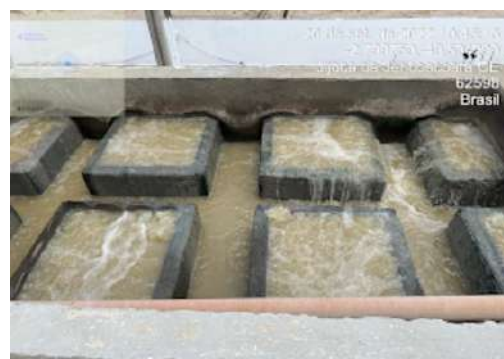
Foto 22 - ETE (Jericoacoara): infraestrutura operando acima da capacidade operacional.
