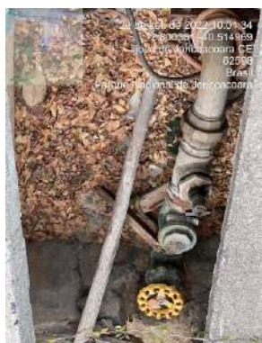
Foto 9 - Poço (Jericoacoara) ausência ou tampa aberta.
