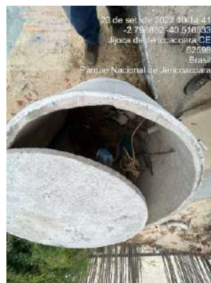
Foto 6 - Poço (Jericoacoara) ausência ou tampa aberta.
