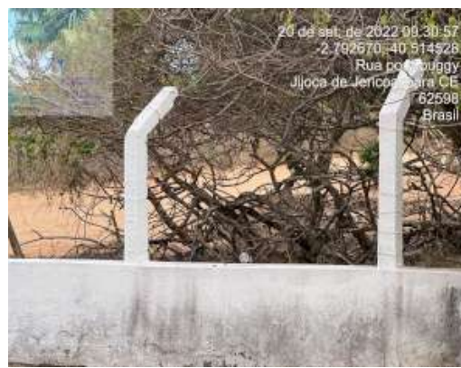
Foto 4 - REL-01 (Jericoacoara): ausência de cerca em vários pontos.
