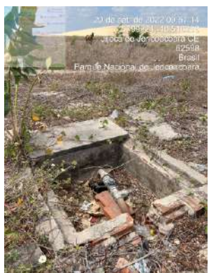
Foto 7 - Poço (Jericoacoara) ausência ou tampa aberta.
