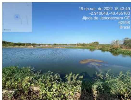
Foto 18 - ETE (Jijoca): assoreamento e presença de vegetação nos taludes da Lagoa Facultativa.
