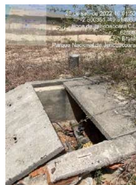
Foto 10 - Poço (Jericoacoara) ausência ou tampa aberta.
