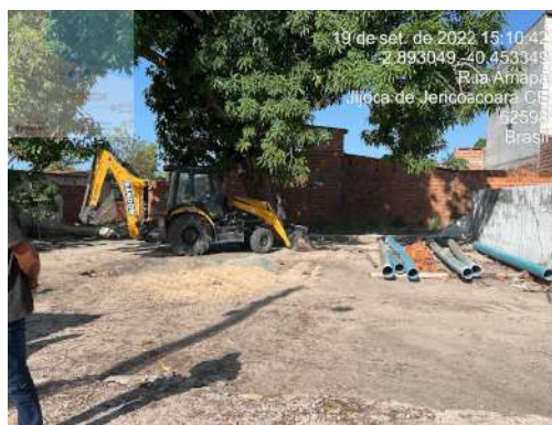
Foto 14 - EEE-01 (Jijoca): o muro do fundo está caído.
