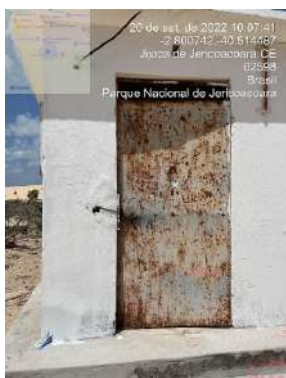
Foto 13 - Quadros de comando (Jericoacoara): sem proteção, vedação da porta com arame.
