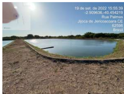
Foto 20 - ETE (Jijoca): ausência de placas de proteção em todos os taludes das Lagoas de Maturação.
