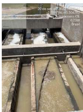
Foto 23 - ETE (Jericoacoara): infraestrutura operando acima da capacidade operacional.
