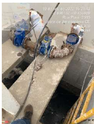
Foto 17 - EEE-02 (Jijoca): estado precário de operação.
