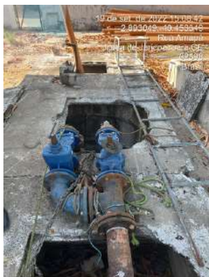
Foto 15 - EEE-01 (Jijoca): ausência de proteção do poço de sucção.
