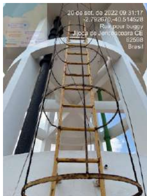
Foto 1 - REL-01 (Jericoacoara): escada de acesso ao reservatório com corrosão.
