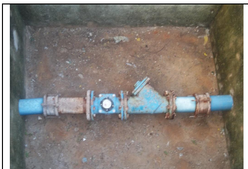
Foto 15 – Macromedidor sem funcionar na chegada do REL-04.
