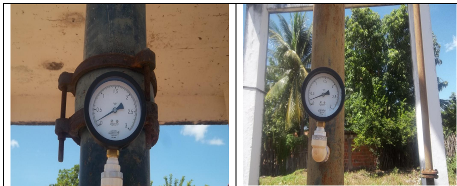
Fotos 11 e 12 – Dispositivos de medição de nível dos reservatórios REL-03 e REL-04
