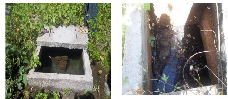
Fotos 13 e 14 – Ventosa e registro na adutora de água tratada.
