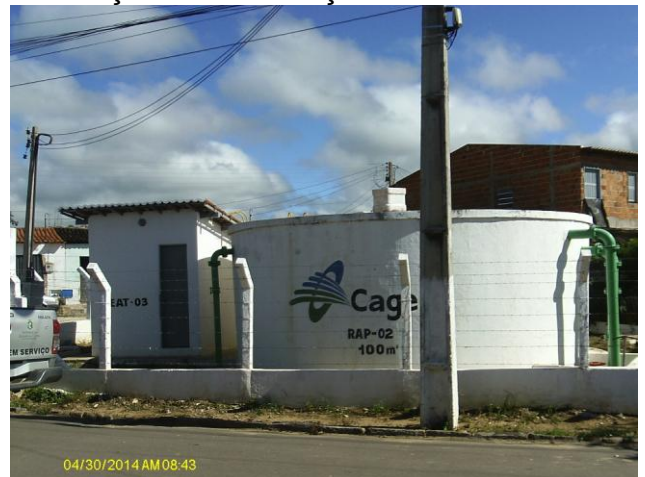
Foto 56 – RAP-02: com identificação.
