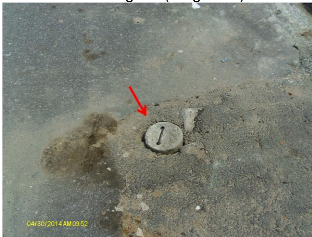
Foto 91 – Registro de descarga na Rua Cel. Miguel Arraes.
