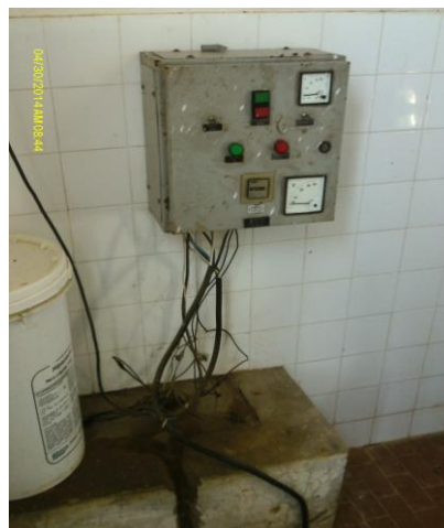
Foto 43 – EEAT-03: quadro de comando.
