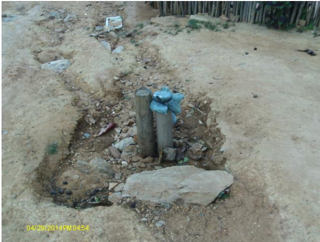
Foto 89 – Registro de descarga na Rua Guilhermina Rodrigues (Alagoinha).
