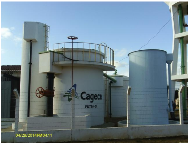
Foto 9 – Vista do filtro F-01.
