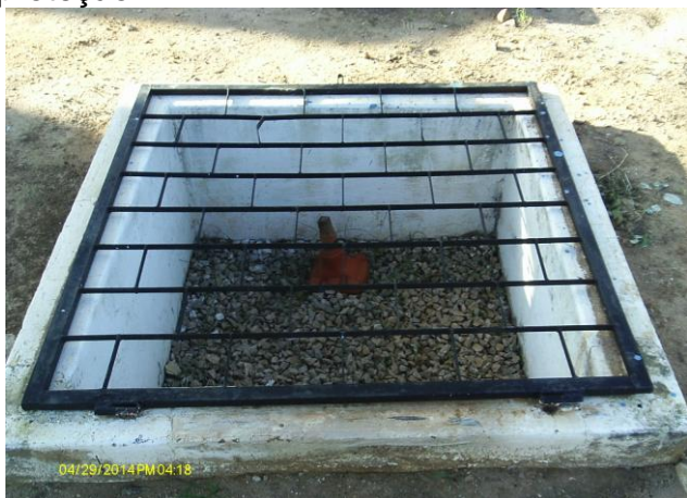
Foto 29 – Caixa de registro na adutora de água tratada na área da ETA, com grade de proteção.
