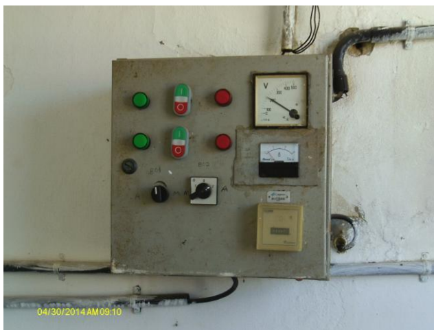
Foto 46 – EEAT-05: quadro de comando.
