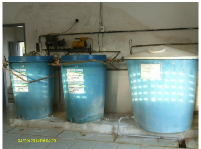
Foto 16 – Casa de química: tanque de mistura de produtos químicos.
