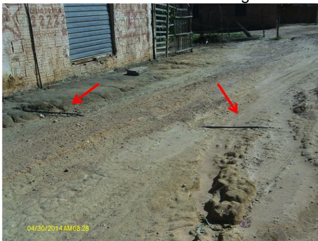
Foto 35 – Ramal de ligação exposto na localidade Pajeú.
