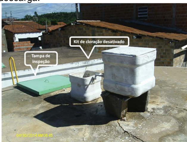
Foto 57 – RAP-02: tampa de inspeção adequada, ausência de tubulação de ventilação e kit de cloração desativado.
