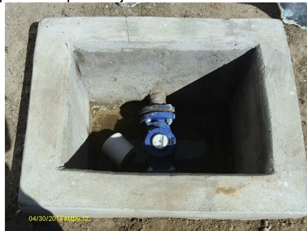
Foto 34 – Macromedidor de água tratada, localizado na saída do RAP-05.
