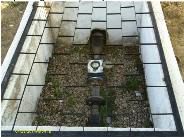
Foto 33 – Macromedidor de água tratada, localizado na saída da ETA de Alagoinha.
