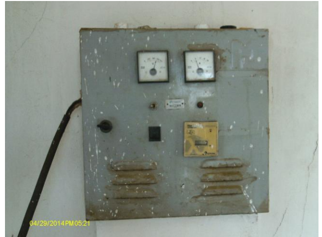
Foto 49 – EEAT-06: quadro de comando.
