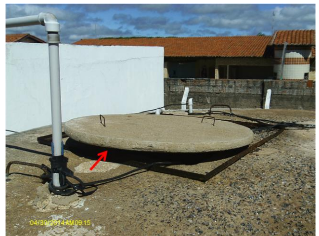
Foto 62 – RAP-05: tampa de inspeção com vedação inadequada.
