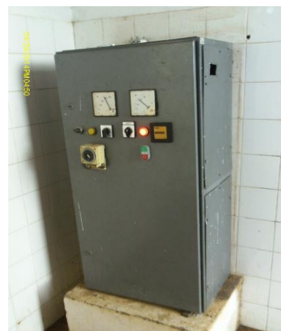
Foto 6 – Quadro de comando da EECS-01.
