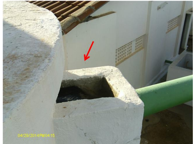
Foto 14 – Filtro-01: sem tampa de proteção na caixa de saída da água tratada.
