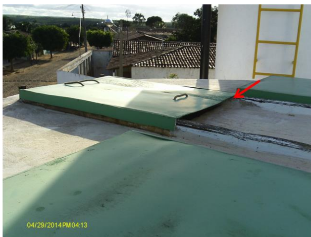
Foto 11 – Filtro-01: vedação de tampa inadequada.
