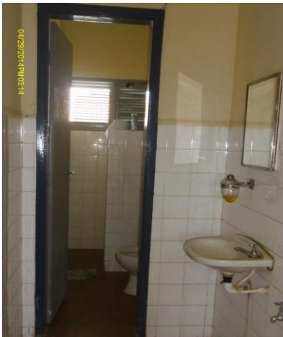
Foto 97 – Instalações sanitárias disponíveis para funcionários e usuários.
