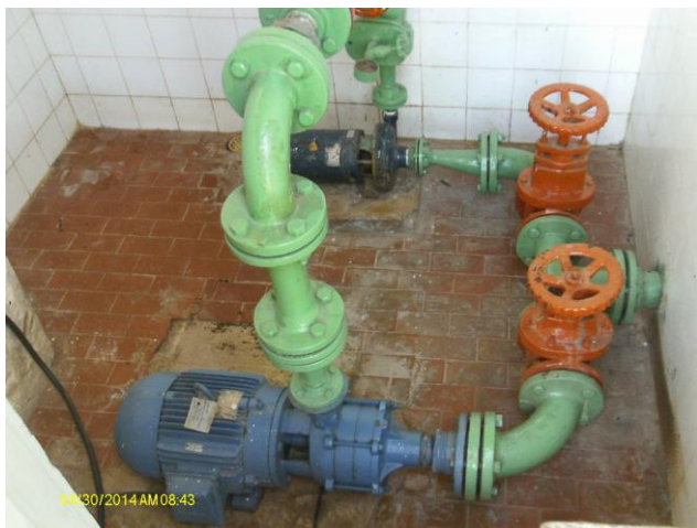
Foto 42 – EEAT-03: conjunto moto-bomba.
