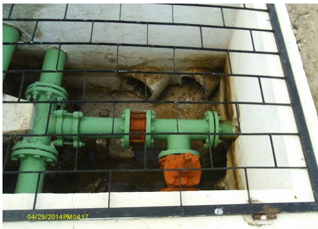
Foto 27 – Caixa de inspeção na adutora de água tratada na área da ETA, com grade de proteção.
