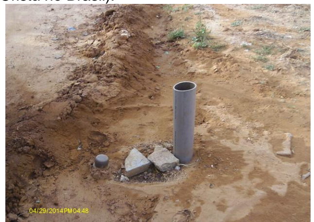
Foto 88 – Registro de descarga na Rua Castelo Branco (Alagoinha).
