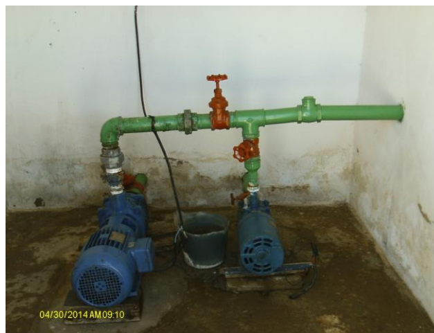
Foto 45 – EEAT-05: conjunto moto-bomba.
