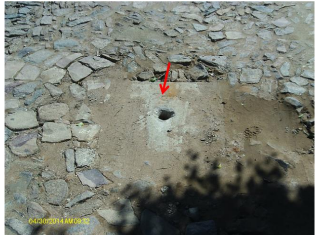
Foto 90 – Registro de descarga na Rua Sebastião de Sousa Cabral.
