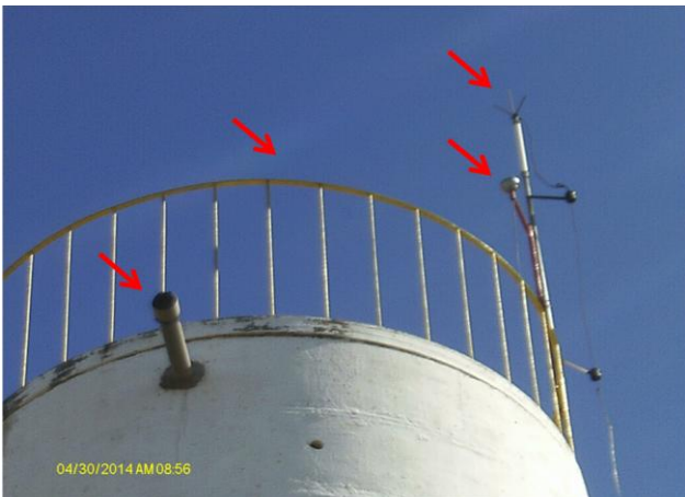
Foto 75 – REL-03: tubulação de ventilação, gaiola protetora na laje de cobertura, pára-raios e ausência de sinalizador noturno.
