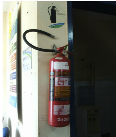
Foto 98 – Extintor de incêndio da loja de atendimento com data de validade vencida desde mar/2014.
