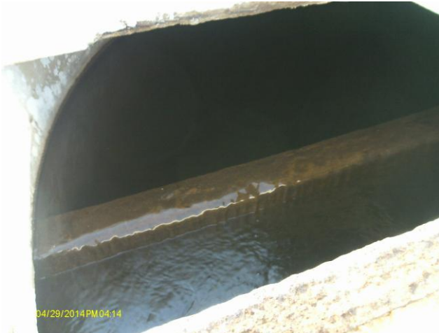
Foto 13 – Filtro-01: calha de água filtrada.
