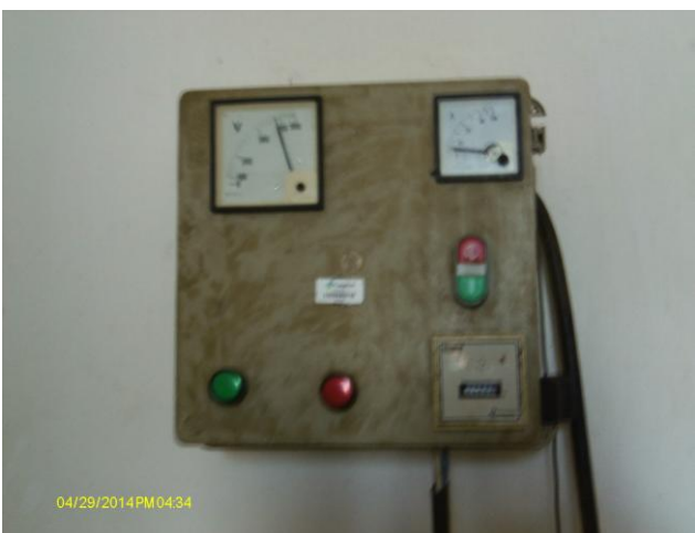
Foto 40 – EEAT-02: quadro de comando.
