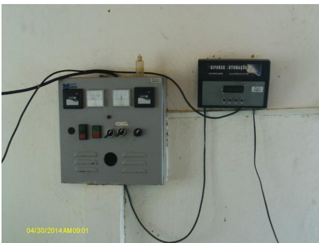
Foto 52 – EEAT-07: quadro de comando.
