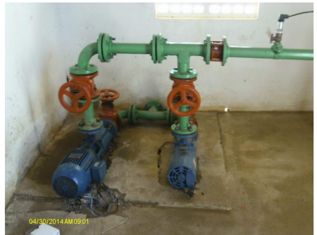
Foto 51 – EEAT-07: conjunto moto-bomba.
