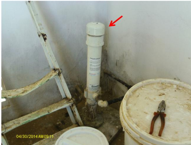
Foto 19 – Clorador de pastilha no RAP-05.
