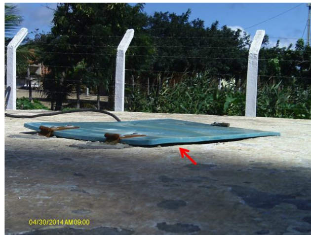
Foto 66 – RSE-02: tampa de inspeção com vedação inadequada.
