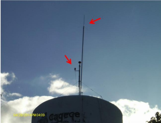
Foto 71 – REL-01: pára-raios e sinalização noturna.
