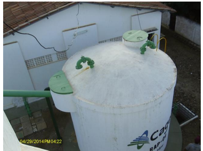
Foto 54 – RAP-01: com tampa e tela nas tubulações de ventilação.
