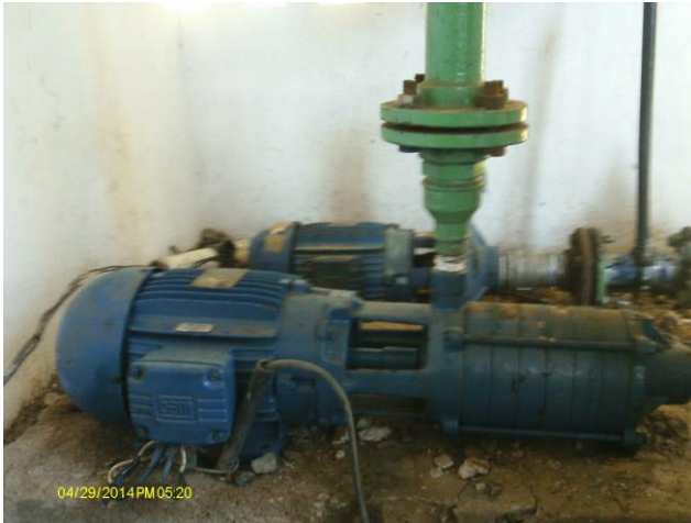
Foto 48 – EEAT-06: conjunto moto-bomba.
