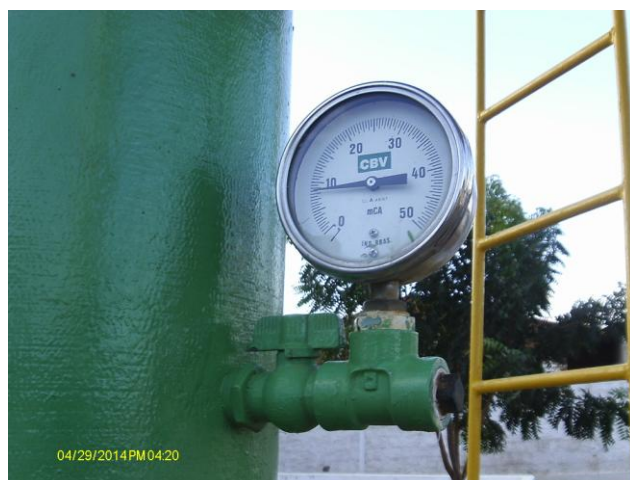
Foto 70 – REL-01: medidor de nível.
