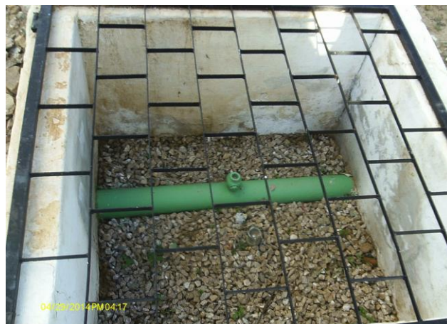
Foto 28 – Caixa de inspeção na adutora de água tratada na área da ETA, com grade de proteção.
