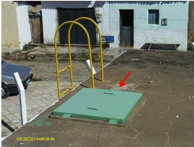
Foto 59 – RAP-03: tampa de inspeção adequada, ausência de tubulação de ventilação.
