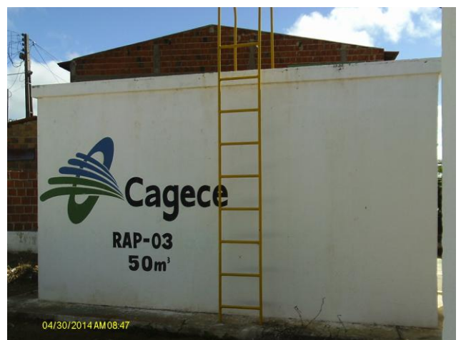
Foto 58 – RAP-03: com identificação e escada de acesso.
