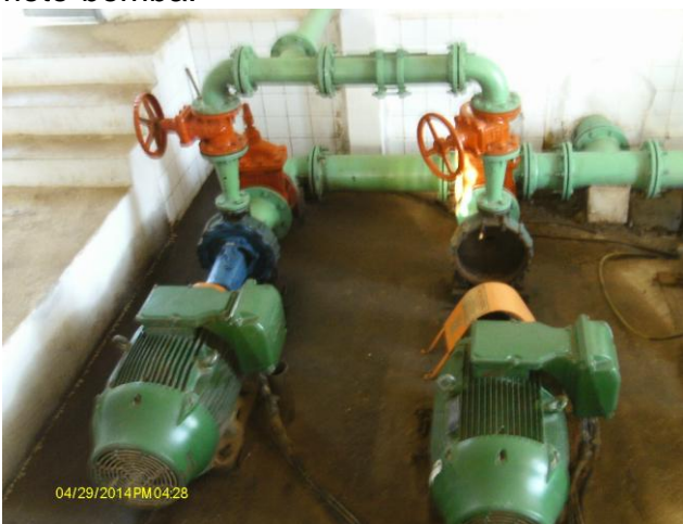
Foto 38 – EEAT-04: conjunto moto-bomba.
