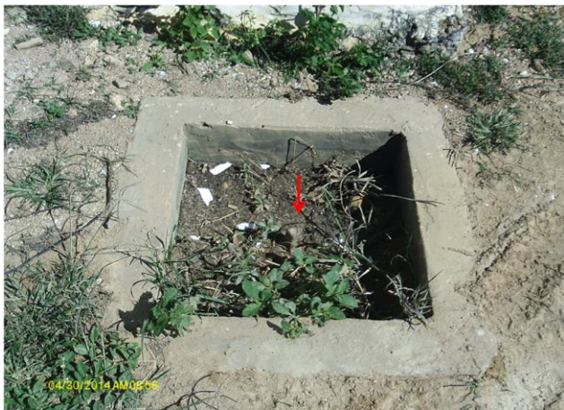
Foto 31 – Caixa de registro da adutora de água tratada na área do REL-03 está sem tampa ou grade de proteção.
