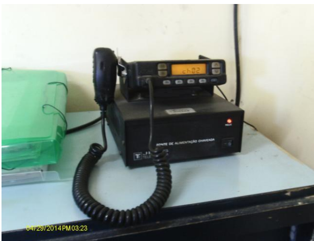
Foto 99 – Rádio de comunicação com a ETA.
