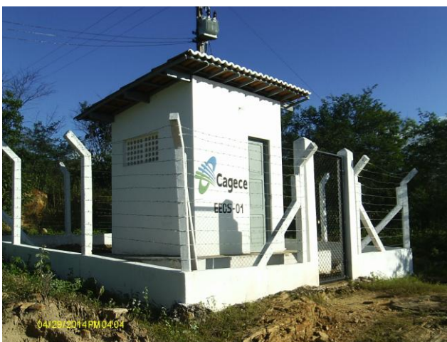
Foto 5 – Casa de abrigo do quadro de comando da EECS-01.
