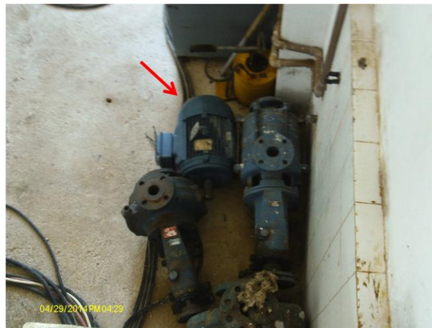
Foto 37 – EEAT-02: bomba reserva.
