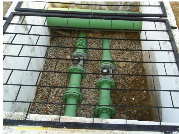
Foto 32 – Macromedidor de água tratada, localizado na saída da ETA de Alagoinha para Araripe e Pajeú.
