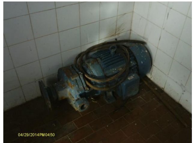
Foto 4 – Bomba reserva da captação.
