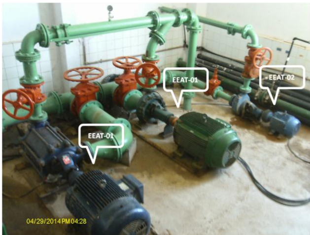
Foto 36 – EEAT-01 e EEAT-02: conjuntos moto-bomba.
