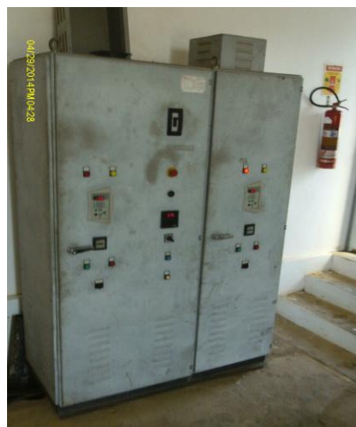
Foto 39 – EEAT-01 e EEAT-04: quadro de comandos.
