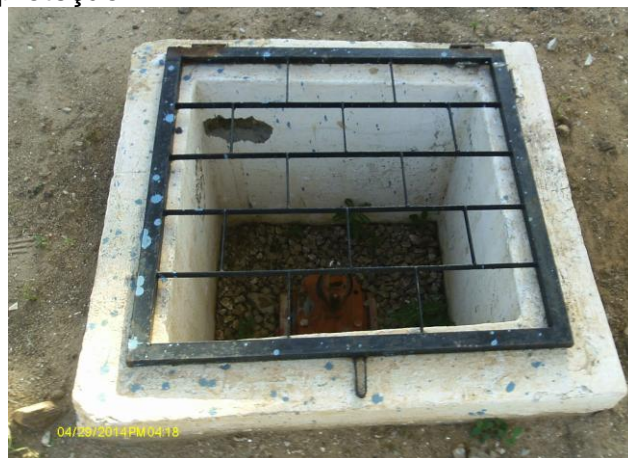
Foto 30 – Caixa de registro na adutora de água tratada na área da ETA, com grade de proteção.
