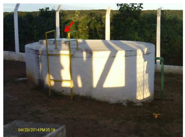
Foto 64 – RSE-01: escada de acesso, tampa de inspeção adequada e ausência de tubulação de ventilação.
