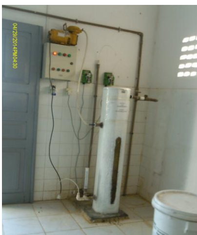
Foto 17 – Casa de química: dosador de flúor.
