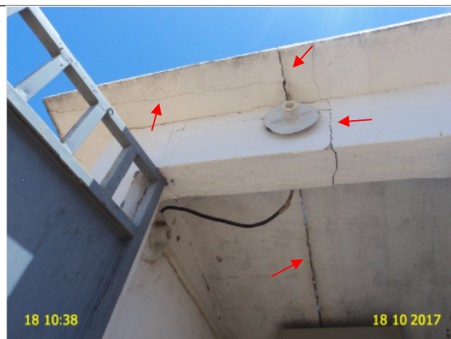
Foto 24 – PT-09: casa de abrigo com rachaduras.
