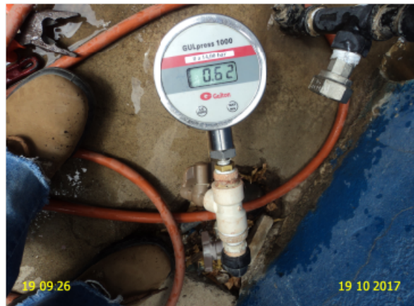
Foto 6 – RDA: medição de pressão instantânea na Av. Perimetral, Colégio José de Alencar Alves – Cajueiro (6,2 mca).
