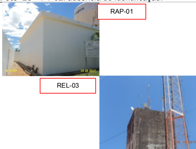
Foto 30 – RAP-01 e REL-03: ausência de identificação.
