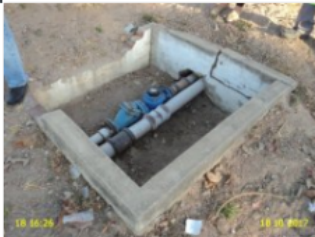
Foto 19 – AAB: caixas de inspeção sem tampa ou grade de inspeção e deteriorada.
