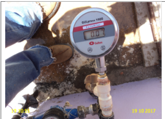
Foto 9 – RDA: medição de pressão instantânea na Rua Santa Luzia, nº 515 (0,7 mca).
