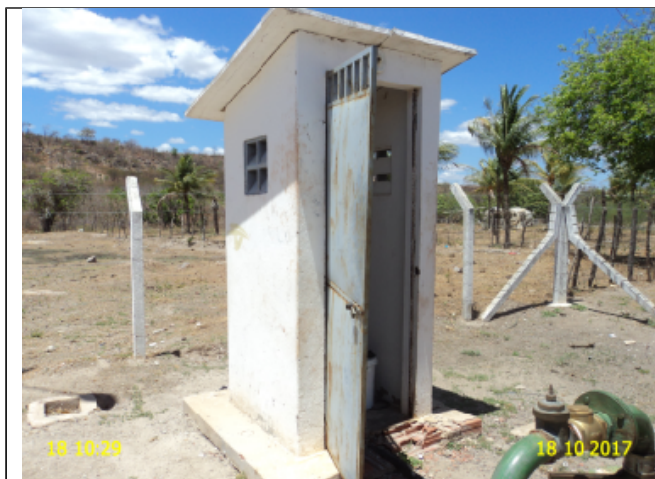
Foto 27 – PT-08: ausência de identificação.
