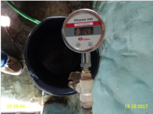
Foto 3 – RDA: medição de pressão instantânea na Rua São João, nº 377 – Vila Alta (4,3 mca).
