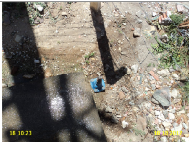
Foto 31 – RAP-02 e EEAT-02: registro sem caixa.
