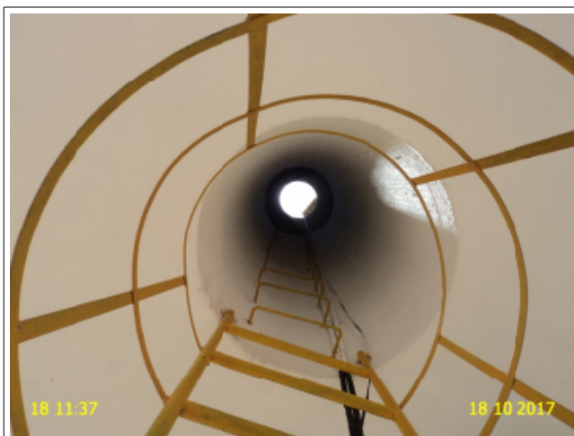
Foto 10 – REL-02: ausência de tampa de inspeção.
