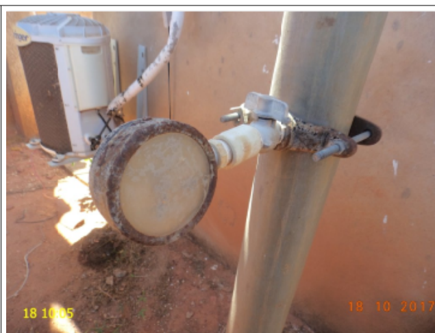
Foto 11 – REL-03: medidor de nível quebrado.
