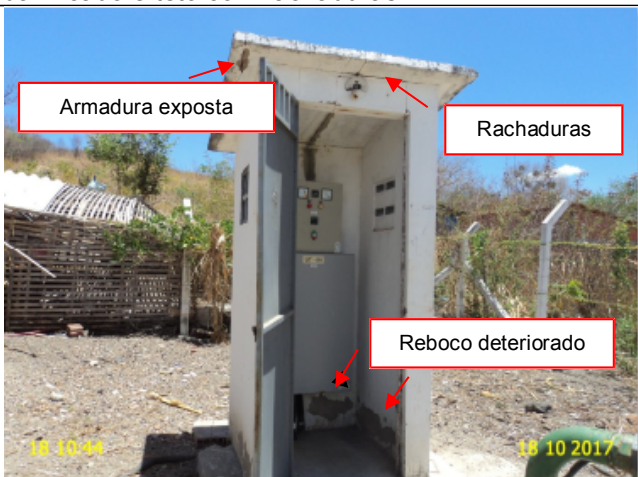
Foto 25 – PT-10: casa de abrigo com rachaduras, reboco deteriorado e armadura exposta.
