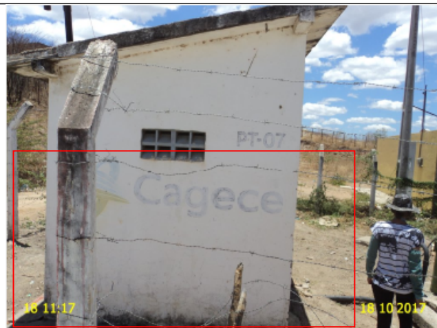
Foto 26 – PT-07: cerca danificada.
