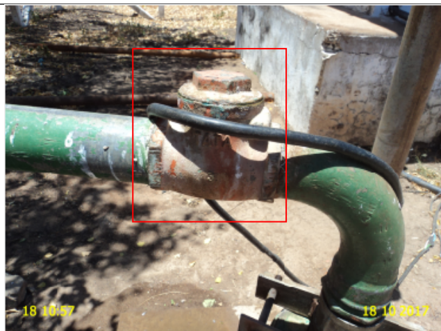
Foto 22 – PT-03: vazamento na tubulação.
