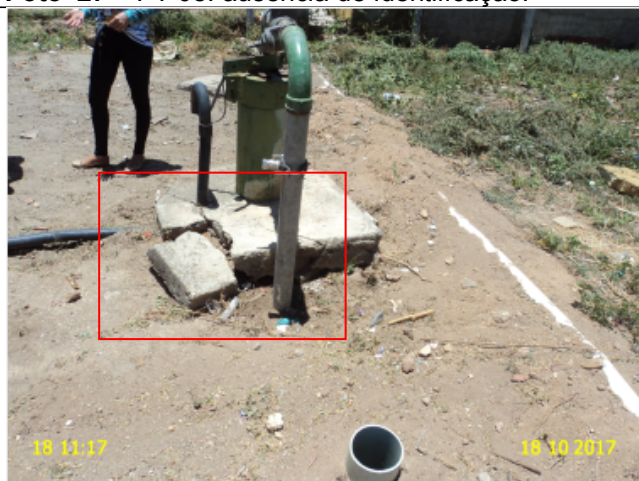
Foto 29 – PT-07: laje de proteção deteriorada.
