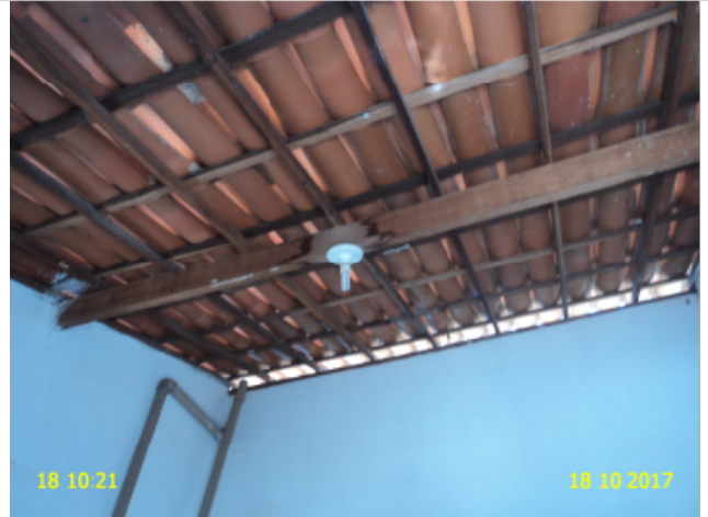
Foto 20 – EEAT-02: lâmpada apagada.
