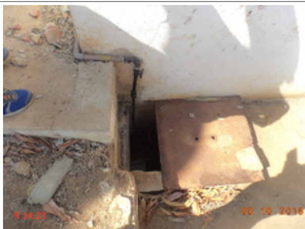
Foto 30 – Reservatório (Sede): REN 01: a tampa está em processo de corrosão.
