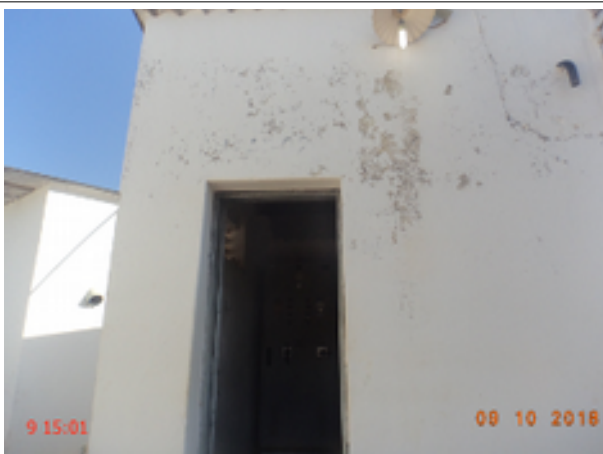
Foto 14 - Elevatória (Sede): EEAT-02 está sem identificação e com a pintura deteriorada.
