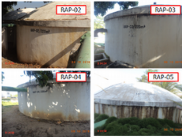
Foto 22 - Reservatórios (Sede): RAP-02; RAP-03, RAP-04, RAP-05 estão com a pintura deteriorada.
