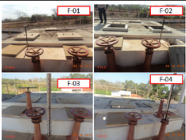
Foto 18 - Filtros (Sede): F-01, F-02, F-03 e F-04 não estão identificados.
