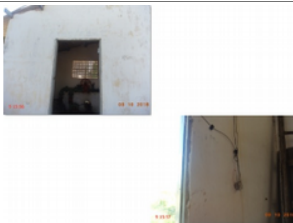
Foto 9 - Elevatórias (Sebastião de Abreu): As elevatórias EECS-01 e EEAT-01 estão com o interruptor solto e a pintura deteriorada.
