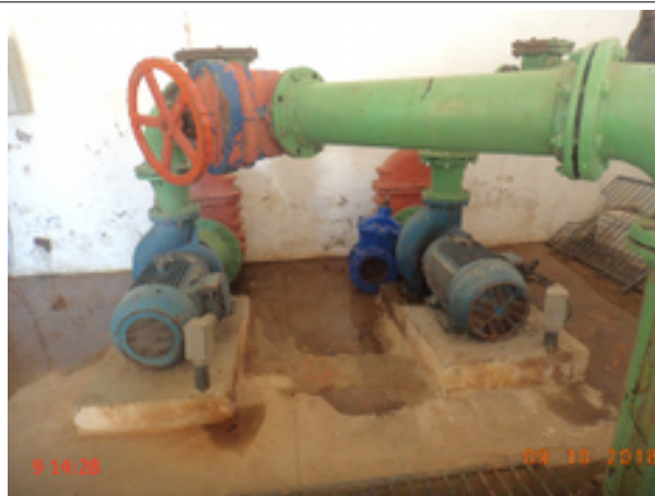
Foto 15 - EEAT-01 (Sede): Ocorre vazamento na elevatória EEAT-01.
