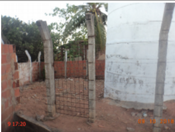
Foto 20 - Reservatório (Sebastião de Abreu): REL-01 está com a pintura deteriorada.
