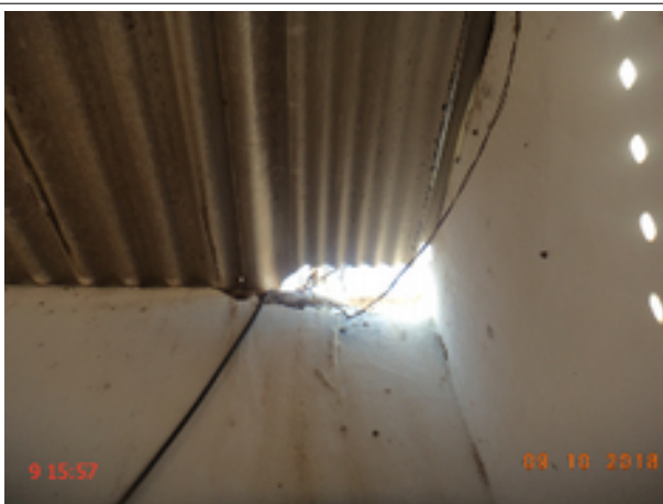
Foto 12 - Elevatória (Sebastião de Abreu): O telhado das elevatórias EECS-01 e EEAT-01 está quebrado.
