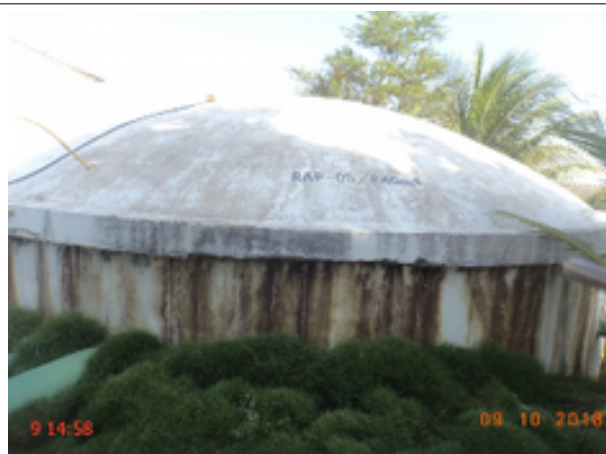
Foto 4 – Reservatório (Sede): RAP-05 não é dotado de tubulação de ventilação.
