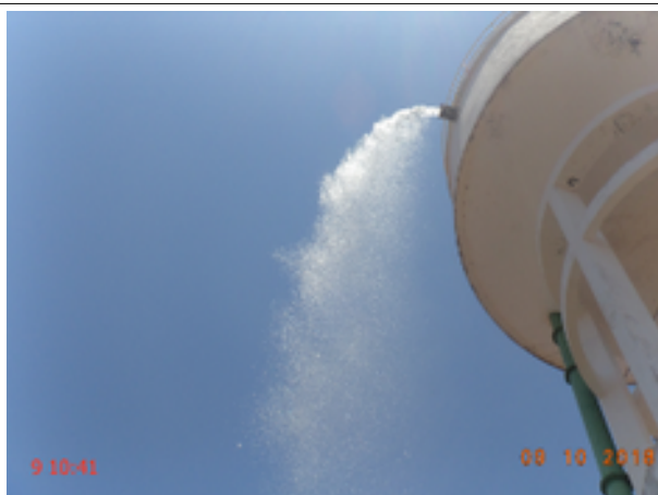
Foto 32 - Reservatório (Sede): Ocorreu extravasamento no REL-02 no dia da inspeção.
