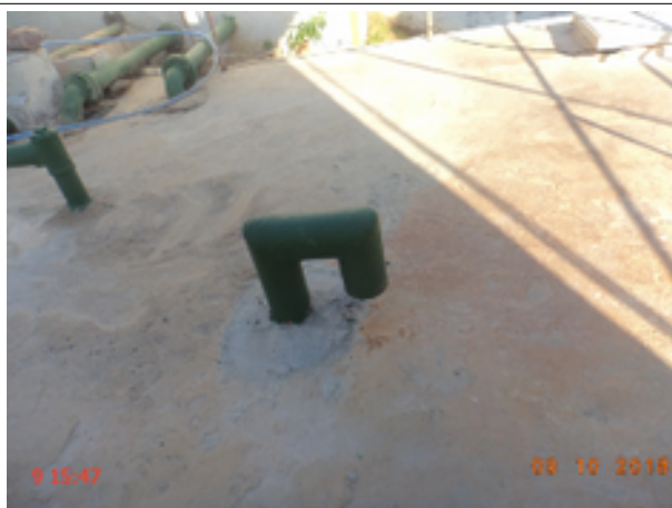
Foto 34 – Reservatório (Sebastião de Abreu): Não existe tela de proteção na tubulação de ventilação do reservatório RSE-01.
