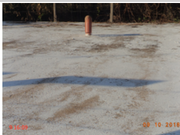
Foto 33 - Reservatório (Sebastião de Abreu): Não existe tela de proteção na tubulação de ventilação do reservatório RAP-01.
