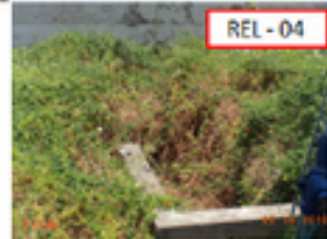
Foto 11 - Reservatório (Sede): Caixas de passagens sem tampa ou grade de proteção.
