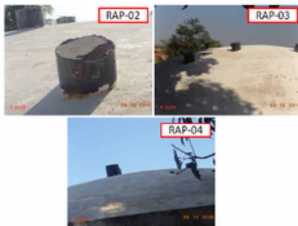
Foto 31 - Reservatórios (Sede): RAP-02, RAP-03 e RAP-04 estão com a tubulação de ventilação em processo de corrosão.
