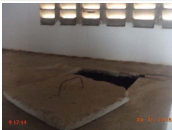
Foto 29 – Reservatório (Sebastião de Abreu): A tampa de inspeção do RSE-02 está aberta.
