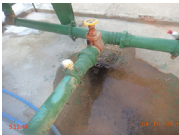
Foto 8 - Filtração (Sebastião de Abreu): Ocorre vazamento no registro localizado entre os filtros.
