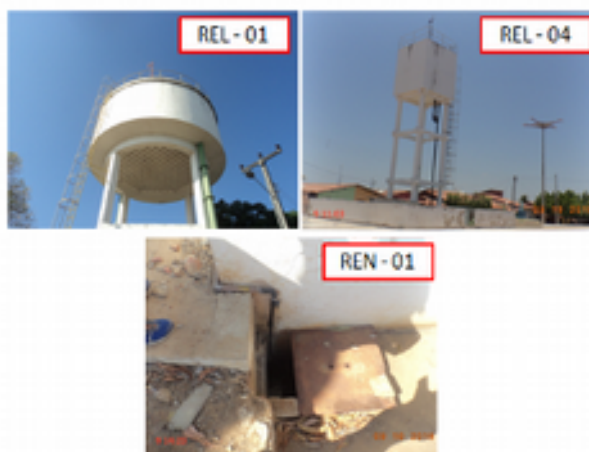
Foto 43 - Reservatório (Sede): REL-01, REL-04 e REN-01 estão com a Identificação pouco visível.
