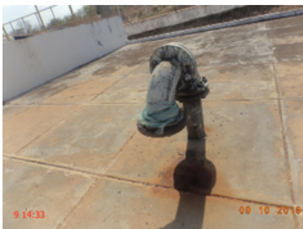
Foto 36 - Reservatório (Sede): Não existe tela de proteção na tubulação de ventilação do reservatório RAP-01.
