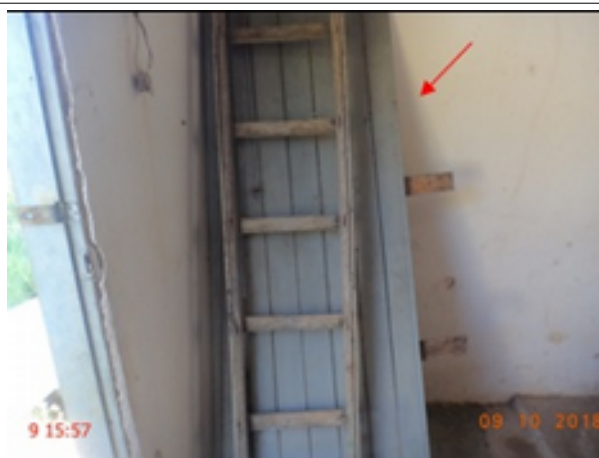
Foto 13 - Elevatória (Sebastião de Abreu): A porta das elevatórias EECS-01 e EEAT-01 não está fixada.
