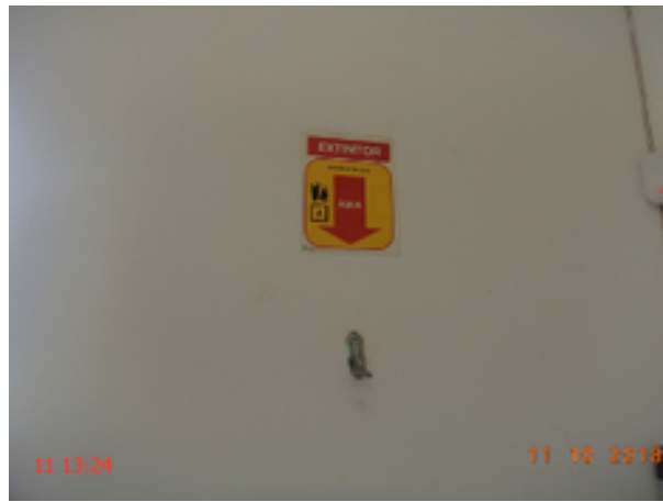
Foto 37 - Comercial (Sede): Não existe extintor de incêndio no almoxarifado e Loja de atendimento da Cagece.
