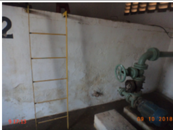
Foto 19 - Reservatório (Sebastião de Abreu): RSE-02 está com a pintura deteriorada.
