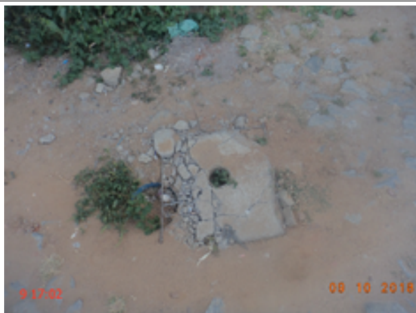
Foto 26 - RDA (Sebastião de Abreu): O registro de descarga localizado no endereço: Rua Campo Velho está com a tampa quebrada.
