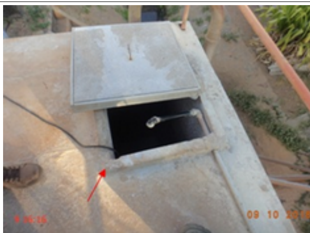
Foto 28 – Reservatório (Sebastião de Abreu): A tampa de inspeção do reservatório RSE-01 não garante vedação.
