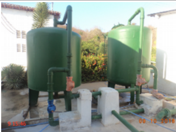
Foto 10 - Filtração (Sebastião de Abreu): Os filtros de Pressão FP-01 e FP-02 não estão identificados.
