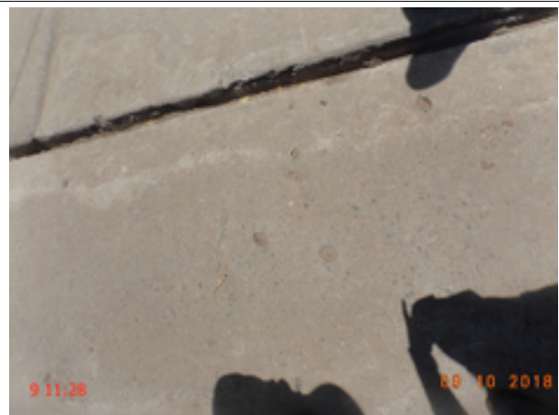
Foto 27 - RDA (Sede): O registro de descarga da Rua Agapito Cordeiro está fechado.
