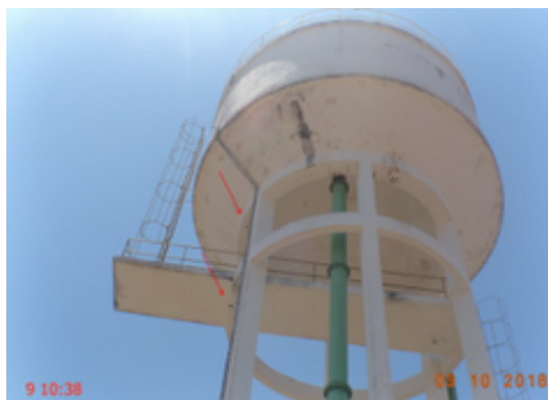
Foto 17 - Reservatório (Sede): REL-02 está sem o cabo do para-raio
