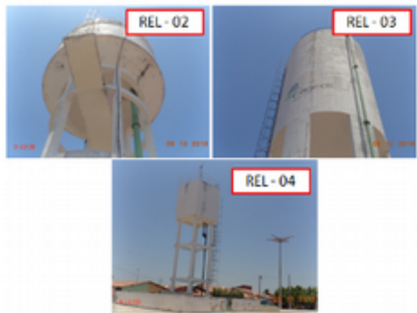
Foto 23 - Reservatórios (Sede): REL-02; REL-03, REL-04, RAP-05 estão com a pintura deteriorada.
