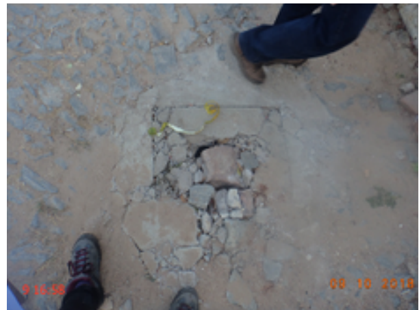
Foto 25 - RDA (Sebastião de Abreu): O registro de descarga localizado na Rua da Paz está com a tampa quebrada.
