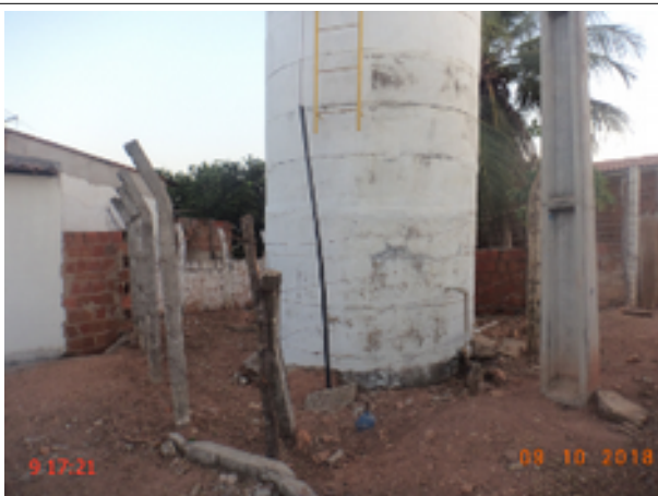
Foto 16 - Reservatório (Sebastião de abreu): A cerca do REL-01 está inadequada.
