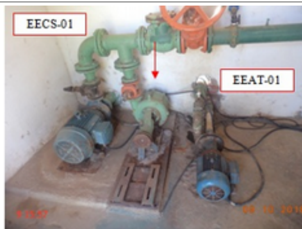
Foto 5 – Elevatória (Sebastião de Abreu): EECS-01 não é dotada de bomba reserva.
