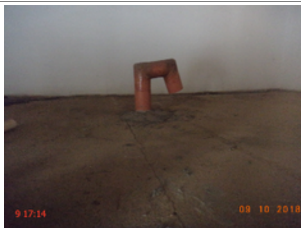
Foto 35 – Reservatório (Sebastião de Abreu): Não existe tela de proteção na tubulação de ventilação do reservatório RSE-02.
