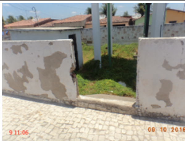
Foto 3 – Reservatório (Sede): A área do REL-04 está sem portão.
