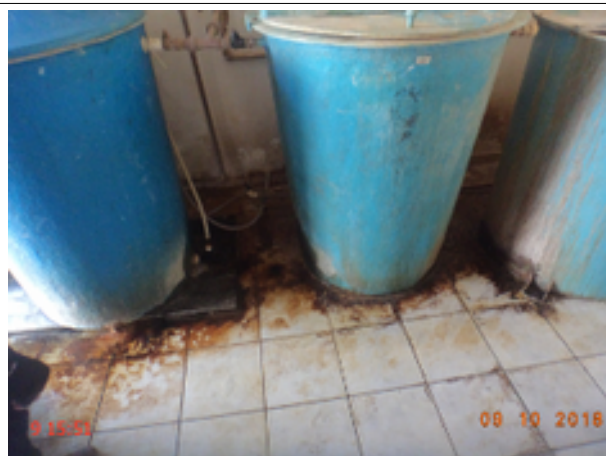
Foto 6 - ETA (Sebastião de Abreu): Ocorre vazamento nos tanques da casa de química.
