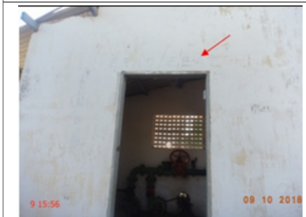
Foto 44 - Elevatórias (Sebastião de Abreu): EECS-01 e EEAT-01 estão com a Identificação pouco visível.
