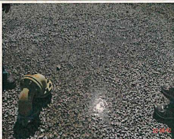
Foto 12 – RAP-03 (Sede): acúmulo de águas pluviais.
