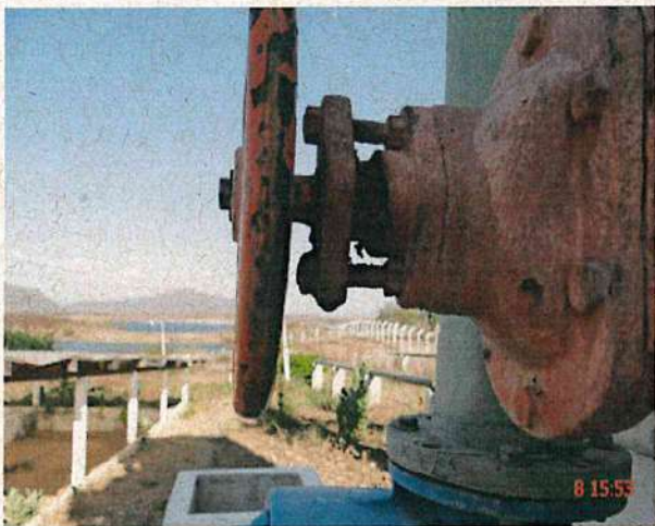
Foto 43 – F-01 (Sede): registro com sinais de vazamento.
