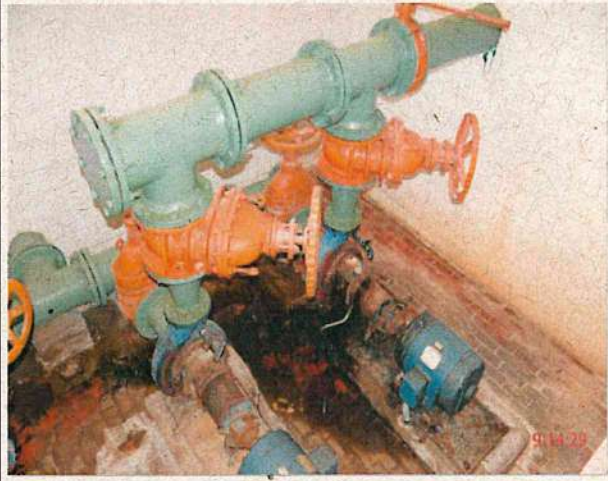
Foto 32 – EELF-01 (Macaraú): ausência de identificação e vazamento na gaxeta.
