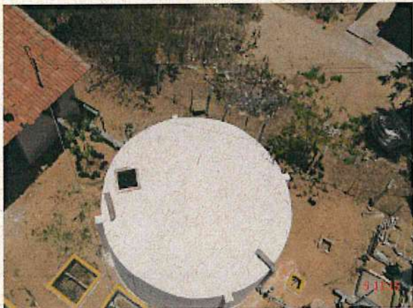
Foto 5 – RAP-01 (Lisieux): ausência de tampa de inspeção e de tubulação de ventilação.
