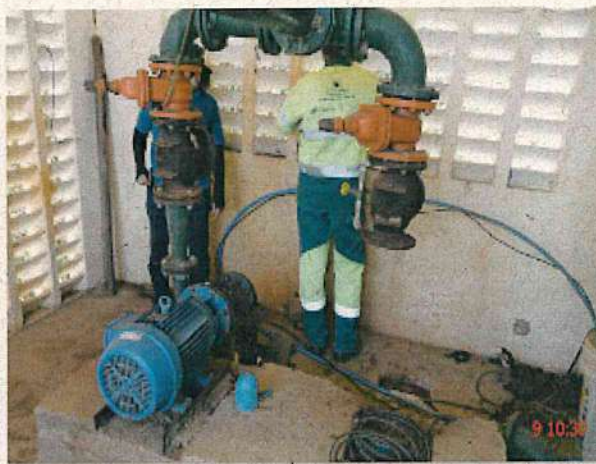
Foto 10 – EEAB-01 (Lisieux): ausência de bomba reserva.
