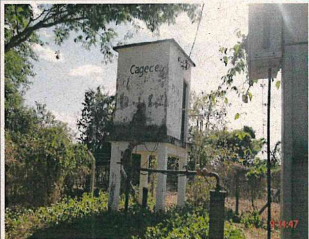
Foto 40 – PT-04 (Macaraú): pintura deteriorada e identificação apagada.
