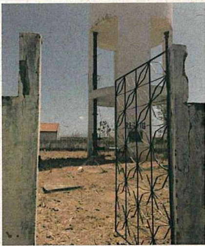
Foto 29 – REL-03 (Sede): muro de proteção com rachaduras, pintura e reboco deteriorados.
