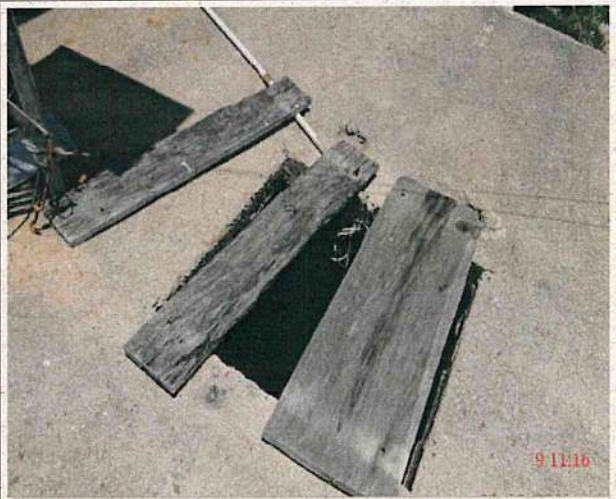
Foto 38 – REL-01 (Lisieux): tampa de inspeção inadequada.
