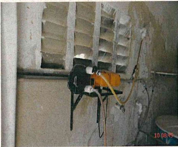
Foto 17 – REL-01 (Sede): bomba dosadora com defeito.
