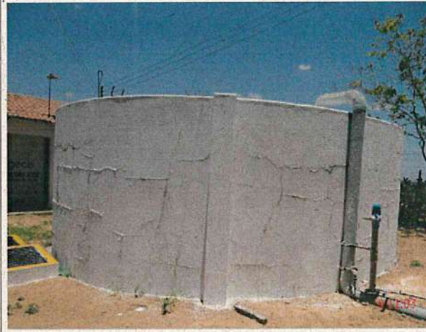
Foto 22 – RAP-01 (Lisieux): ausência de identificação e sinal de infiltração.
