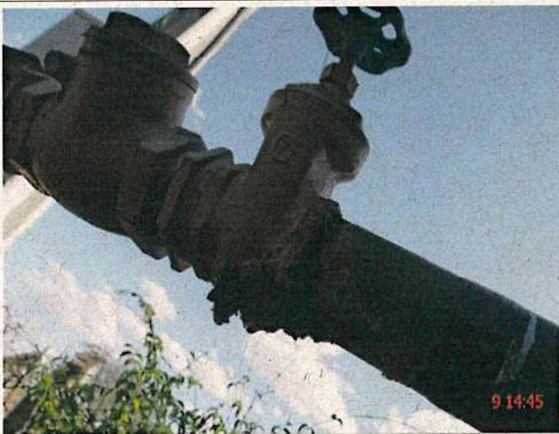
Foto 19 – PT-03 (Macaraú): sinais de vazamento no registro.
