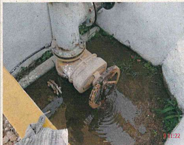
Foto 48 – REL-01 (Lisieux): registro com sinais de vazamento.
