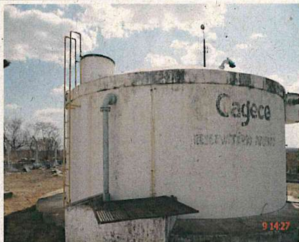
Foto 28 – RAP-01 (Macaraú): pintura deteriorada e identificação pouco visível.
