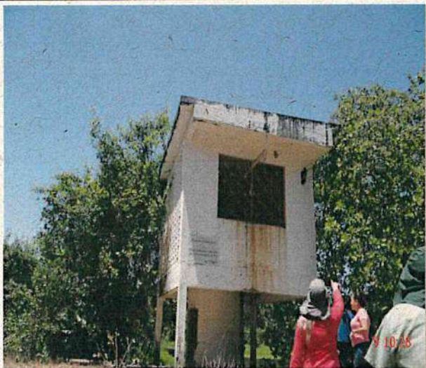
Foto 33 – EEAB-01 (Lisieux): ausência de identificação e pintura deteriorada.
