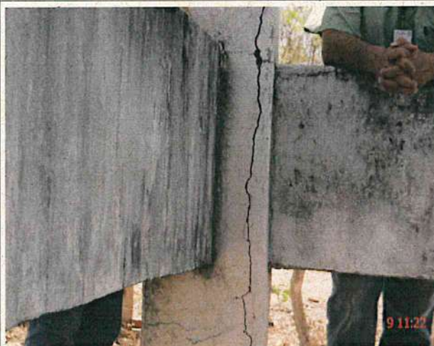
Foto 27 – REL-01 (Lisieux): rachaduras.
