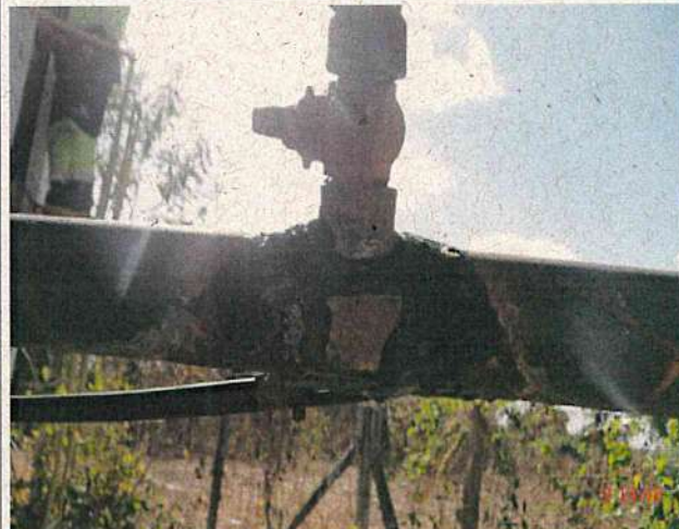
Foto 20 – PT-04 (Macaraú): sinais de vazamento no registro.
