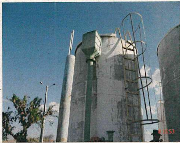
Foto 18 – F-01 (Sede): guarda-corpos danificado.
