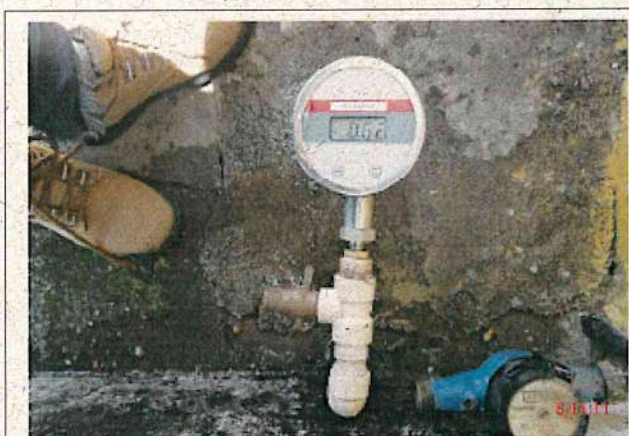
Foto 1 – RDA (Sede): pressão fora da faixa de 10 a 50 mca no endereço Rua Luis Lobo Catunda, SMS 6 – Flores.
