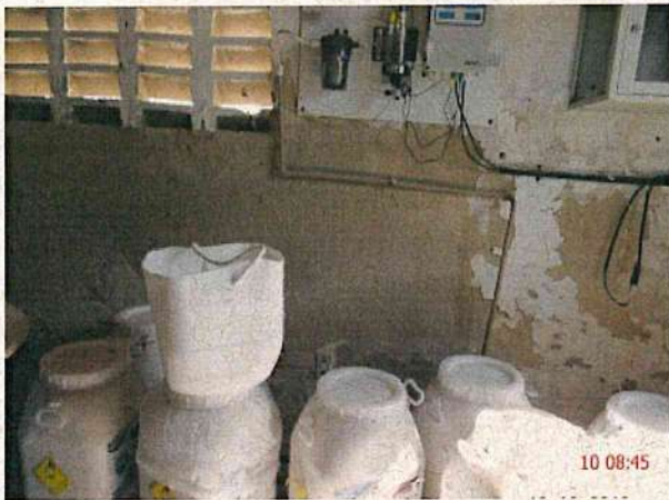
Foto 41 – REL-01 (Sede): casa de abrigo dos produtos químicos com pintura e reboco deteriorados.
