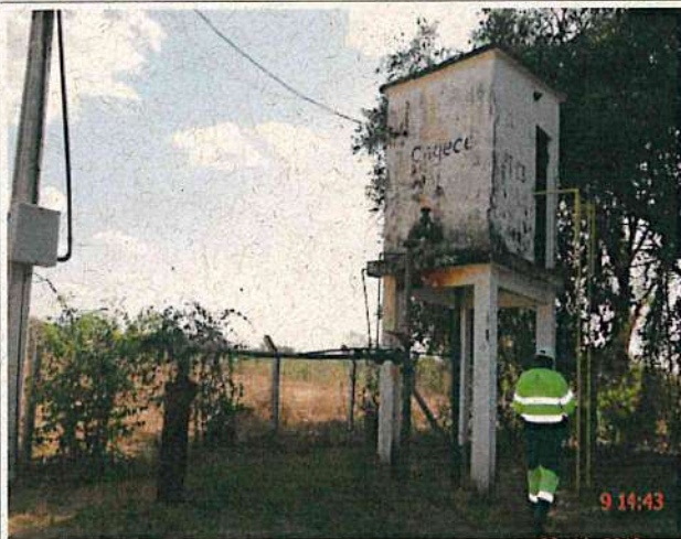
Foto 39 – PT-03 (Macaraú): pintura deteriorada e identificação apagada.
