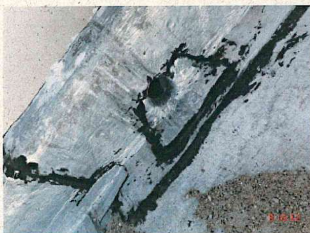
Foto 11 – RAP-01 (Sede): tubulação inadequada para escoamento das águas pluviais.
