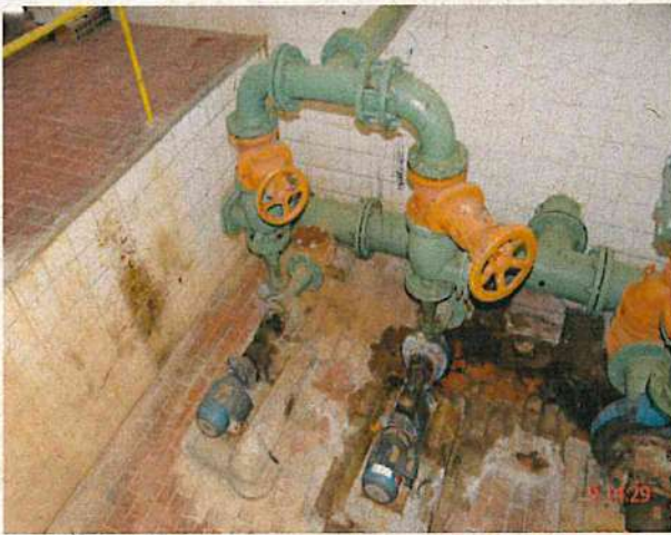
Foto 31 – EEAT-01 (Macaraú): ausência de identificação e vazamento na gaxeta.
