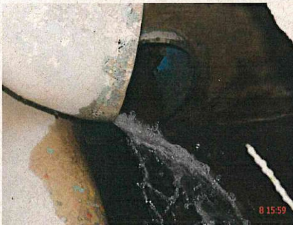
Foto 45 – F-05 (Sede): registro sem vedação adequada.
