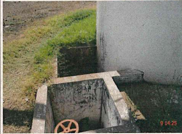
Foto 42 – F-01 (Macaraú): caixas de inspeção sem tampa ou grade de proteção.
