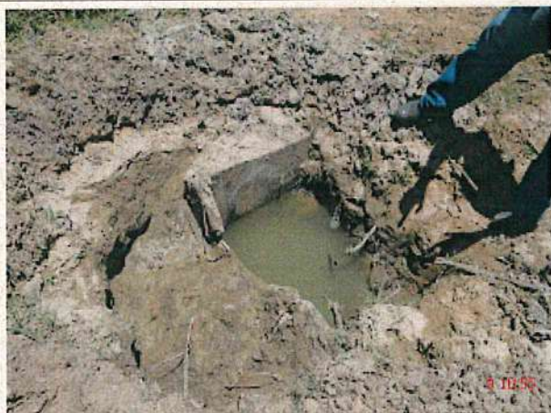
Foto 15 – AAB (Lisieux): caixa deteriorada e vazamento.
