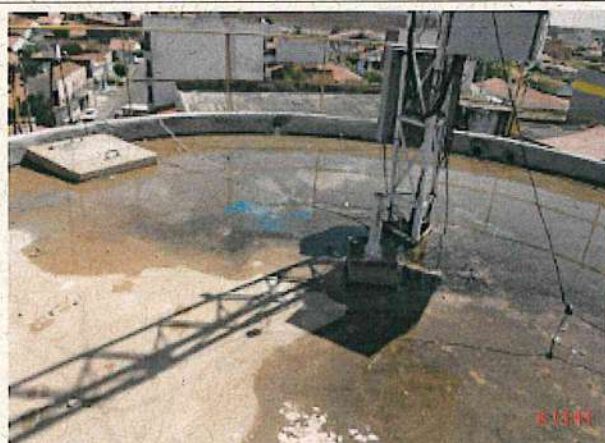
Foto 13 – REL-02 (Sede): ausência de tubulação de ventilação e acúmulo de águas pluviais.
