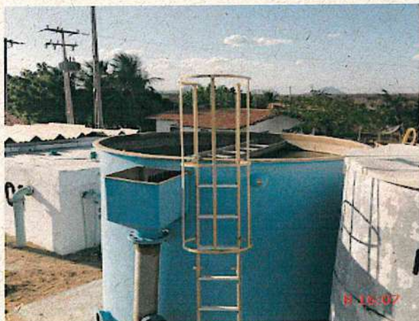
Foto 9 – F-03 (Sede): ausência de tampa.
