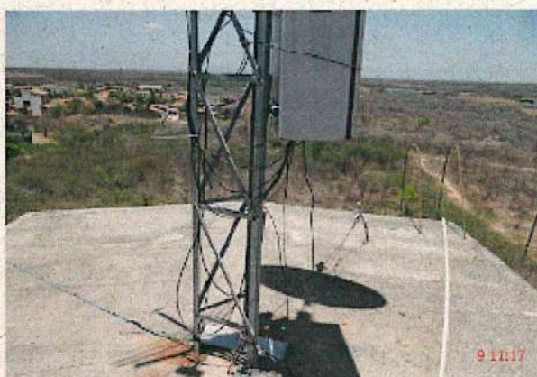
Foto 14 – REL-01 (Lisieux): ausência de guarda-corpo e de tubulação de ventilação.
