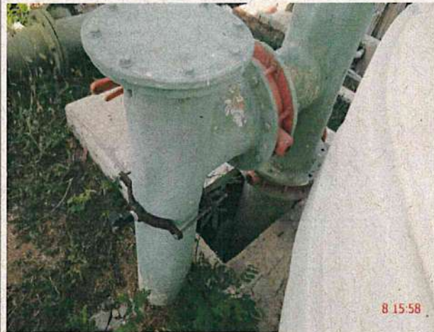
Foto 44 – F-04 (Sede): registro sem vedação adequada.
