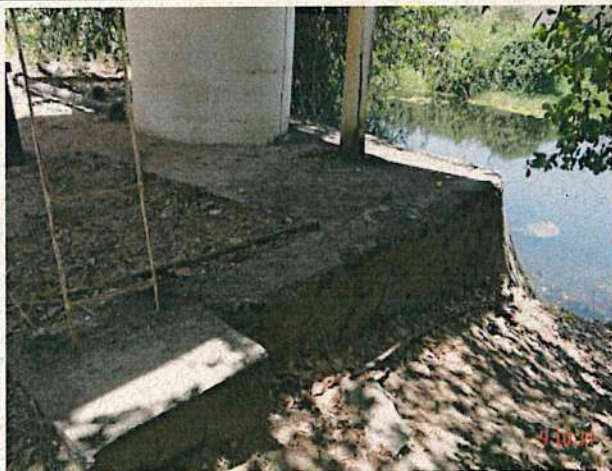
Foto 21 – PR-01 (Lisieux): ausência de identificação
