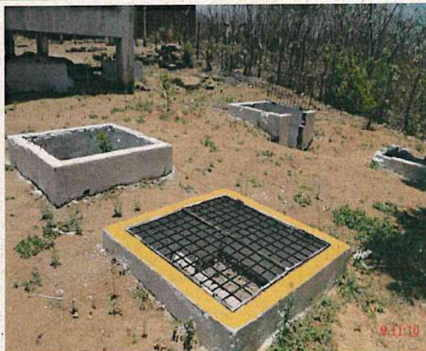
Foto 24 – AAT (Lisieux): caixas sem tampas ou grades.
