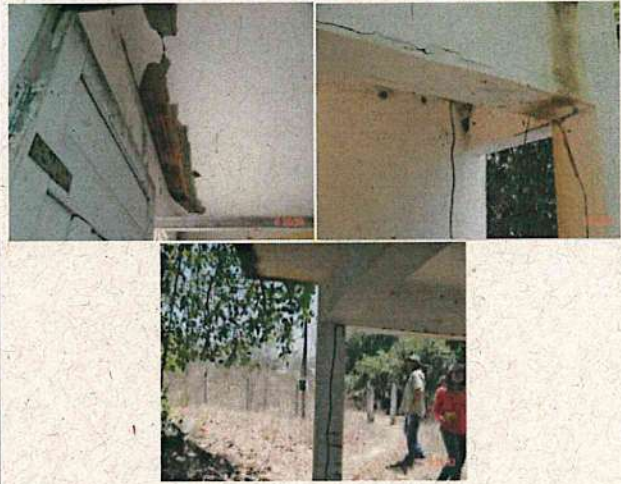
Foto 30 – EEAB-01 (Lisieux): estrutura deteriorada, rachaduras, cupins e armadura exposta.
