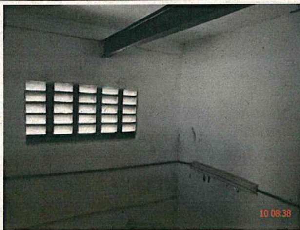
Foto 47 – EEAT-02 (Sede): ausência de iluminação.
