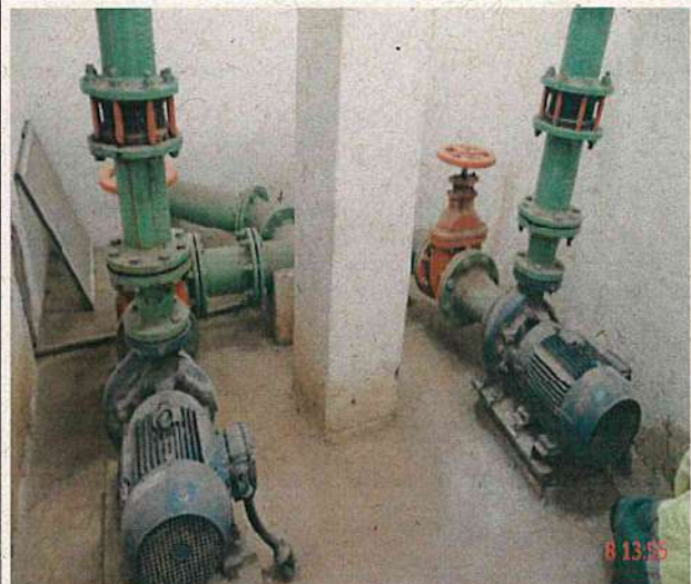
Foto 34 – EEAT-03 (Sede): ausência de identificação.
