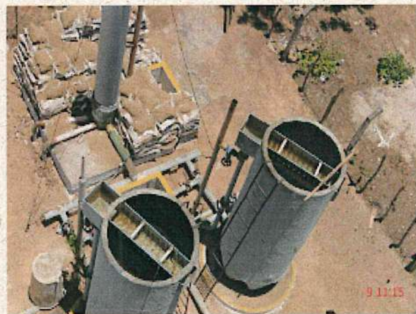
Foto 8 – F-01 e F-02 (Lisieux): ausência de tampas.
