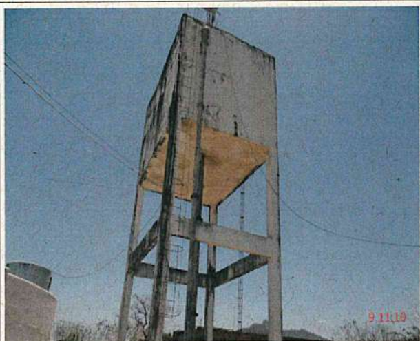
Foto 23 – REL-01 (Lisieux): ausência de identificação e pintura deteriorada.
