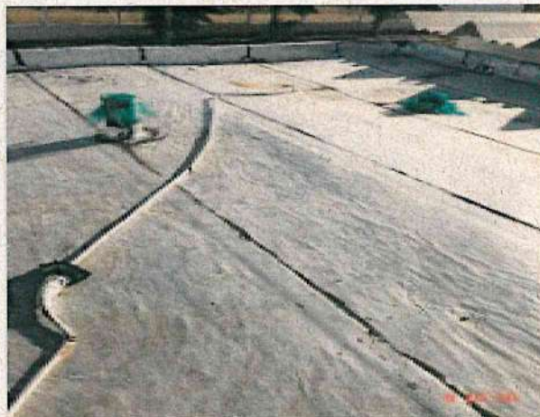
Foto 16 – RAP-01 (Sede): tubulações de ventilação inadequadas.
