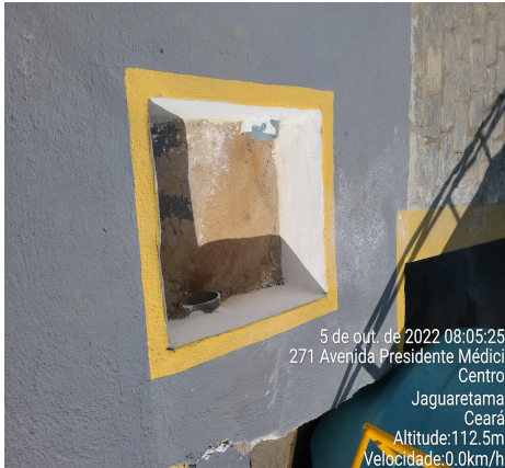
Foto 2 - ETA: Caixa de passagem sem tampa/grade.
