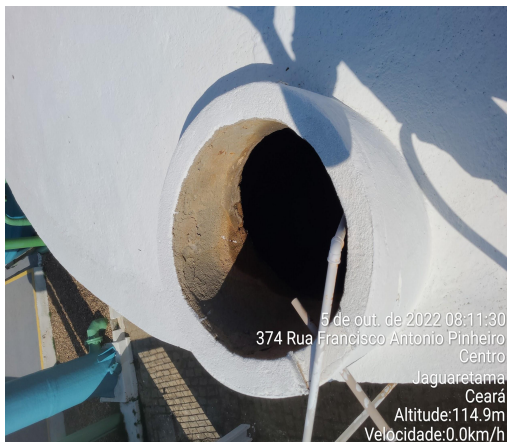
Foto 7 - RAP-01: Ausência de tampa.
