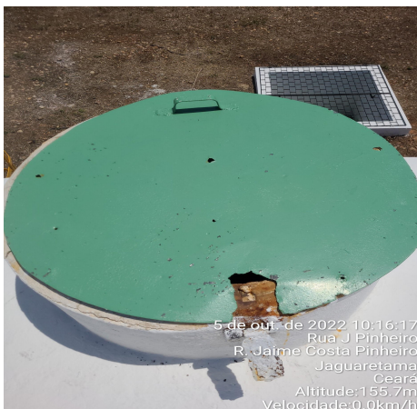
Foto 5 - RSE-01: Tampa sem vedação.
