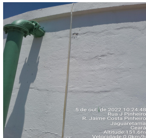
Foto 6 - RSE-01: Mangueira sem possibilidade de aferição de nível.
