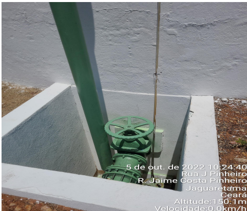
Foto 4 - RSE-01: Caixa de registro sem tampa/grade.
