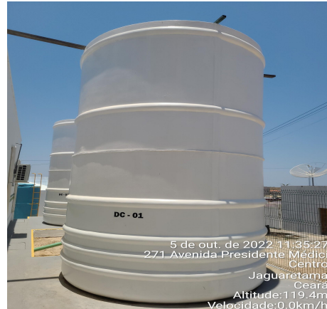
Foto 3 - ETA: Ausência de escadas nos decantadores.
