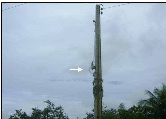
Foto 50 – REL-01: Iluminação noturna danificada.
