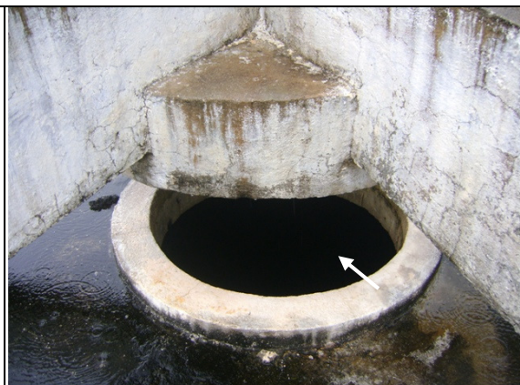
Foto 45 – REL-01: Orifício sem tampa de proteção.
