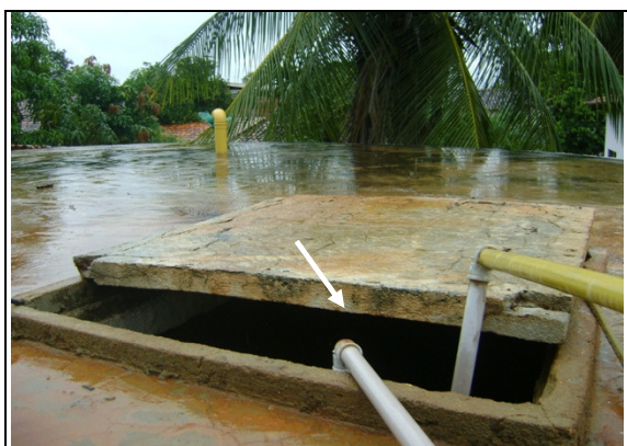
Foto 40 – Entrada inadequada das tubulações de produto químico, o que impossibilita fechar o acesso à inspeção.
