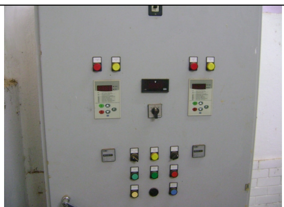
Foto 34 – Quadro de comando da EEAT-02.
