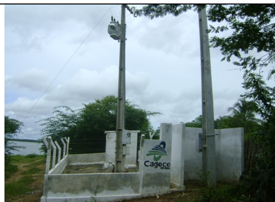
Foto 26 – Vista da EECS-01.
