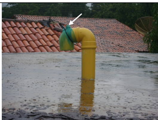
Foto 39 – RAP-01: Tubulação de ventilação com tela de proteção.
