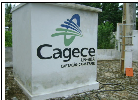
Foto 27 – Casa do quadro de comando da EECS-01
