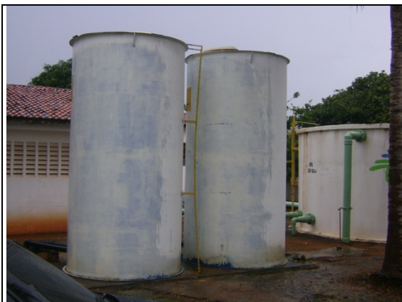
Foto 5 – ETA: filtro sem identificação.
