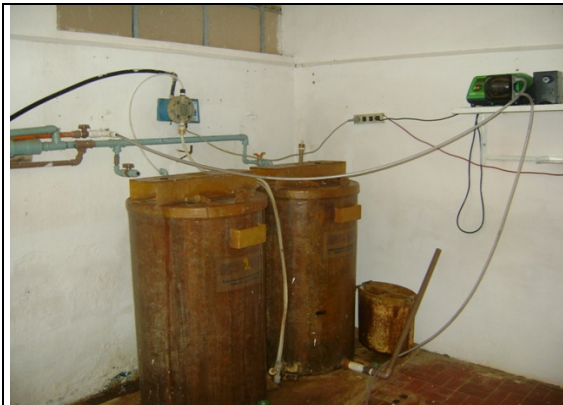
Foto 20 – Tanques de dosagens na casa de química.
