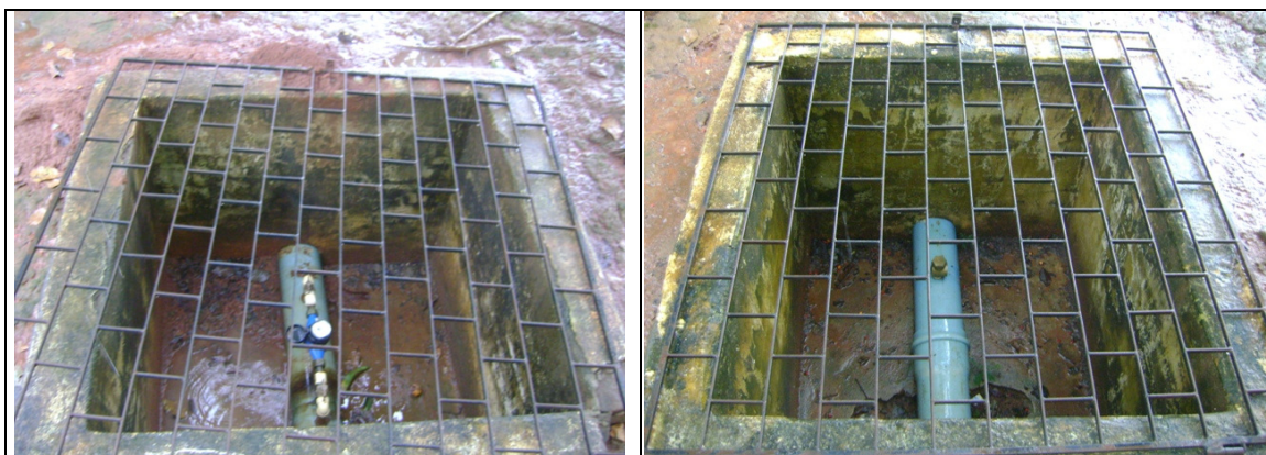
Foto 23 – Medidor proporcional e estação pitométrica localizados na saída do REL-01.
