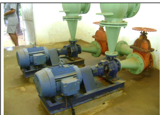
Foto 33 – Conjunto moto-bomba da EEAT-02.
