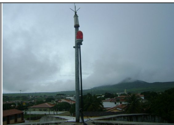
Foto 47 – REL-01: Para-raios e sinalizador noturno.
