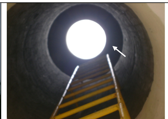
Foto 51 – REL-02: Orifício sem tampa de proteção.
