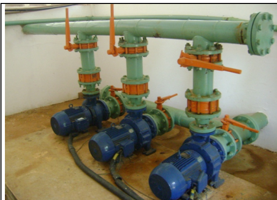
Foto 29 – Conjunto moto-bomba da EEAT-01.
