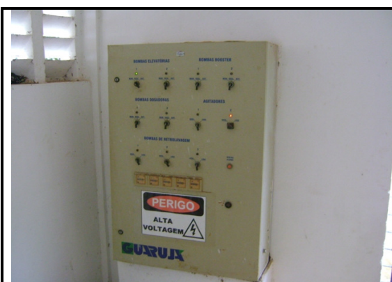
Foto 31 – Quadro de comando da EEAT-01 e EELF-01.
