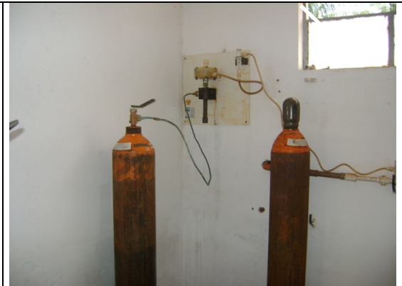
Foto 17 – Dosador de cloro.
