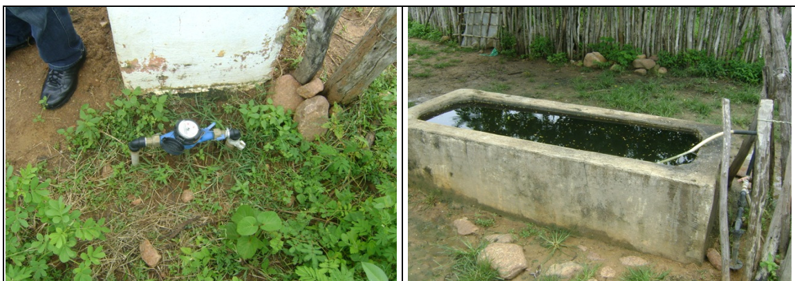
Foto 22 – Hidrômetro instalado no ramal de alimentação de água bruta e o Tanque utilizado para sedimentação de animais.
