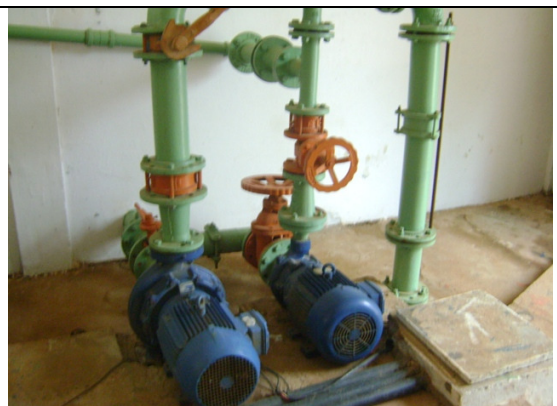
Foto 30 – Conjunto moto-bomba da EELF-01.
