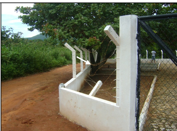
Foto 49 – REL-02: Cerca danificada.
