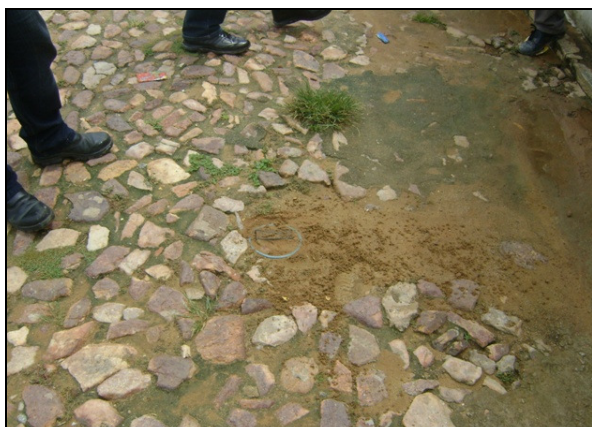
Foto 56 – Registro de descarga sem tampa e praticamente soterrado, localizado na Rua Dona Videlina.
