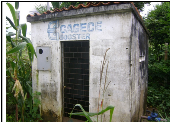
Foto 35 – Casa do quadro de comando e do conjunto moto-bomba da EEAT-03.
