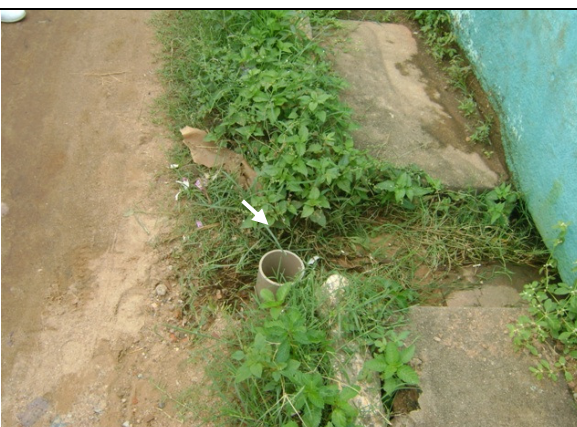
Foto 57 – Registro de descarga sem tampa de proteção localizada na Rua Vila São Francisco.
