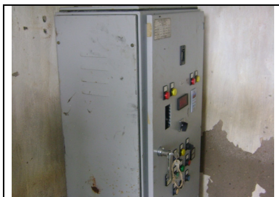
Foto 37 – Quadro de comando da EEAT-03.
