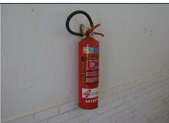
Foto 32 – Extintor de incêndio das EEAT-01 e EELF-01.
