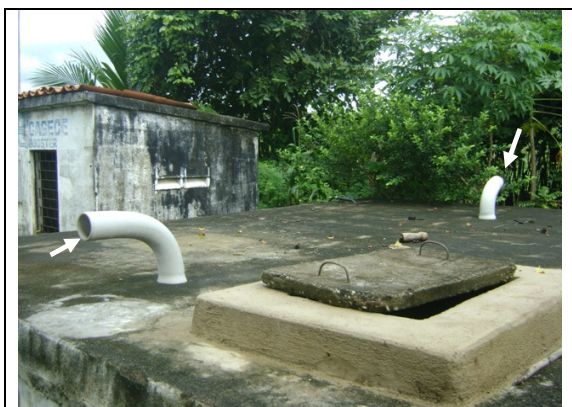
Foto 43 – RAP-02: Tubulação de ventilação inadequada.
