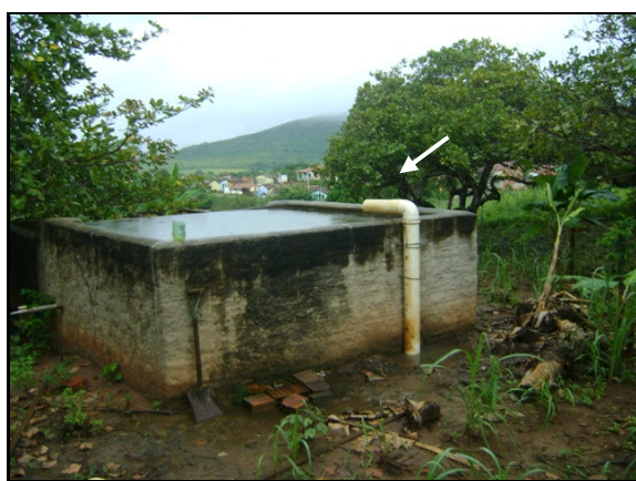
Foto 7 – Tanque de recepção das águas de lavagem dos filtros, localizado no terreno vizinho à ETA.
