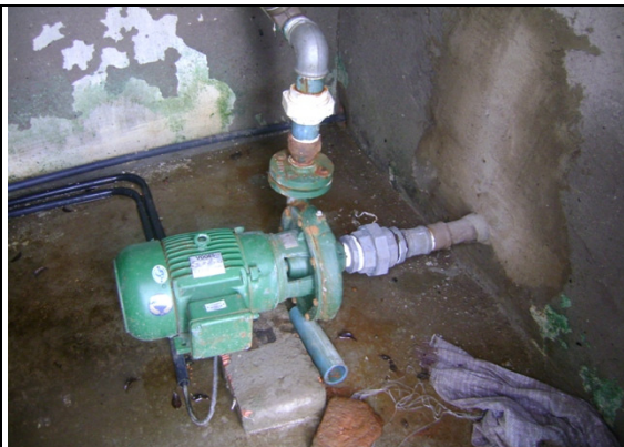
Foto 36 – Conjunto moto-bomba da EEAT-03.
