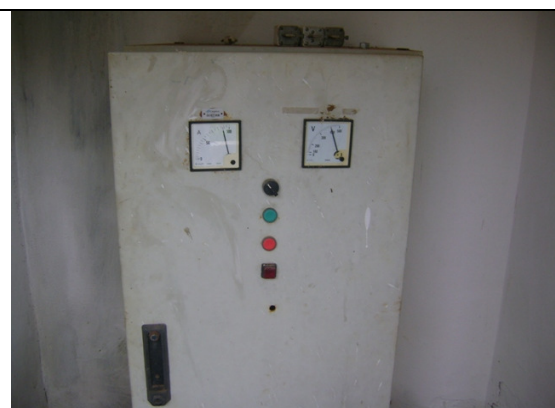
Foto 28 – Quadro de comando da EECS-01.
