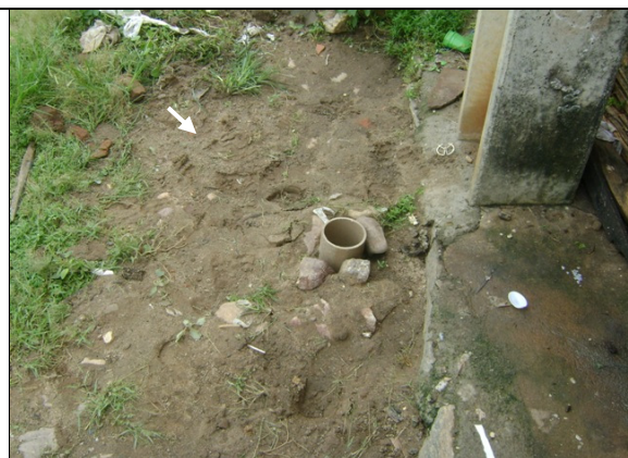
Foto 55 – Registro de descarga sem tampa de proteção localizada na Rua Vereador Francisco N. Cavalcante.
