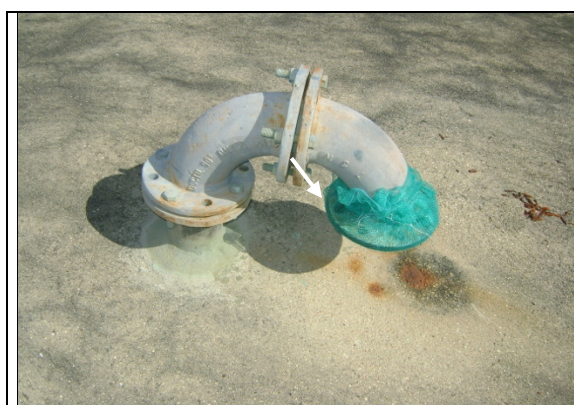
Foto 37 – RAP-02: Tubulação de ventilação com tela de proteção.
