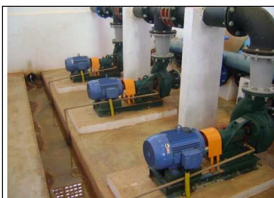
Foto 27 – EELF-01: Conjuntos moto-bomba.
