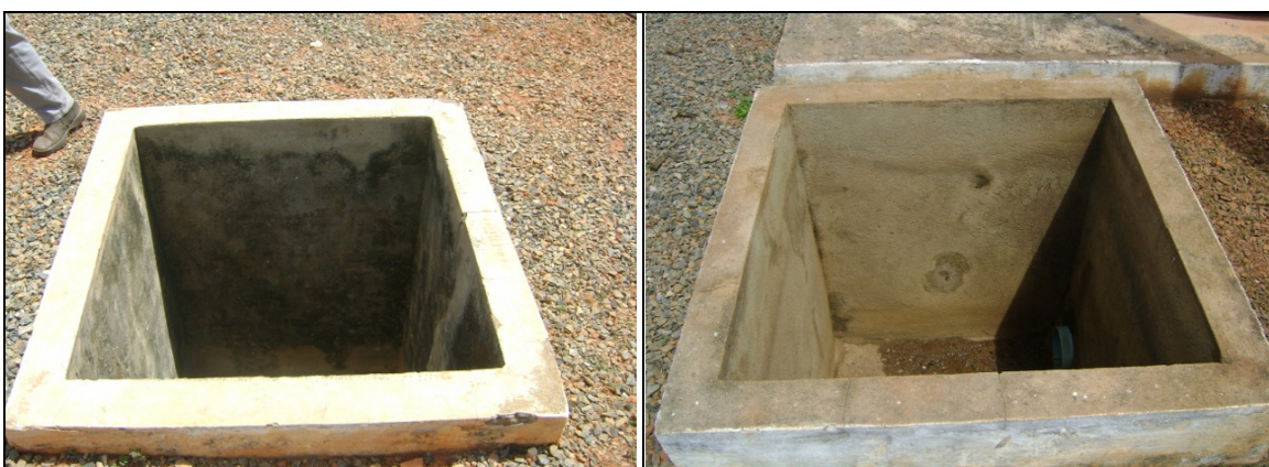
Fotos 4 e 5 – Caixas de inspeção sem tampa na área da ETA.
