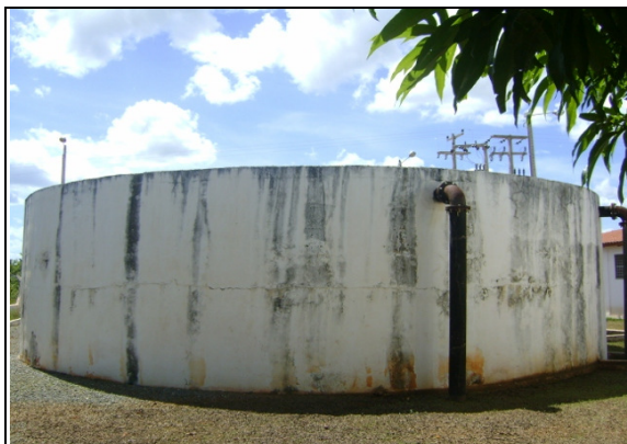
Foto 30 – RAP-01: sem identificação e com pintura deteriorada.
