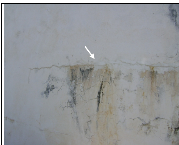
Foto 32 – RAP-01: fissura e ocorrência de infiltrações.
