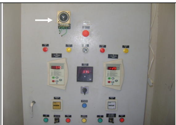
Foto 29 – EEAT-02: Quadro de comando, apresentando timer .
