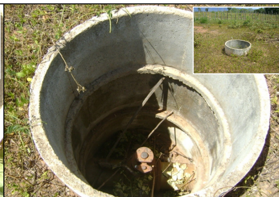
Foto 21 – Caixa de inspeção de ventosa da adutora de água bruta: sem tampa.
