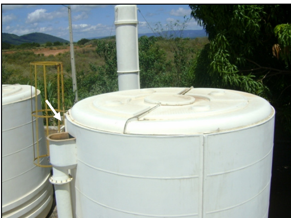
Foto 8 – Filtro 2: Sem tampa de proteção na caixa de saída de água tratada.
