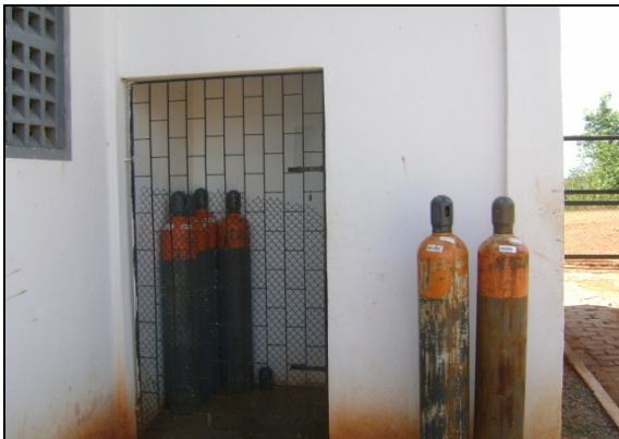
Foto 16 – Extintor de incêndio da ETA e Cilindros de cloro gasoso.
