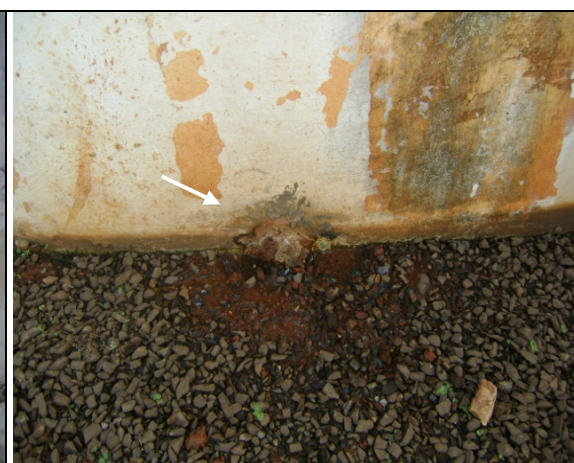
Foto 33 – RAP-01: vazamento na base.
