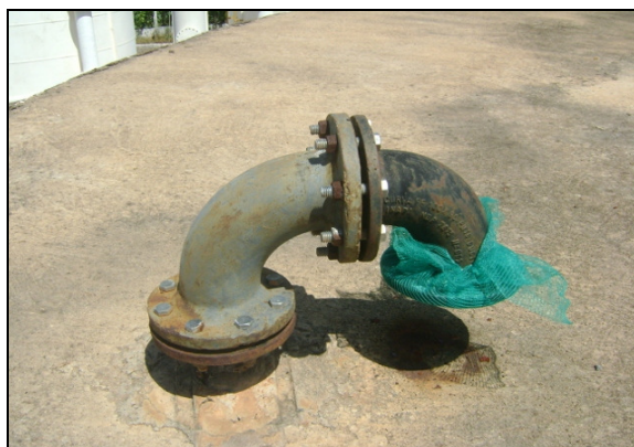
Foto 34 – RAP-01: Tubulação de ventilação com tela de proteção.
