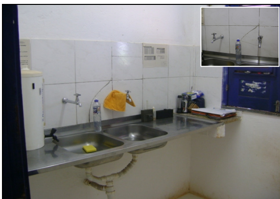
Foto 10 – Laboratório: sem água bruta e tratada em suas respectivas torneiras.
