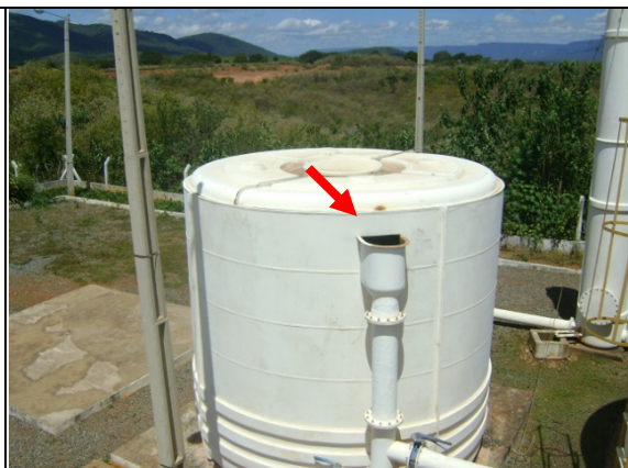
Foto 7 – Filtro 01: Ausência de escada de acesso e de tampa de proteção na caixa de saída de água tratada.
