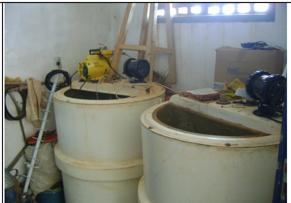
Foto 15 – Tanques de mistura de produtos químicos desativados.
