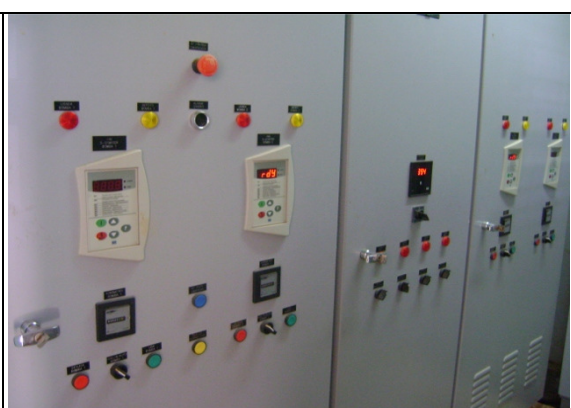
Foto 26 – EELF-01: Quadro de comando.
