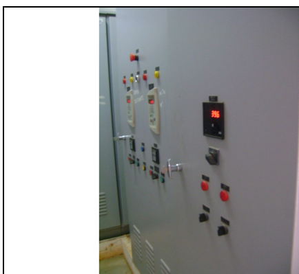
Foto 23 – EECS-01: Quadro de comando.
