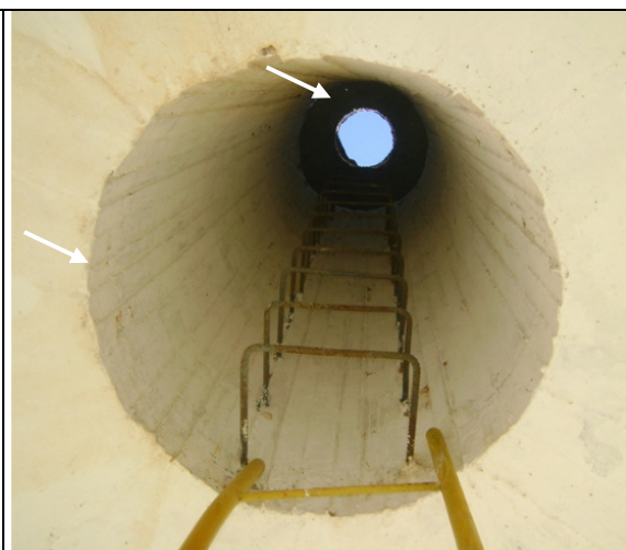
Foto 39 – REL-01: Acesso interno à laje superior: ausência de tampa na laje superior e de tela de proteção.
