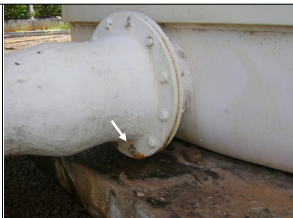
Foto 9 – Filtro 02: Vazamento na tubulação de entrada.
