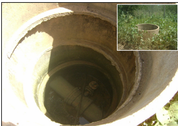
Foto 20 – Caixa de inspeção de registro de descarga da adutora de água bruta: sem tampa.
