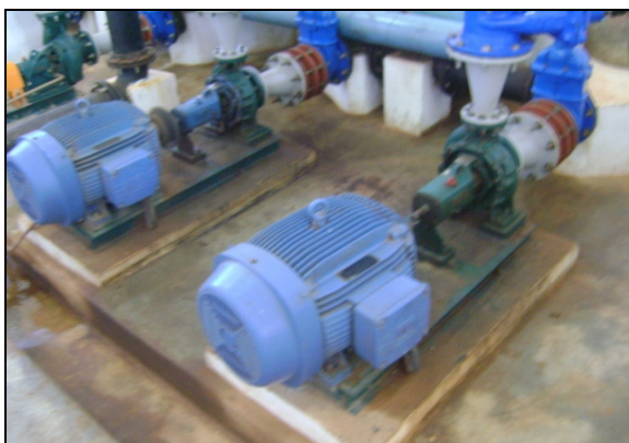
Foto 25 – EEAT-01: Conjuntos moto-bomba.
