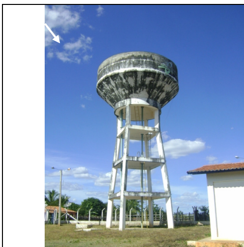
Foto 38 – REL-01: Sem de identificação e com pintura deteriorada.
