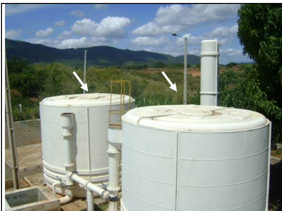
Foto 6 – Filtros 01 e 02: Ausência de identificação.
