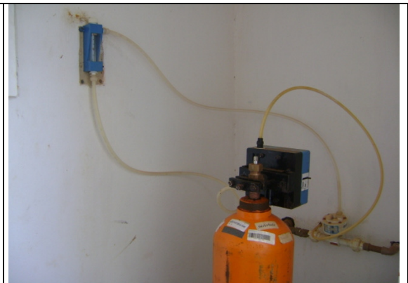
Foto 17 – Dosador de cloro gasoso.
