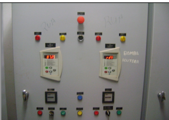
Foto 26 – EEAT-01: Quadro de comando.
