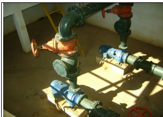
Foto 28 – EEAT-02: Conjuntos moto-bomba.
