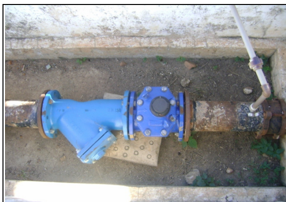
Foto 22 – Macromedidor de água tratada, localizado na entrada do RAP-02.
