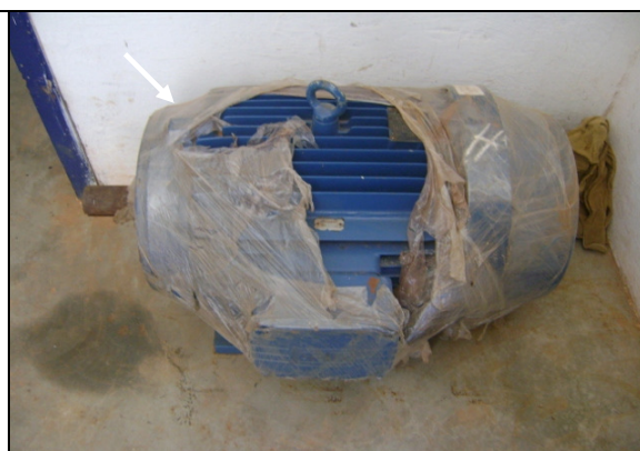
Foto 24 – EECS-01: Conjunto moto-bomba reserva, localizado na ETA.
