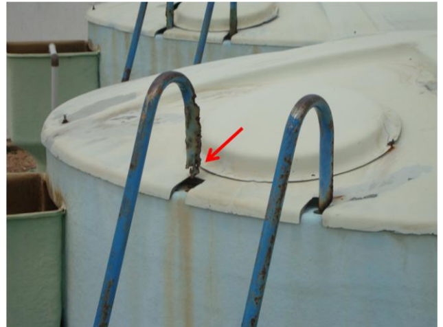
Foto 13 – Escada de acesso em processo de corrosão.
