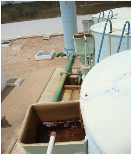
Foto 12 – Vista superior dos filtros 01, 02 e 03.
