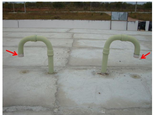
Foto 50 – RSE-02: tubulação de ventilação com vedação.
