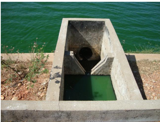
Foto 125 – ETE: poço de chegada da lagoa de maturação 02.
