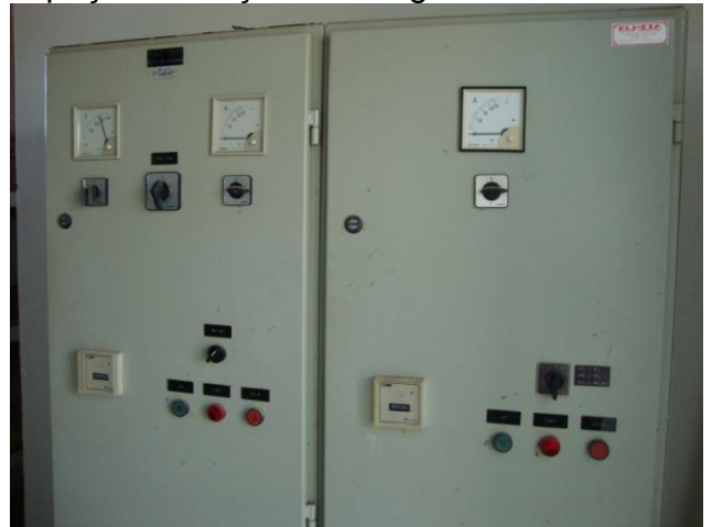
Foto 103 – EEE-03: quadro de comando das bombas.
