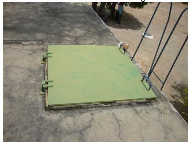
Foto 46 – RSE-01: com tampa de vedação adequada.
