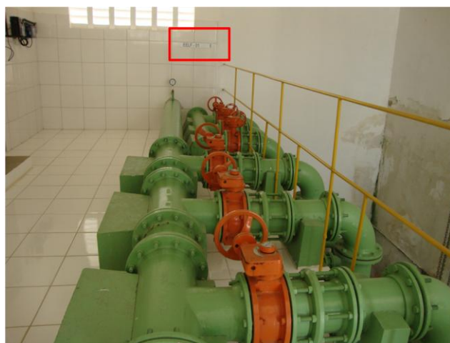
Foto 39 – Identificação das elevatórias EEA-01 e EELF-01.
