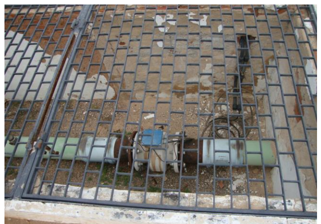
Foto 34 – Caixa de inspeção do macromedidor para lavagem dos filtros.
