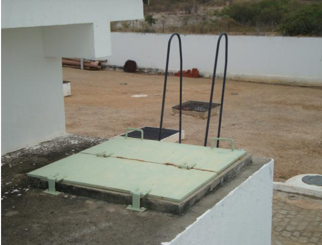
Foto 53 – Tanque de reunião com tampa adequadamente vedada.
