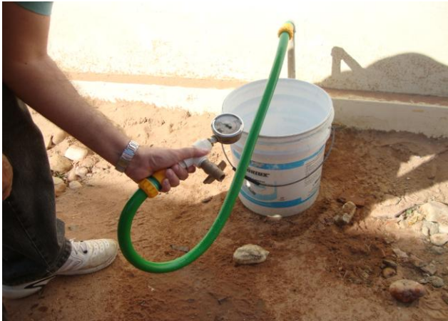
Foto 65 – Medição de pressão na Rua Porcínio Fernandes Maia, nº 348 – Centro.
