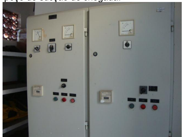
Foto 93 – EEE-02: quadro de comando das bombas.
