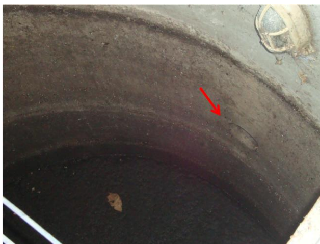
Foto 92 – EEE-02: extravasador do poço de visita de chegada.
