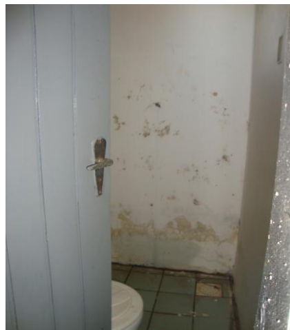
Foto 105 – EEE-03: Instalação sanitária para os operadores.
