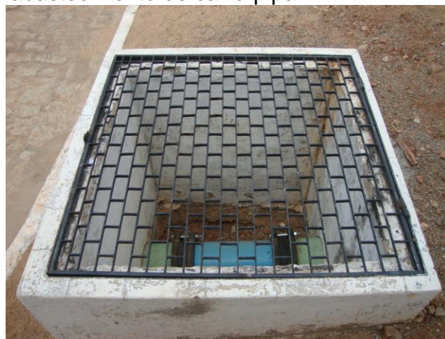
Foto 38 – Caixa da estação pitométrica de água tratada no interior da ETA.
