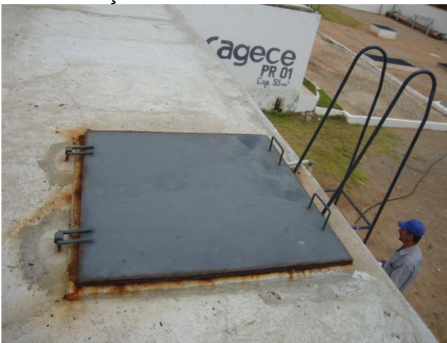
Foto 49 – RSE-02: com tampa adequadamente vedada.
