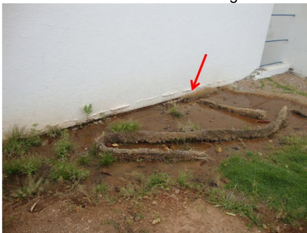
Foto 45 – RSE-01 com vazamento.
