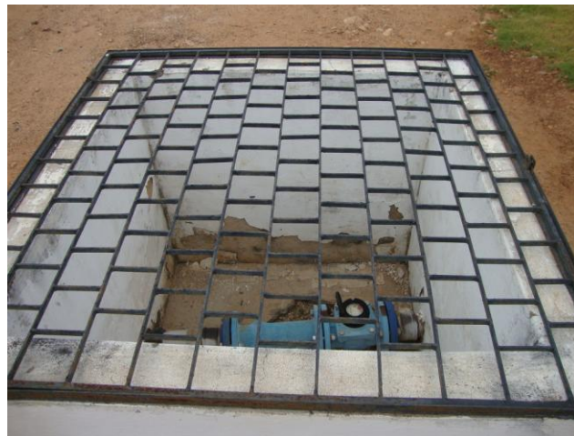
Foto 36 – Caixa do macromedidor para o abastecimento de carro-pipa.
