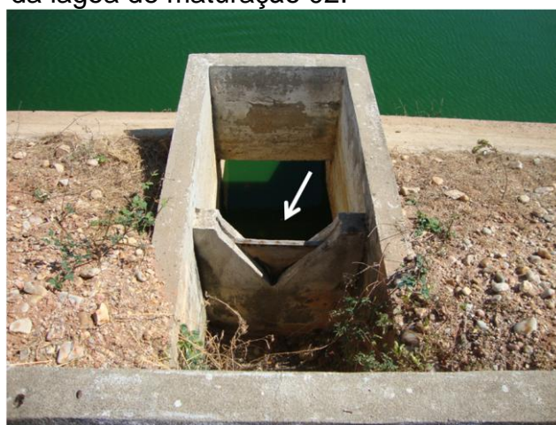
Foto 128 – ETE: poço de saída da lagoa de maturação 02, com passagem obstruída.
