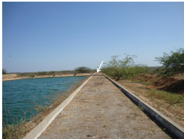
Foto 124 – Adaptação provisória para a saída do esgoto tratado de maturação 02 para o corpo receptor.
