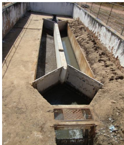
Foto 114 – ETE: caixa de areia.
