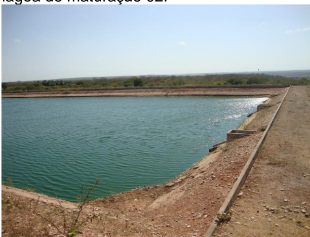
Foto 127 – ETE: vista da lagoa de maturação 02.
