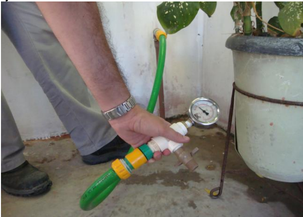
Foto 61 – Medição de pressão na Rua Zacarias Silveira, nº 115 – Centro.
