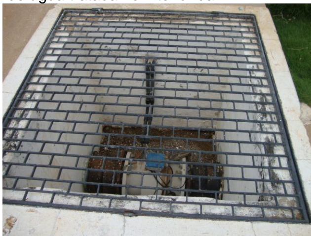
Foto 37 – Caixa de inspeção do macromedidor na saída da ETA.
