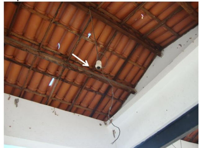
Foto 87 – EEE-01: ausência de iluminação.
