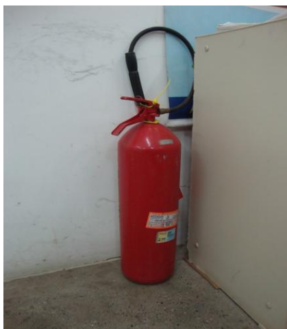
Foto 138 – Extintor de incêndio da loja de atendimento com validade até jun/2017.
