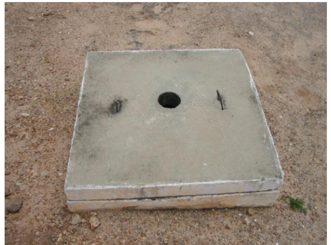
Foto 32 – Estação pitométrica de água bruta na entrada da ETA.
