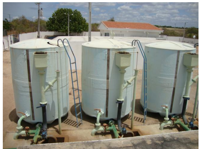
Foto 11 – Vista frontal dos filtros 01, 02 e 03 de fluxo ascendente.
