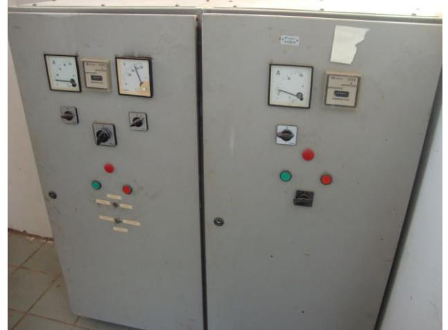
Foto 83 – EEE-01: quadro de comando das bombas.
