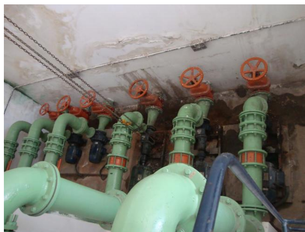
Foto 40 – Conjunto motor-bomba das EEA-01 e EELF-01.
