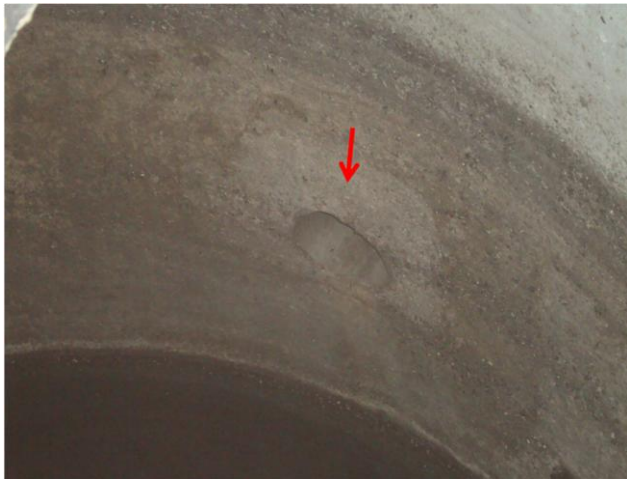
Foto 102 – EEE-03: extravasador do poço de visita de chegada.
