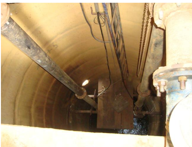
Foto 5 – Vista interna do Poço Amazonas.
