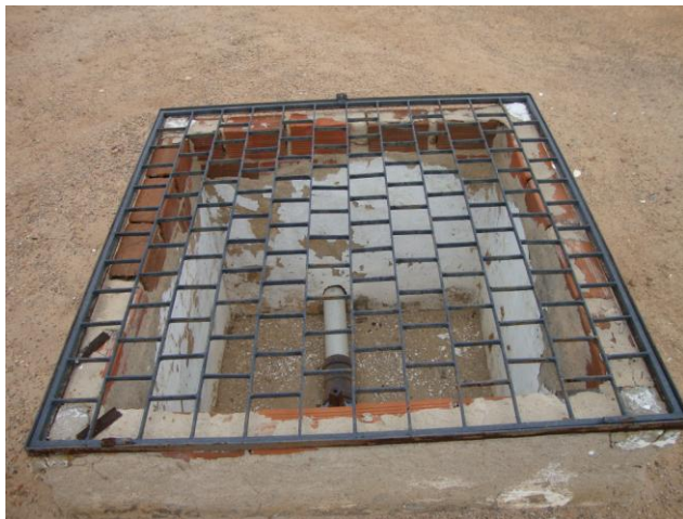
Foto 35 – Caixa da estação pitométrica de água tratada no interior da ETA.
