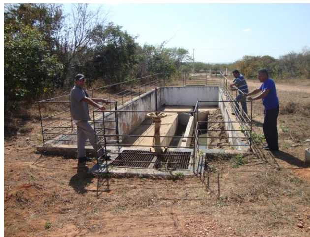
Foto 112 – ETE: vista geral do tratamento preliminar.
