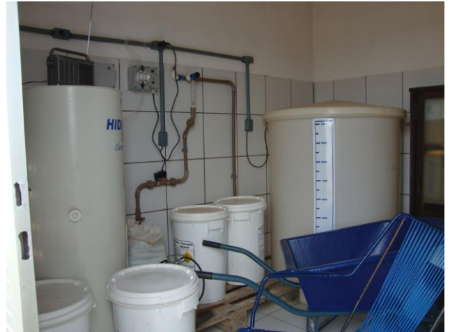
Foto 19 – Armazenamento de materiais e produtos químicos.
