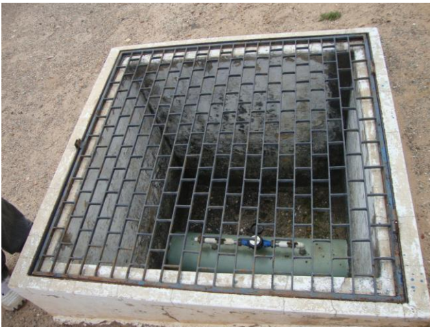
Foto 31 – Caixa de inspeção do medidor proporcional de água bruta na entrada da ETA.
