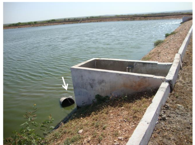
Foto 120 – ETE: poço de chegada da lagoa facultativa com tubulação desconectada.
