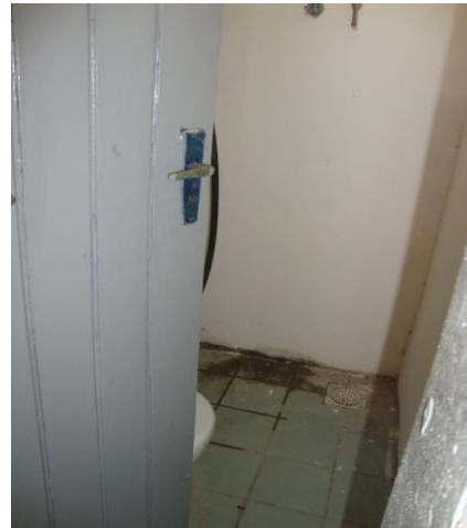
Foto 85 – EEE-01: instalação sanitária para os operadores.
