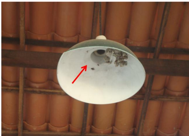
Foto 106 – EEE-03: ausência de iluminação.
