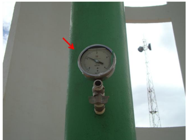
Foto 56 – REL-01: manômetro para medição de nível.
