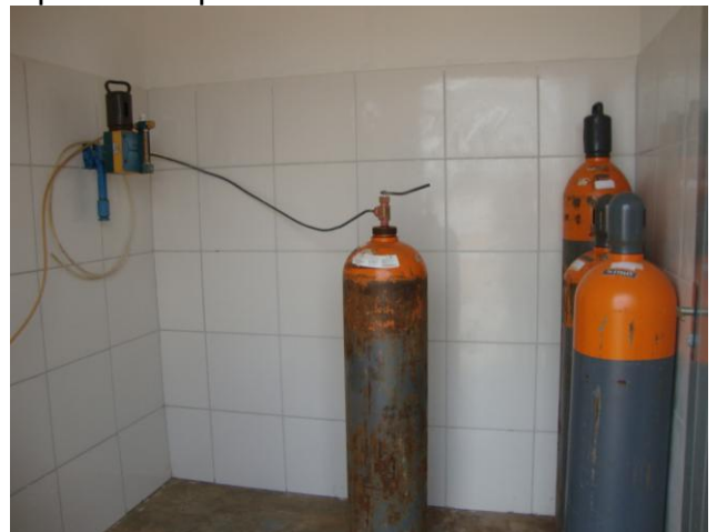
Foto 21 – Dosador de cloro gasoso.
