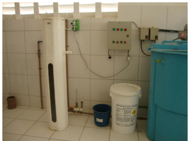
Foto 17 – Dosador de flúor.
