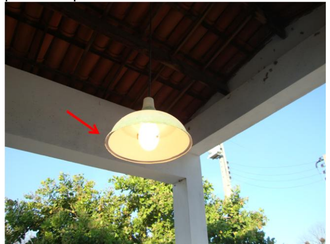
Foto 97 – Iluminação na EEE-02.
