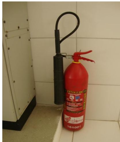
Foto 42 – Extintor de incêndios das EEAT-01 e EELF-01 com validade até jun/2017.
