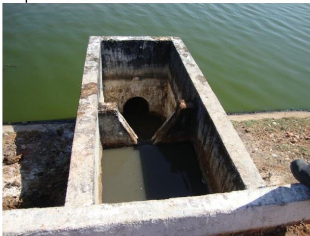
Foto 119 – ETE: poço de chegada da lagoa facultativa.
