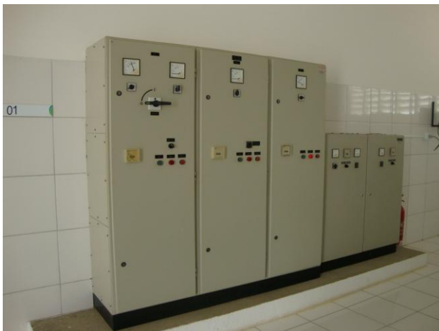
Foto 41 – Quadro de comando da EEAT-01 e EELF-01.
