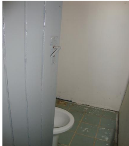
Foto 95 – EEE-02: Instalação sanitária para os operadores.
