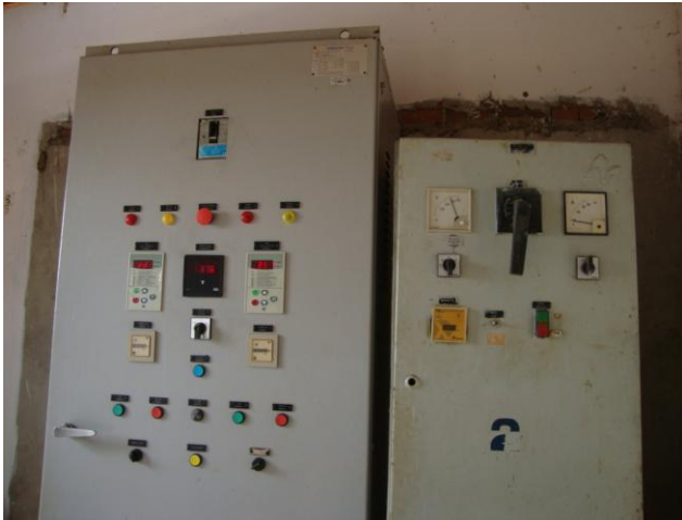
Foto 7 – Quadros de comando da captação subterrânea.
