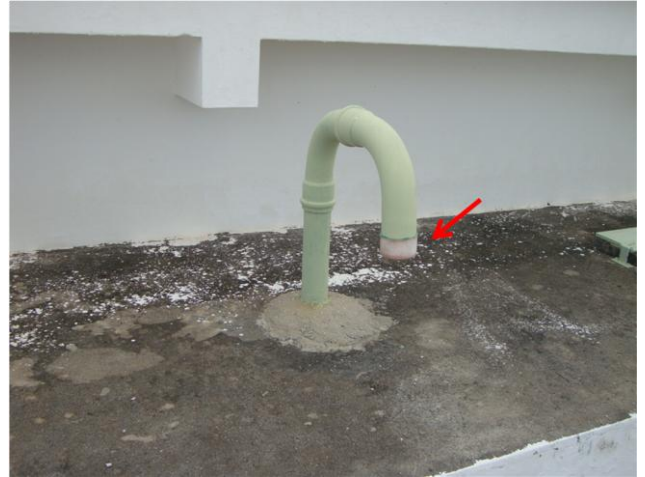
Foto 54 – Tanque de reunião com tubulação de ventilação com vedação.
