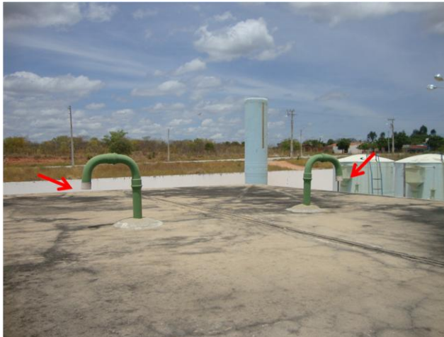
Foto 47 – RSE-01: tubulação de ventilação com vedação.
