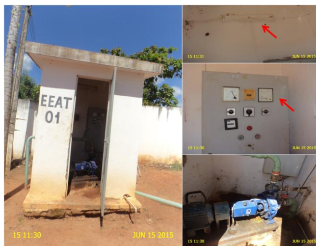
Foto 13 – EEAT-01: ausência de bomba reserva, iluminação e amperímetro sem funcionamento.
