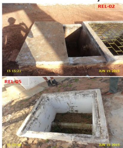
Foto 26 – REL-02 e REL-05: caixas de inspeção sem tampa ou grade de proteção.
