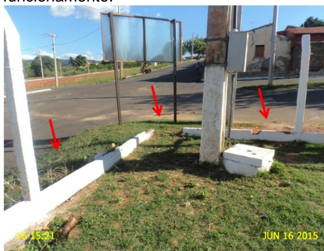
Foto 15 – EEE-03: cerca danificada.
