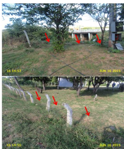
Foto 14 – EEE-02: cerca danificada.
