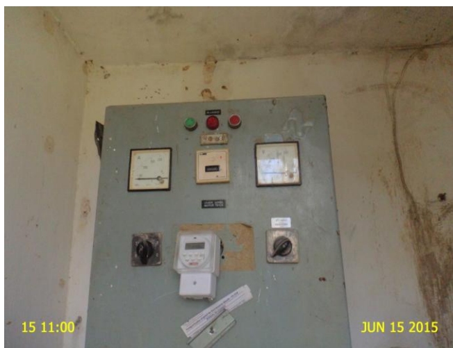
Foto 12 – PT-02: amperímetro e voltímetro sem funcionar.
