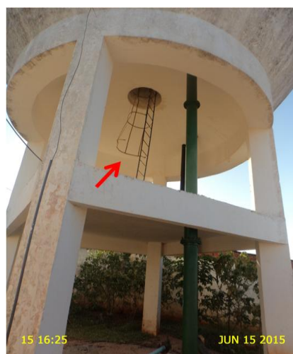
Foto 27 – REL-03: ausência de escada no nível inferior e gaiola protetora da escada sem fixação na estrutura.
