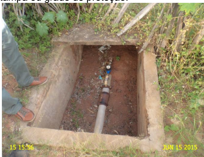
Foto 8 – PT-05: caixa de inspeção sem tampa ou grade de proteção.
