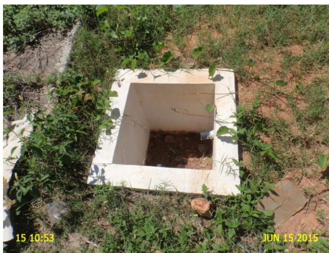
Foto 6 – PT-01: caixa de inspeção sem tampa ou grade de proteção.
