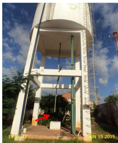
Foto 31 – REL-01: ausência de identificação e tubulação de descarga inadequada.
