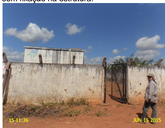
Foto 29 – RSE-03: pintura e estrutura deterioradas.
