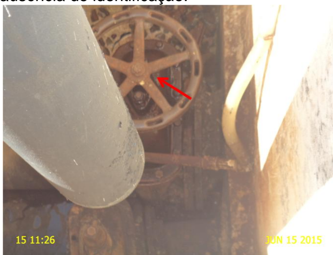
Foto 34 – RAP-01 – vazamento no registro de saída.
