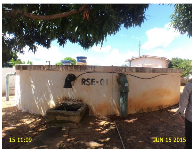
Foto 28 – RSE-01: pintura deteriorada.
