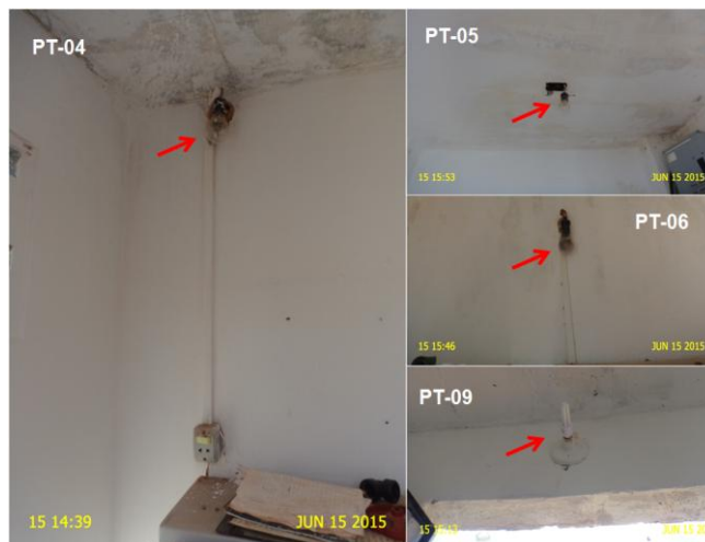
Foto 2 – PT-04, PT-05, PT-06 e PT-09: poços sem iluminação.
