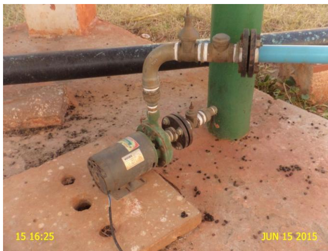
Foto 3 – Booster : ausência de bomba reserva.
