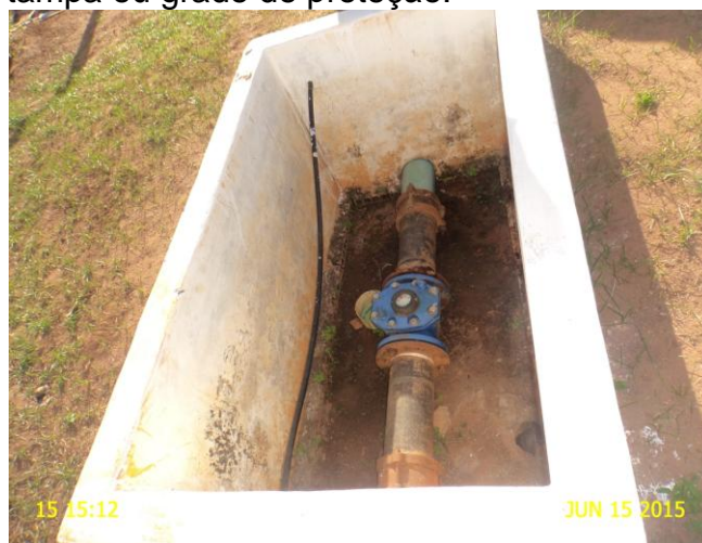
Foto 9 – PT-09: caixa de inspeção sem tampa ou grade de proteção.
