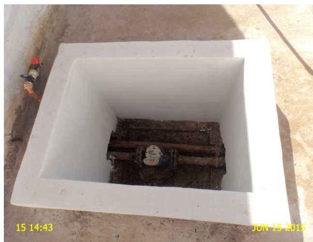
Foto 7 – PT-04: caixa de inspeção sem tampa ou grade de proteção.
