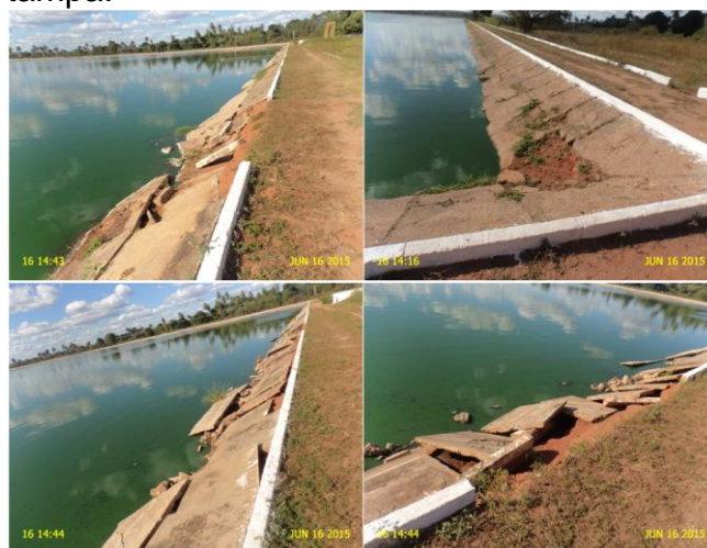
Foto 21 – ETE: placas de proteção dos taludes da lagoa facultativa danificadas.
