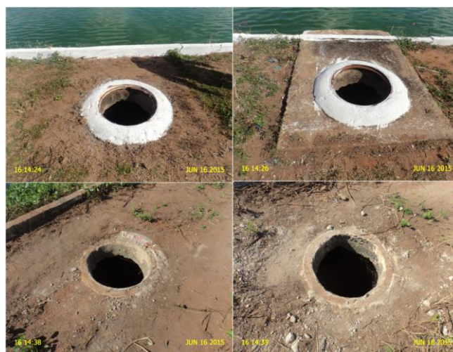
Foto 19 – ETE: caixa de inspeção sem tampa.
