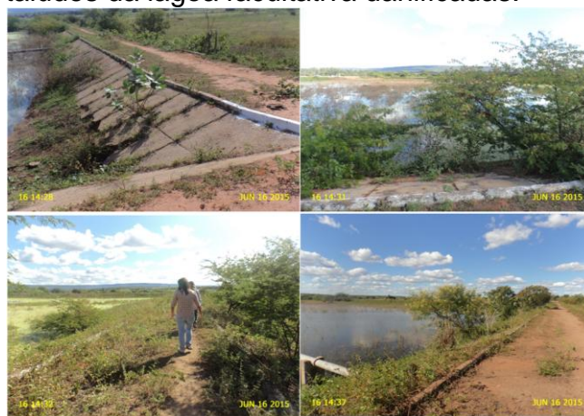
Foto 23 – ETE: taludes danificados e presença de vegetações na lagoa de maturação M1.
