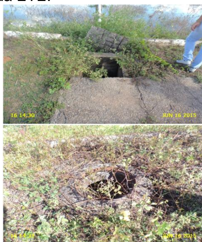
Foto 20 – ETE: caixa de inspeção sem tampa.
