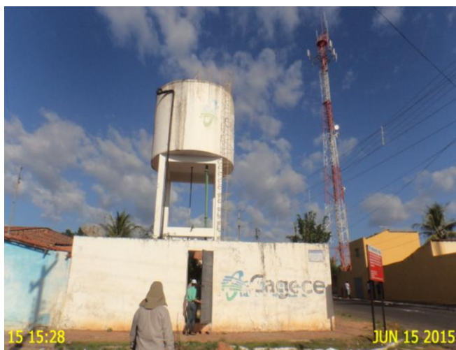
Foto 30 – REL-01: pintura deteriorada.
