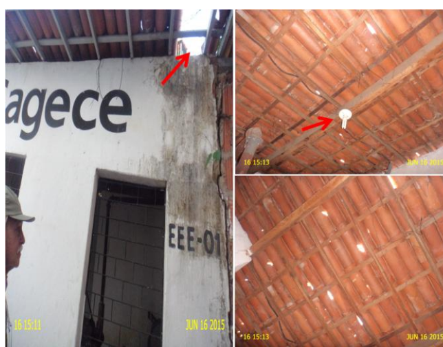
Foto 17 – EEE-01: ausência de iluminação e telhado danificado.
