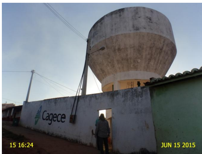
Foto 32 – REL-03: pintura deteriorada e ausência de identificação.
