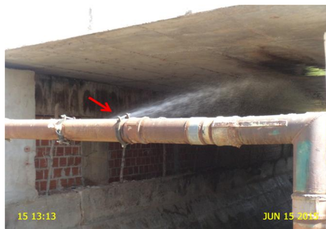
Foto 25 – RD: vazamento na rede de distribuição no endereço Av. Ministro Costa Cavalcante.
