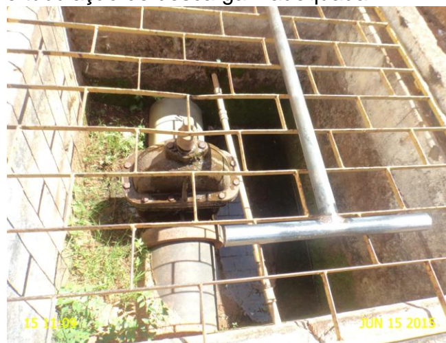
Foto 33 – RSE-01 – vazamento no registro da tubulação de entrada.
