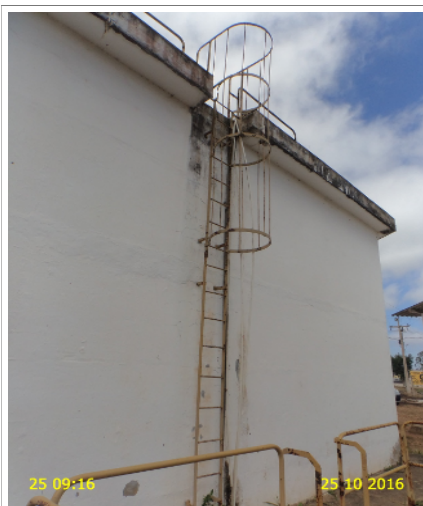
Foto 7 – RAP-08 (Sede): escada e guarda-corpos com pintura deteriorada.
