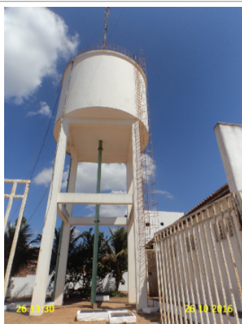
Foto 9 – REL-10 (Sede): ausência de identificação.
