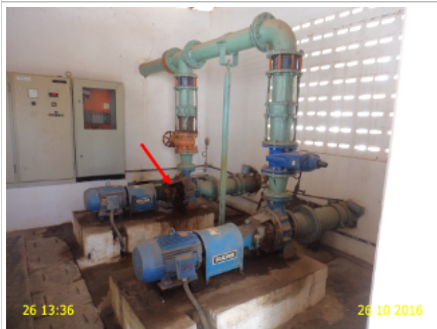
Foto 5 – EEAT-07 (Sede): vazamento na bomba.
