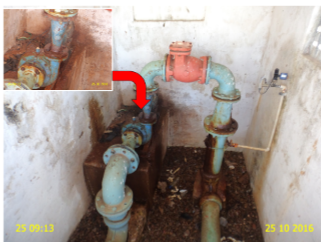
Foto 2 – Booster Sebastião Gomes Parente (Sede): ausência de bomba reserva, pintura interna deteriorada e vazamento na bomba.
