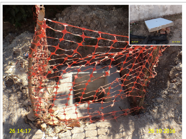
Foto 13 – caixa de descarga no Sítio do meio sem tampa.
