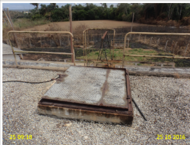
Foto 6 – RAP-08 (Sede): tampa de inspeção com corrosão.
