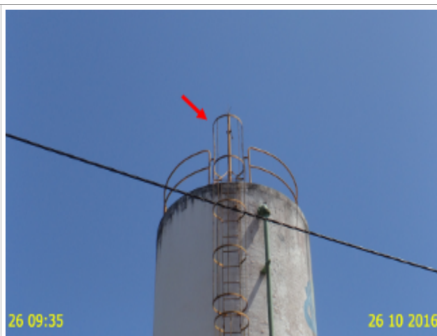
Foto 4 – TAU-09: ausência de sinalizador de obstáculo.
