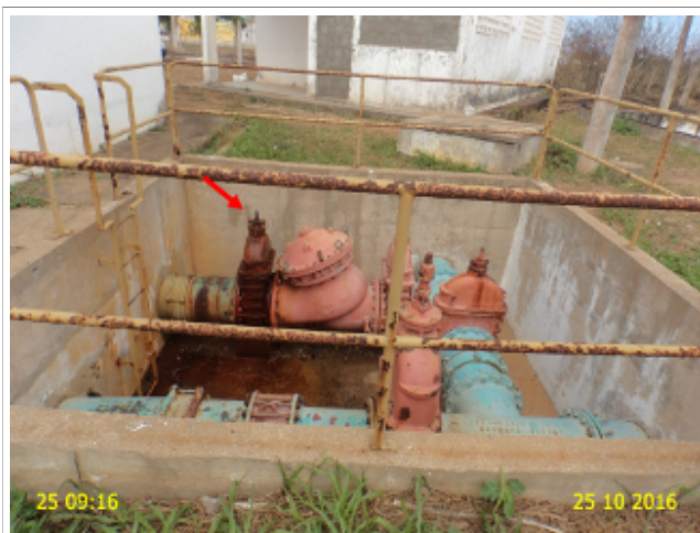
Foto 3 – RAP-08 (Sede): vazamento no registro.
