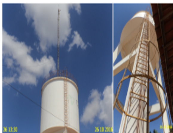
Foto 8 – REL-10 (Sede): escada e guarda-corpos com pintura deteriorada. REL-10 (Sede): ausência de identificação.
