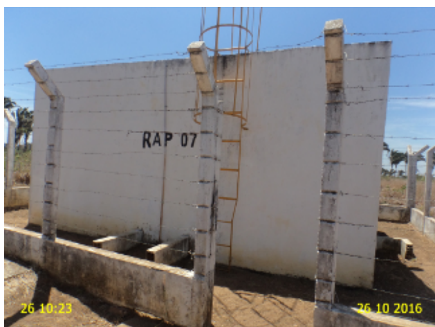
Foto 1 – RAP-07 (Jaburuna): ausência de portão de acesso.
