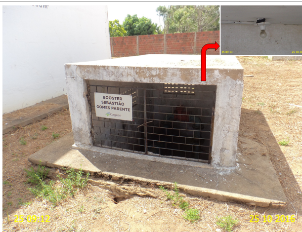
Foto 12 – Booster Sebastião Gomes Parente (Sede): pintura externa deteriorada e a lâmpada não acende.
