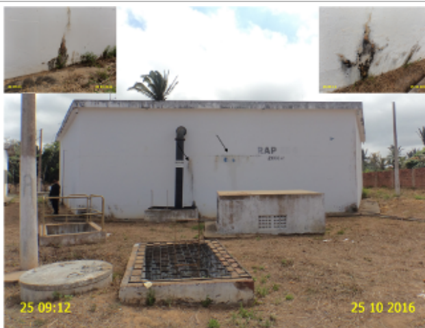
Foto 10 – RAP-08 (Sede): com rachadura na parede
