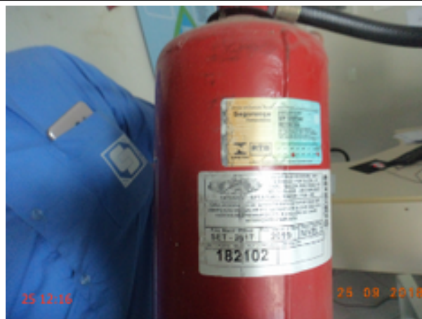
Foto 13 – O extintor de incêndio da Loja de Atendimento da Cagece/almoxarifado está com a recarga vencida.
