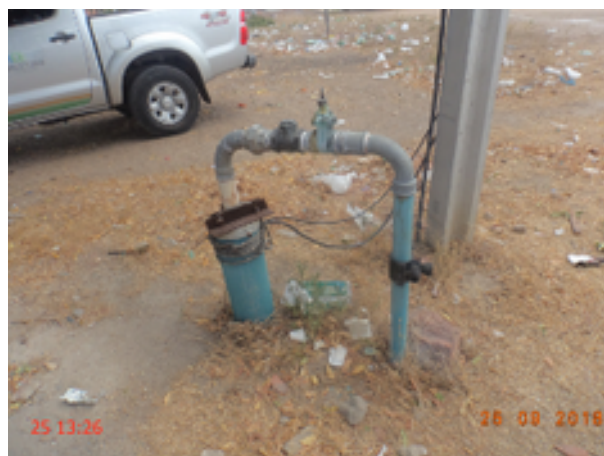
Foto 8 - O poço PT-05 não é dotado de laje de proteção e clorador de pastilha.
