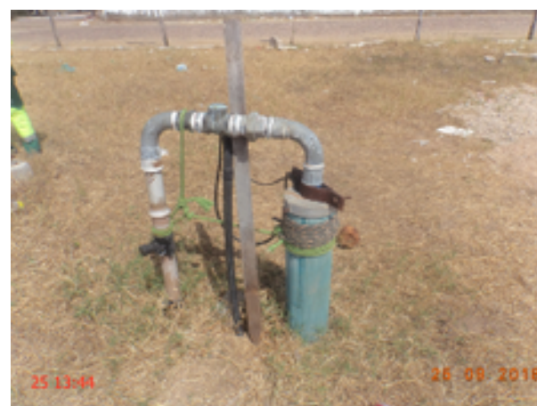
Foto 9 - O poço PT-06 não é dotado de laje de proteção e clorador de pastilha.
