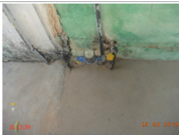
Foto 5 – RDA: medição instantânea de pressão no endereço: Rua Padre Tarcísio Melo, S/N.
