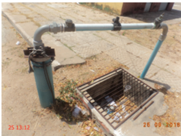
Foto 10 - O poço PT-08 não é dotado de laje de proteção, clorador pastilha de identificação.
