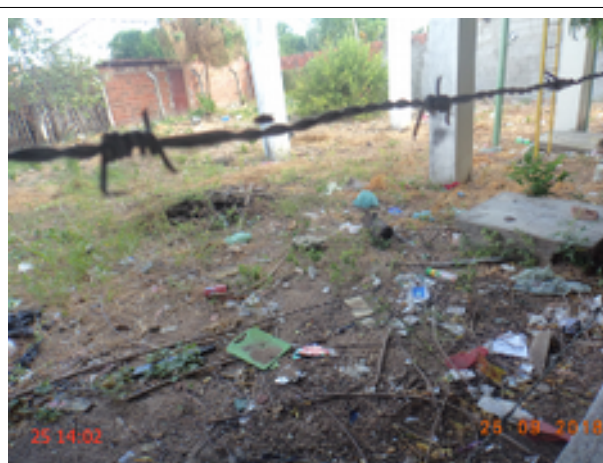
Foto 7 – A área do reservatório REL-03 está com a limpeza deficitária.
