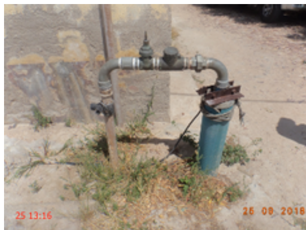
Foto 11 - O poço PT-04 não é dotado de laje de proteção.
