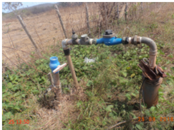
Foto 12 - O poço PT-13 não é dotado de laje de proteção.
