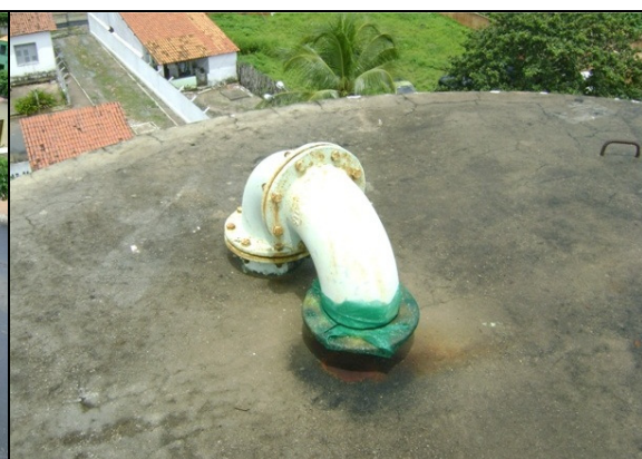
Foto 31 – REL-01: Tubulação de Ventilação.
