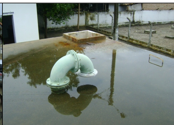
Foto 28 – RAP-01: Tubulação de ventilação.
