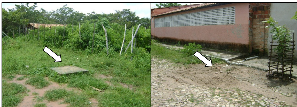
Foto 40 – Registro de descarga localizado na Rua João Paulo II, Centro.
