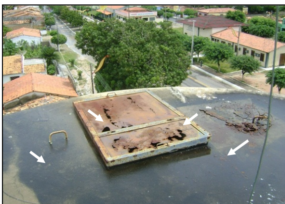
Foto 30 – REL-01: Tapa de visita deteriorada pela corrosão e acúmulo de água na laje superior.
