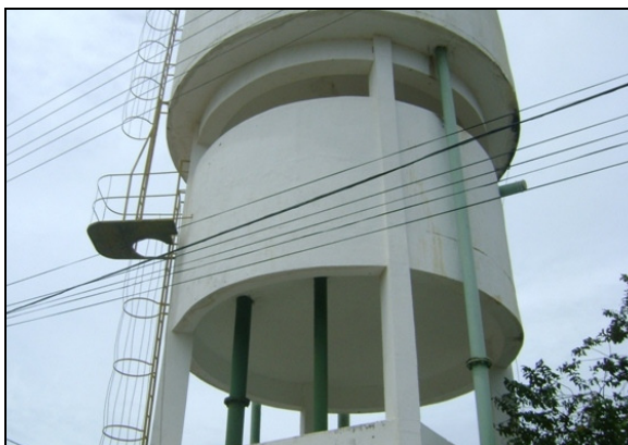
Foto 24 – Vista do reservatório de quebra de pressão.
