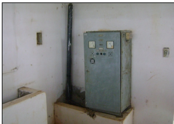
Foto 20 – Quadro de comando da EECS-01.
