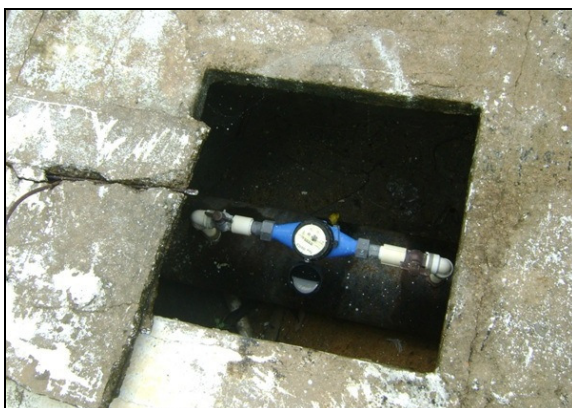
Foto 6 – Medidor proporcional para lavagem de filtros.
