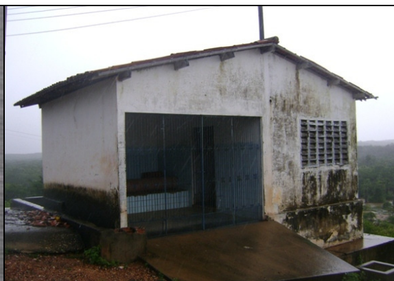
Foto 19 – Casa do quadro de comando da EECS-01, apresentando pintura deteriorada.
