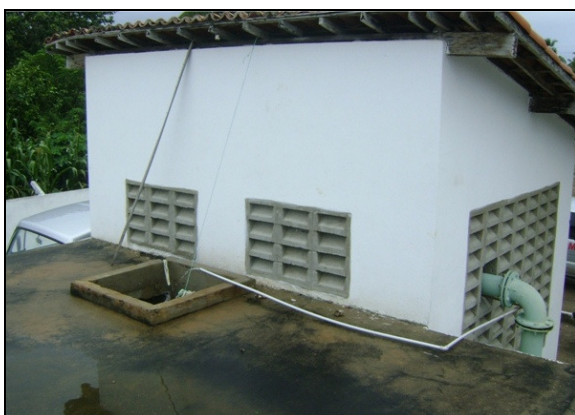
Foto 27 – RAP-01: Sem tampa de inspeção.
