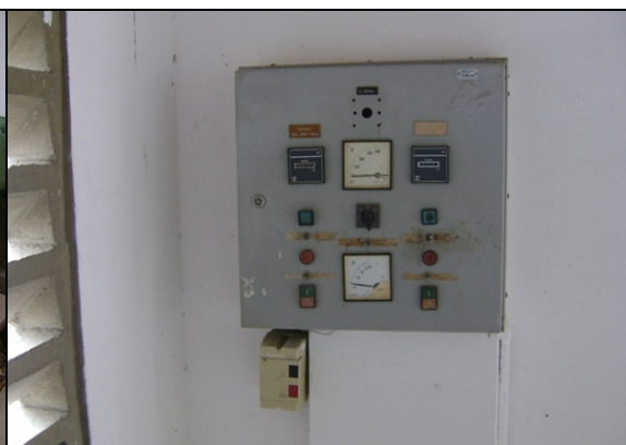
Foto 22 – Quadro de comando da EEAT-01.
