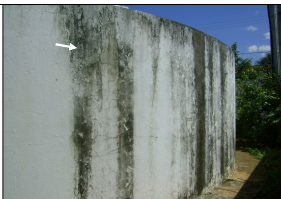
Foto 36 – RAP-01: Pintura deteriorada.
