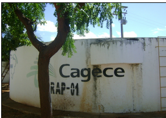
Foto 35 – RAP-01: Existência de identificação e pintura deteriorada.
