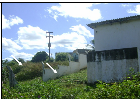
Foto 24 – EECS-01: Muro danificado.
