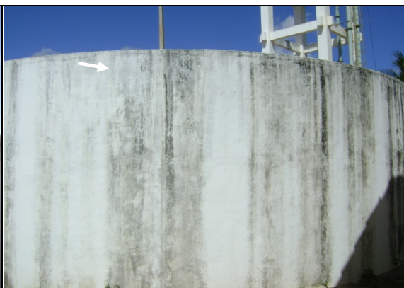
Foto 40 – RAP-02: Pintura deteriorada.
