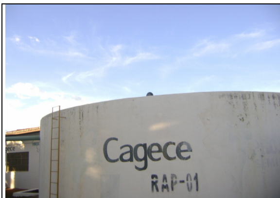
Foto 39 – RAP-02: Identificação incorreta.
