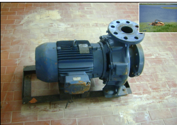
Foto 30 – EECS-01: Conjunto moto-bomba reserva, localizada na ETA.
