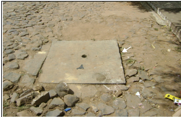
Foto 54 – Registro de manobra localizado na Rua José Alves.
