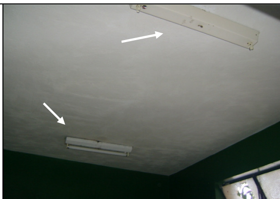
Foto 9 – Laboratório: Luminárias sem funcionar (ausência de lâmpadas).
