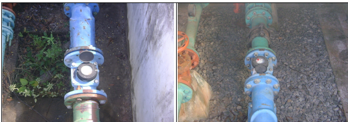
Foto 20 – Macromedidor de água bruta, localizado na entrada da ETA.
