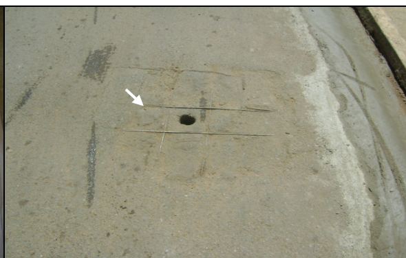
Foto 51 – Registro de manobra localizado na Rua Serafim Aquino.
