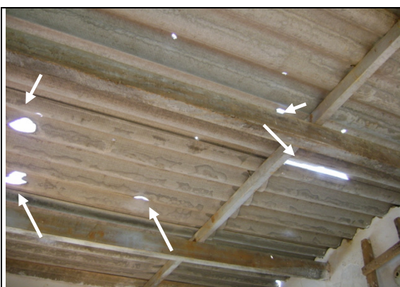
Foto 27 – EECS-01: Telhado danificado.
