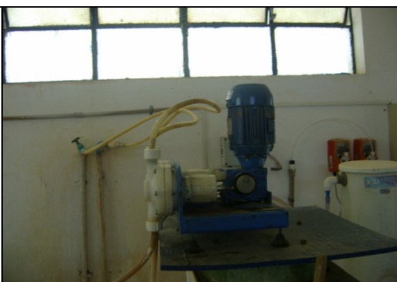
Foto 16 – Bomba dosadora de produtos químicos.
