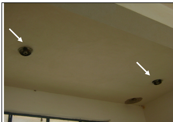
Foto 19 – Casa de química: Luminárias sem lâmpadas.
