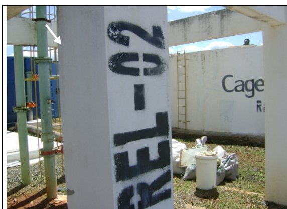
Foto 46 – REL-02: Existência de identificação.
