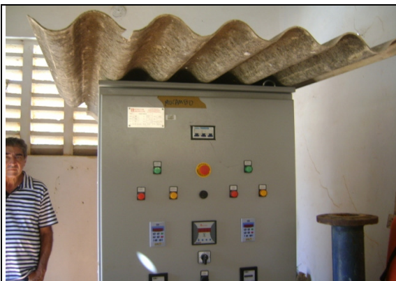
Foto 29 – EECS-01: Novo quadro de comando.
