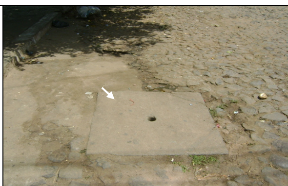
Foto 53 – Registro de manobra localizado na Rua José Alves.
