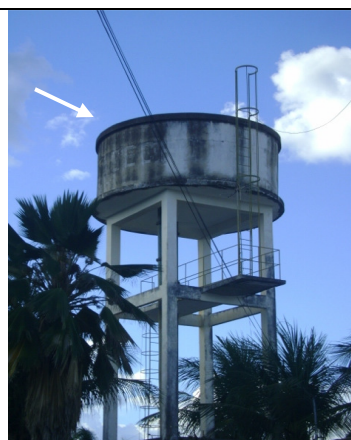
Foto 43 – REL-01: Pintura deteriorada e ausência de guarda-corpo na laje de cobertura.
