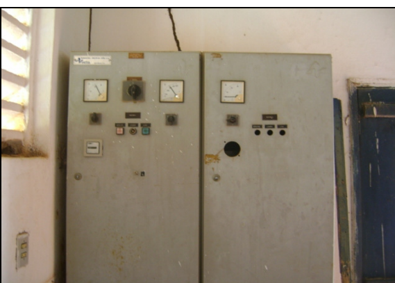
Foto 28 – EECS-01: Quadro de comando sem limpeza e necessitando pintura.
