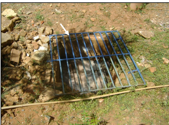
Foto 6 – Filtro 01: Caixa de drenagem danificada.
