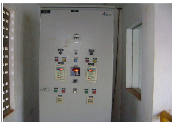
Foto 34 – EEAT-02: Quadro de comando.
