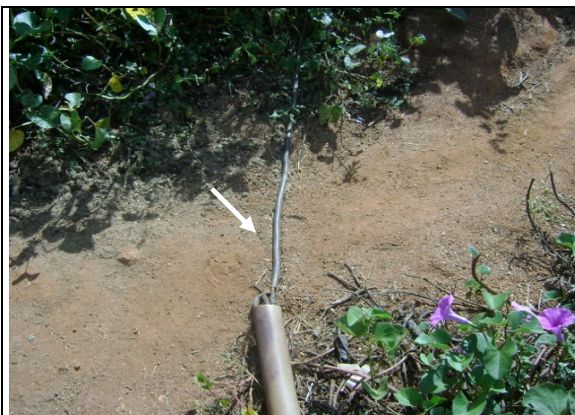
Foto 25 – EECS-01: Cabo de energia exposto.
