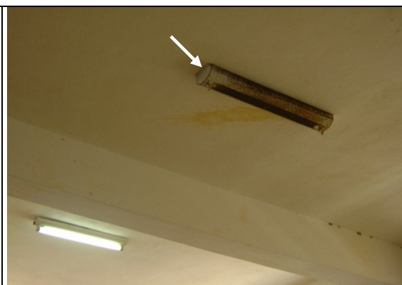
Foto 18 – Casa de química: Luminária sem lâmpada.
