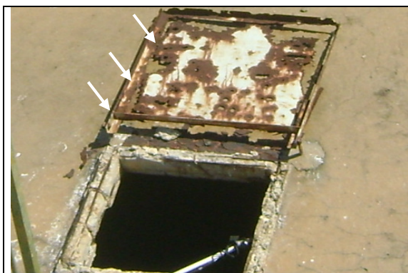
Foto 44 – REL-01: Tampa de inspeção comprometida pela corrosão.
