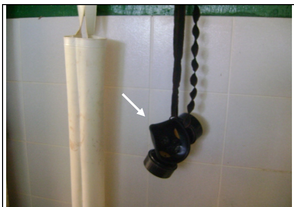
Foto 17 – Casa de química: Máscara de proteção dos operadores.
