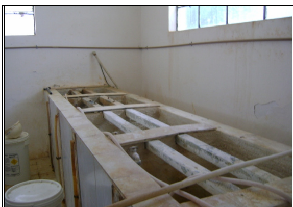
Foto 15 – Tanques de dosagem sem agitadores mecânicos.
