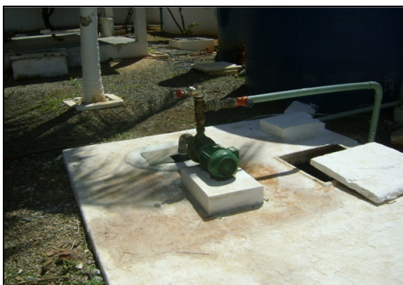
Foto 31 – EEAT-01: Conjunto moto-bomba sem casa de proteção.
