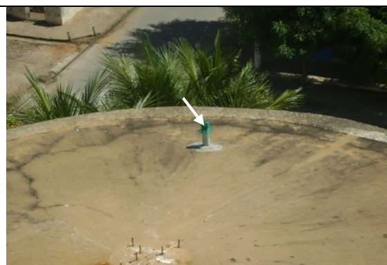
Foto 45 – REL-01: Tubulação de ventilação inadequada.
