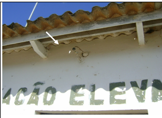
Foto 26 – EECS-01: Ausência de iluminação externa.
