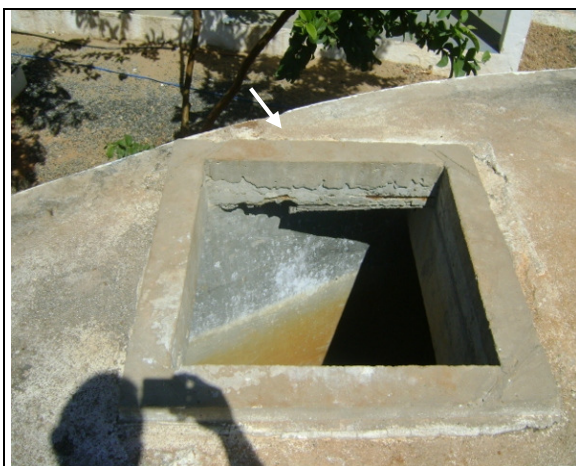
Foto 37 – RAP-01: Inspeção sem tampa de proteção.
