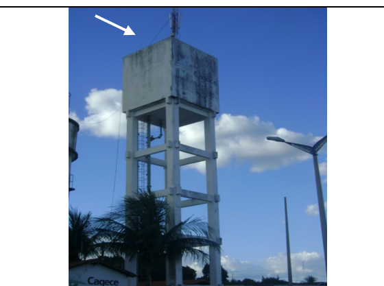
Foto 47 – REL-01: Pintura deteriorada e ausência de guarda corpo na laje de cobertura.
