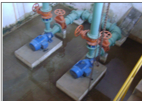
Foto 33 – EEAT-02: Conjuntos moto-bomba.
