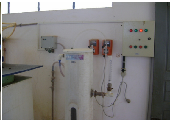
Foto 14 – Dosador de flúor.
