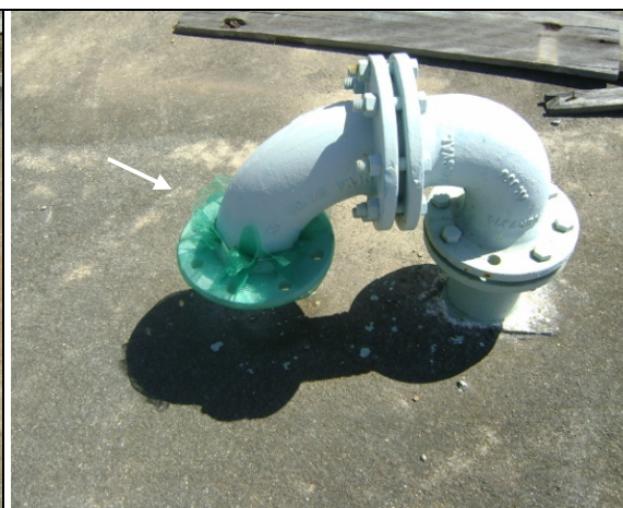
Foto 38 – RAP-01: Tubulação de ventilação com tela de proteção.
