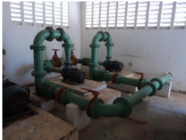
Foto 48 – EELF -01: conjunto moto-bomba.
