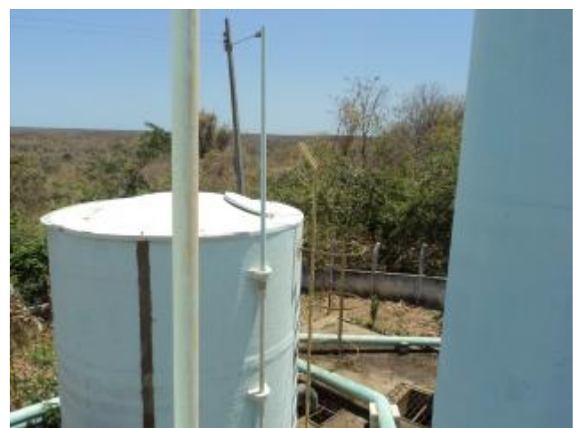
Foto 15 – Filtro 1: tampa adequada.
