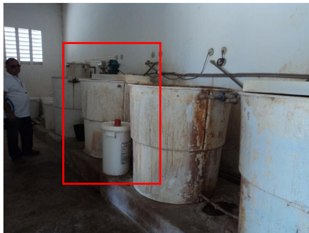
Foto 23 – Casa de química: tanques de dosagem-somente 1 (um) em funcionamento e 2 (dois) desativados.
