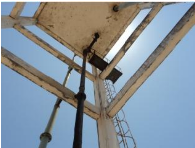
Foto 64 – REL-01: pintura deteriorada e plataforma em processo de corrosão.
