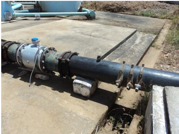
Foto 35 – AAB: macromedidor parado e estação pitométrica na entrada da ETA.
