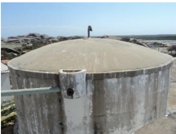
Foto 60 – RAP-03: cobertura do reservatório - tubulação de ventilação com tela de proteção e antiga entrada de água do filtro desativado sem tampa.
