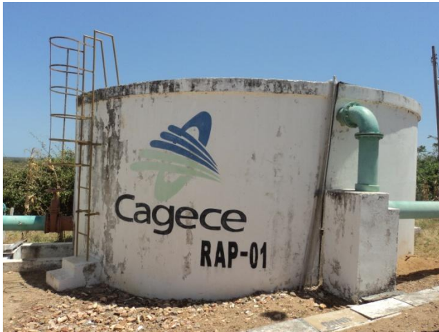
Foto 50 – RAP-01: vista geral - pintura deteriorada e identificação.
