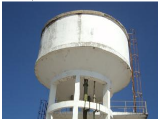
Foto 77 – REL-03: ausência de guarda-corpo na laje de cobertura, para-raios e sinalização noturna.
