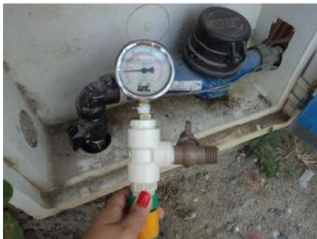
Foto 83 – Medição instantânea de pressão na Vila Nova.
