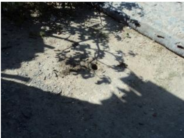
Foto 90 – Registro de descarga na Vila Nova.
