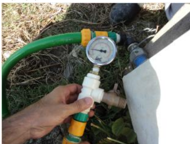
Foto 85 – Medição instantânea de pressão na Rua Major Fiel, FNS 1048.
