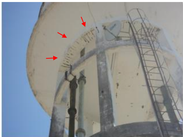
Foto 78 – REL-03: armadura exposta.
