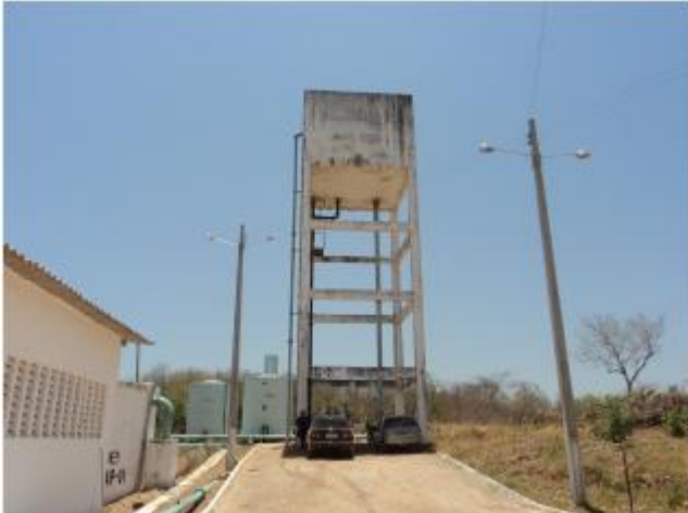
Foto 62 – REL-01: vista geral - pintura deteriorada, sem guarda-corpo na laje de proteção e ausência de identificação.
