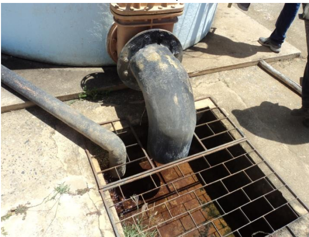
Foto 18 – Filtro 1: tubulação e caixa de descarga.
