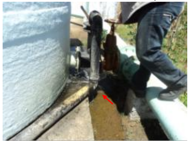
Foto 19 – Filtro 2: tubulação de descarga quebrada com vazamento.
