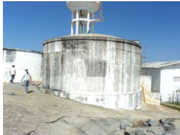
Foto 59 – RAP-03: vista geral - pintura deteriorada, ausência de identificação e medidor de nível.
