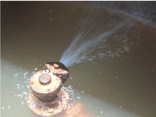
Foto 41 – AAT: ventosa danificada (4) com acúmulo de água na caixa.
