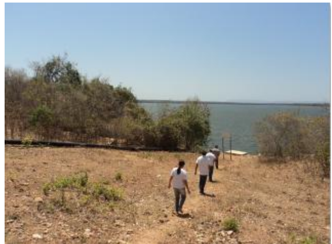
Foto 2 – Açude Itaúna: ausência de barreira de delimitação e proteção.
