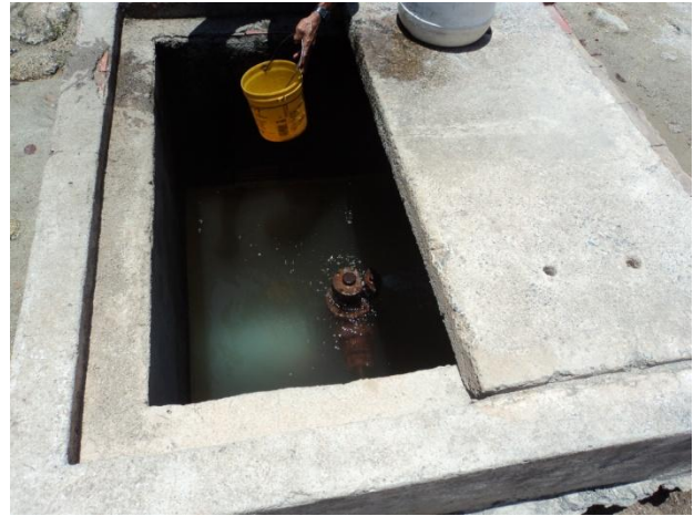
Foto 40 – AAT: ventosa danificada (4) com acúmulo de água na caixa.
