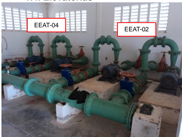
Foto 45 – EEAT-02 e 04: conjunto moto-bomba.
