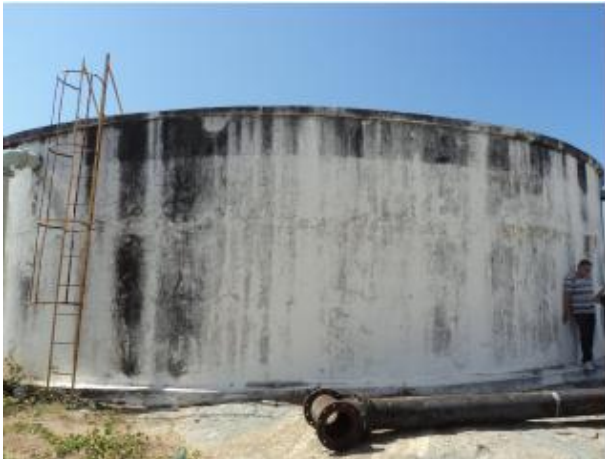
Foto 56 – RAP-02: vista geral - pintura deteriorada, ausência de identificação e escada de acesso em processo de corrosão.
