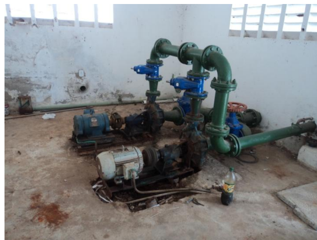
Foto 46 – EEAT-03: conjunto moto-bomba.
