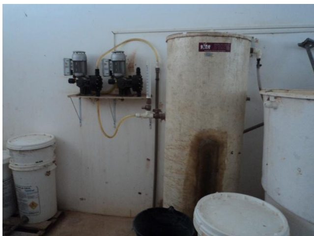
Foto 24 – Casa de química: sistema de fluoretação
