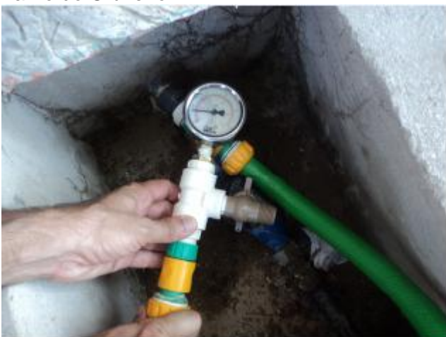
Foto 84 – Medição instantânea de pressão na Rua Padre Antonio Carneiro, FNS 1599.
