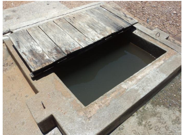
Foto 36 – AAT: ventosa danificada (1) com acúmulo de água na caixa.
