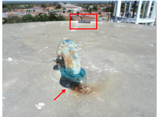
Foto 57 – RAP-02: tubulação de ventilação com tela de proteção e tampa de inspeção em processo de corrosão.
