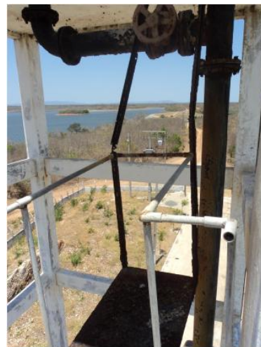
Foto 65 – REL-01: detalhe da estrutura da plataforma em processo de corrosão.
