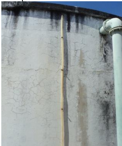
Foto 58 – RAP-02: medidor de nível.
