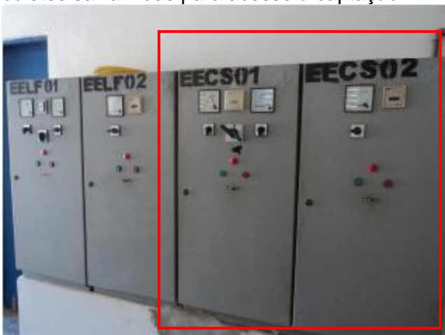
Foto 7 – EECS: identificação da elevatória e condições adequadas do quadro de comando.
