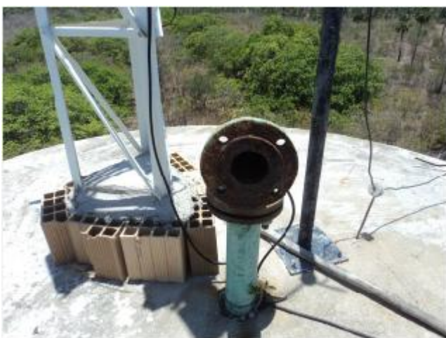
Foto 72 – REL-02: tubulação de ventilação sem
