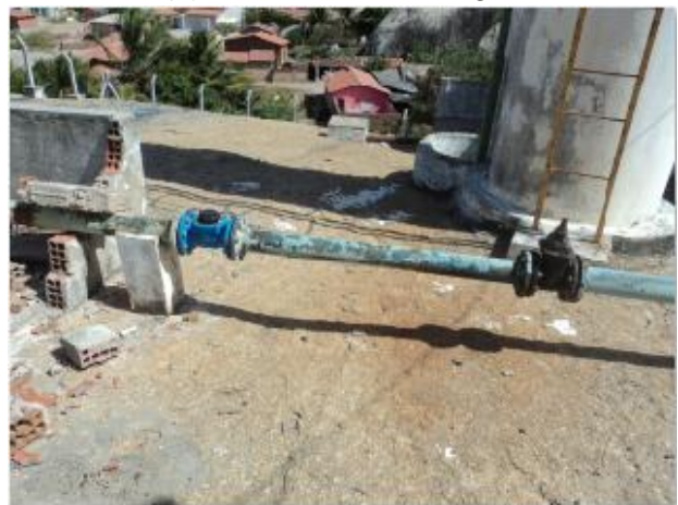
Foto 44 – AAT: medidor de saída na área dos reservatórios RAP-02, 03 e REL-03.
