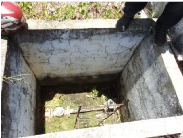
Foto 74 – REL-02: medidor de entrada do reservatório sem tampa ou grade de proteção.
