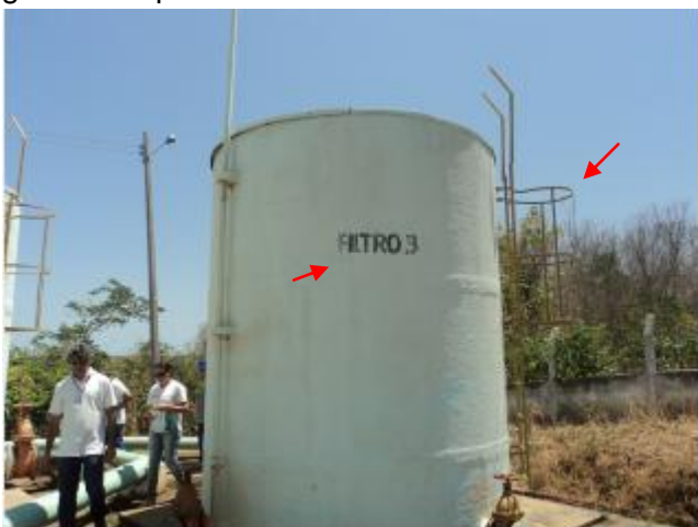
Foto 14 – Filtro 3: identificação e escada com guarda corpo.
