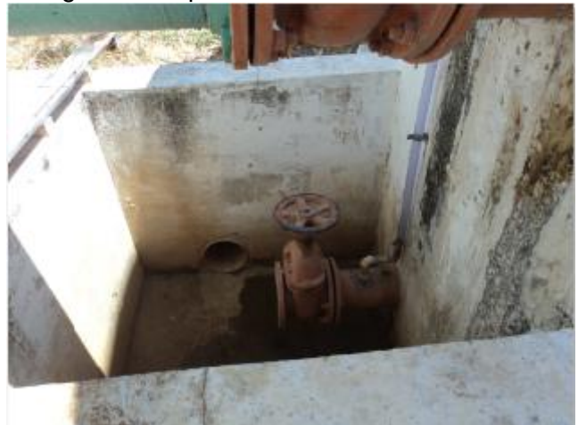
Foto 53 – RAP -01: registro sem tampa ou grade de proteção.
