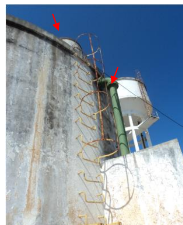
Foto 61 – RAP-03: tampa de inspeção, escada de acesso e guarda corpo em processo de corrosão.
