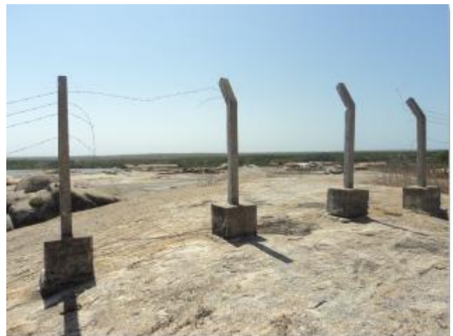
Foto 55 – RAP-02, 03 e REL-03: cerca de proteção da área dos reservatórios danificada.
