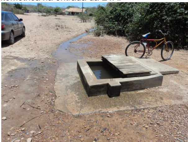
Foto 37 – AAT: ventosa danificada (2) com acúmulo de água na caixa e transbordamento para a estrada.
