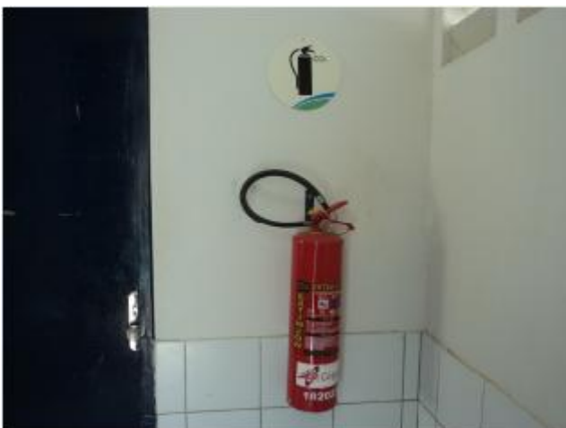
Foto 102 – Loja de atendimento: extintor de incêndio.
