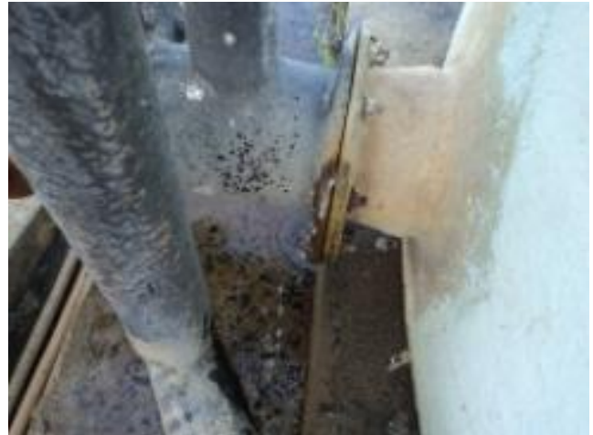
Foto 17 – Filtro 1: vazamento na tubulação.
