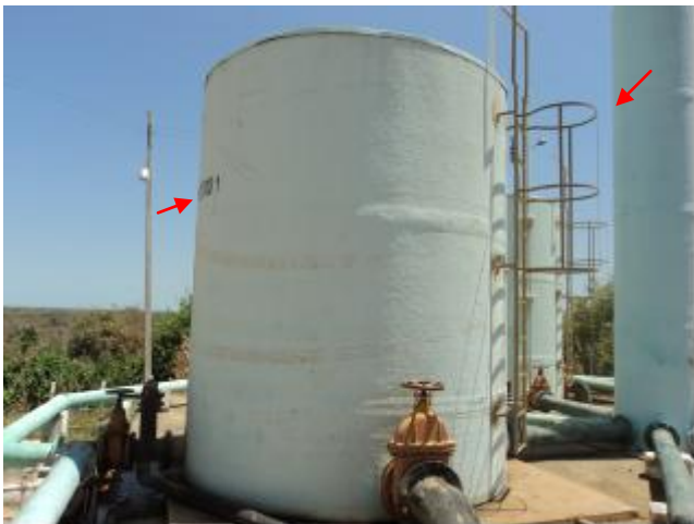
Foto 12 – Filtro 1: identificação e escada com guarda corpo.
