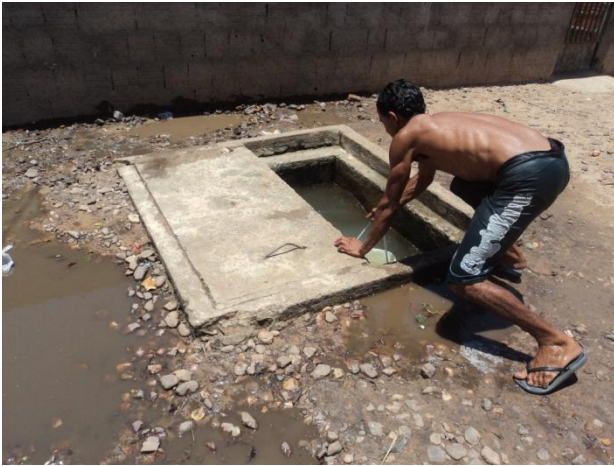
Foto 39 – AAT: retirada de água pelos moradores da região da localidade de Passagem e a Sede de Chaval na caixa da ventosa danificada (3) com acúmulo de água.
