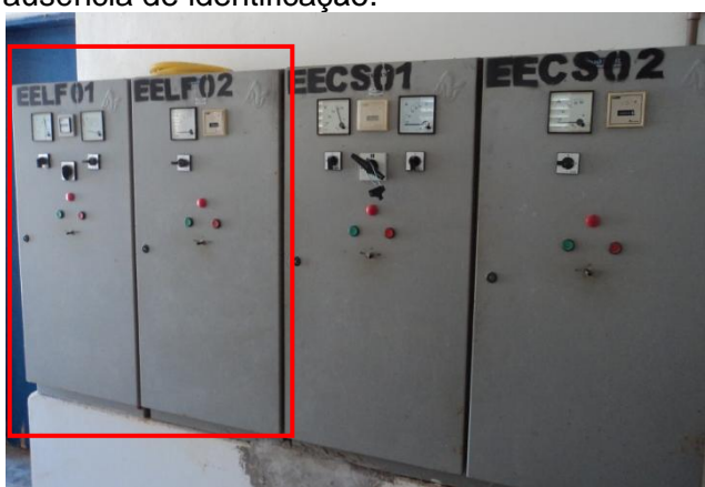
Foto 49 – EELF-01: quadro de comando e identificação.
