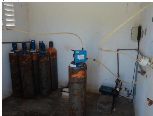
Foto 25 – Casa de química: cloro gasoso.
