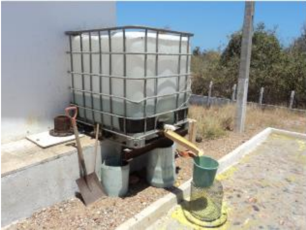
Foto 34 – ETA: tanque de armazenamento de PAC localizado na área externa da casa de química, exposto ao sol.
