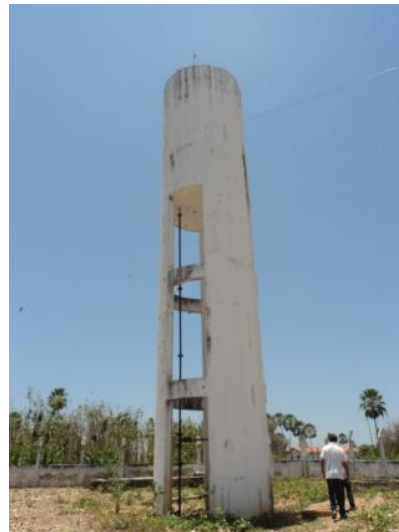
Foto 69 – REL-02: ausência de identificação, medidor de nível e guarda-corpo na laje de cobertura.
