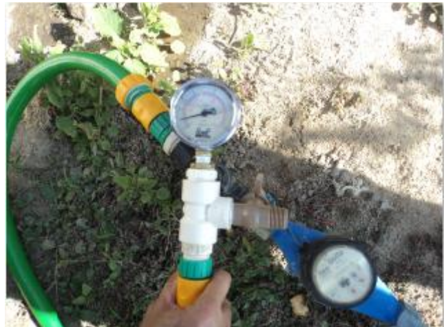
Foto 87 – Medição instantânea de pressão na Rua Padre João Rodrigues Braga.
