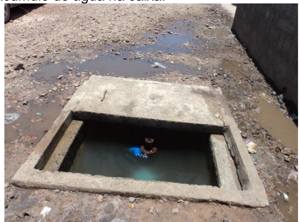
Foto 38 – AAT: ventosa danificada (2) com acúmulo de água na caixa e transbordamento para a estrada.
