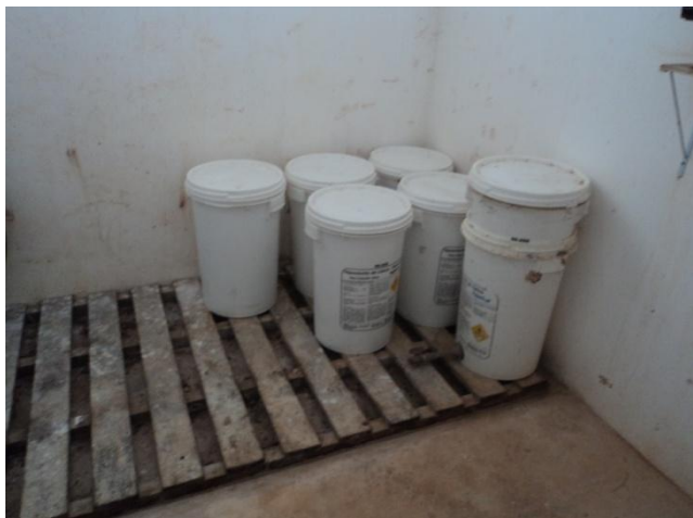
Foto 22 – Casa de química: armazenamento adequado de produtos químicos.
