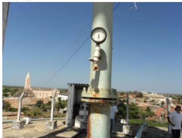
Foto 79 – REL-03: medidor de nível.
