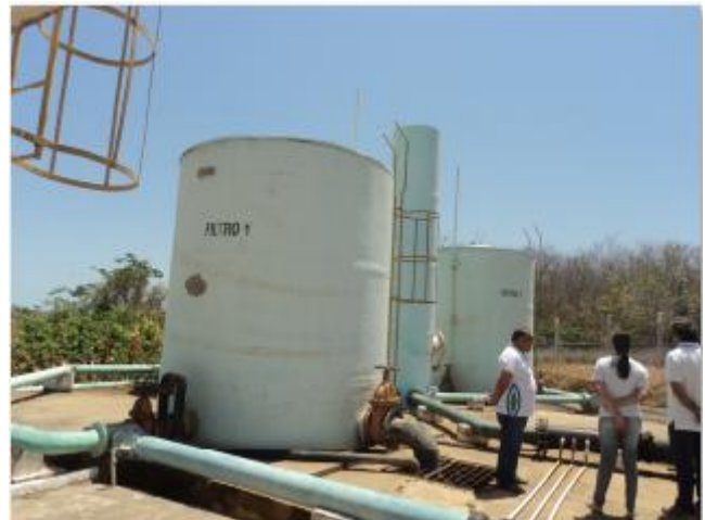
Foto 11 – ETA: vista geral das instalações de filtração com identificação dos filtros.
