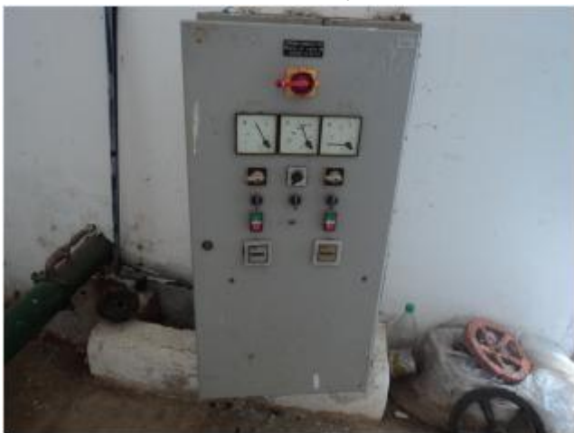
Foto 47 – EEAT-03: quadro de comando e ausência de identificação.
