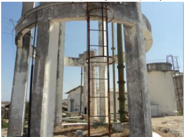
Foto 76 – REL-03: escada e guarda-corpo em processo de corrosão
