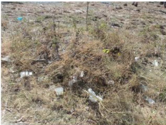
Foto 92 – Registro de descarga coberto pela vegetação na Rua Major Fiel, FNS 1048.
