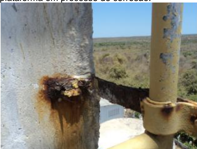
Foto 66 – REL-01: fixação da escada no reservatório em processo de corrosão.
