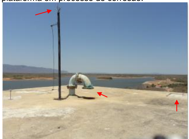
Foto 67 – REL-01: tubulação de ventilação com tela de proteção, sem guarda-corpo na laje de cobertura, tampa de inspeção e para-raios.
