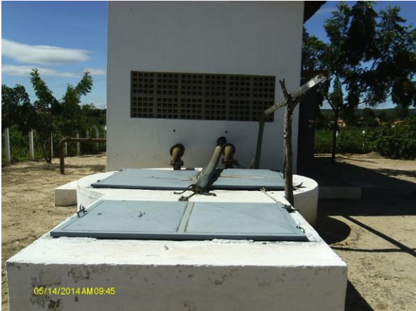
Foto 46 - EEE-01: poço de sucção com tampa.
