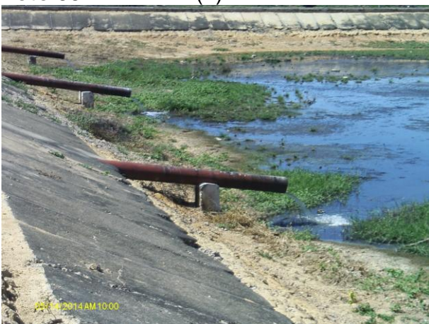
Foto 61 - ETE: lançamento de esgoto bruto na lagoa facultativa.
