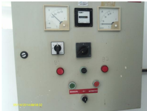
Foto 15 - EEAT-01: quadro de comando.
