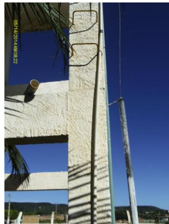
Foto 27 - REL-01: escada de acesso sem apoio para subir.
