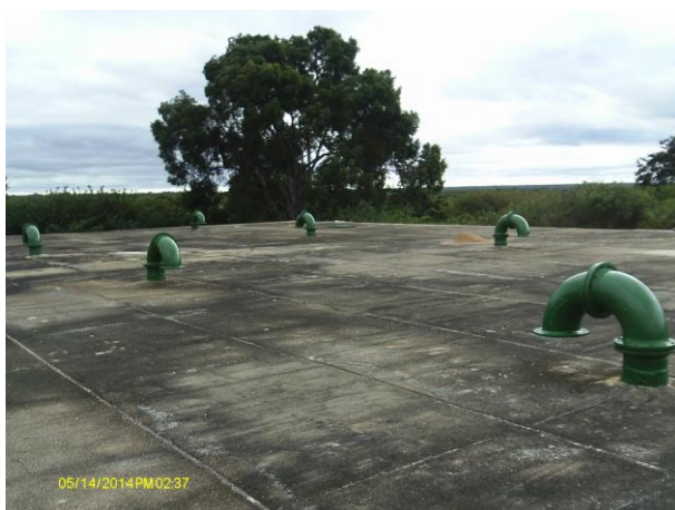
Foto 20 - RAP-01: tubulação de ventilação.
