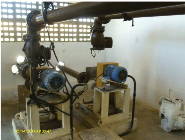
Foto 48 - EEE-01: conjunto moto-bomba com reserva.
