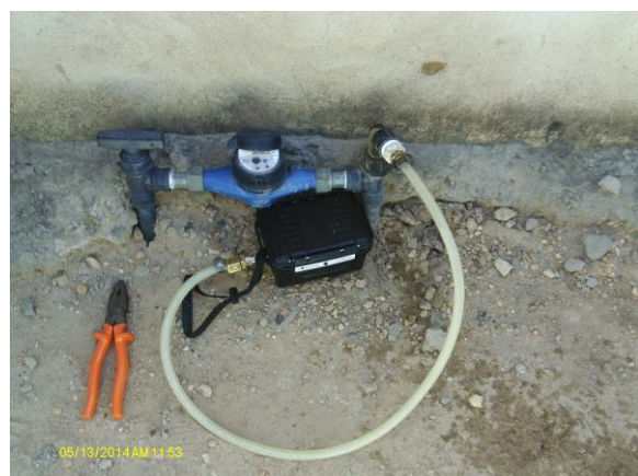
Foto 41 - Equipamento de medição contínua de pressão instalado na rede de distribuição no endereço localizado na Travessa Santo Antônio, 44.
