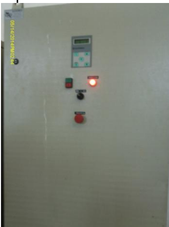
Foto 5 - PP-05: Quadro de comando.
