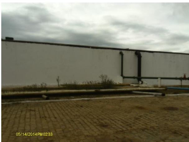
Foto 16 - RAP-01: ausência de identificação.
