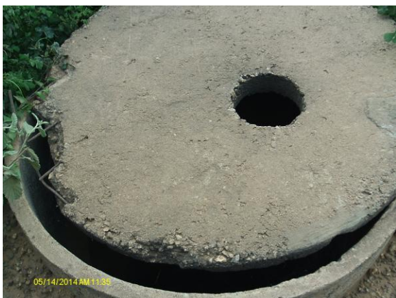
Foto 12 - AAT-01: caixa de descarga com tampa danificada.
