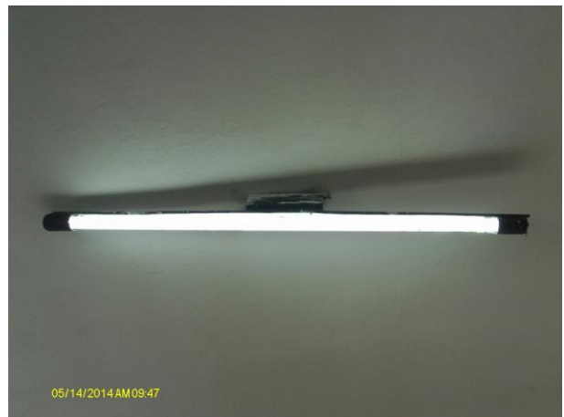
Foto 51 - EEE-01: iluminação interna.
