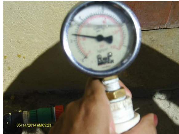
Foto 37 - Medição instantânea de pressão na rede de distribuição: Rua João Libânio, 479.
