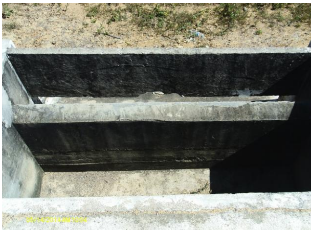
Foto 63 - ETE: caixa de saída do esgoto da lagoa facultativa para lagoa de maturação (1).
