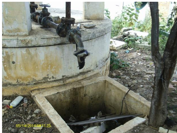
Foto 33 - REL-02: tubo extravasor em processo de corrosão e acúmulo de lixo na caixa de descarga de fundo.
