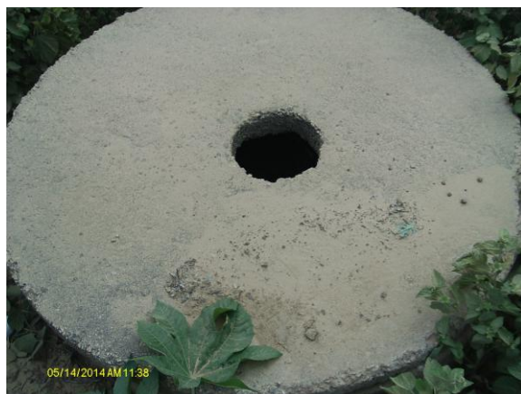
Foto 13 - AAT-01: caixa de ventosa.
