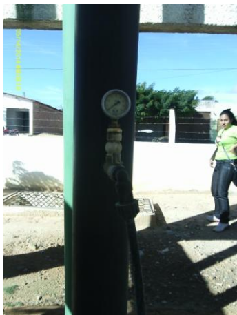
Foto 28 - REL-01: medidor de nível.
