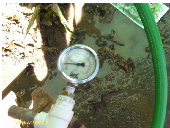
Foto 35 - Medição instantânea de pressão na rede de distribuição: Rua Santo Antônio, 876.
