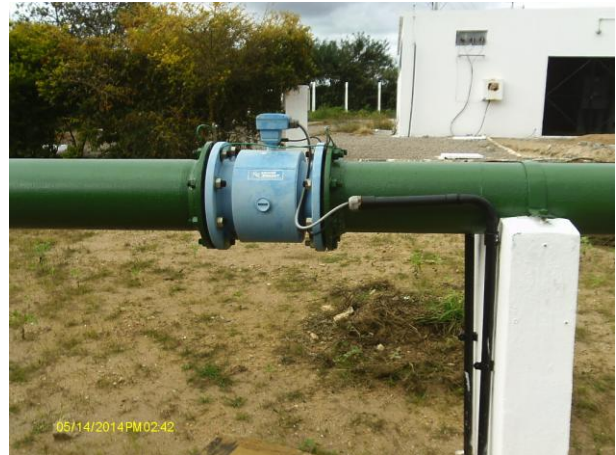
Foto 4 - PP-05/AAB-01: medidor eletromagnético instalado.
