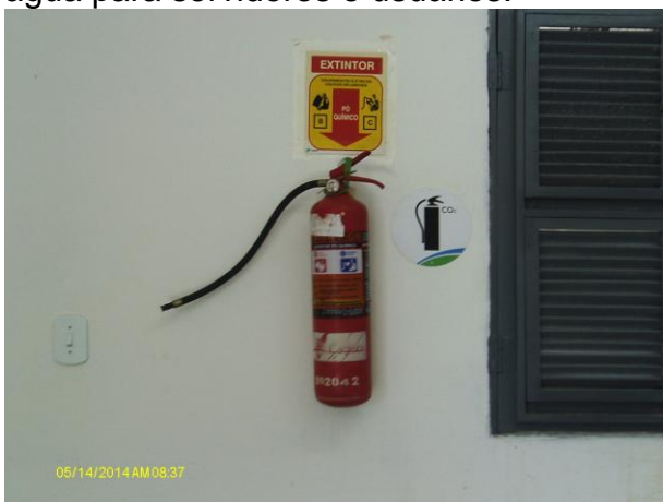
Foto 71 - Escritório/almoxarifado: extintor de incêndio.
