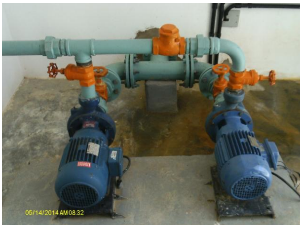
Foto 14 - EEAT-01: conjunto moto-bomba com reserva e vazamento na gaxeta da bomba.
