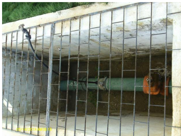
Foto 7 - ETA/AAB: registro na chegada da ETA.
