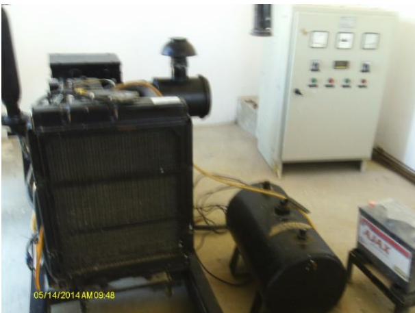
Foto 50 - EEE-01: grupo gerador de energia elétrica não instalado.
