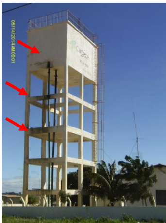
Foto 24 - REL-01: identificação, escada de acesso com guarda-corpo, guarda-corpo na laje de cobertura e sinais de vazamento.
