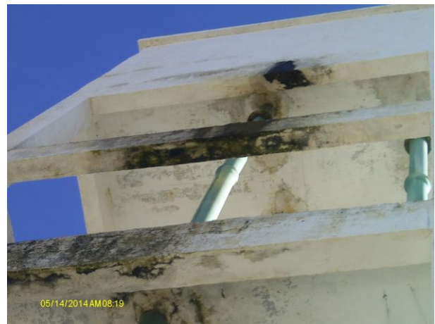
Foto 25 - REL-01: sinais de vazamento.
