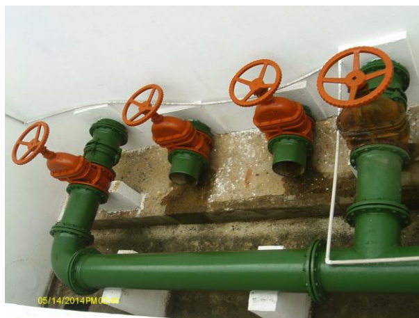
Foto 19 - RAP-01: caixa da descarga de fundo e registros sem tampa ou grade de proteção.
