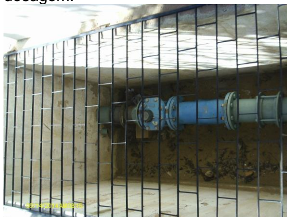
Foto 11 - ETA/AAT: medidor proporcional instalado na saída da ETA.
