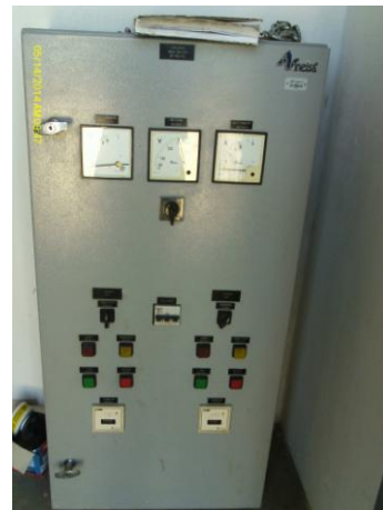
Foto 49 - EEE-01: quadro de comando.
