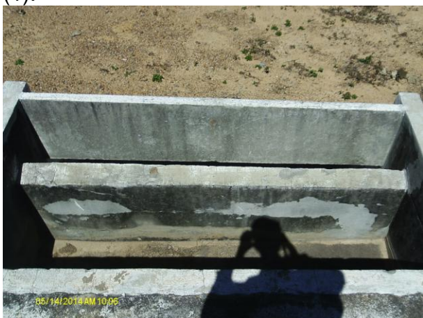
Foto 65 - ETE: caixa de saída da lagoa de maturação (1) para lagoa de maturação (2).
