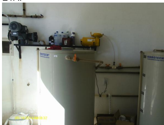
Foto 9 - Casa de química: tanques de dosagem.
