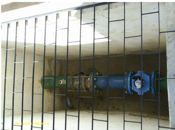
Foto 6 - ETA/AAB: medidor proporcional instalado na chegada da ETA.
