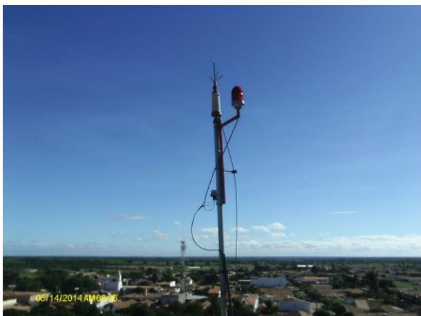
Foto 30 - REL-01: pára-raio e sinalização noturna de obstáculos.
