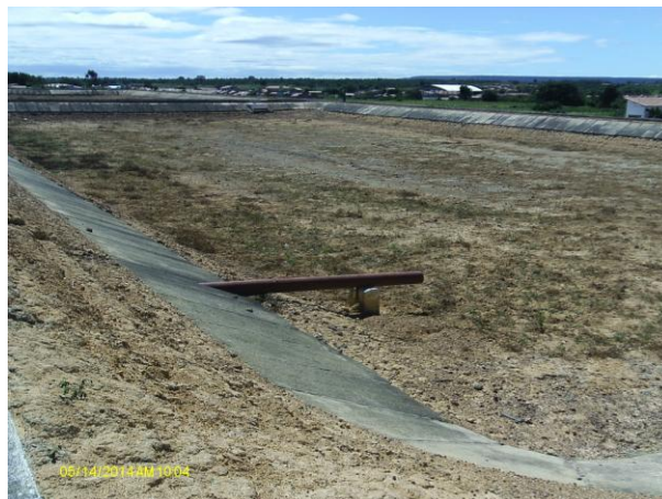
Foto 64 - ETE: lagoa de maturação (1).
