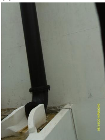
Foto 18 - RAP-01: tubo extravasor.
