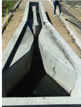
Foto 58 - ETE: calha Parshall.
