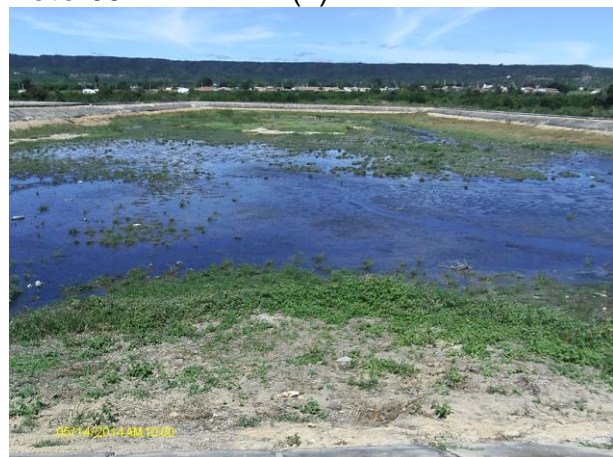
Foto 62 - ETE: leito da lagoa facultativa.
