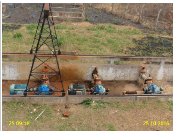
Foto 13 – EEAT-04 (na área do RAP-08): ausência de identificação.
