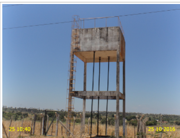
Foto 4 – REL-16 (Janeiro): pintura deteriorada, ausência de identificação, para-raios e sinalizador noturno.
