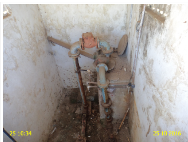
Foto 5 – Booster (na área do RAP-09): ausência de bomba reserva e pintura interna deteriorada.
