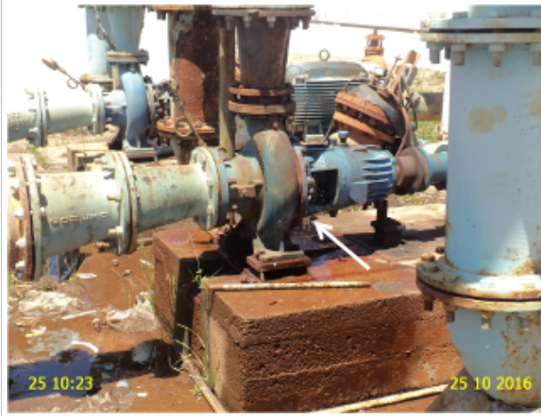
Foto 21 – EEAT-05 (Sede): vazamento no registro.
