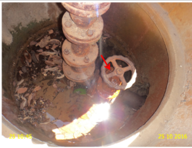
Foto 7 – AAT (Localidade de Janeiro): vazamento no registro da ventosa.
