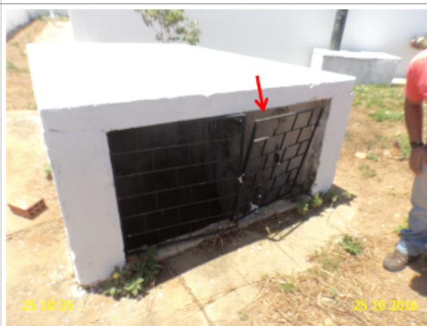
Foto 15 – Booster (na área do RAP-09): ausência de identificação e portão de acesso danificado.
