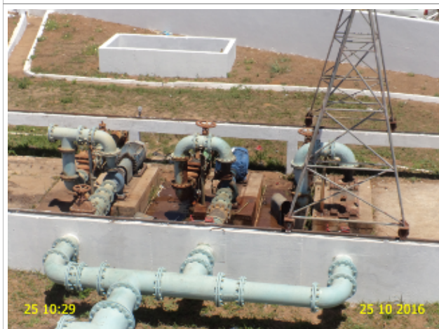
Foto 14 – EEAT-05 (Sede): ausência de identificação.
