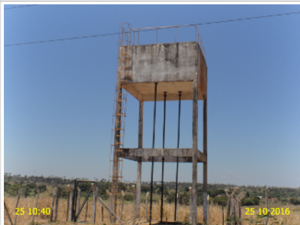
Foto 10 – REL-16 (Janeiro): pintura deteriorada, ausência de identificação, para-raios e sinalizador de obstáculos.
