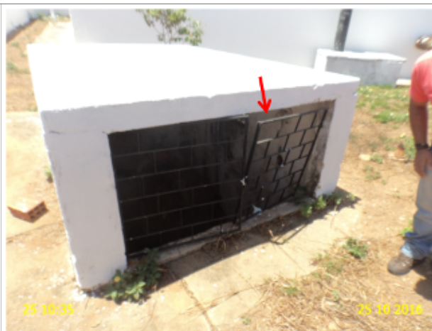
Foto 19 – Booster (na área do RAP-09): ausência de identificação e portão de acesso danificado.
