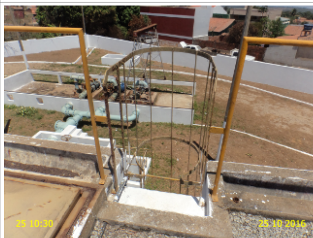
Foto 17 – RAP-09 (São João): escada e guarda-corpos com pintura deteriorada.
