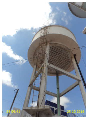
Foto 9 – REL-11(Sede): ausência de identificação.
