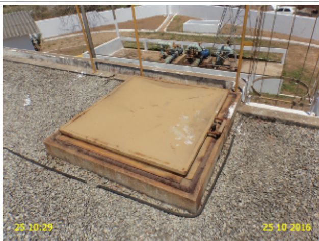
Foto 11 – RAP-09 (São João): tampa de inspeção com corrosão
