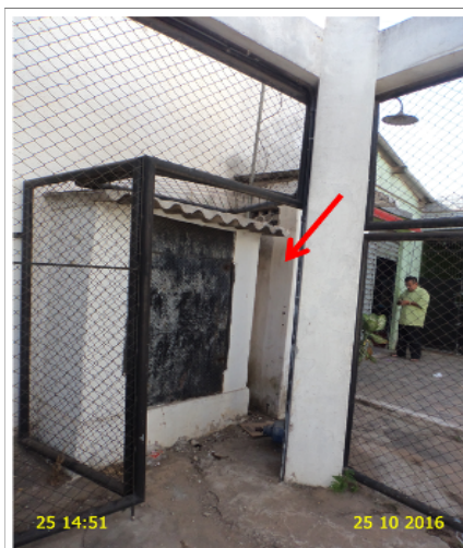
Foto 3 – REL-11 (Sede): sem proteção do acesso indevido de pessoas e animais.
