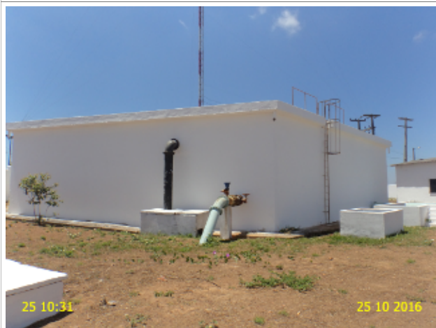
Foto 8 – RAP-09 (São João): ausência de identificação.
