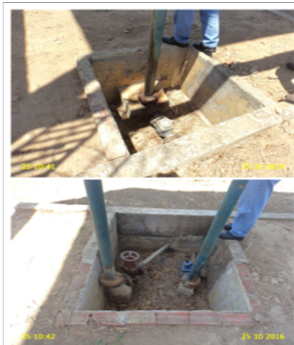
Foto 12 – REL-16 (Janeiro): caixas de inspeções sem tampa ou grade de proteção.
