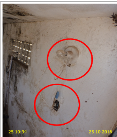
Foto 18 – Booster (na área do RAP-09): instalação elétrica inadequada e a lâmpada não ascende.
