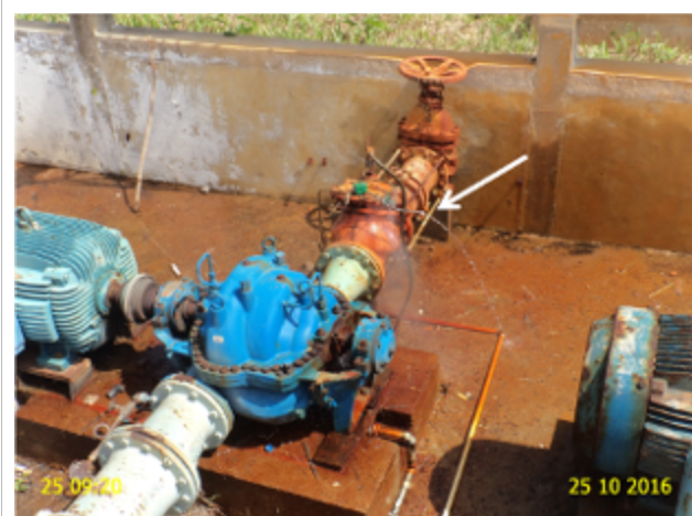
Foto 20 – EEAT-04 (na área do RAP-08): vazamento na válvula de vazão.
