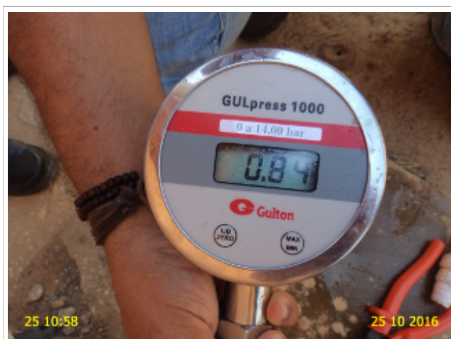
Foto 1 – Medição instantânea de pressão na rede de distribuição, no endereço localizado na Rua Pituba (SMS-39) – Distrito Pituba.
