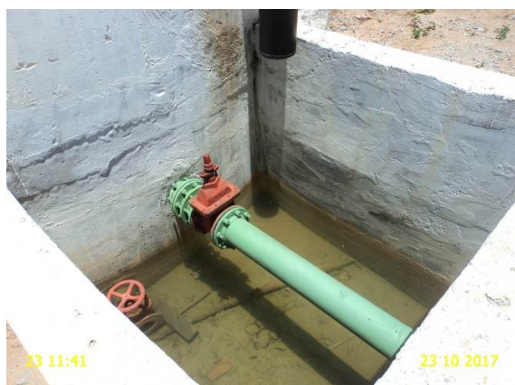
Foto 33 – Reservatórios: RAP – 02 apresentando sinais de extravasamento.
