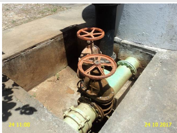
Foto 7 – ETA/Filtração: vazamento no registro.
