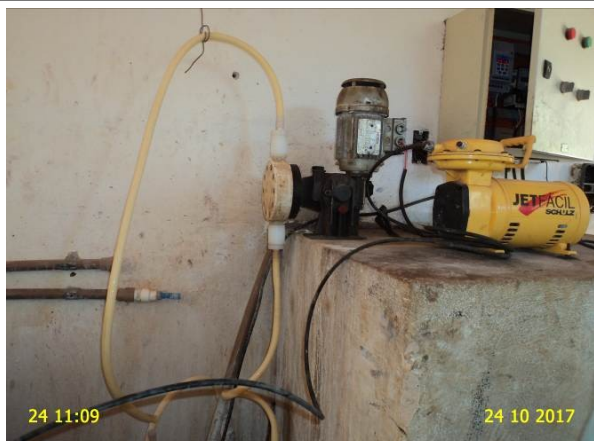
Foto 3 – ETA/Casa de química: bomba dosadora de hypocal com defeito.
