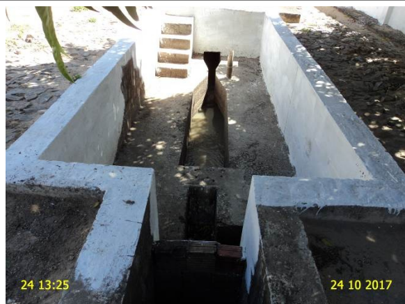
Foto 13 – EEE-01: ausência de guarda-corpo na área do gradeamento/caixa de areia.
