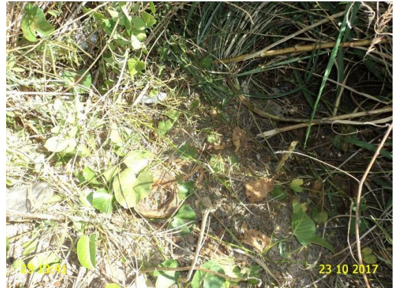
Foto 22 – RDA: registro de descarga soterrado no endereço Av. Boa Esperança.
