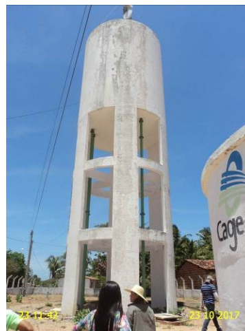
Foto 2 – Reservatórios: REL-03 sem identificação, pintura deteriorada e ausência de guarda-corpo na laje de cobertura.
