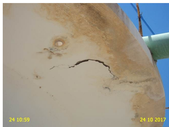
Foto 38 – ETA/Filtração: F-02 com reboco com pintura deteriorada e filtro F-01 com deteriorado.
