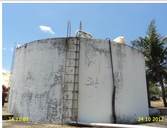
Foto 26 – Reservatórios: RAP-01 com pintura deteriorada.
