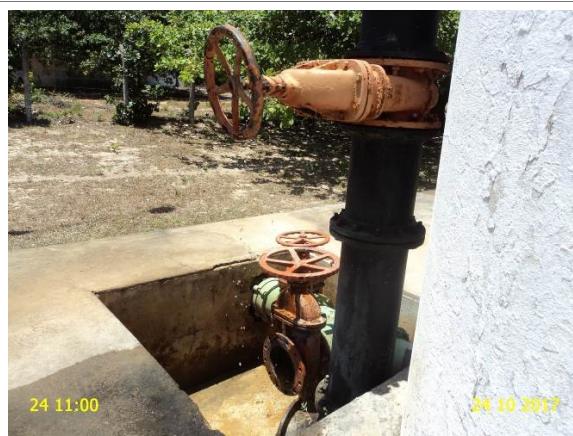
Foto 6 – ETA/filtração: registro do filtro F-01 sem vedação.
