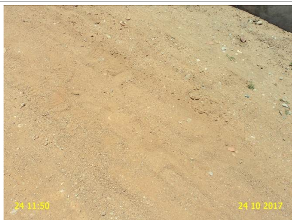
Foto 25 – RDA: registro de descarga soterrado no endereço Rua Pe Cícero.
