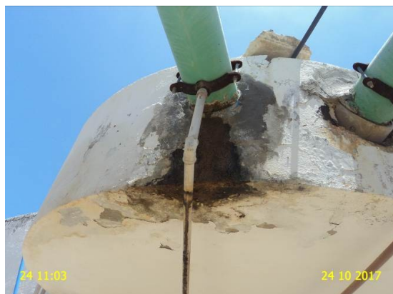
Foto 31 – Reservatórios: RAP-01 apresentando sinais de vazamento na entrada de água.
