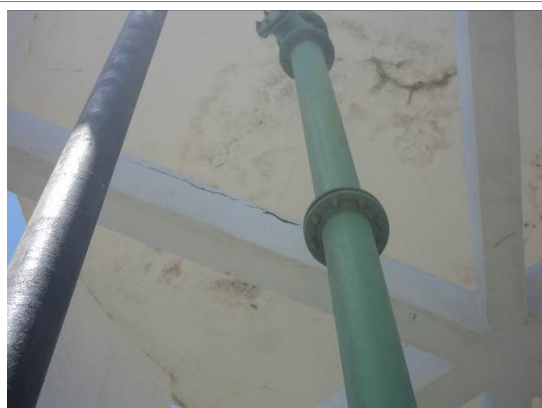
Foto 29 – Reservatórios: REL-02 apresentando armaduras expostas.
