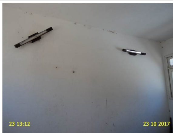
Foto 18 – Almoxarifado externo: lâmpadas com defeito.
