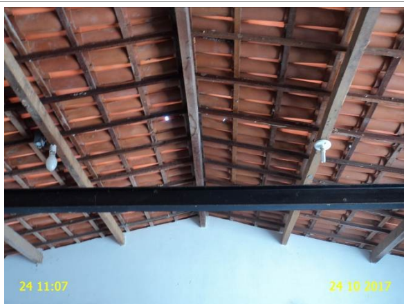
Foto 17 – EEAT-01: lâmpadas com defeito.
