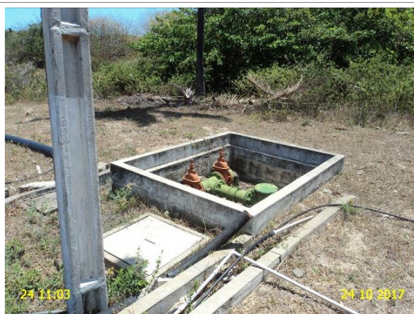
Foto 8 – ETA: caixa de inspeção sem tampa ou grade de proteção.
