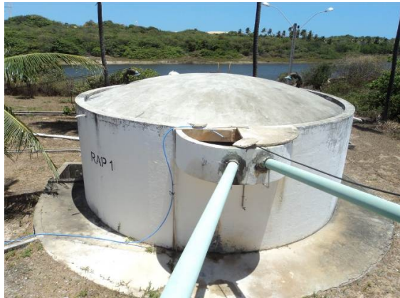
Foto 21 – Reservatórios: tampa de inspeção do RAP-01 sem vedação.
