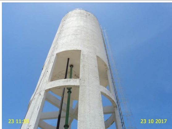
Foto 27 – Reservatórios: REL-02 com pintura deteriorada e ausência de identificação.
