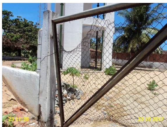
Foto 34 – Reservatórios: REL-03 portão de acesso danificado.
