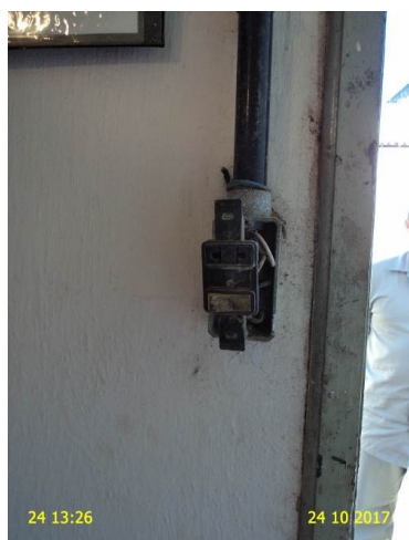
Foto 19 – EEE-01: instalações elétricas inadequadas.
