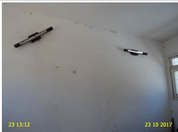
Foto 15 – Almoxarifado externo: lâmpadas com defeito.
