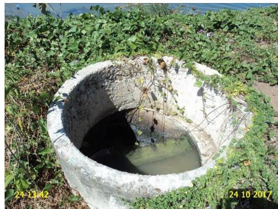
Foto 36 – ETE: caixa de inspeção sem tampa.
