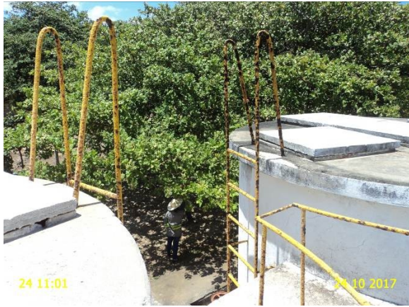
Foto 9 – ETA/Filtração: escadas de acesso e guarda-corpo dos filtros F-01 e F-02 em processo de corrosão.
