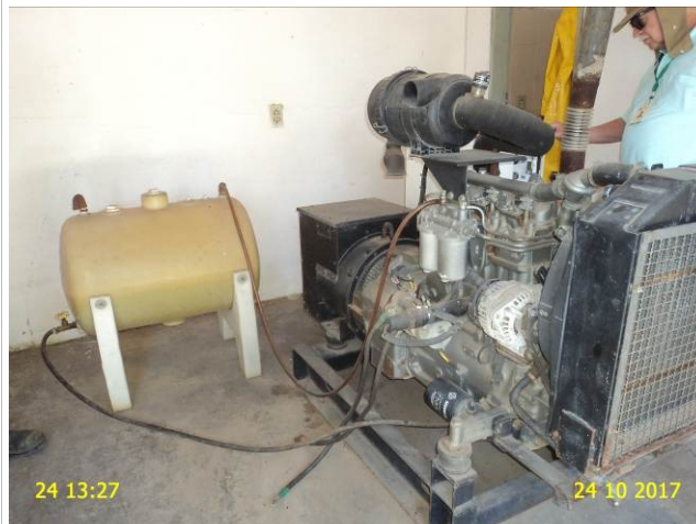
Foto 20 – EEE-01: grupo gerador de energia elétrica com defeito.
