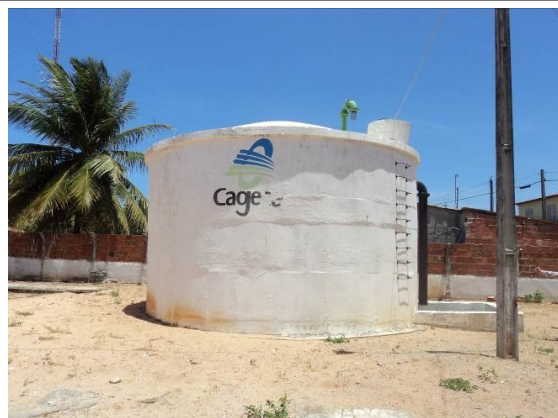
Foto 28 – Reservatórios: RAP-02 sem identificação.
