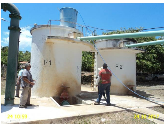
Foto 37 – ETA/Filtração: filtros F-01 e F-02 com pintura deteriorada e filtro F-01 com identificação pouco visível.
