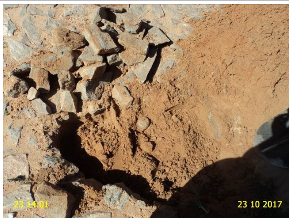
Foto 24 – RDA: registro de descarga soterrado no endereço Rua Francisco Eudes Martins.
