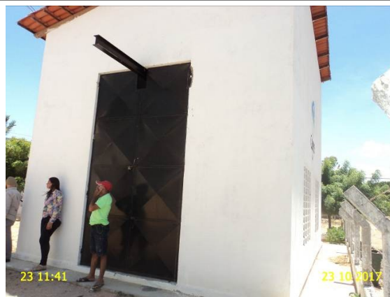
Foto 16 – EEAT-02: ausência de identificação.
