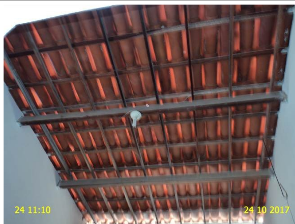
Foto 4 – ETA/Casa de química: lâmpada não ascende.
