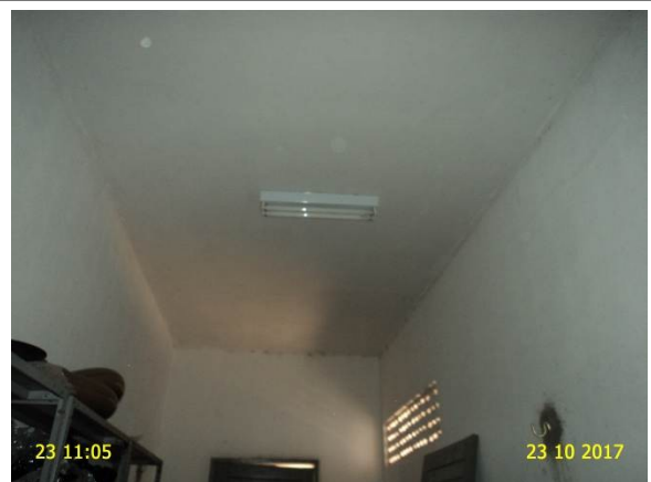
Foto 14 – Almoxarifado interno: lâmpada com defeito.
