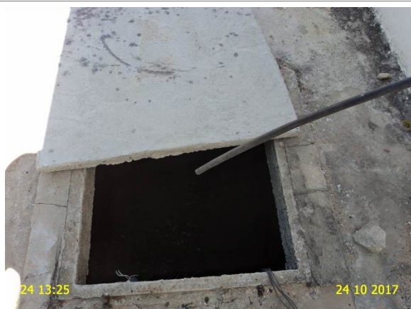
Foto 5 – EEE-01: tampa do poço de sucção sem vedação
