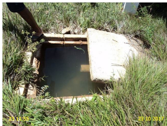
Foto 32 – Reservatórios: REL-02 apresentando sinais de extravasamento.
