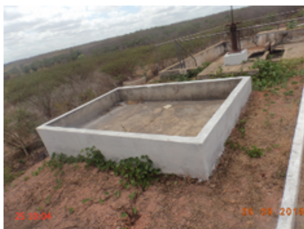
Foto 17 – ETE: O leito de secagem está rachado.
