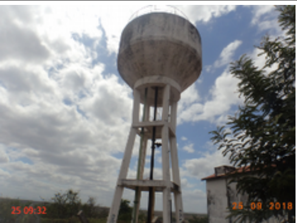
Foto 10 – Reservatório: O REL-02 está com a pintura deteriorada.
