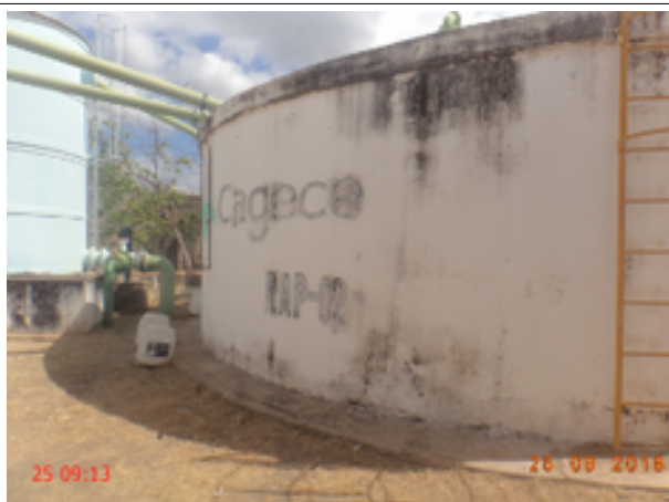
Foto 8 – Reservatório: O RAP-02 está com a pintura deteriorada.
