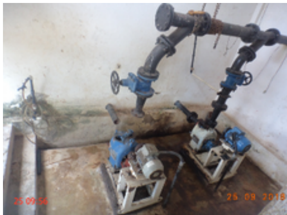
Foto 2 – Elevatória: na ETE-01 só existe uma bomba funcionando.
