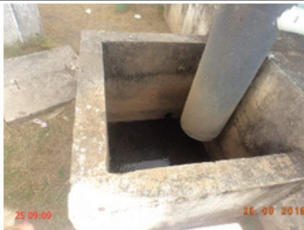
Foto 11 - Filtração: O registro do Filtro F-03 não garante vedação.
