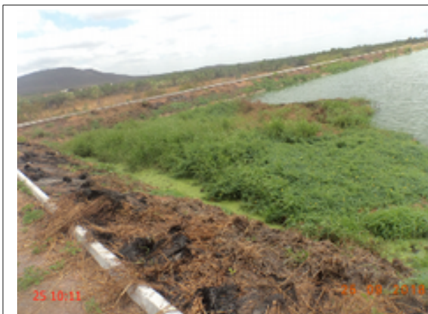
Foto 18 - ETE: A lagoa facultativa apresenta sobrenadantes.
