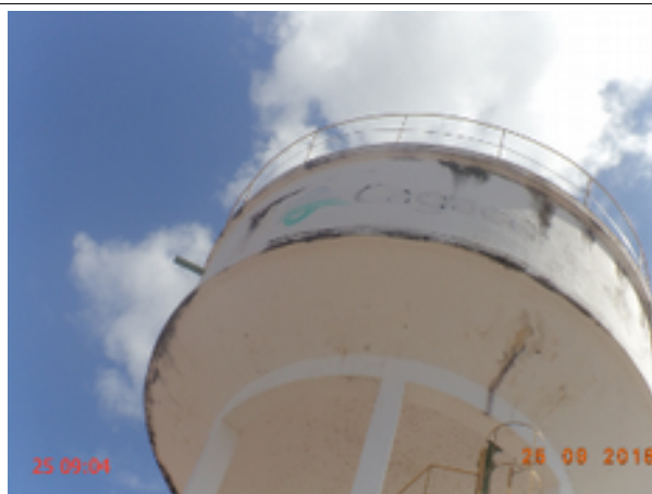
Foto 9 – Reservatório: O REL-01 está com a pintura deteriorada.
