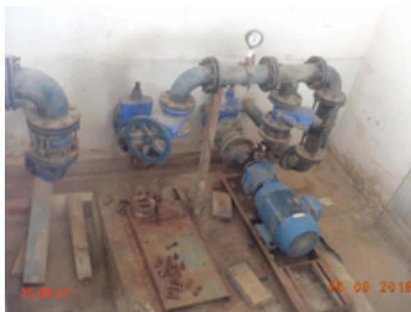
Foto 3 - Elevatória: A bomba reserva da elevatória EEAT-03 não está instalada.
