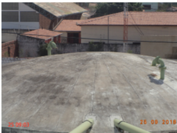
Foto 12 – Reservatório: O RAP-02 está com as tubulações de ventilação sem tela de proteção.
