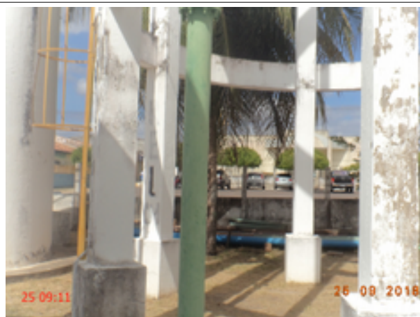
Foto 22 - Reservatório: O reservatório REL-01 está com a identificação pouco visível.
