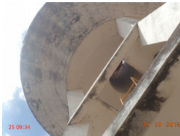
Foto 13 – Reservatório: A tampa do REL-02 não estava devidamente fechada.
