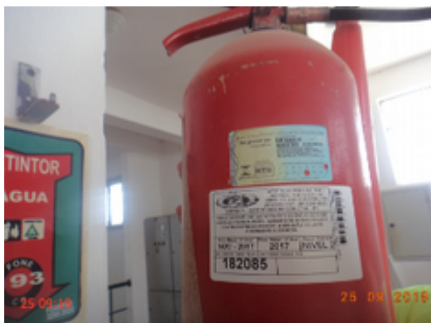
Foto 6 – Elevatória: O extintor de incêndio das elevatórias EEAT-01, EELF-01 e EELF-03 está com a recarga vencida.
