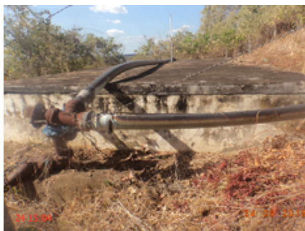
Foto 7 - Reservatório: O RAP-01 está com a pintura deteriorada.
