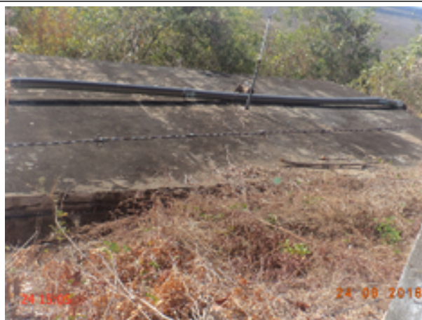
Foto 15 - Reservatório: O RAP-01 está com a tubulação de ventilação danificada.
