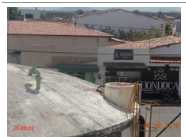
Foto 1 - Reservatório: ausência de tampa de inspeção no RAP-02.
