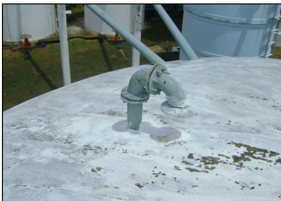
Foto 31 – RAP-02: Tubulação de ventilação.
