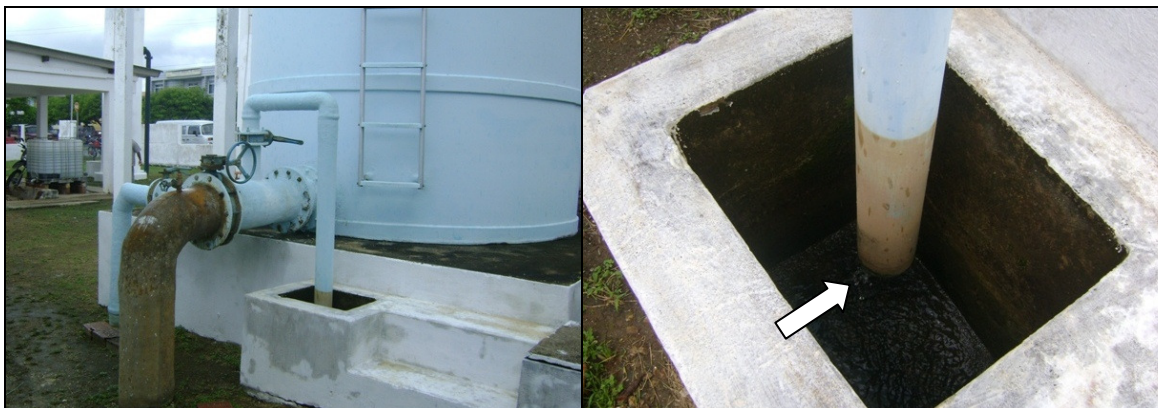
Fotos 6 e 7 – Registro do Filtro 03 com problema de vedação.
