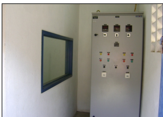
Foto 27 – Quadro de comando da EEAT-02.
