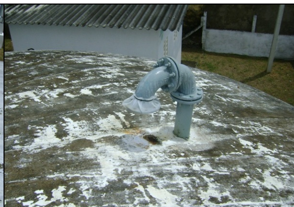
Foto 32 – RAP-02: Tubulação de ventilação.
