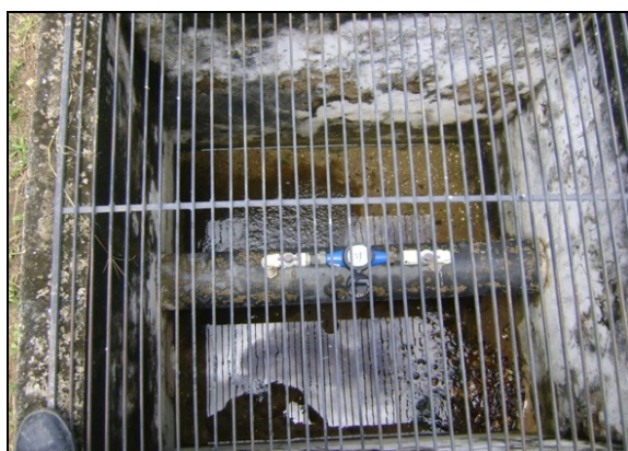
Foto 38 – Medidor proporcional de água tratada na saída da EEAT-03.
