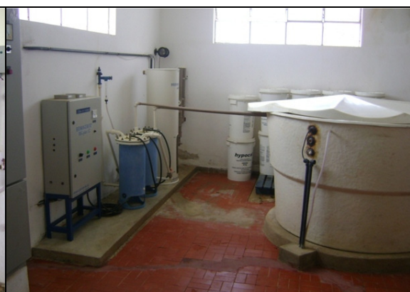
Foto 10 – Vista da fábrica de cloro.
