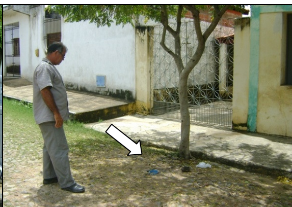
Foto 43 – Registro de descarga sem tampa de proteção, localizado na Rua Antônio de Carvalho Rocha, Centro.
