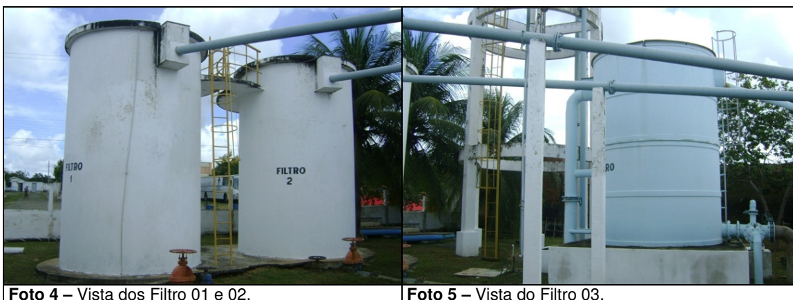
Foto 4 – Vista dos Filtros 01 e 02.
