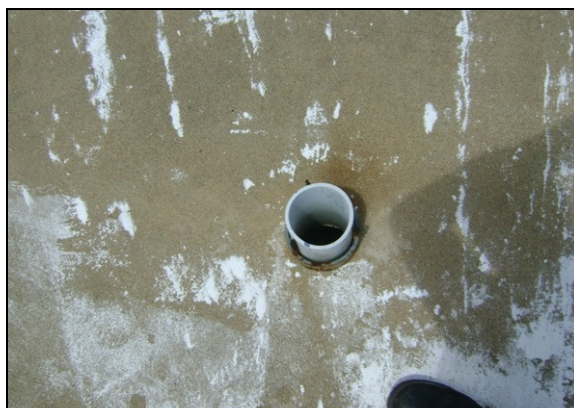
Foto 35 – REL-01: Tubulação de ventilação inadequada.
