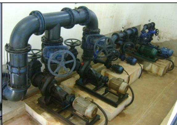
Foto 23 – Elevatórias EELF-01, EEAT-01 e EEAT-03.
