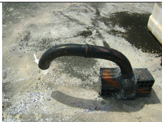
Foto 24 – RAP-01: Tubulação de ventilação sem tela de proteção.
