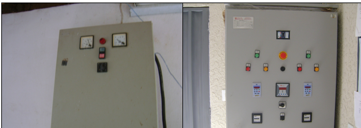
Foto 3 – PA-01 :Quadro de comando.
