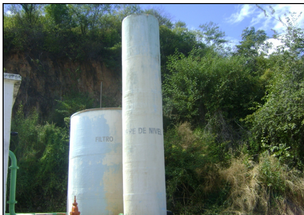
Foto 7 – ETA: Filtro e torre de nível
