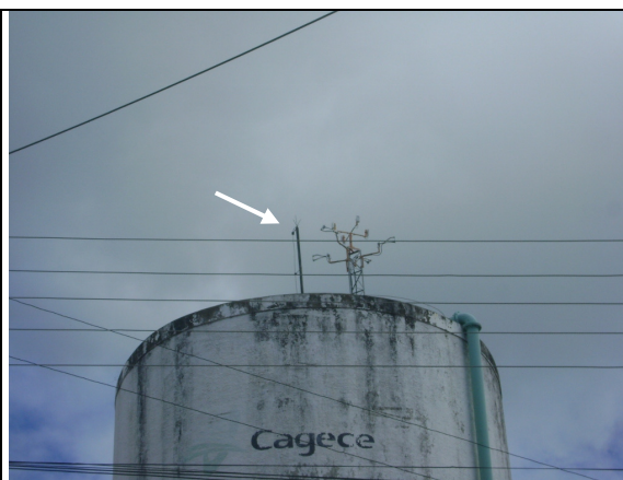
Foto 27 – REL-01: Ausência de guarda-corpo na laje superior e de sinalizador noturno.
