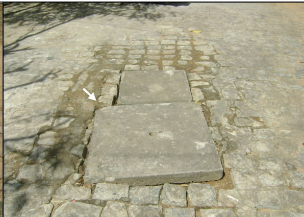
Foto 32 – Registro de descarga localizado na Rua Projetada 13.
