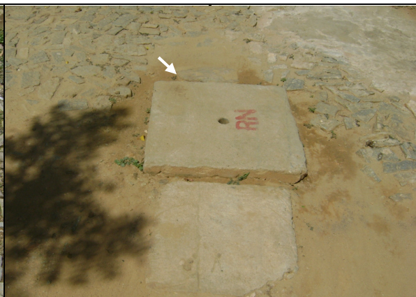
Foto 34 – Registro de descarga localizado na Rua André Pusas.
