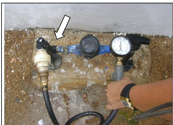
Foto 37 – Medição de pressão na Rua Manoel Doca – Escola Municipal Maria Alcides da Silva.
