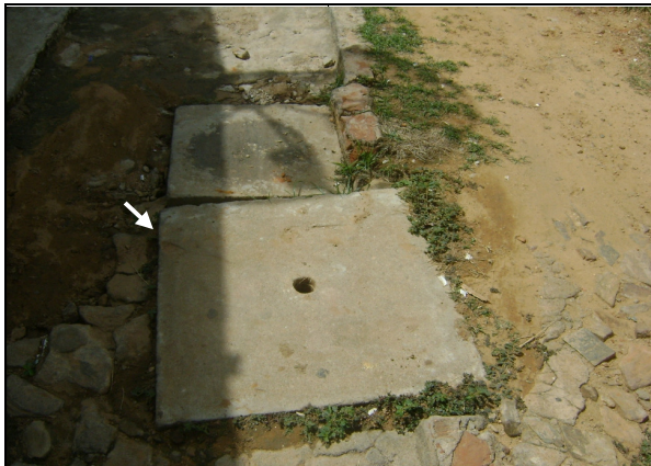
Foto 31 – Registro de descarga localizado na Rua Padre José Sobreira.
