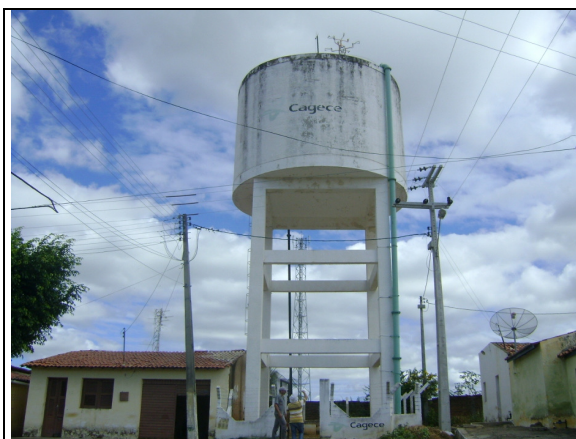
Foto 26 – REL-01: Existência de identificação.
