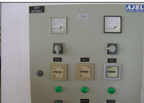
Foto 22 – EELF-01: Quadro de comando.
