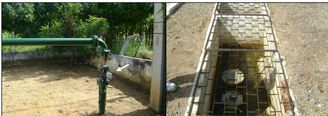
Foto 19 – Macromedidor na saída do PA-01.
