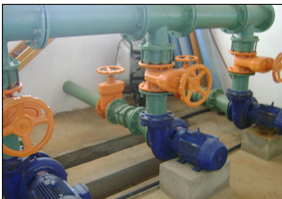
Foto 21 – EELF-01: Conjunto moto-bomba.
