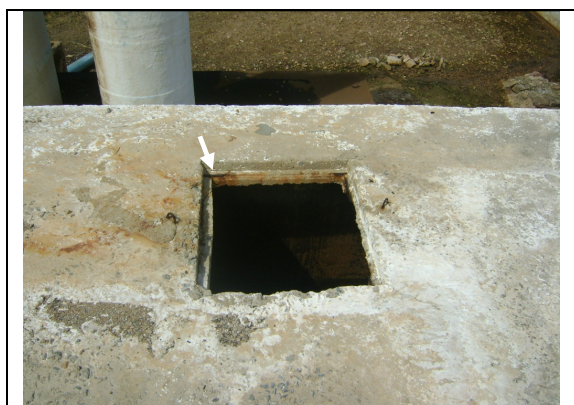
Foto 25 – RAP-01: Ausência de tampa de visita.
