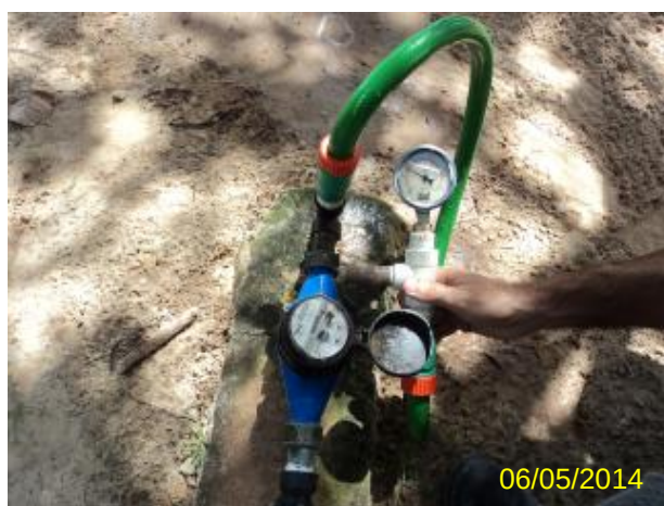
Foto 81 – RDA: medição instantânea de pressão na R. Samuel Bede, SMS22.
