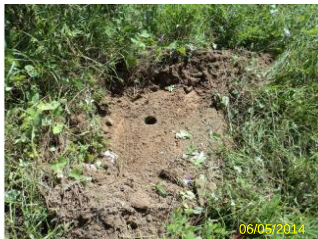
Foto 91 – RDA: registro de descarga na R. Jasmin.
