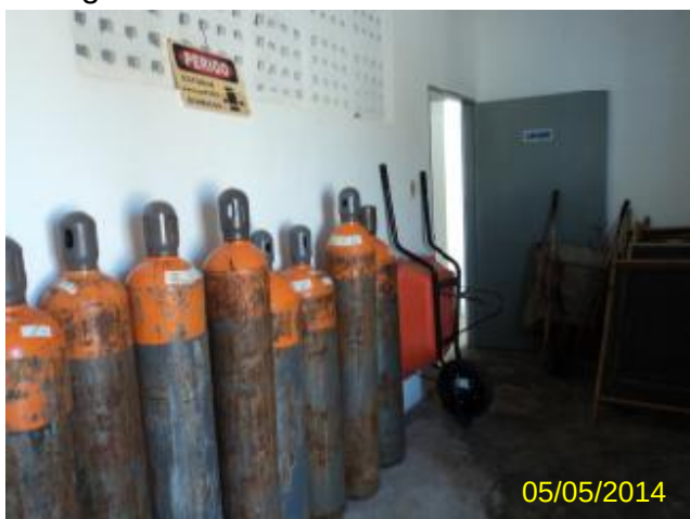
Foto 35 – Casa de química: cloro gasoso.
