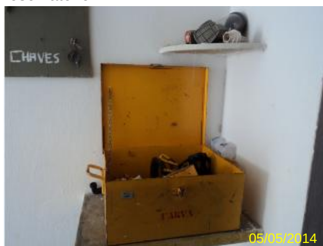
Foto 38 – Casa de química: KIT de emergência.
