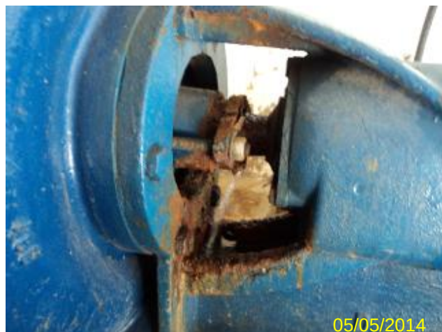
Foto 57 – EELF-01: vazamento no conjunto moto-bomba.
