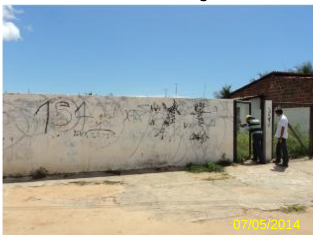
Foto 105 – EEE-Vila Xexeu: ausência de identificação e pintura deteriorada.
