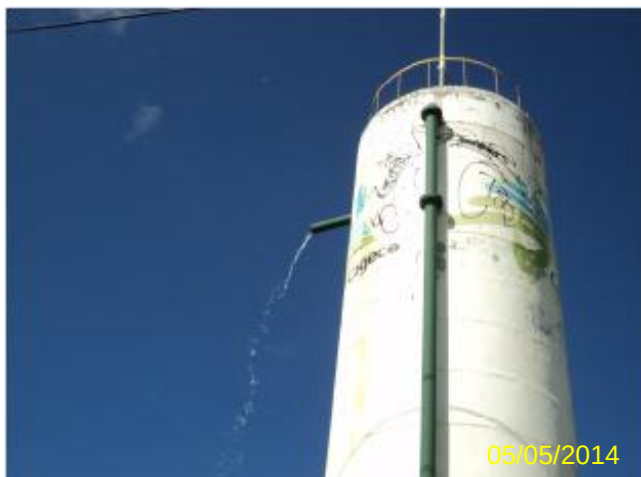
Foto 10 – AAB: caixa de quebra de pressão - extravasamento.
