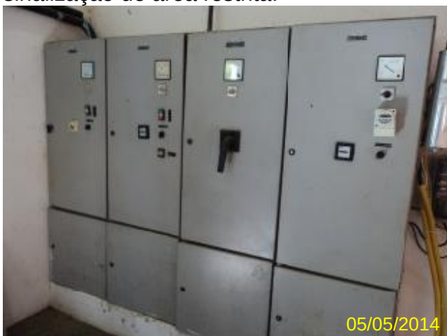
Foto 7 – EEAB-01: quadro de comando.
