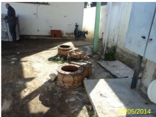
Foto 23 – ETA: pátio externo – peças soltas, sem armazenamento adequado.
