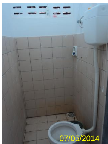
Foto 135 – ETE-Mutirão: instalações sanitárias.
