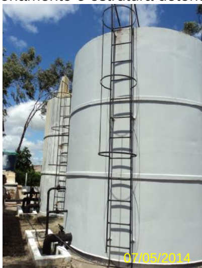
Foto 121 – ETE-Mutirão: escadas de acesso.
