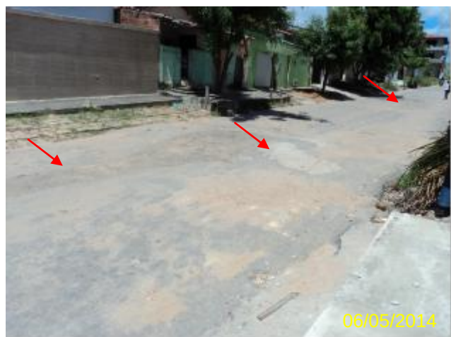
Foto 100 – RDA: R. Padre Maximiniano – problemas frequentes de rompimento da tubulação.
