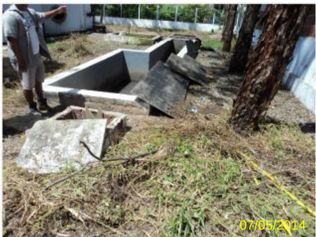
Foto 115 – ETE-Mutirão: vista geral do tratamento.
