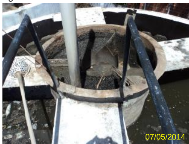
Foto 124 – ETE-Mutirão: reator ativo – presença de sobrenadantes.
