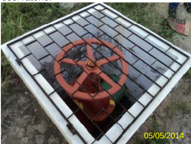
Foto 75 – REL-01: válvula com caixa de proteção.
