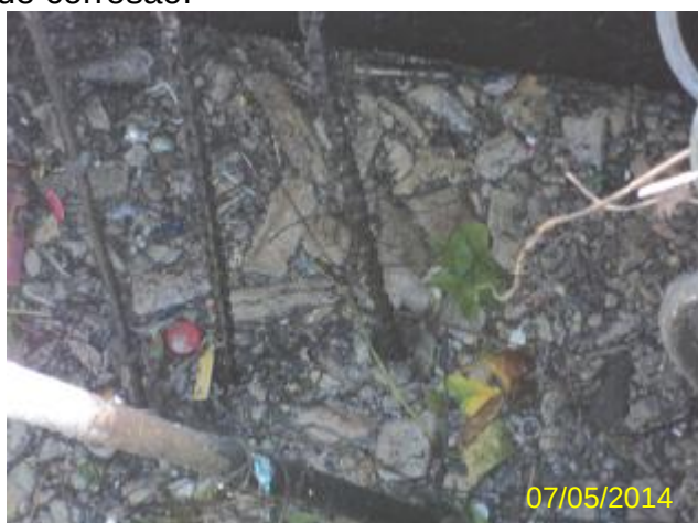
Foto 111 – EEE-Vila Xexeu: vista interna do poço de sucção – necessitando de limpeza.
