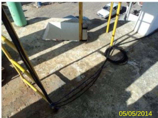
Foto 73 – REL-01: fiação exposta na laje do reservatório.
