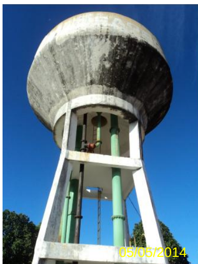
Foto 69 – REL-01: escada de acesso e pintura deteriorada.
