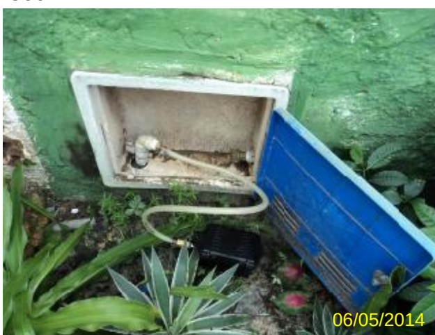
Foto 89 – RDA: medição contínua de pressão na R. SDO 34, 10.
