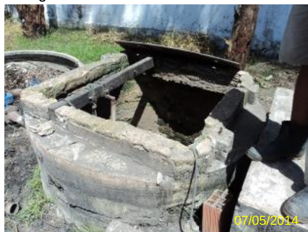
Foto 118 – ETE-Mutirão: poço de sucção.
