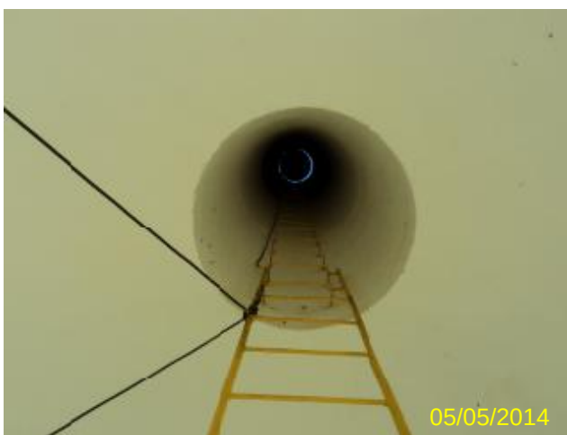
Foto 78 – REL-01: escada de acesso – fiação exposta.
