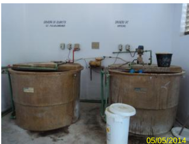
Foto 32 – Casa de química: tanque de polialumínio parado devido a falta de bomba.
