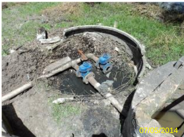
Foto 119 – ETE-Mutirão: apenas uma bomba em funcionamento e estrutura deteriorada.
