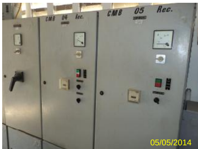
Foto 52 – EEAT-01: quadro de comando.
