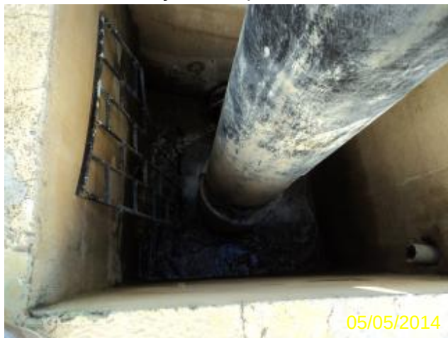
Foto 30 – Filtração: vazamento no filtro F-01.
