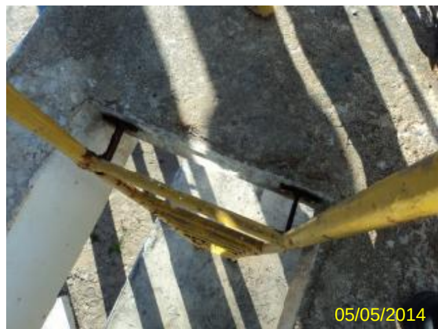
Foto 70 – REL-01: escada de acesso em processo de corrosão.
