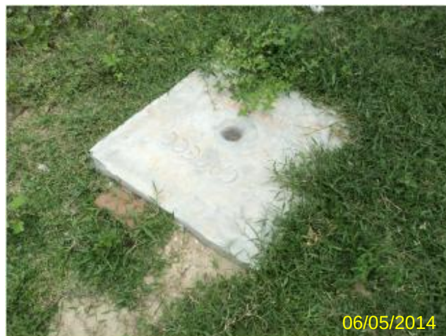
Foto 99 – RDA: registro de descarga na Av. Chanceler Edson Queiroz.
