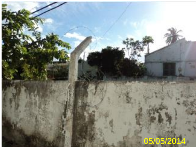
Foto 62 – EERD-01 ( Booster ): cerca danificada.
