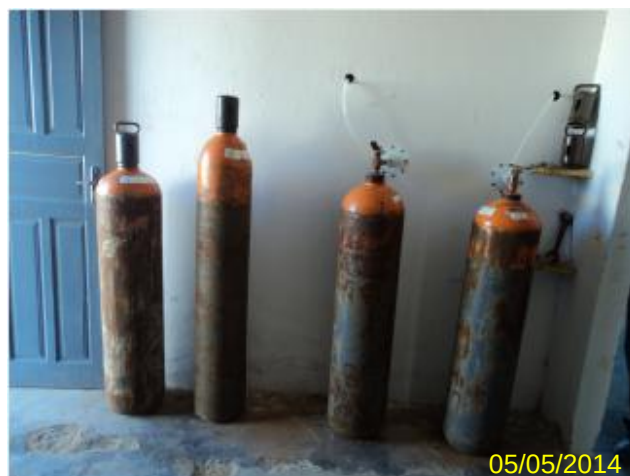
Foto 34 – Casa de química: cloro gasoso.
