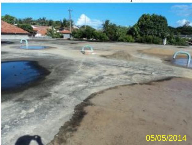
Foto 65 – RAP-01: tubulações de ventilação e acúmulo de água.
