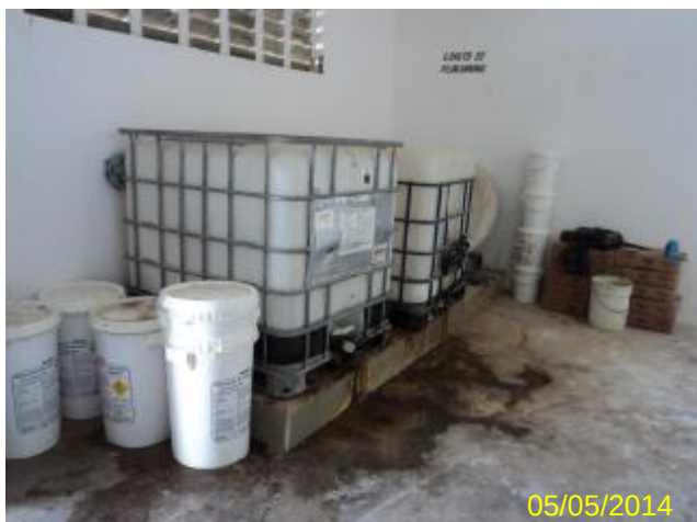
Foto 33 – Casa de química: tanques do dosagem.
