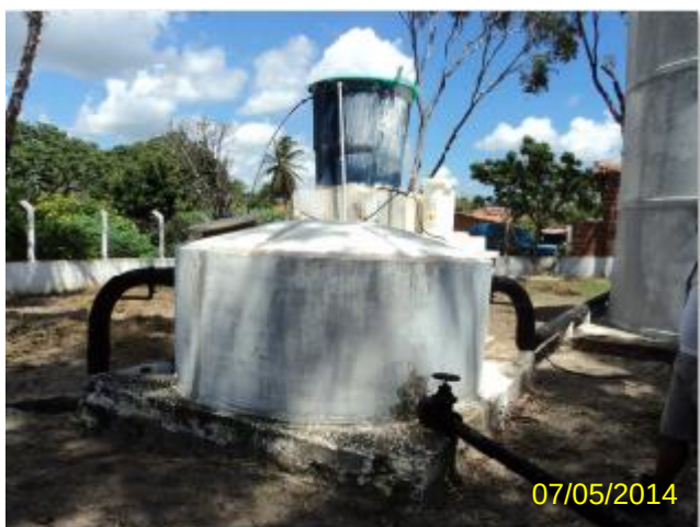
Foto 127 – ETE-Mutirão: tanque de contato para desinfecção.
