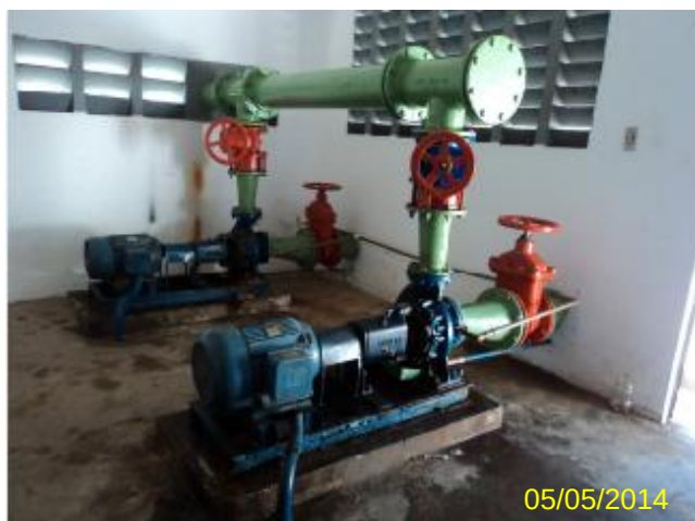
Foto 60 – EERD-01 (Booster): conjunto moto-bomba.
