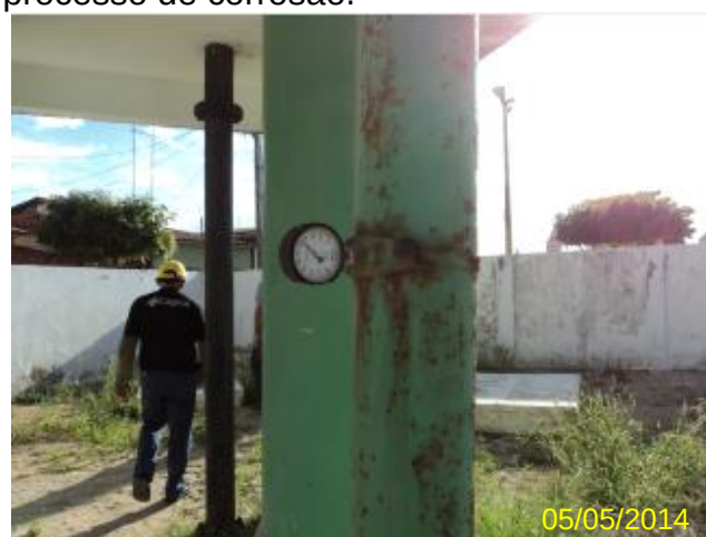
Foto 72 – REL-01: medidor de nível.
