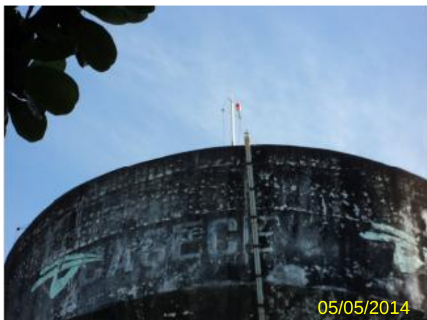
Foto 79 – REL-01: controle de nível, para-raios e sinalização noturna.
