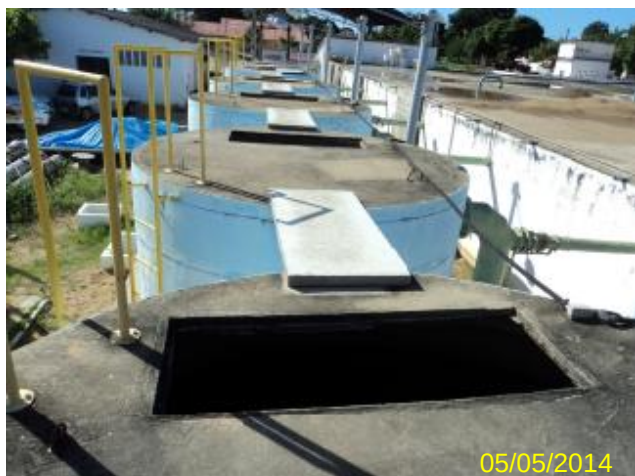
Foto 27 – Filtração: ausência de tampas.
