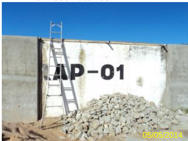
Foto 63 – RAP-01: pintura deteriorada, escada de acesso e identificação.
