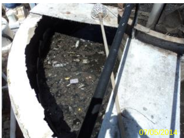
Foto 123 – ETE-Mutirão: reator ativo – presença de sobrenadantes.
