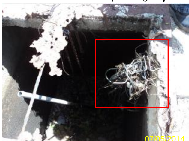
Foto 110 – EEE-Vila Xexeu: poço de sucção – tampa corroída e fiação exposta.
