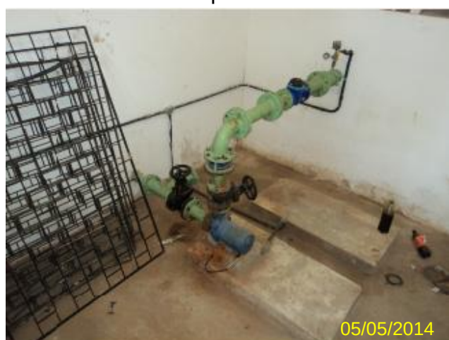
Foto 54 – EEAT-02: conjunto moto-bomba.
