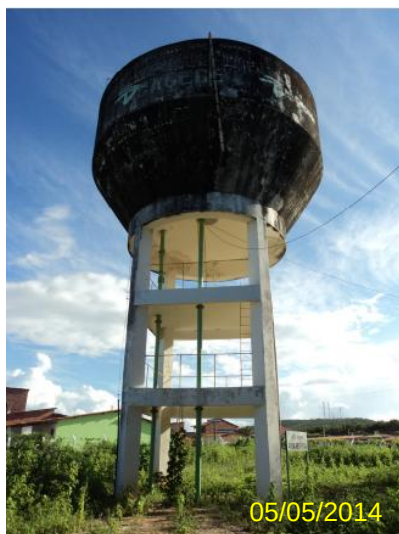
Foto 77 – REL-01: pintura deteriorada e área coberta pela vegetação.
