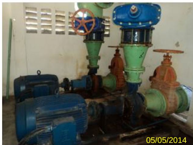
Foto 51 – EEAT-01: conjunto moto-bomba.
