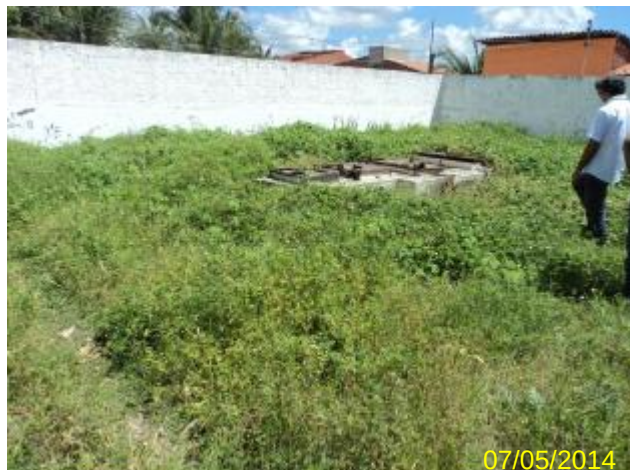
Foto 108 – EEE-Vila Xexeu: vista geral do tratamento – área coberta pela vegetação.
