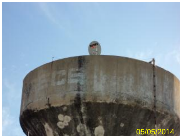
Foto 74 – REL-01: controle de nível, para raios e sinalização noturna.
