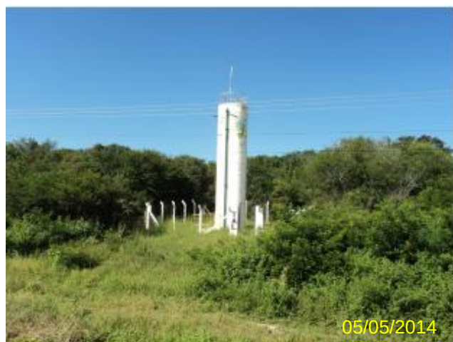
Foto 8 – AAB: caixa de quebra de pressão – área de acesso.
