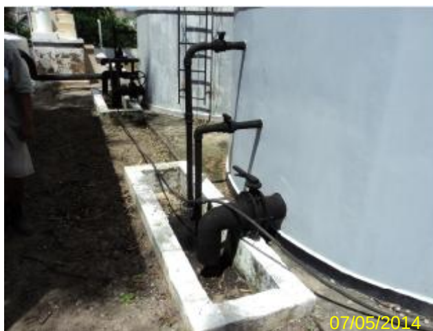
Foto 122 – ETE-Mutirão: tubulações e registros.
