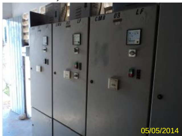
Foto 58 – EELF-01: quadro de comando.
