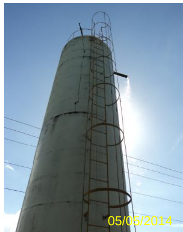
Foto 11 – AAB: caixa de quebra de pressão – escada de acesso.
