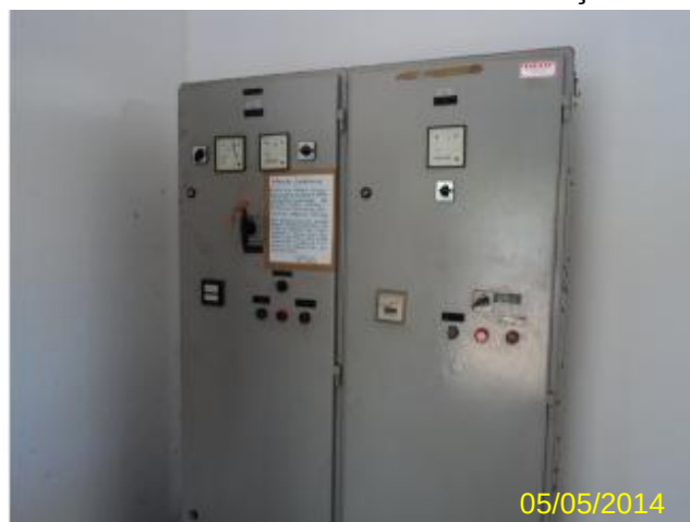
Foto 61 – EERD-01 (Booster): quadro de comando.
