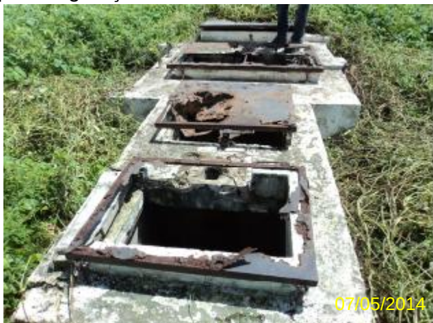
Foto 109 – EEE-Vila Xexeu: vista geral do tratamento – poços com tampas em processo de corrosão.
