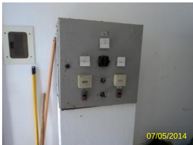
Foto 131 – ETE-Mutirão: quadro de comando.
