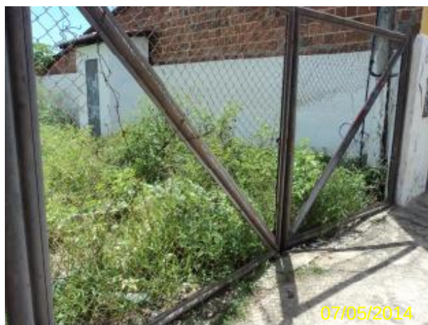
Foto 106 – EEE-Vila Xexeu: portão danificado.
