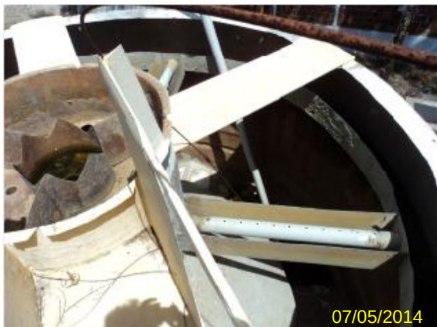
Foto 125 – ETE-Mutirão: reator desativado.
