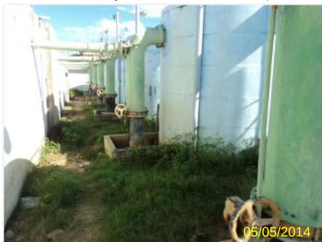
Foto 29 – Filtração: tubulações e registros.
