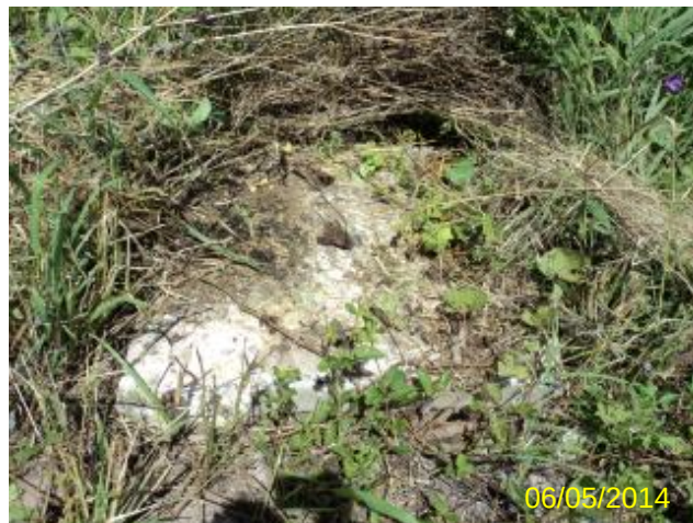
Foto 97 – RDA: registro de descarga na CE-040.
