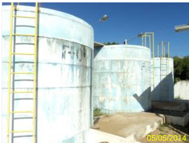
Foto 26 – Filtração: F-04, F-05 e F-06 com escadas de acesso.
