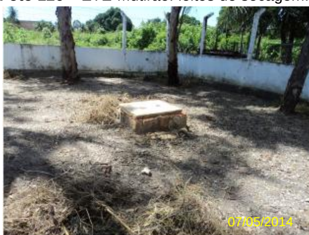
Foto 128 – ETE-Mutirão: poço de saída do efluente tratado.
