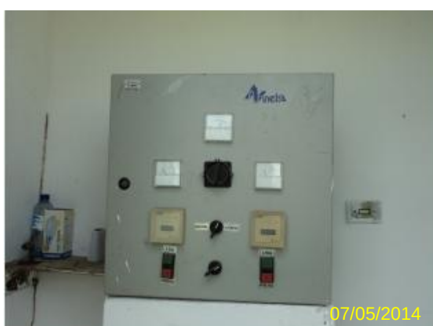
Foto 112 – EEE-Vila Xexeu: quadro de comando.
