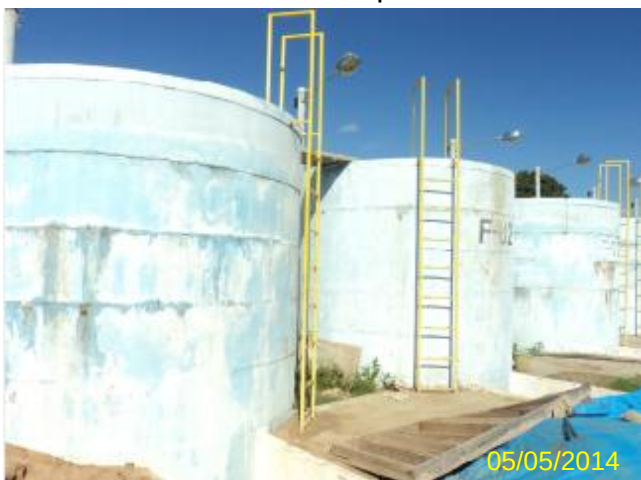
Foto 25 – Filtração: F-01, F-02 e F-03 com escadas de acesso.
