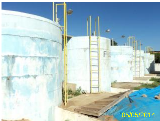
Foto 24 – Filtração: F-01, F-02, F-03, F-04, F-05 e F-06.
