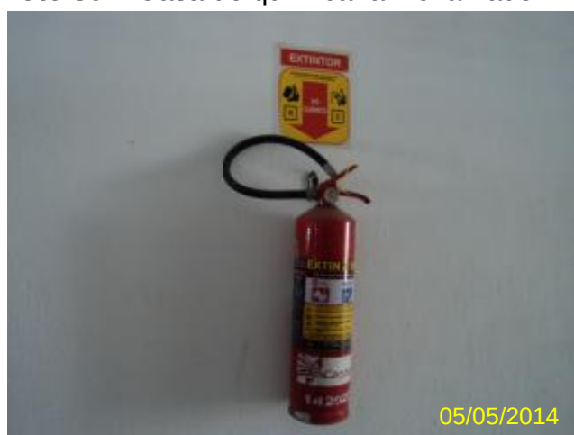
Foto 41 – Casa de química: extintor de incêndio.
