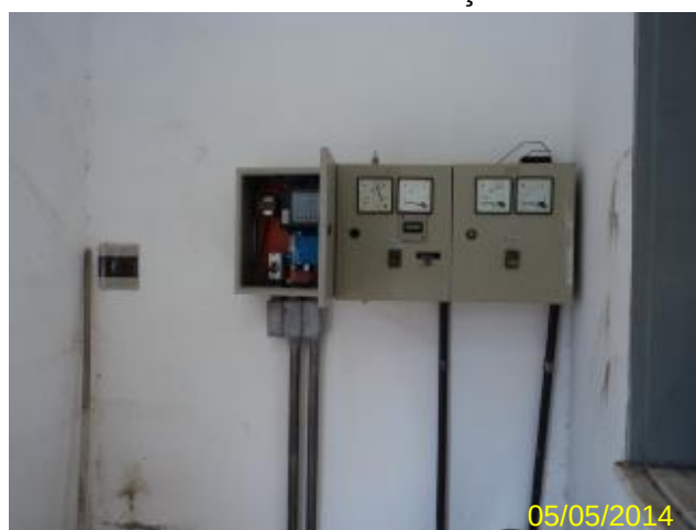
Foto 55 – EEAT-02: quadro de comando.
