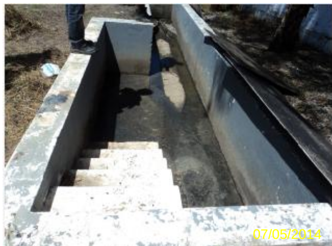
Foto 117 – ETE-Mutirão: caixa de areia.
