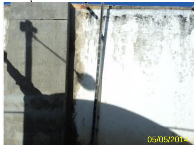
Foto 66 – RAP-01: medidor de nível.
